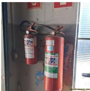
Foto 9 - Extintor de incêndio
