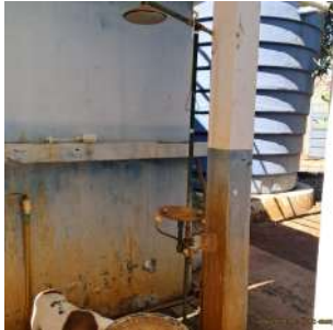
Foto 26 - Chuveiro de emergência
