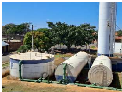
Foto 6 - Vista superior dos reservatórios apoiados ETA Santa Fé (R100,R85,R50)
