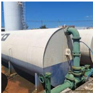
Foto 2 - Reservatório apoiado Santa Fé (R85 e R50)
