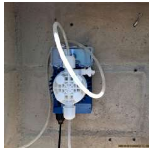
Foto 13 - Bomba dosadora de flúor
