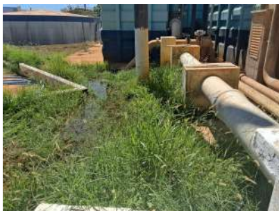
Foto 1 - Vazamento provocando acúmulo de água próximo a ETA
