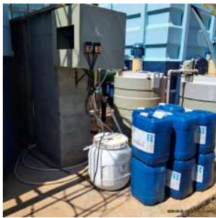
Foto 1 - Armazenamento de cloro
