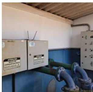
Foto 1 - Painel de comando e controle II
