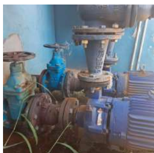
Foto 3 - Conjuntos motobombas I
