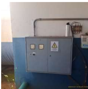
Foto 5 - Painel de comando e controle I
