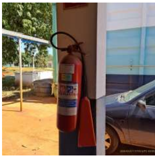
Foto 24 - Extintor de incêndio
