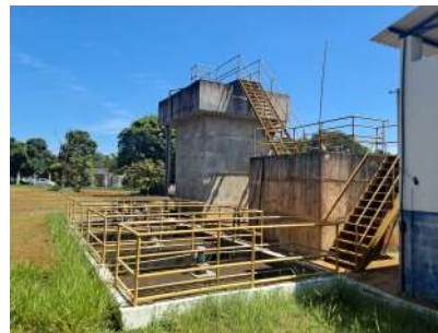
Foto 2 - Vista lateral do sistema de tratamento de lodo fora de operação
