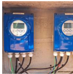
Foto 5 - Display do medidor vazão da entrada
