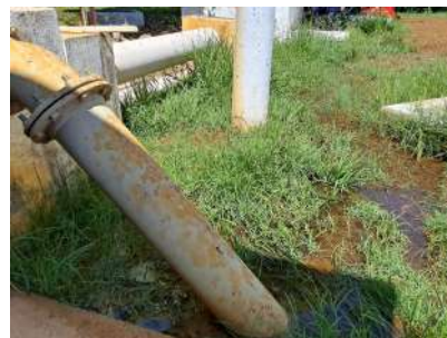
Foto 2 - Vazamento provocando acúmulo de água próximo a ETA
