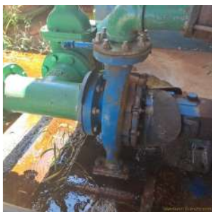
Foto 1 - Ausência de drenagem da gaxeta
