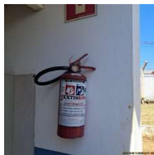
Foto 2 - Extintor de incêndio
