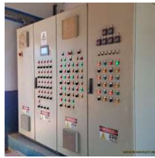
Foto 25 - Painele de comando e controle
