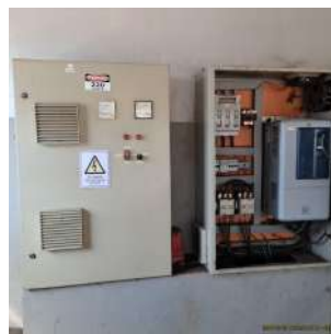
Foto 10 - Painele de comando e controle
