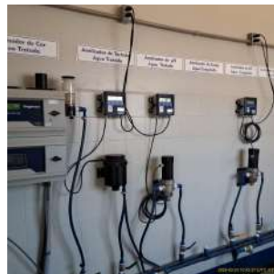
Foto 2 - Display dos analisadores on-line
