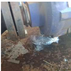
Foto 1 - Vazamento no selo mecânico da bomba
