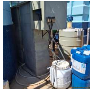
Foto 11 - Armazenamento e dosagem de cloro
