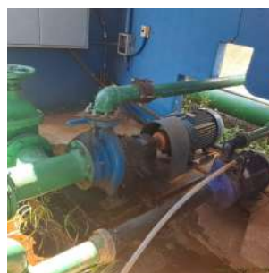
Foto 4 - Conjuntos motobombas II
