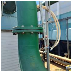
Foto 10 - Ponto de dosagem de cloro
