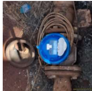
Foto 7 - Medidor de vazão da saída II
