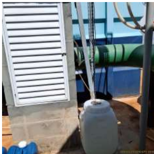
Foto 12 - Armazenamento e dosagem de flúor
