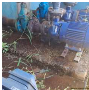
Foto 2 - Vazamento no selo mecânico da bomba
