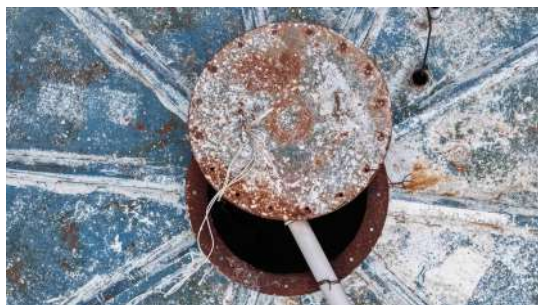
Foto 1 - Corrosão na tampa de inspeção e ao redor dela, na parte superior do reservatório.
