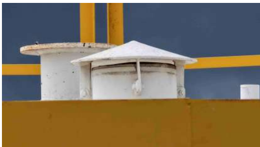
Foto 9 - Tubo de ventilação com tela de proteção.
