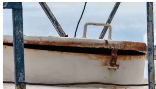
Foto 2 - Tampa de inspeção do reservatório, parcialmente aberta durante a fiscalização.
