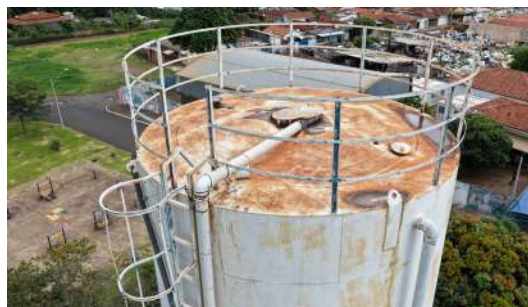
Foto 4 - Início de corrosão nas laterais do reservatório.
