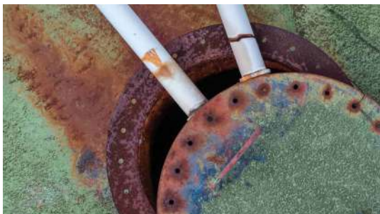
Foto 3 - Tampa de inspeção do reservatório 1 apresenta corrosão.
