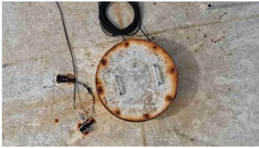
Foto 1 - Tampa apresenta corrosão e permanece entreaberta para passagem de um cabo.
