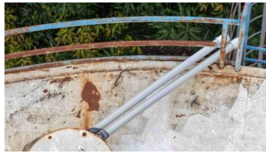
Foto 10 - Tubulação (condutores para cabos dos sensores de nível?) instalada no reservatório apoiado 1.
