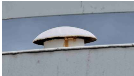
Foto 18 - Reservatório cilíndrico: ventilação na parte superior.
