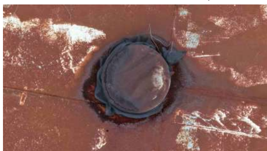
Foto 9 - Corrosão no reservatório apoiado 2.
