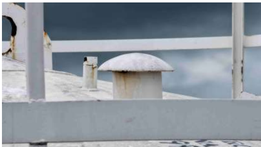
Foto 17 - Reservatório cilíndrico: ventilação na parte superior.
