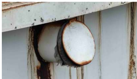
Foto 2 - Corrosão no reservatório apoiado 1.
