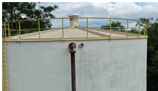
Foto 2 - Corrosão em tubulação.
