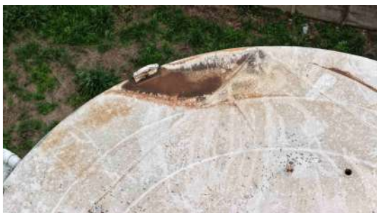
Foto 1 - Corrosão na parte superior do reservatório.
