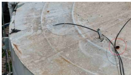
Foto 2 - Aberturas de ventilação no topo do reservatório não possuem tela de proteção e
