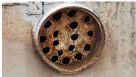
Foto 7 - Tubo extravasor do reservatório.
