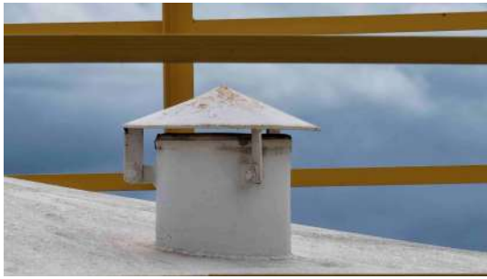
Foto 11 - Tubo de ventilação com tela de proteção.
