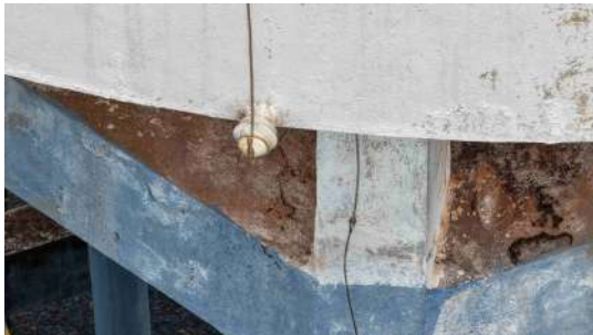
Foto 7 - Condutor do SPDA.
