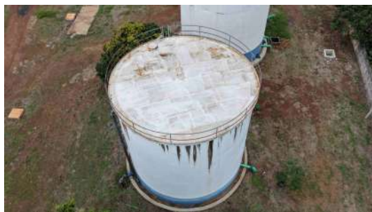
Foto 1 - Corrosão no reservatório apoiado 1.
