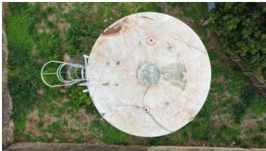
Foto 3 - Aberturas de ventilação no topo do reservatório não possuem tela de proteção e permitem a entrada de água de chuva.
