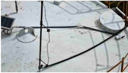
Foto 10 - Conductor do SPDA do reservatório 1.
