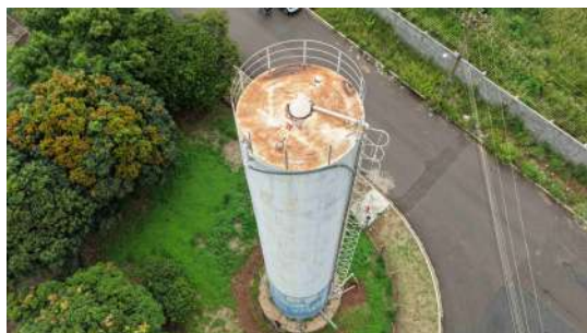
Foto 5 - Início de corrosão nas laterais do reservatório.
