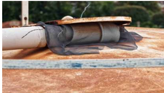
Foto 4 - Tampa de inspeção está entreaberta.
