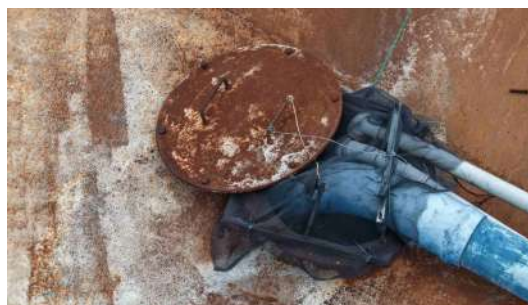
Foto 6 - Corrosão no reservatório apoiado 2.
