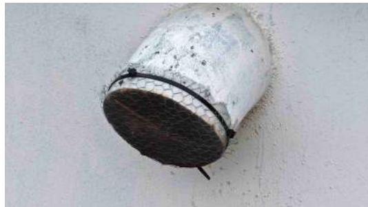
Foto 16 - Tubo extravasor do reservatório 1.
