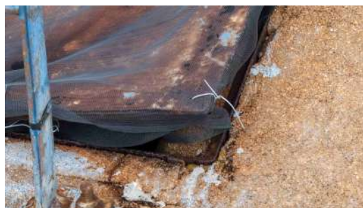
Foto 2 - Tampa de inspeção na parte superior do reservatório apresenta deformação, corrosão e não possui distância mínima 0,10 m em relação à superfície da cobertura do reservatório.
