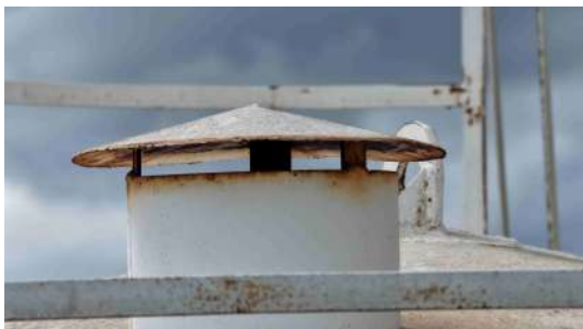
Foto 1 - Tubo de ventilação sem tela de proteção.
