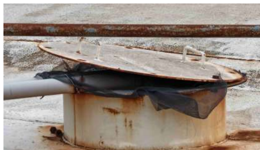
Foto 4 - Corrosão no reservatório apoiado 1.
