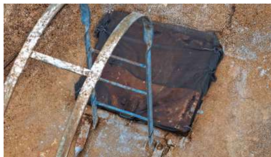
Foto 4 - Tampa de inspeção na parte superior do reservatório apresenta deformação, corrosão e não possui distância mínima 0,10 m em relação à superfície da cobertura do reservatório.
