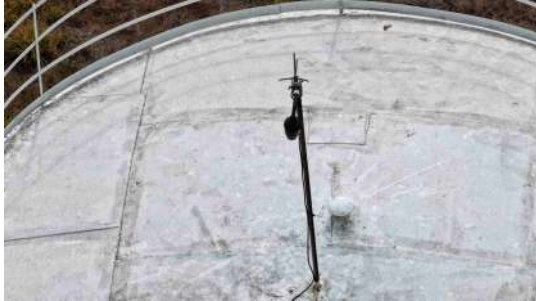
Foto 1 - Tubulação de ventilação na parte superior do reservatório.
