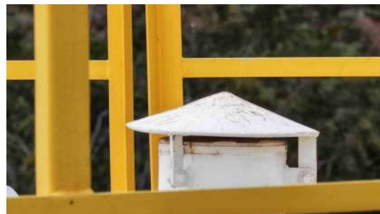
Foto 10 - Tubo de ventilação com tela de proteção.
