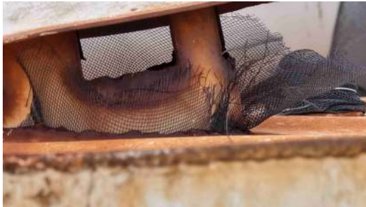
Foto 1 - Abertura de ventilação na parte superior do reservatório apresenta tela solta.
