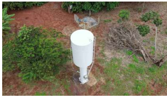
Foto 2 - Não há guarda corpo na escada do reservatório.
