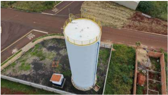
Foto 2 - Vista lateral exibindo tubo extravasor e tubo de dreno.
