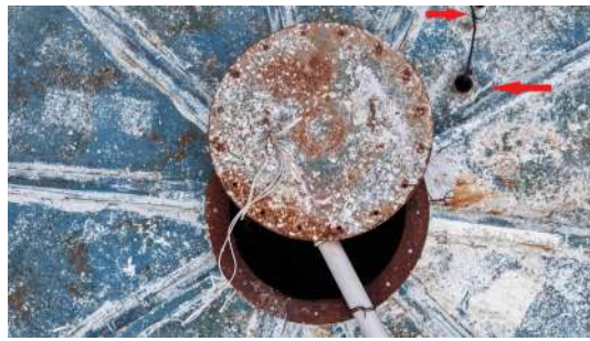
Foto 4 - Aberturas na parte superior do reservatório taça, sem tela de proteção.
