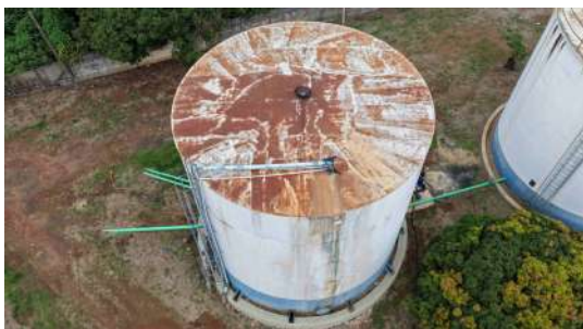
Foto 1 - Ausência de guarda corpo na parte superior do reservatório apoiado 2.
