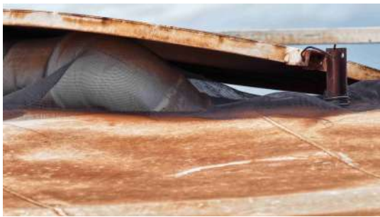
Foto 1 - Tampa de inspeção está entreaberta.
