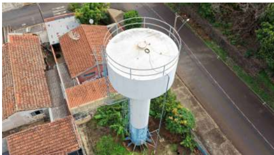
Foto 7 - Vista geral do reservatório, evidenciando tubo extravasor..
