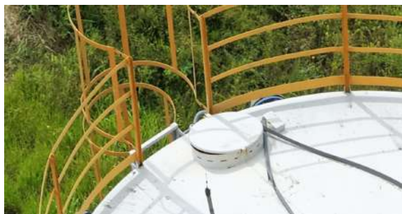
Foto 1 - Tampa de inspeção do reservatório 1 entreaberta.
