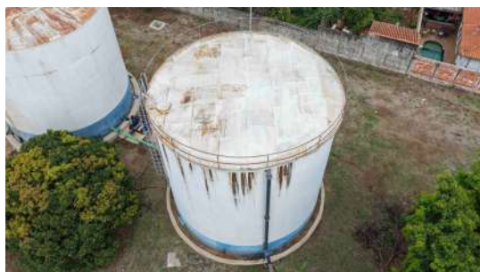
Foto 5 - Corrosão no reservatório apoiado 1.
