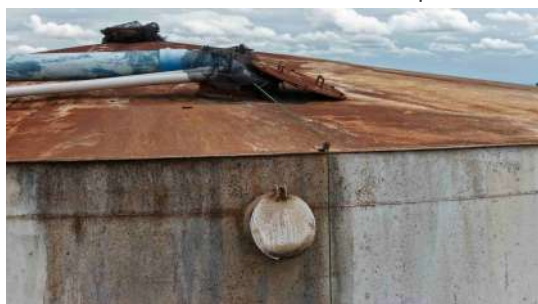
Foto 7 - Corrosão no reservatório apoiado 2.
