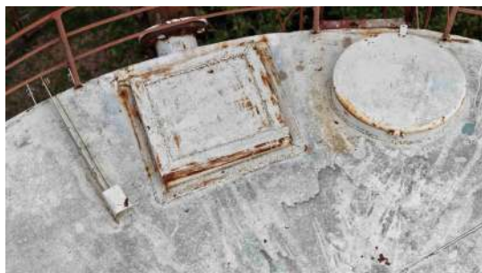
Foto 1 - Tampas de inspeção apresentam corrosão.
