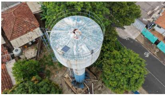
Foto 3 - Aberturas na parte superior do reservatório taça, sem tela de proteção.
