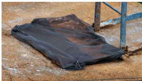
Foto 3 - Tampa de inspeção na parte superior do reservatório apresenta deformação, corrosão e não possui distância mínima 0,10 m em relação à superfície da cobertura do reservatório.
