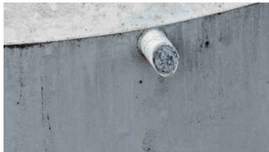
Foto 9 - Tubo extravasor do reservatório, fora de utilização.
