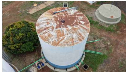
Foto 13 - Vista geral reservatório apoiado 2, não há guarda corpo no topo do reservatório.
