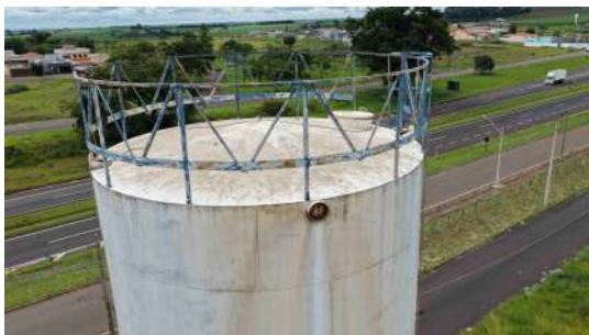
Foto 6 - Tubo extravasor do reservatório.
