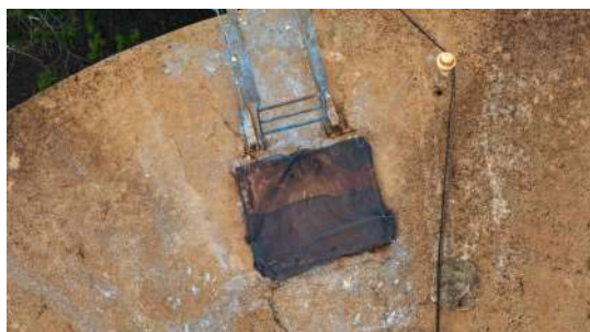
Foto 1 - Tampa de inspeção na parte superior do reservatório apresenta deformação, corrosão e não possui distância mínima 0,10 m em relação à superfície da cobertura do reservatório.
