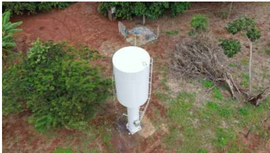
Foto 1 - Não há cercamento limitando o acesso ao reservatório.
