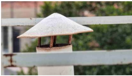
Foto 1 - Tubo de ventilação sem tela de proteção.
