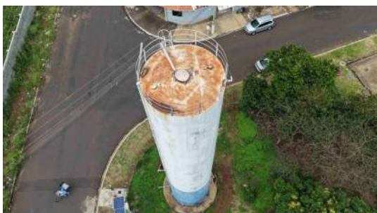
Foto 1 - Corrosão na parte superior do reservatório.
