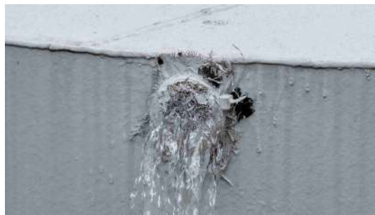
Foto 2 - No momento da fiscalização vazava água pelo extravasor.
