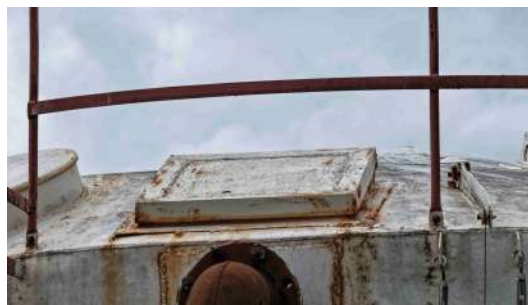
Foto 2 - Tampas de inspeção apresentam corrosão.
