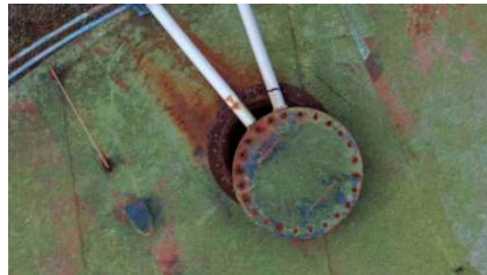
Foto 2 - Tampa de inspeção do reservatório 1 apresenta corrosão e está entreaberta.
