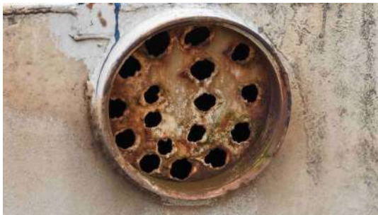
Foto 1 - Tubo extravasor permite entrada de insetos.
