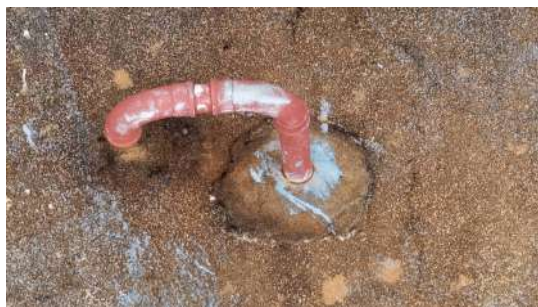
Foto 13 - Tubulação de ventilação do reservatório.
