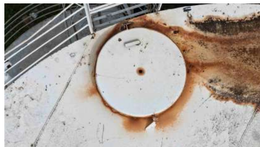
Foto 2 - Corrosão na parte superior do reservatório.
