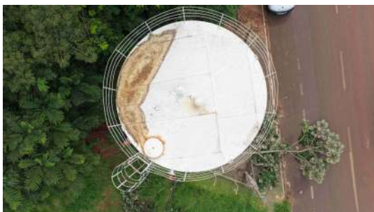
Foto 1 - Corrosão na parte superior do reservatório.
