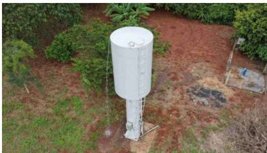
Foto 1 - No momento da fiscalização vazava água pelo extravasor.
