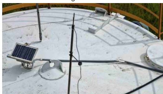
Foto 9 - Antena do SPDA no reservatório 1.
