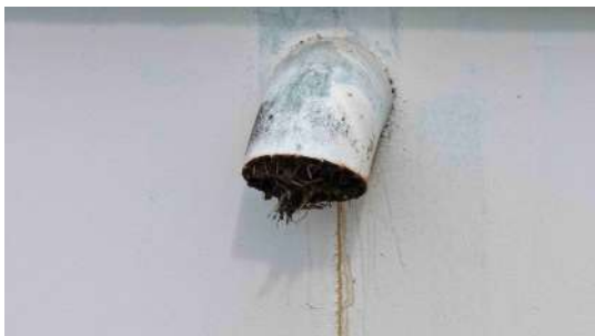
Foto 17 - Tubo extravasor do reservatório 2.
