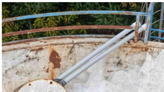
Foto 3 - Corrosão no reservatório apoiado 1.
