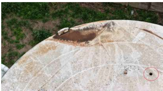
Foto 1 - Aberturas de ventilação no topo do reservatório não possuem tela de proteção e
