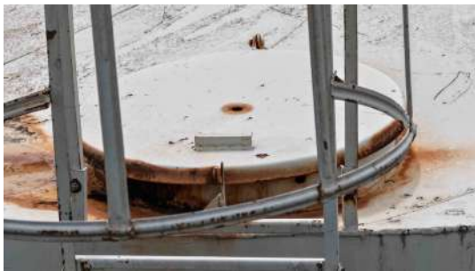
Foto 1 - Furo no centro da tampa de inspeção permite entrada de insetos, pequenos animais e ou contaminantes.
