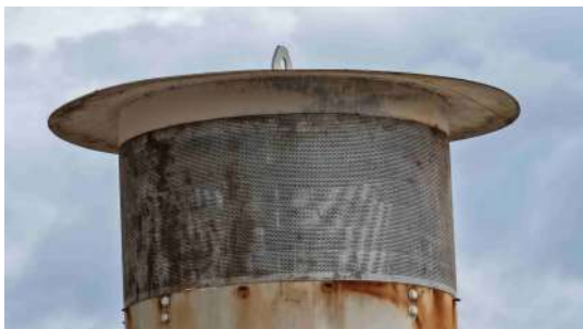
Foto 9 - Tubulação de ventilação com tela.
