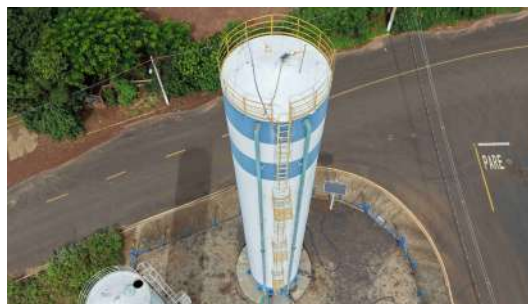
Foto 5 - Vista geral do reservatório 1, evidenciando escadas e guarda corpos. Tudo extravasor à esquerda da escada.
