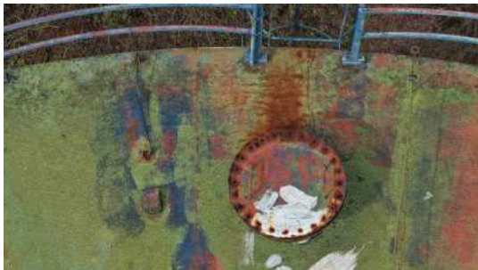
Foto 1 - Tampa de inspeção do reservatório 2 apresenta corrosão.
