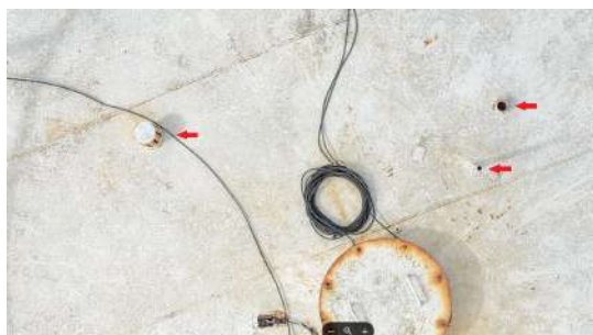
Foto 1 - Aberturas sem tela de proteção e permitindo entrada de água de chuva.
