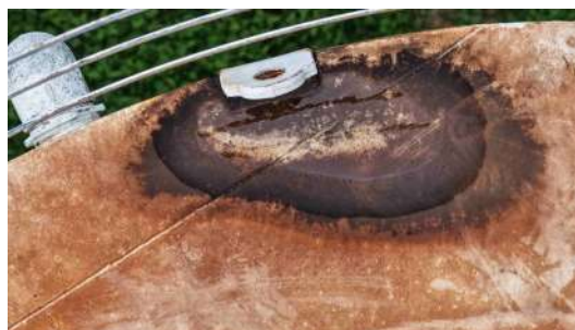
Foto 2 - Corrosão na parte superior do reservatório.
