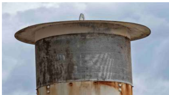
Foto 1 - Corrosão no reservatório.
