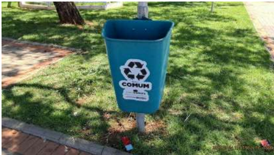
Foto 1 - Necessário realizar a manutenção do dispositivo e providenciar a instalação da tampa.
