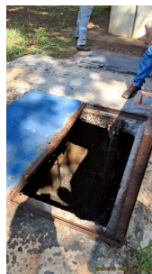
Foto 4 - Local onde se encontram instaladas as motobombas submersas, com uma unidade em operação e outra mantida como reserva.
