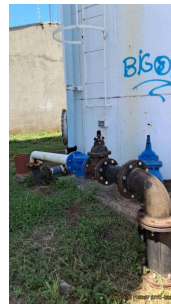
Foto 4 - Tubulação para distribuição.
