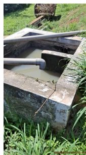
Foto 5 - Ponto de entrada do esgoto no tanque séptico, com controle de vazão realizado por meio do volume.
