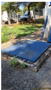
Foto 3 - Tampas de proteção das moto bombas.
