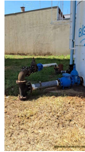
Foto 2 - Tubulação para distribuição.
