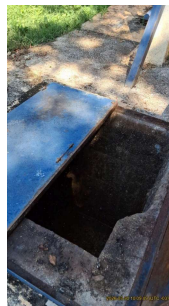
Foto 2 - Local da peneira utilizada para remoção de sólidos grosseiros.
