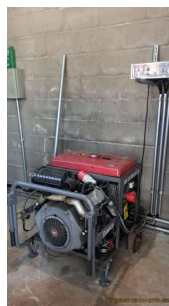
Foto 6 - Gerador de energia.
