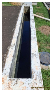
Foto 9 - Canal de passagem do efluente após a etapa de decantação.
