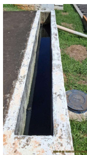
Foto 1 - Abertura identificada no decantador, representando risco de queda.
