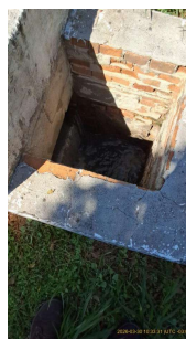
Foto 2 - Abertura na saída do efluente tratado, representando risco de queda.
