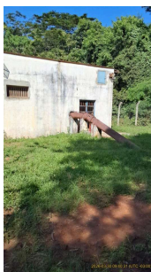
Foto 8 - Tubulação de recalque do esgoto para a ETE.
