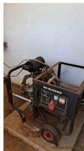
Foto 6 - Gerador de energia.
