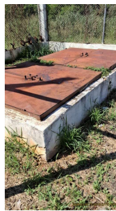
Foto 2 - Área onde se encontram instalados a peneira e o conjunto de motobombas.
