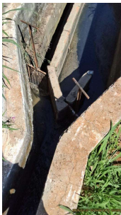
Foto 2 - Primeira grade do conjunto de gradeamento grosseiro.
