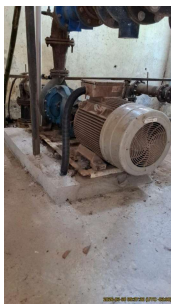
Foto 3 - Motobomba (Faz parte de um conjunto, sendo uma utilizada em operação, e outra em reserva).
