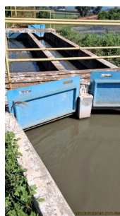
Foto 4 - Passagem do esgoto bruto para as lagoas.
