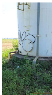
Foto 3 - Base do reservatório.
