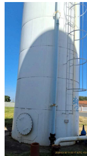
Foto 5 - Base do reservatório.
