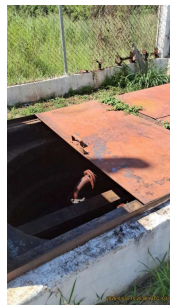
Foto 4 - Local de instalação do conjunto de motobombas.
