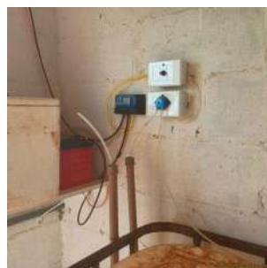
Foto 20 - Bomba dosadora de hipoclorito.
