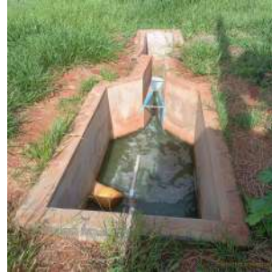
Foto 24 - Macromedicação por Calha Parshall, na saída do efluente tratado.
