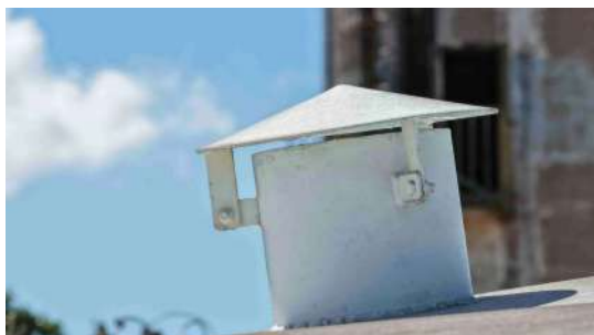
Foto 16 - Chaminé de respiro (ventilação) do reservatório metálico.
