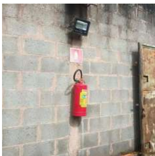
Foto 25 - Extintor de incêndio da EEE.
