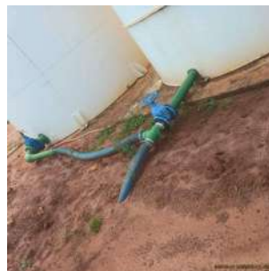
Foto 9 - Mangote de interligação com o P4.
