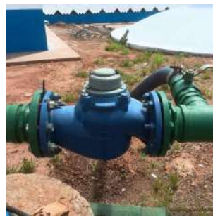
Foto 6 - Macromedidor do Poço P4.
