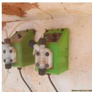
Foto 20 - Segundo conjunto de bombas dosadoras (recalque para reservatório elevado em concreto).
