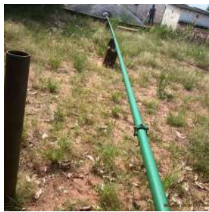
Foto 10 - Adutora do P1 que abastece o reservatório globo na mesma área.
