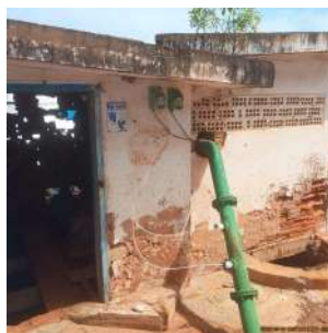
Foto 19 - Dosagem de produtos químicos em recalque para o reservatório elevado em concreto.
