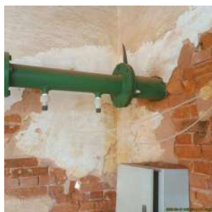
Foto 16 - Ponto de dosagem de produtos químicos.
