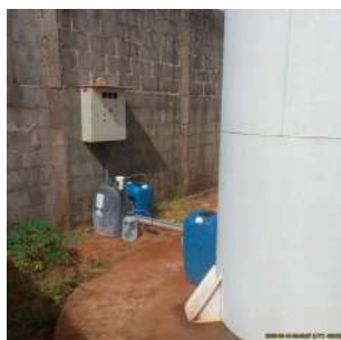
Foto 15 - Armazenamento de produtos químicos e painel das bombas dosadoras.
