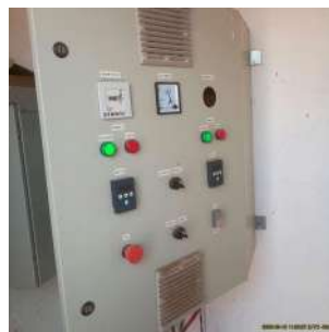
Foto 15 - Pannel elétrico e de comando da elevatória.
