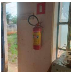
Foto 13 - Extintor de incêndio da EEAT.
