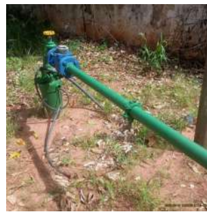
Foto 11 - Adutora do P1 que abastece o reservatório globo na mesma área.
