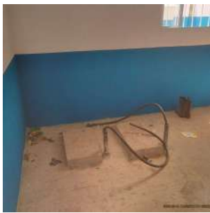
Foto 10 - Novo abrigo dos conjuntos motobomba.
