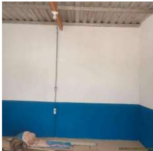
Foto 12 - Novo abrigo dos conjuntos motobomba.
