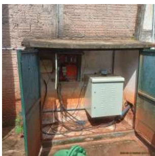
Foto 7 - Painel elétrico e de comando do poço.
