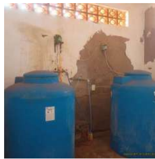
Foto 10 - Tanques de produtos químicos (hipoclorito e flúor).
