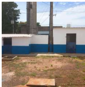
Foto 2 - Novos abrigos dos painéis elétricos e de produtos químicos.
