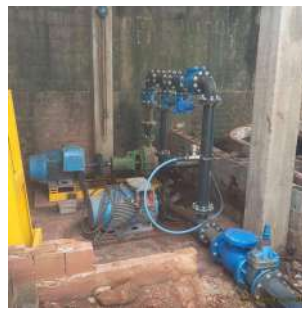
Foto 10 - Conjunto motobomba instalado e em operação. Segundo conjunto apenas com motor no local, bomba não estava instalada. Segundo o prestador, o equipamento estava em manutenção.
