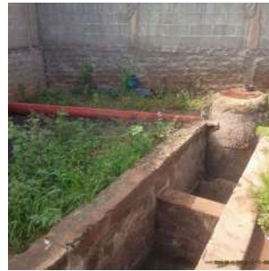
Foto 4 - Entrada do esgoto e canal de desarenação e gradeamento.
