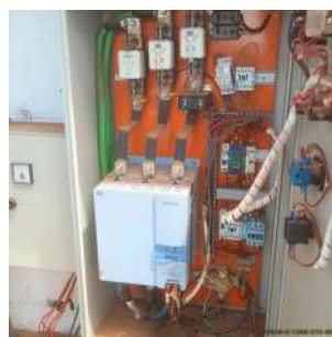
Foto 22 - Painel elétrico e de comando (com soft starter).
