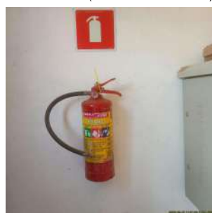
Foto 19 - Extintor de incêndio da elevatória.
