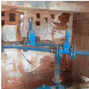
Foto 7 - Barrilete de recalque.
