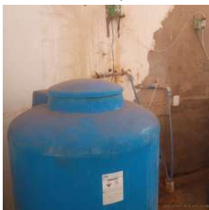
Foto 13 - Tanque de flúor.
