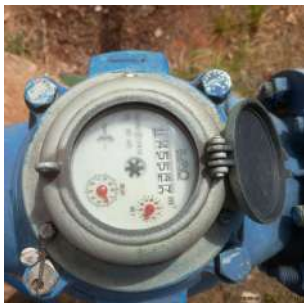
Foto 7 - Macromedidor do Poço P4.
