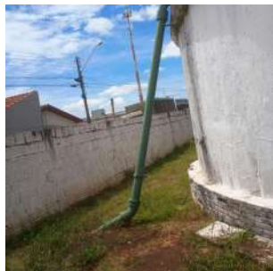
Foto 7 - Tubulação de entrada do reservatório.
