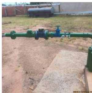
Foto 4 - Cavalete do poço.
