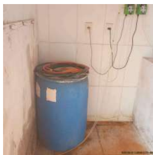
Foto 14 - Tanque de produto químico e bombas dosadoras.
