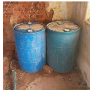
Foto 13 - Tanques de produtos químicos (hipoclorito e flúor).
