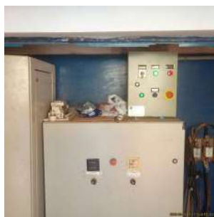
Foto 16 - Painéis elétricos e de comando dos equipamentos.
