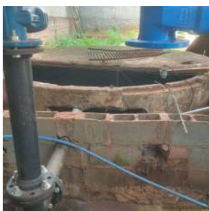
Foto 15 - Tanque de sucção de recalque.
