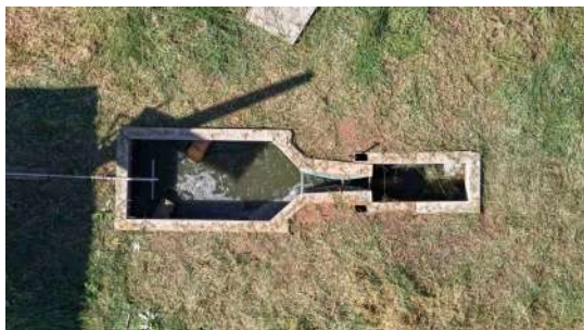
Foto 39 - Canal de dosagem de hipoclorito e medição de vazão na calha Parshall.
