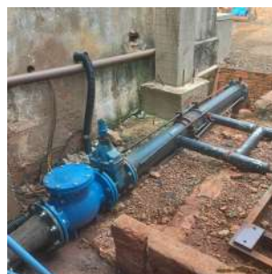
Foto 18 - Tubulação de recalque.
