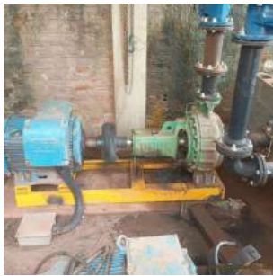
Foto 11 - Equipamento instalado e em operação.
