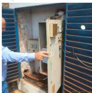
Foto 21 - Painel elétrico e de comando (com soft starter).
