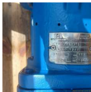
Foto 13 - Placa de especificações técnicas da bomba do equipamento reserva.
