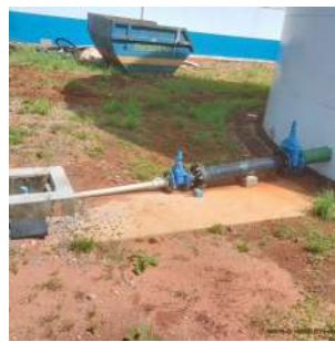
Foto 7 - Tubulação de saída do reservatório e Bosster instalado em linha.
