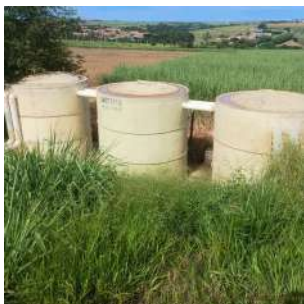
Foto 29 - Tanques de desinfecção, na saída do efluente tratado.
