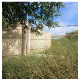
Foto 30 - Tanques de desinfecção, na saída do efluente tratado.
