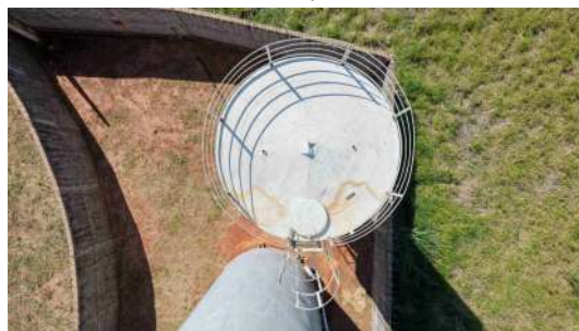
Foto 21 - Vista aérea da cobertura do reservatório em operação.
