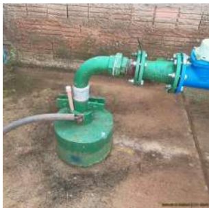
Foto 3 - Cavalete do poço.
