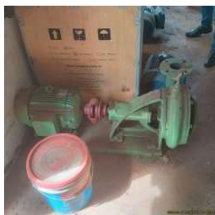
Foto 7 - equipamento reserva de um dos conjuntos das EEATs do P4
