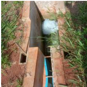
Foto 25 - Macromedicação por Calha Parshall, na saída do efluente tratado.
