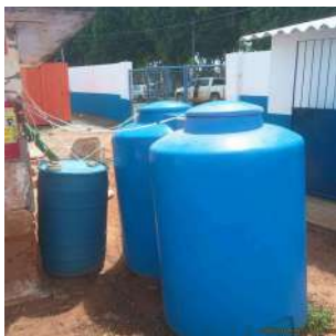
Foto 13 - Tanques de armazenamento de produtos químicos para as duas EEATs.
