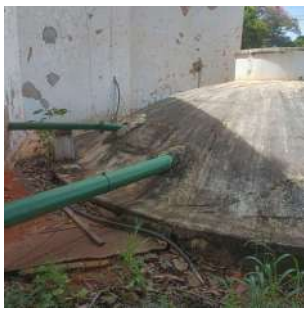
Foto 6 - Ao fundo a tubulação de sucção da EEAT.
