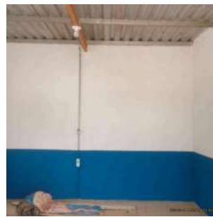
Foto 11 - Novo abrigo dos conjuntos motobomba.
