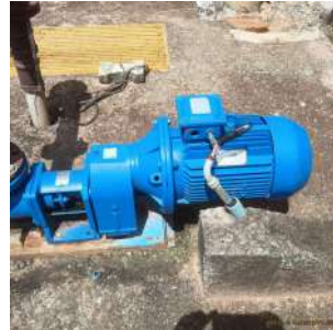
Foto 5 - Motor do conjunto instalado.
