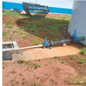
Foto 2 - Tubulação de saída do reservatório e Booster instalado em linha.
