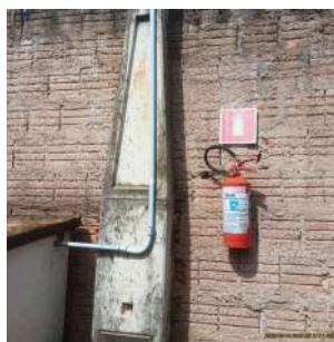
Foto 8 - Extintor de incêndio da área.
