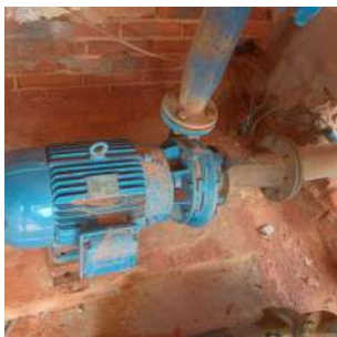
Foto 11 - Segundo conjunto motobomba.
