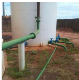
Foto 2 - Tubulações de abastecimento do reservatório e de saída.
