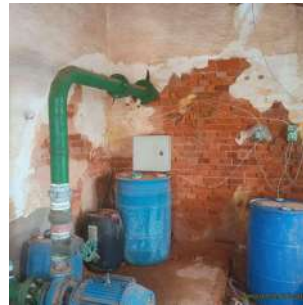
Foto 2 - Conjunto motobomba, produtos químicos e bombas dosadoras na tubulação de recalque.
