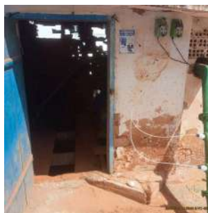
Foto 4 - Atual EEAT que abastece o reservatório metálico.
