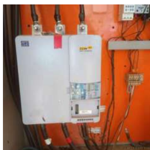
Foto 11 - Soft starter do poço.
