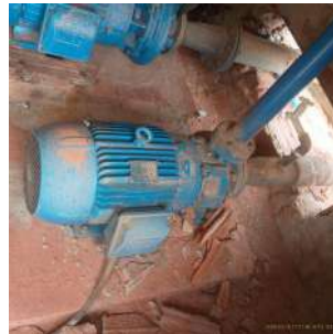
Foto 8 - Primeiro dos conjuntos motobomba.
