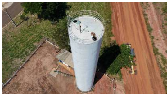
Foto 11 - Vista aérea do reservatório elevado. Detalhe para tampa de inspeção aberta.
