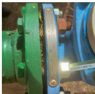
Foto 7 - Detalhe do macromedidor do poço.
