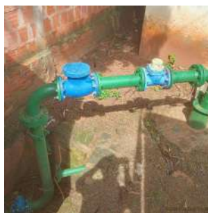
Foto 2 - Cavalete do poço.
