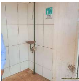
Foto 9 - Chuveiro de emergência e lavador de olhos.
