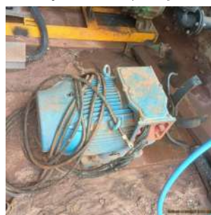
Foto 16 - Motor reserva, sem bomba instalada.
