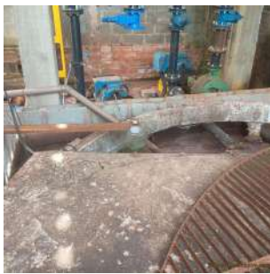
Foto 9 - Tanque de sucção pós-gradeamento.
