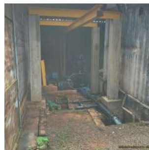
Foto 26 - Vista geral interna da EEE.
