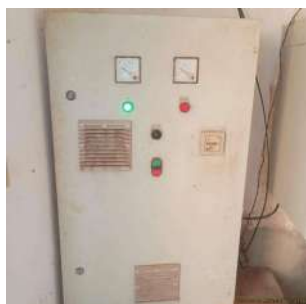
Foto 9 - Painél elétrico e de acionamento do poço.
