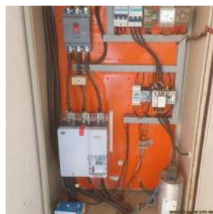
Foto 10 - Painél elétrico e de acionamento do poço.
