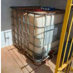
Foto 23 - Tanque de armazenamento de hipoclorito para desinfecção.
