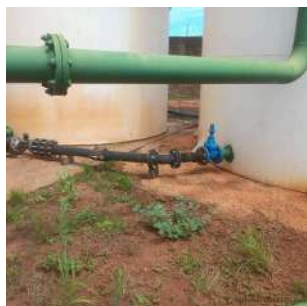
Foto 3 - Tubulações de abastecimento do reservatório e deste para os de fibra.
