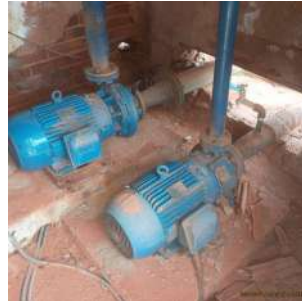
Foto 6 - Conjuntos motobomba da EEAT.
