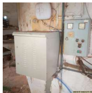
Foto 17 - Quadro elétrico e de acionamento do Poço.
