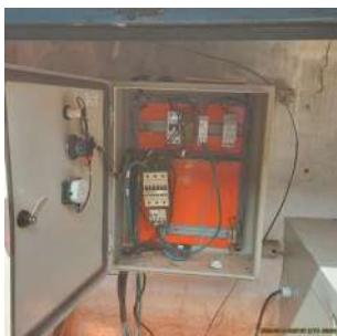
Foto 9 - Painel elétrico e de comando do poço.
