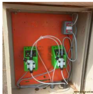
Foto 11 - Bombas dosadoras de produtos químicos.
