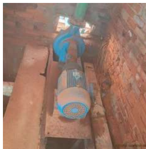
Foto 6 - Conjunto motobomba que abastece o reservatório metálico.
