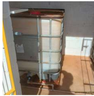
Foto 22 - Tanque de armazenamento de hipoclorito para desinfecção.
