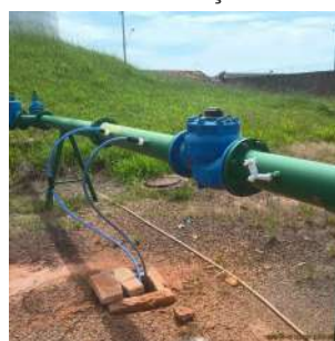
Foto 6 - Macromedidor do Poço P5.
