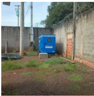
Foto 19 - Gerador de energia a diesel da EEE.
