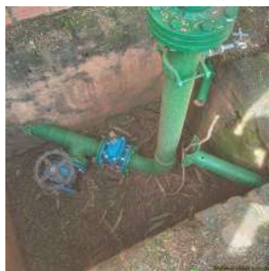
Foto 4 - Tubulação de recalque.
