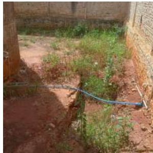
Foto 10 - Ligação direta do reservatório com unidade usuária vizinha (escola).
