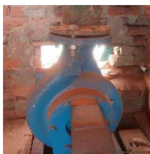
Foto 8 - Bomba do conjunto.
