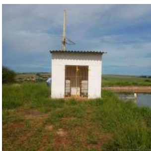
Foto 19 - Abrigo do tanque de armazenamento de hipoclorito e da bomba dosadora.
