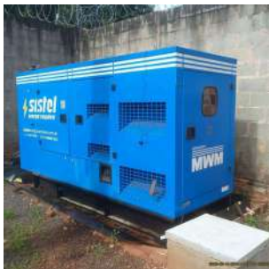
Foto 23 - Gerador de energia a diesel da EEE.
