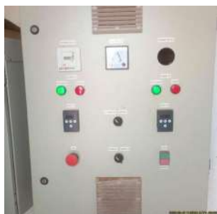
Foto 16 - Pannel elétrico e de comando da elevatória.
