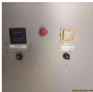
Foto 17 - Painéis elétricos e de comando dos equipamentos.
