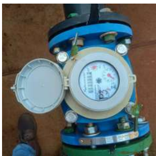
Foto 5 - Macromedidor do poço.
