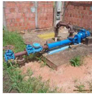
Foto 4 - Conjunto motobomba instalado.
