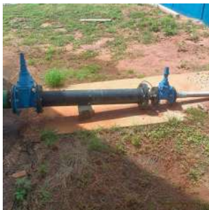
Foto 8 - Booster em linha, de 3cv. Segundo o prestador há apenas um equipamento reserva que também pode ser utilizado no Booster do reservatório do Poço P5.
