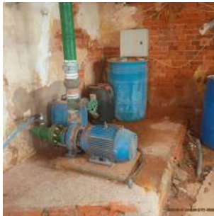
Foto 1 - Conjunto motobomba instalado na EEAT.
