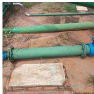
Foto 12 - Booster em linha na saída do reservatório 2.
