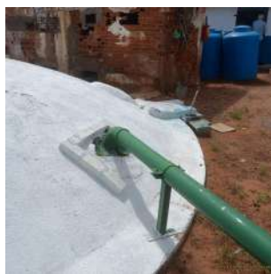
Foto 5 - Adutora de abastecimento do reservatório (vinda do Poço P4).
