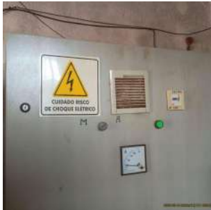
Foto 21 - Paineis elétricos da EEE.
