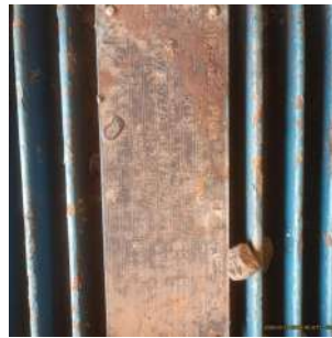
Foto 12 - Placa de especificações do motor do conjunto em operação.
