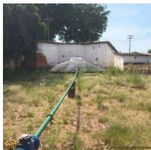
Foto 1 - Adutora do Poço P1 que abastece o reservatório.
