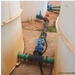
Foto 5 - Abastecimento 1 do elevado para os apoiados.
