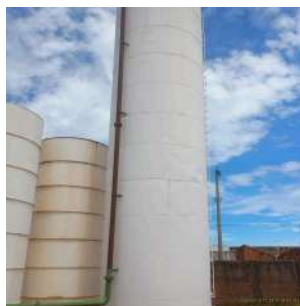
Foto 4 - Reservatório elevado e, à frente, os de fibra.
