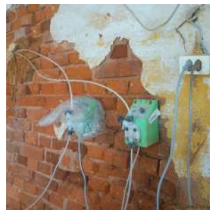
Foto 15 - Bombas dosadoras de produtos químicos.
