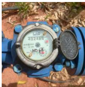
Foto 8 - Macromedidor do Poço P1.
