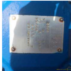
Foto 7 - Placa de especificações da caixa de ligação elétrica do motor do conjunto instalado.
