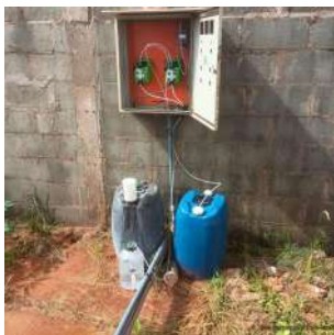
Foto 10 - Bombonas de armazenamento de produtos químicos (hipoclorito e flúor) e, ao fundo, bombas dosadoras.
