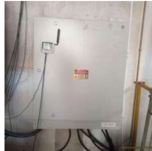
Foto 22 - Paineis elétricos da EEE.
