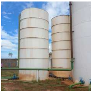
Foto 1 - Reservatório apoiado de fibra da área operacional do Poço P5.
