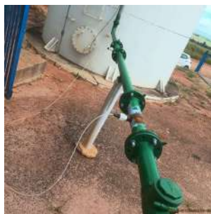
Foto 7 - Ponto de dosagem de produtos químicos.
