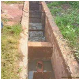
Foto 5 - Canal de gradeamento e desarenação.
