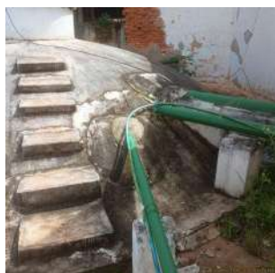
Foto 4 - Tubulações de interligação de outros poços com o reservatório, caso sejam necessárias manobras para complementar atendimento à demanda de abastecimento.
