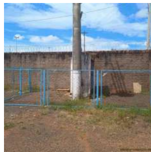
Foto 16 - Abrigo dos painéis elétricos.
