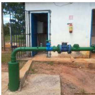
Foto 3 - Poço P6 e, ao fundo, abrigo de produtos químicos e bombas dosadoras.
