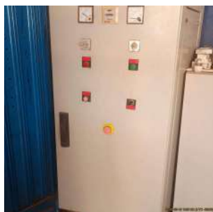
Foto 15 - Painéis elétricos e de comando do poço.
