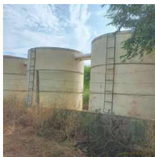
Foto 31 - Tanques de desinfecção, na saída do efluente tratado.
