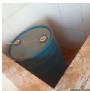
Foto 15 - Tanque de produto químico dentro de bacia de contenção.
