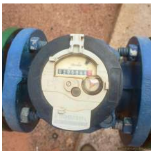
Foto 6 - Macromedidor do Poço.
