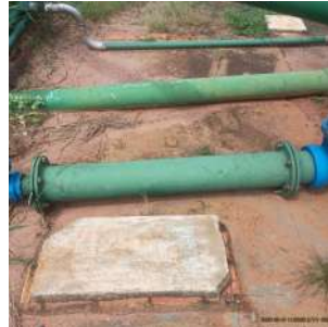
Foto 12 - Booster em linha na saída do reservatório 2.
