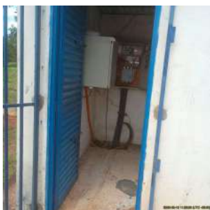
Foto 8 - Painel elétrico e de comando.
