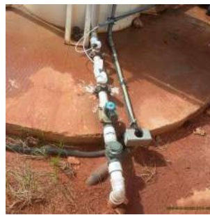
Foto 7 - Tubulação de entrada, com pontos de dosagem de produtos químicos (hipoclorito e flúor).
