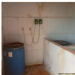
Foto 13 - Tanque de produto químico e bombas dosadoras.
