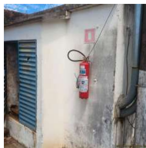
Foto 20 - Abrigo do painel elétrico e extintor de incêndio do local.
