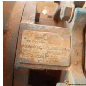
Foto 6 - Placa de especificações técnicas da bomba do conjunto motobomba instalado.
