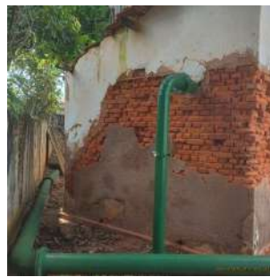
Foto 7 - Lateral da EEAT, com tubulação de recalque para o reservatório do Asilo.
