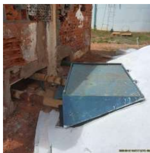
Foto 4 - Tampas de acesso e tubulações de sucção.
