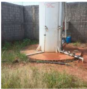
Foto 6 - Base do reservatório em funcionamento.
