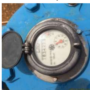
Foto 7 - Macromedidor do Poço P5.
