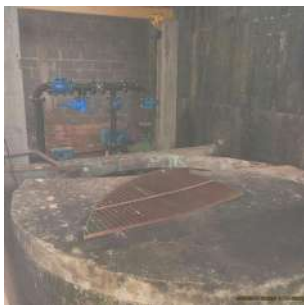
Foto 7 - Tanque de sucção pós-gradeamento.
