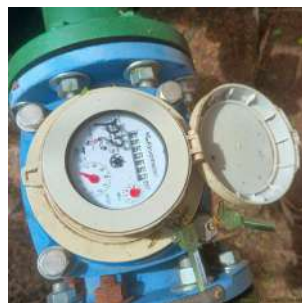
Foto 8 - Macromedidor do poço.
