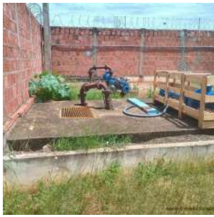
Foto 3 - Equipamentos (instalado e reservado) da elevatória.
