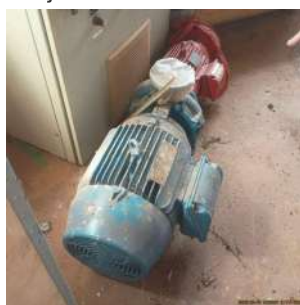
Foto 10 - Equipamento reserva da bomba da EEAT do P1.
