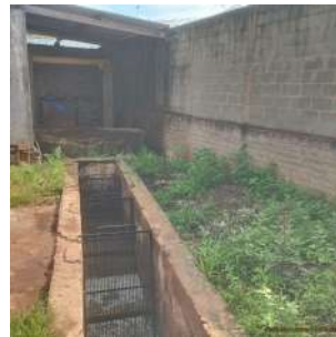
Foto 6 - Canal de gradeamento e desarenação.
