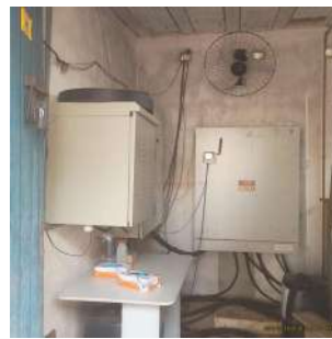
Foto 20 - Paineis elétricos e de telemetria da EEE.
