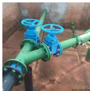
Foto 12 - Tubulação à direita vai pro reservatório do distrito industrial; tubulação da esquerda vai e vem do poço P2, além de, posteriormente, conectar com os poços P1 e P4 também.
