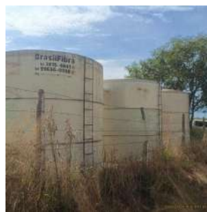
Foto 32 - Tanques de desinfecção, na saída do efluente tratado.
