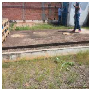
Foto 14 - Tanques pulmão (acúmulo) da Elevatória.
