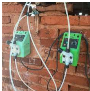
Foto 12 - Bombas dosadoras de produtos químicos (hipoclorito e flúor).
