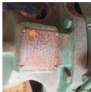
Foto 14 - Placa de especificações da bomba do conjunto em operação.
