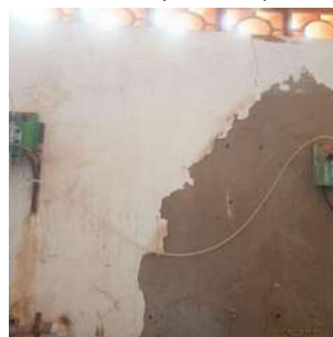
Foto 14 - Bombas dosadoras de produtos químicos.
