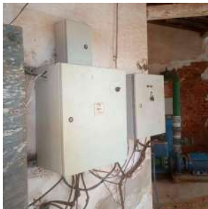
Foto 3 - Painéis elétricos e de acionamento.
