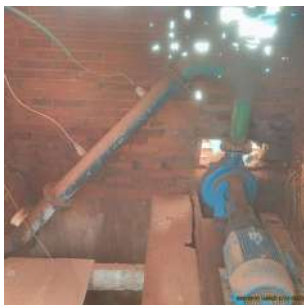
Foto 5 - Conjunto motobomba que abastece o reservatório metálico.
