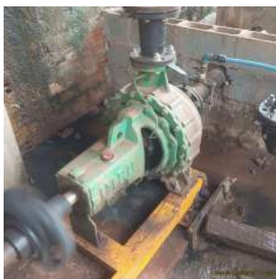
Foto 13 - Equipamento instalado e em operação.
