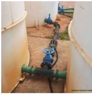
Foto 10 - Abastecimento 1 do elevado para os apoiados.
