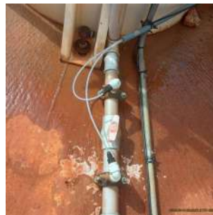
Foto 9 - Tubulação de entrada, com pontos de dosagem de produtos químicos (hipoclorito e flúor).
