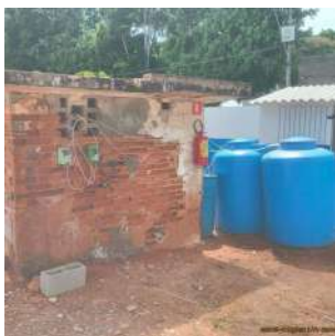
Foto 11 - Dosagem de produtos químicos no recalque para o reservatório metálico.
