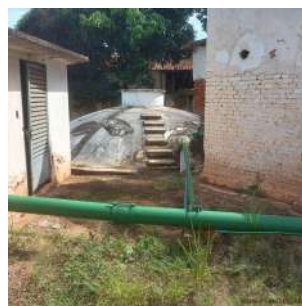
Foto 3 - Vista geral do reservatório e adutoras dos Poços P2 e P3.
