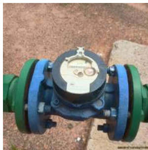
Foto 5 - Macromedidor do Poço.
