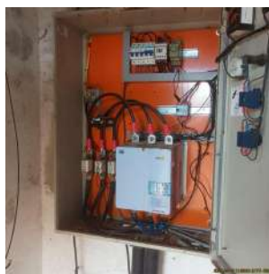
Foto 10 - Painel elétrico e de comando (com soft starter).
