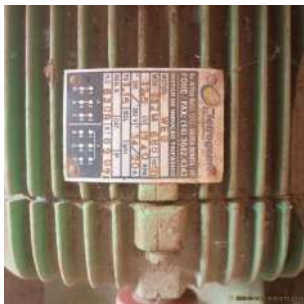
Foto 14 - Placa de especificações técnicas do motor do equipamento reserva.
