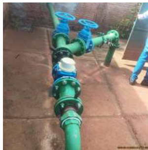
Foto 4 - Tubulação à direita vai pro reservatório do distrito industrial; tubulação da esquerda vai e vem do poço P2, além de, posteriormente, conectar com os poços P1 e P4 também.
