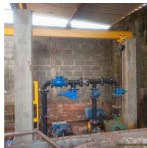
Foto 8 - Barrilete de recalque do esgoto.
