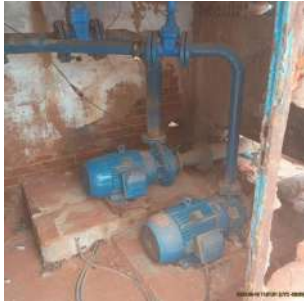
Foto 5 - Conjuntos motobomba da EEAT.
