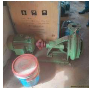
Foto 13 - Equipamento reserva, segundo o prestador, guardado na EEAT do Poço P1.
