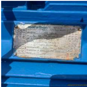
Foto 6 - Placa de especificações técnicas do motor do conjunto instalado.
