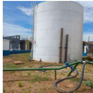
Foto 2 - Vista geral do reservatório metálico. Vista geral do reservatório metálico. Bombas reservas do P4 (maior) e do P2 (menor).
