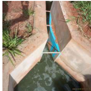
Foto 26 - Macromedicação por Calha Parshall, na saída do efluente tratado.
