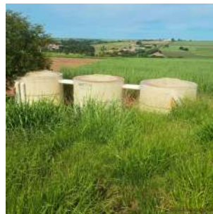
Foto 28 - Tanques de desinfecção, na saída do efluente tratado.
