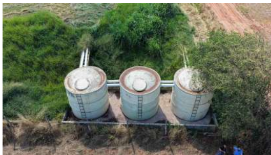
Foto 40 - Tanques de contato do hipoclorito após saída do efluente tratado.
