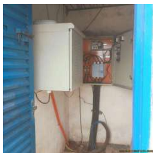
Foto 9 - Painel elétrico e de comando (com soft starter).
