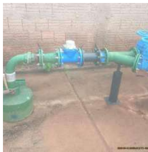
Foto 2 - Cavalete do poço.
