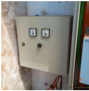
Foto 4 - Painel elétrico do booster.
