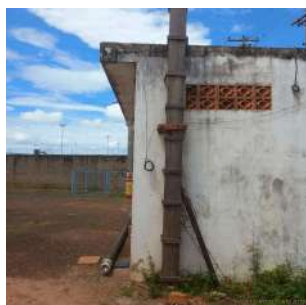
Foto 19 - Bomba reserva do poço, ao lado do abrigo dos produtos químicos.
