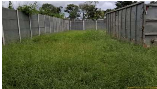
Foto 2 - Necessidade de execução de roçada
