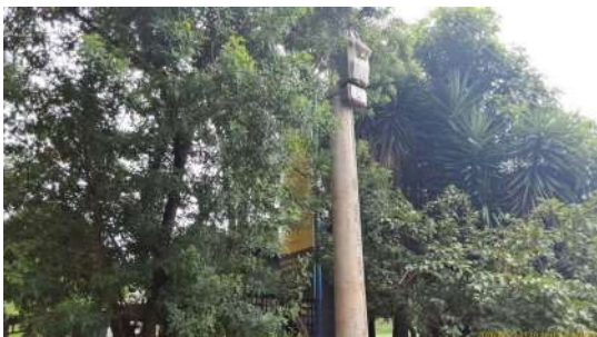
Foto 1 - Placa de identificação encoberta por vegetação
