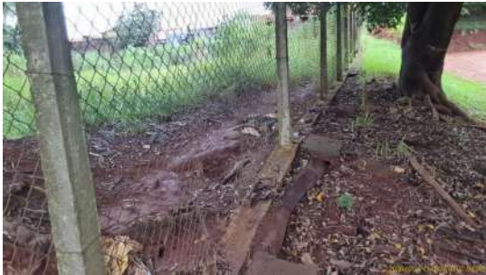
Foto 1 - Danos no cercamento da unidade
