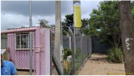
Foto 1 - Cercamento da unidade danificado, próximo ao portão de acesso.
