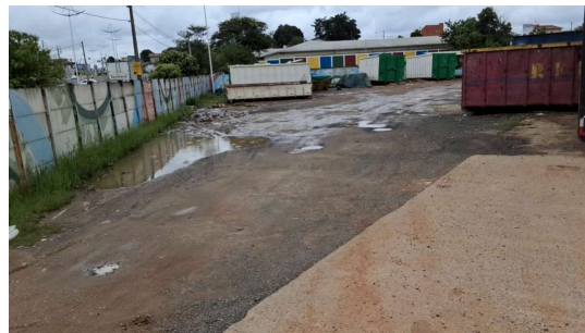
Foto 2 - Acúmulo de água
