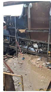
Foto 2 - Deterioração da seção inicial da linha de triagem
