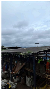
Foto 1 - Avarias na estrutura de cobertura da linha de triagem
