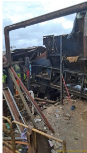
Foto 3 - Deterioração da seção inicial da linha de triagem
