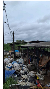
Foto 4 - Avarias na estrutura de cobertura da linha de triagem
