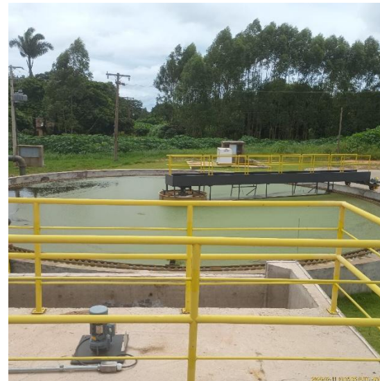
Foto 4 – Decantador do sistema terciário.
