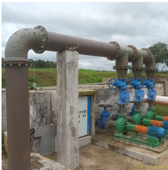
Foto 3 – Recalque do efluente da terceira lagoa para o sistema terciário.
