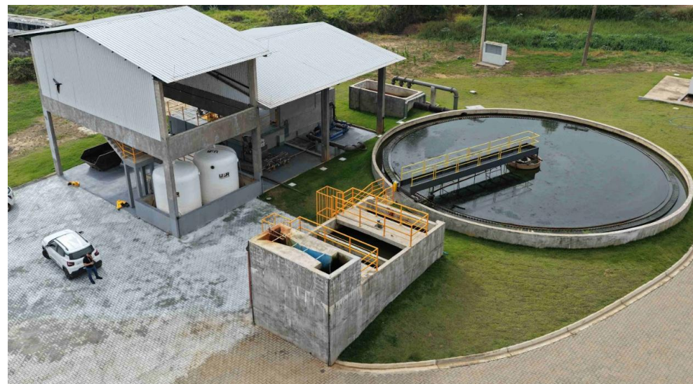
Foto 2 – Vista aérea do sistema terciário (decantador e tratamento do lodo).
