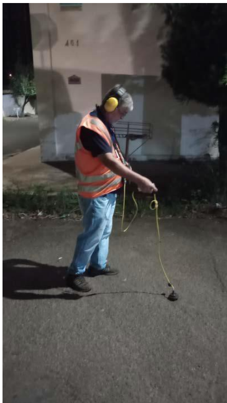
Foto 1 – Pesquisa de vazamento com haste de escuta. Fonte: RELATÓRIO FINAL. Prefeitura Municipal de Itirapina. Outubro/2025.
