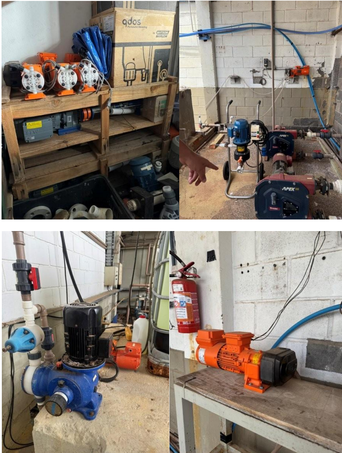
Figura TEC 6 – Aquisição de 10 bombas peristálticas; 3 bombas centrífugas; 12 bombas dosadoras e 1 bomba monobloco
