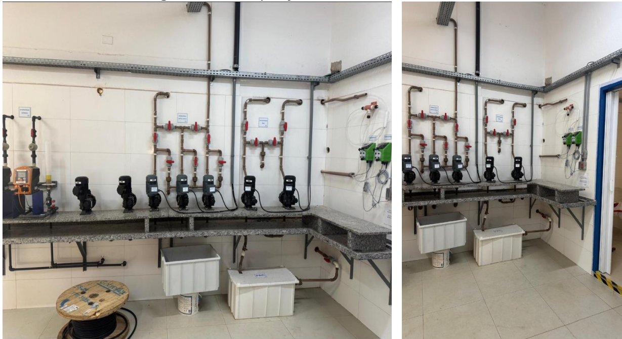
Figura TEC 3 – Aquisição de 10 bombas dosadoras
