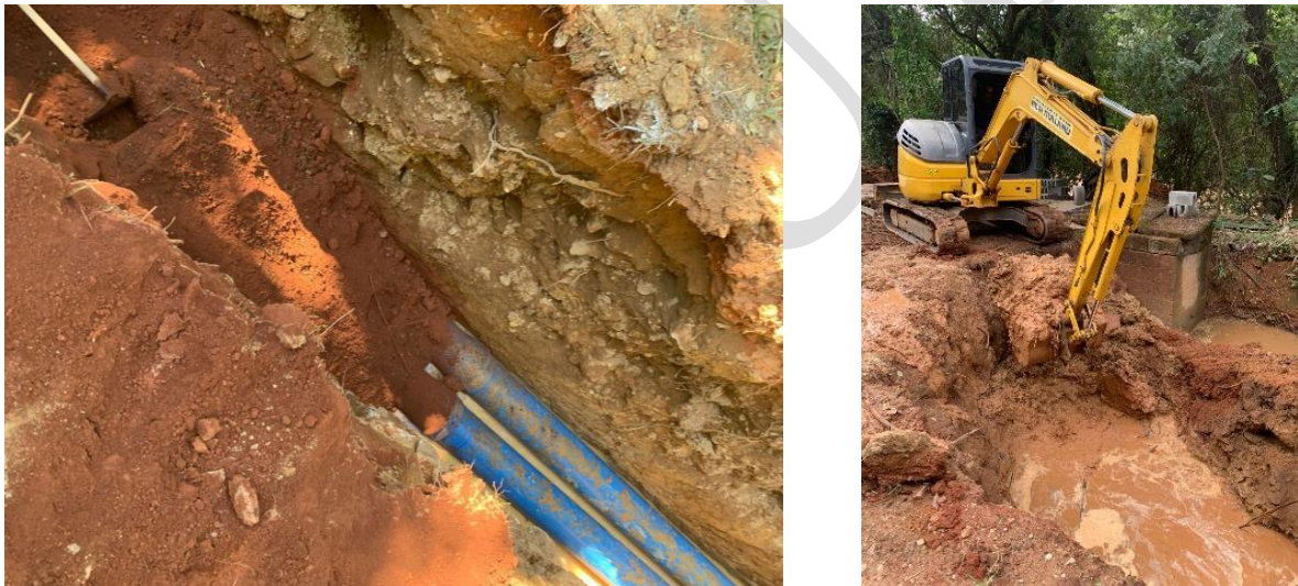
Figura TEC 11 – Reparo e implantação de rede adutora de água bruta do Rio Camanducaia para recalque até a ETA III (Fonte: SAAE Amparo)
