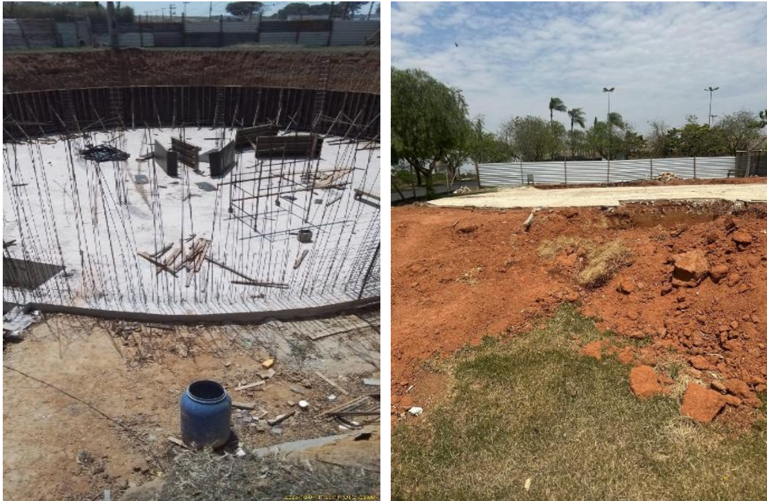
Figura TEC 2 – Estrutura e base de fundação dos reservatórios localizados nos bairros Fazenda da Barra e São José.
