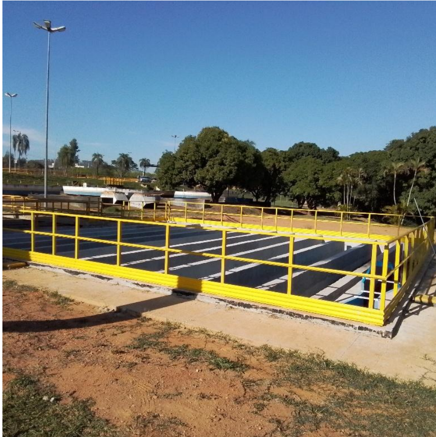
Figura TEC 5 – Ampliação da Câmara de Contato com as Interligações da ETE Camanducaia.
