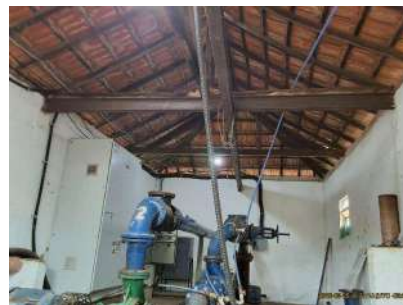
Foto 2 - Guias metálicas para auxílio no içamento de bombas, em caso de manutenção.
