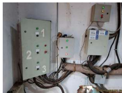
Foto 3 - Painel elétrico das bombas.
