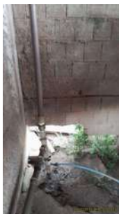
Foto 8 - Tubulação de saída do reservatório, ligada à tubulação de saída do reservatório vizinho.
