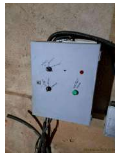
Foto 5 - Painel elétrico de comando das bombas.
