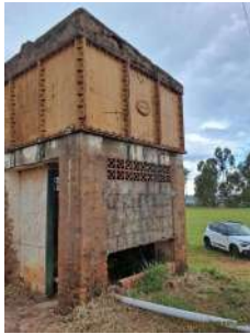
Foto 1 - Alvenaria em mal estado de conservação e partes metálicas apresentando corrosão.
