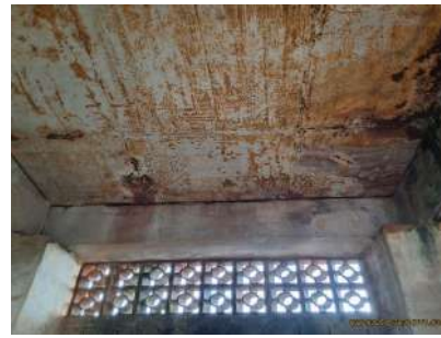
Foto 8 - Vista geral da parte interna da estrutura de alvenaria sob o reservatório.
