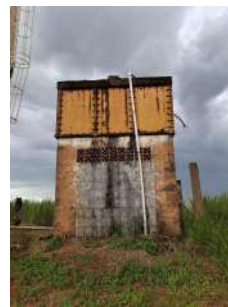
Foto 4 - Alvenaria em mal estado de conservação e partes metálicas apresentando corrosão.
