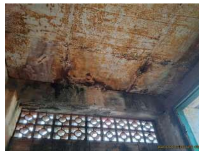
Foto 6 - Alvenaria em mal estado de conservação e partes metálicas apresentando corrosão.
