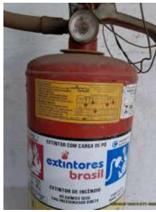
Foto 3 - Extintor de incêndio presente na unidade apresenta validade vencida.
