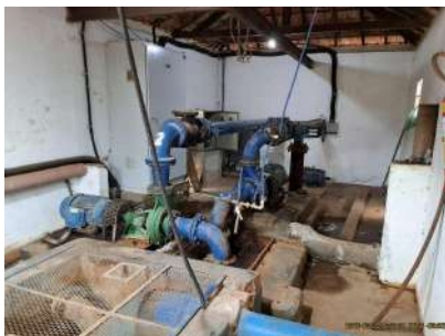
Foto 1 - Vista geral do interior da casa de bombas, sendo possível visualizar conjuntos moto-bomba 1 e 2.
