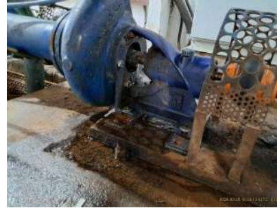
Foto 2 - Água de lubrificação de gaixetas.
