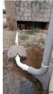
Foto 7 - Tubulação de saída do reservatório.
