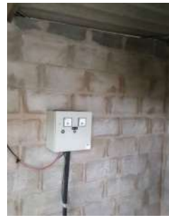
Foto 4 - Painel elétrico da bomba do poço.
