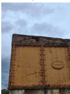
Foto 7 - Alvenaria em mal estado de conservação e partes metálicas apresentando corrosão.
