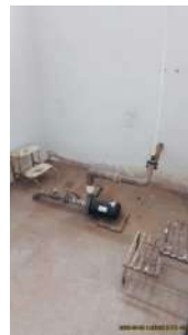
Foto 7 - Bomba instalada no interior de edificação existente no local, utilizada para recalque da água do reservatório semienterrado para o reservatório elevado também presente na área.
