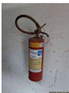
Foto 1 - Extintor de incêndio presente na unidade apresenta validade vencida.
