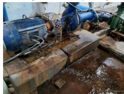
Foto 3 - Acúmulo de água de lubrificação de gaixetas no piso do interior da casa de bombas.
