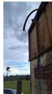
Foto 2 - Vazamento no tubo extravasor.
