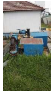
Foto 8 - Vista geral da EEA (abrigo metálico à frente).
