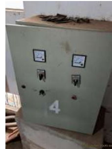
Foto 12 - Painel elétrico do conjunto motobomba 4.
