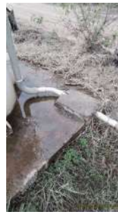
Foto 6 - Tubulação de saída do reservatório.
