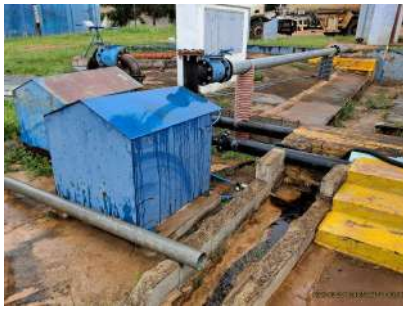
Foto 6 - Vista dos abrigos dos conjuntos motobomba 3 (esquerda) e 4 (direita).
