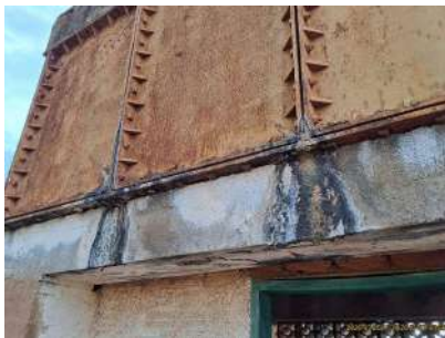
Foto 1 - Vazamentos na estrutura acima da porta da base do reservatório.
