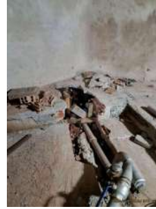
Foto 2 - Cortes no piso e valas abertas. Entulho depositado na unidade.
