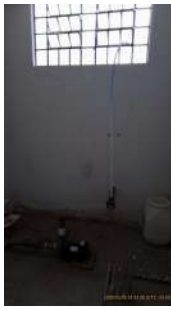
Foto 8 - Tubulação para água que alimenta dosador de reagentes cloro e flúor.
