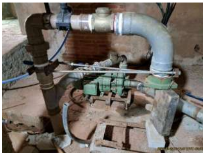
Foto 4 - Conjunto moto-bomba da EEA. A posição onde se encontrava a bomba reserva está vazia.
