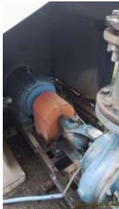
Foto 3 - Conjunto moto bomba instalado.
