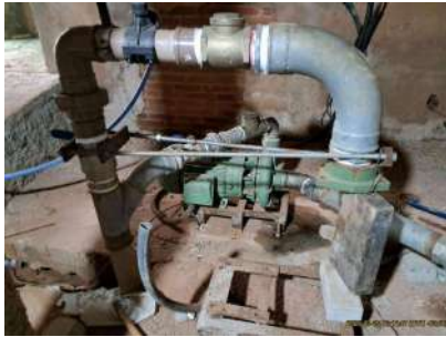
Foto 1 - Ausência de bomba reserva na EEA.
