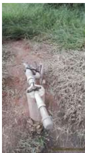
Foto 10 - Tubulação para conexão de caminhão pipa para abastecimento dos dois reservatórios existentes no local.
