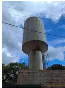
Foto 2 - Reservatório apresenta corrosão.
