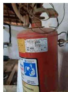
Foto 2 - Extintor de incêndio presente na unidade apresenta validade vencida.
