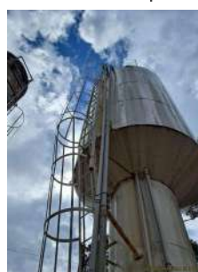
Foto 5 - Tubo extravasor (esquerda).
