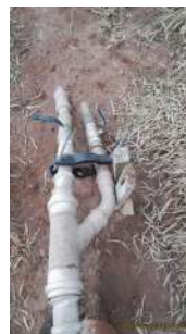
Foto 11 - Tubo à esquerda abastece o reservatório em forma de taça, tubo à direita alimenta o reservatório em forma de paralelepípedo.
