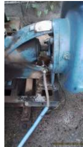
Foto 4 - Drenagem da água de lubrificação de gaixeta.
