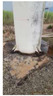
Foto 2 - Pontos de corrosão na estrutura do reservatório.
