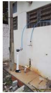
Foto 9 - Dosador de reagentes cloro e flúor, adicionados na água recalçada para o reservatório elevado existente na área.
