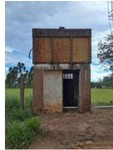
Foto 2 - Alvenaria em mal estado de conservação e partes metálicas apresentando corrosão.
