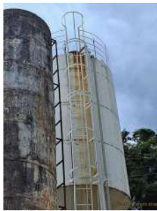
Foto 1 - Reservatório apresenta corrosão.
