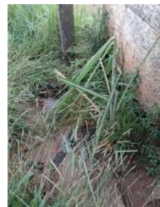
Foto 3 - Acúmulo da água que vaza pelo tubo extravasor.
