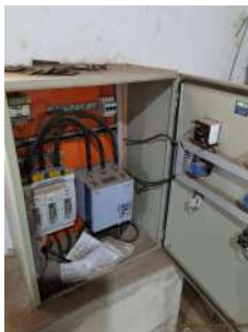
Foto 13 - Painel elétrico do conjunto motobomba 4, aberto.
