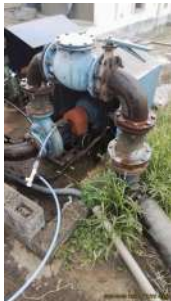
Foto 7 - Vista geral EEA.
