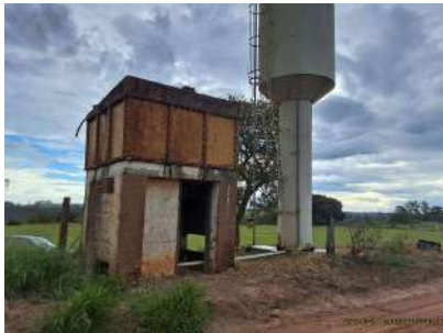
Foto 1 - Vista geral da área onde se localizam os reservatórios. Não há qualquer tipo de cercamento que evite acesso indevido.
