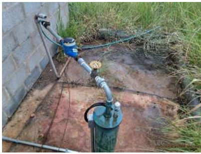
Foto 3 - Vista geral da captação.
