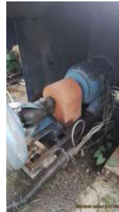
Foto 6 - Conjunto moto bomba instalado.
