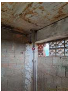
Foto 5 - Alvenaria em mal estado de conservação e partes metálicas apresentando corrosão.
