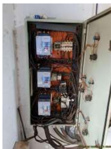
Foto 4 - Painel elétrico das bombas, aberto. Cada bomba possui equipamento para partida em rampa.
