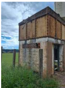
Foto 3 - Alvenaria em mal estado de conservação e partes metálicas apresentando corrosão.
