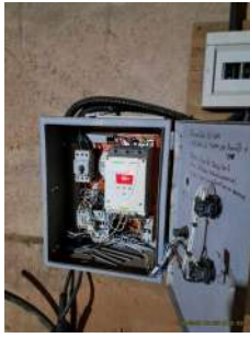
Foto 6 - Painel elétrico de comando das bombas.
