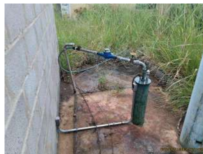
Foto 2 - Vista geral da captação.
