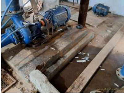
Foto 1 - Acúmulo de água de lubrificação de gaixetas no piso do interior da casa de bombas.
