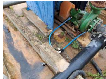
Foto 10 - Drenagem da água de lubrificação de gaixetas das bombas 3 e 4.
