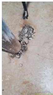
Foto 1 - Detalhe da laje de proteção quebrada
