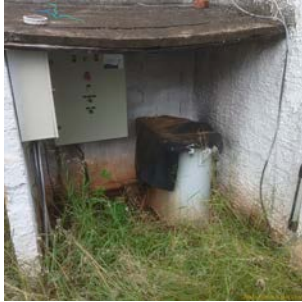
Foto 1 - Situação do transformador dentro da área do poço.
