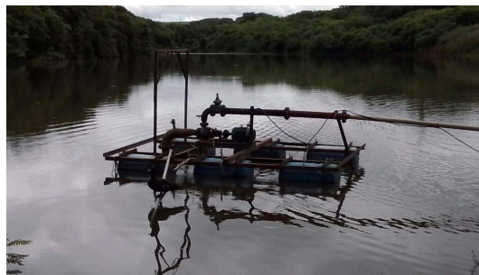
Foto 2 - Conjunto motobomba em cima do flutuador
