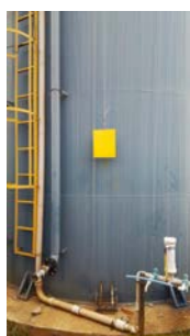
Foto 1 - Medidor de nível
