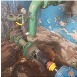
Foto 17 - Conjunto motobomba do Pombal.
