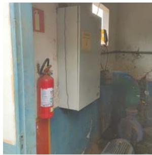
Foto 6 - Extintor de incêndio do local.
