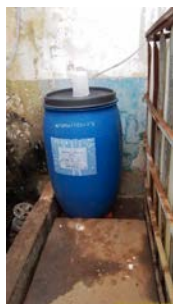
Foto 8 - Sem tanque de contenção
