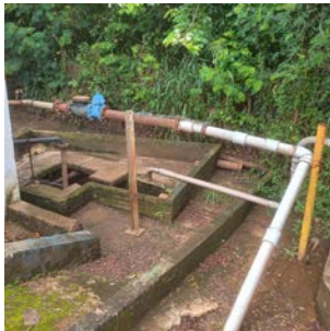
Foto 5 - Vista parcial interna da EEE.
