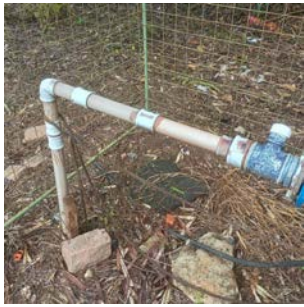
Foto 5 - Cavalete do poço.
