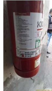
Foto 21 - Validade do extintor
