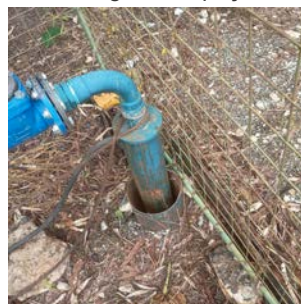
Foto 4 - Cavalete do poço.
