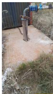
Foto 3 - Vista geral da laje de proteção quebrada
