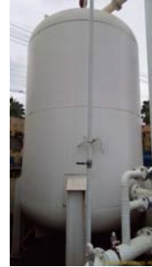
Foto 13 - Vista geral do filtro rápido (areia, pedra e antracito)
