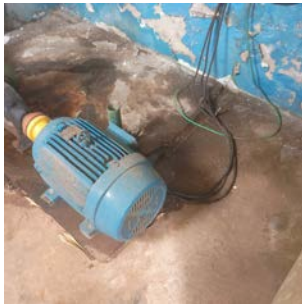
Foto 15 - Conjunto motobomba do Pombal.
