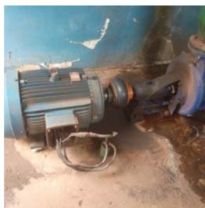
Foto 10 - Conjunto motobomba do Bom Jardim.
