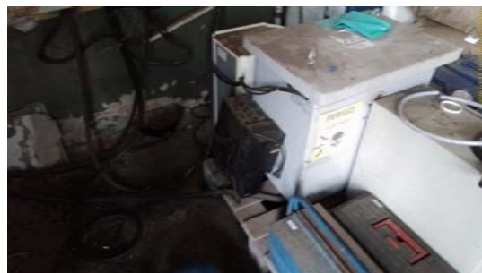
Foto 2 - B - Gerador de alta tensão não pode ficar na mesma área de estoque de produtos químicos com fácil contato para os técnicos, deve ser isolado para evitar acidentes graves.
