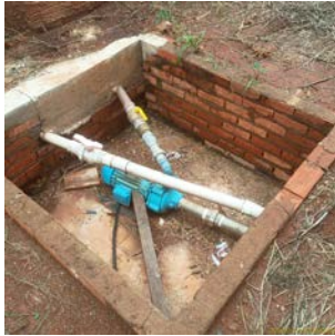
Foto 1 - Vista geral do equipamento 1.
