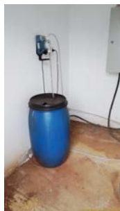
Foto 3 - Armazenamento de hipoclorito de sódio
