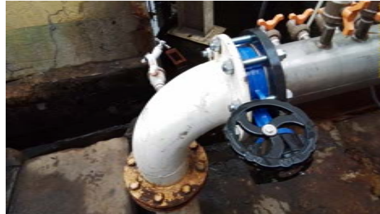
Foto 4 - Entrada de água da Represa Bom Jesus II com tomada de água bruta
