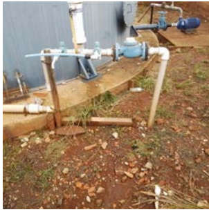
Foto 1 - Inexistência de laje de proteção
