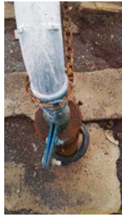
Foto 1 - Não possui tubo de medição de nível
