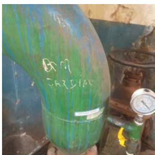
Foto 9 - Identificação na tubulação de recalque.
