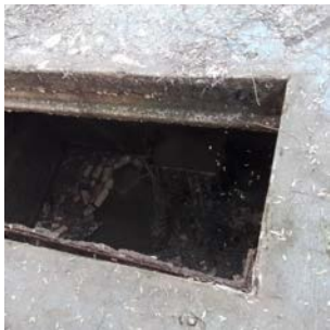
Foto 1 - Gradeamento grosseiro não está sendo limpo
