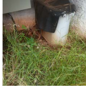
Foto 2 - Situação do transformador dentro da área do poço.
