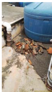
Foto 1 - Material de alvenaria encontrada dentro do reservatório
