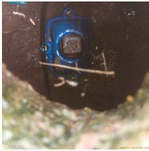
Foto 5 - Registro com vazamento.
