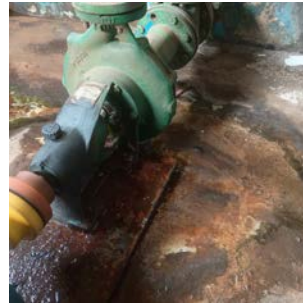
Foto 4 - Piso molhado próximo ao equipamento do Pombal.
