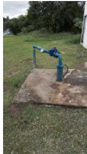
Foto 1 - Área não é cercada permitindo o acesso de qualquer pessoa ao sistema.
