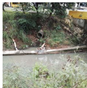
Foto 4 - Trecho com depressão (
