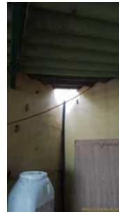
Foto 2 - Abertura no telhado
