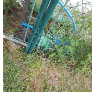
Foto 4 - Conexões e válvulas
