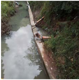
Foto 5 - Vista por cima das ligações de coletores no coletor tronco (fora da Norma)
