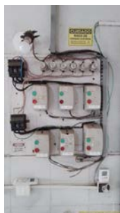
Foto 1 - A - Substituir painel elétrico por quadro elétrico fechado
