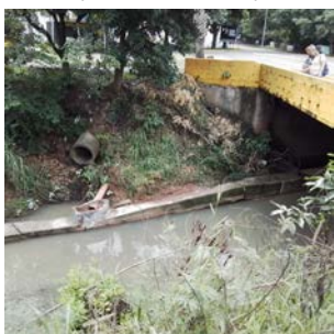
Foto 3 - Trecho com depressão (
