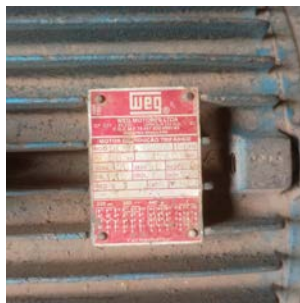
Foto 12 - Placa de especificações técnicas do motor do conjunto motobomba do Bom Jardim.
