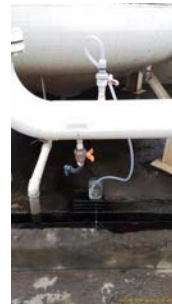
Foto 11 - Local de coleta de água após o decantador
