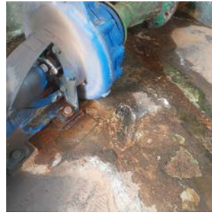
Foto 2 - Piso molhado próximo ao equipamento do Bom Jardim.
