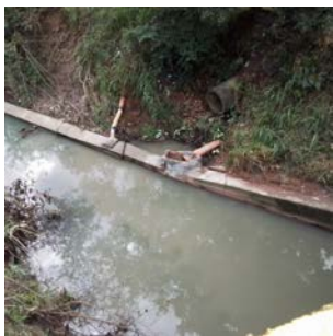
Foto 1 - Ligações de coletores no coletor tronco (fora da Norma)
