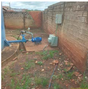
Foto 1 - Ausência de proteção dos quadros elétricos.
