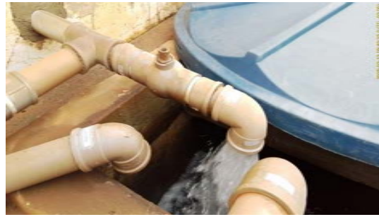
Foto 2 - Entrada da água dos poços no reservatório
