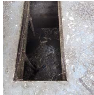
Foto 2 - Gradeamento grosseiro não está sendo limpo
