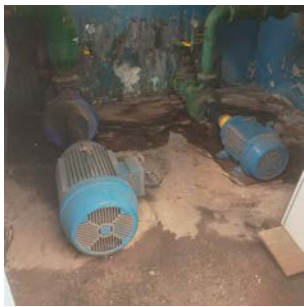
Foto 5 - Conjuntos motobomba da EEAT.
