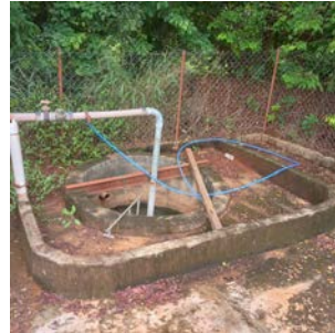
Foto 4 - Vista parcial interna da EEE.
