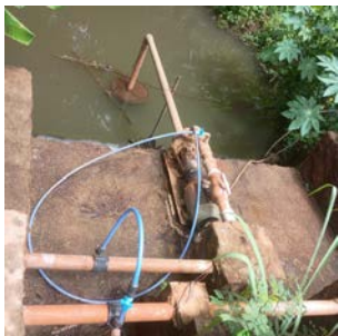
Foto 7 - Local de captação do sistema de retorno.
