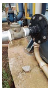
Foto 2 - Válvula de retenção direcionando o fluxo para dentro do reservatório
