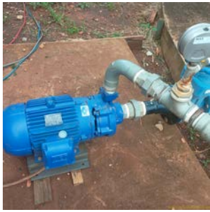
Foto 9 - Vista geral do equipamento 2 e interligações hidráulicas.
