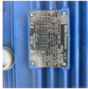
Foto 10 - Placa de especificações técnicas do motor do equipamento 2
