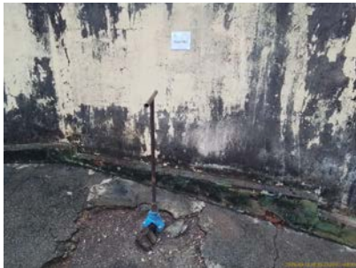
Foto 22 - Registro para manobra de água para a ETA III da ETA I (Reservatório água tratada)
