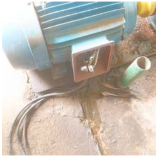
Foto 3 - Ausência de tampa na caixa de ligação elétrica do motor do conjunto do Pombal.
