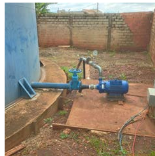
Foto 8 - Vista geral do equipamento 2 e interligações hidráulicas.
