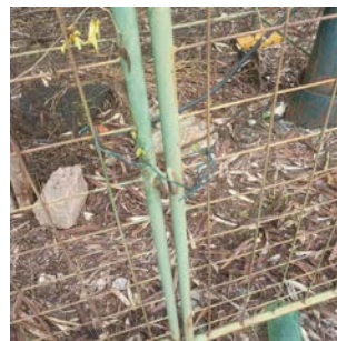
Foto 2 - Arame travando o portão.
