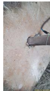
Foto 2 - Detalhe da laje de proteção quebrada
