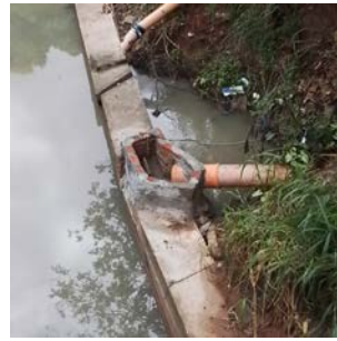
Foto 6 - Vista por cima das ligações de coletores no coletor tronco (fora da Norma)
