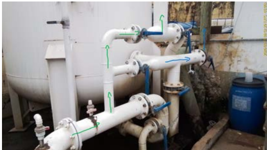
Foto 15 - Tubulação de entrada e saída do filtro. Entrada na seta verde e saída na seta azul
