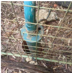
Foto 1 - Ausência de tubo para medição de nível.
