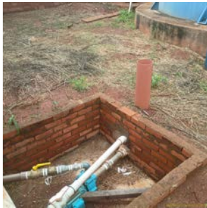
Foto 5 - Vista geral do equipamento e interligações hidráulicas do equipamento 1.
