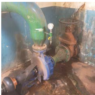
Foto 11 - Conjunto motobomba do Bom Jardim.
