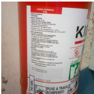
Foto 7 - Validade do extintor de incêndio.
