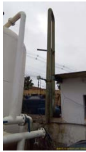
Foto 1 - Entrada de água no reservatório da ETA III
