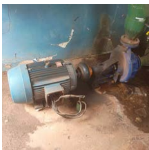
Foto 1 - Conjunto do Bom Jardim, sem tampa da ligação elétrica do motor.
