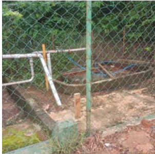
Foto 3 - Vista parcial interna da EEE.
