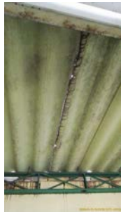
Foto 1 - Abertura no telhado permitindo passagem de chuva
