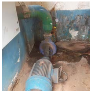
Foto 8 - Conjunto motobomba do Bom Jardim.
