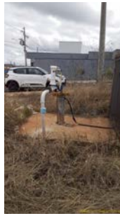
Foto 1 - A área não está cercada, permitindo acesso de pessoas estranhas a operação.
