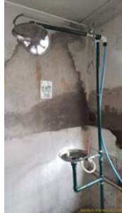
Foto 1 - Chuveiro de emergência
