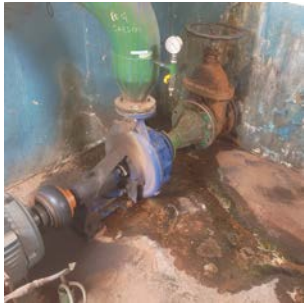
Foto 1 - Piso molhado próximo ao equipamento do Bom Jardim.
