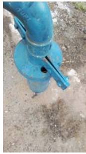
Foto 1 - Proteção para medidor de nível, porém não existe tal dispositivo
