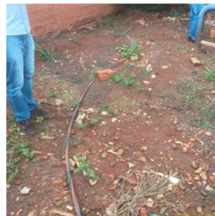
Foto 2 - Cabeamento elétrico no terreno, sem identificação ou proteção, sendo sua disposição inadequada tecnicamente.
