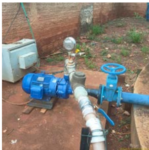
Foto 7 - Vista geral do equipamento 2 e interligações hidráulicas.
