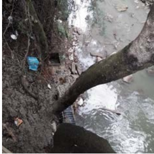
Foto 7 - Trecho conduzindo esgoto como canal aberto (irregular)
