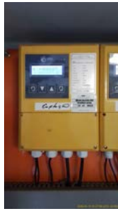
Foto 1 - Apesar de estar escrito Captação, medidor está na saída da ETA
