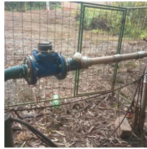
Foto 6 - Cavalete do poço.
