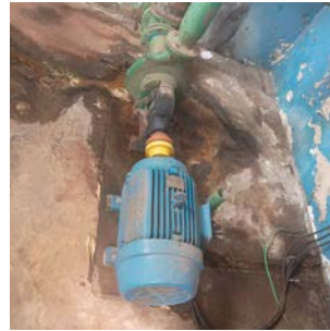
Foto 18 - Conjunto motobomba do Pombal.
