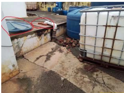
Foto 1 - Tampa de caixa d'água e azulejo como tampa de inspeção (irregular)
