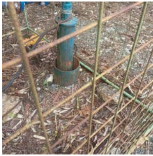
Foto 1 - Ausência de laje de proteção.
