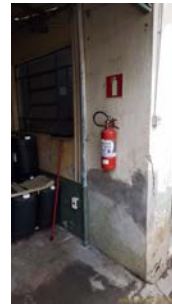
Foto 20 - Extintor de incêndio
