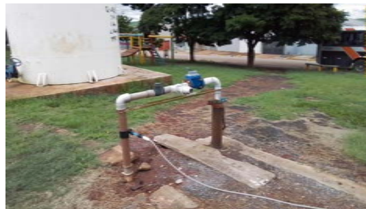
Foto 2 - A área não está cercada, permitindo acesso de pessoas estranhas a operação.
