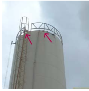
Foto 2 - Indicação dos locais sem tela de proteção.
