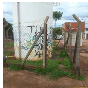
Foto 2 - Ausência de portão.
