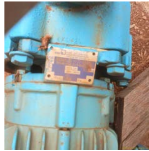
Foto 4 - Placa de especificações técnicas da bomba do equipamento 1.
