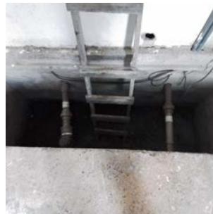
Foto 2 - Tubulação de recalque
