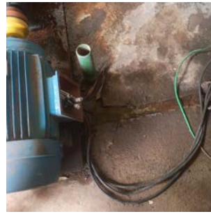
Foto 16 - Cabeamento elétrico exposto e motor sem tampa de proteção.
