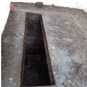
Foto 3 - Acesso para o tanque de equalização
