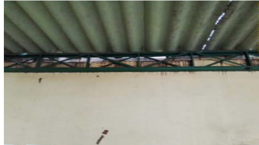
Foto 3 - Abertura no telhado permitindo passagem de chuva
