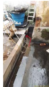
Foto 23 - Caminho que o lodo do decantador e filtro percorre
