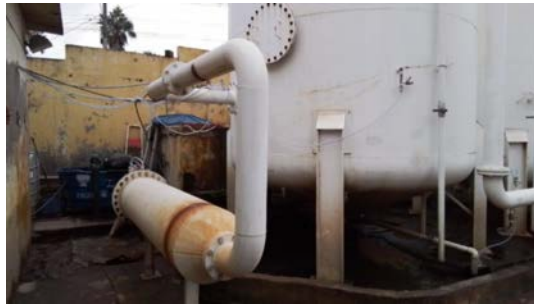
Foto 6 - Misturador rápido dos produtos químicos
