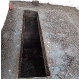
Foto 1 - Não possui acesso para manutenção do gradeamento grosseiro
