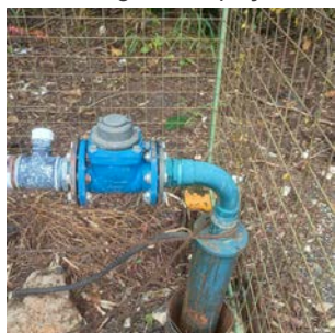
Foto 3 - Cavalete do poço.
