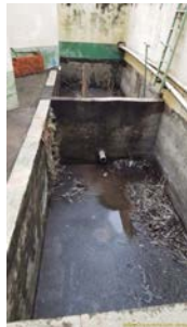
Foto 26 - Antigo sistema de decantação do lodo (irregular)
