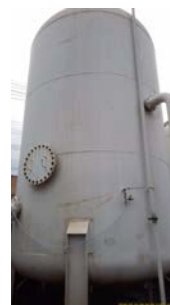
Foto 9 - Vista do decantador compacto
