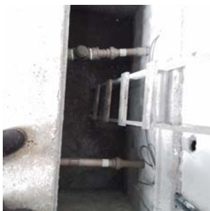
Foto 1 - Tubulação está trepidando
