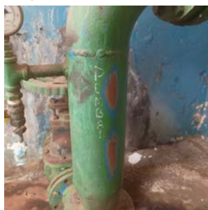
Foto 14 - Identificação na tubulação de recalque.
