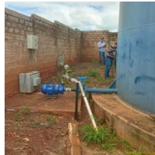
Foto 6 - Vista geral do equipamento 2 e interligações hidráulicas.
