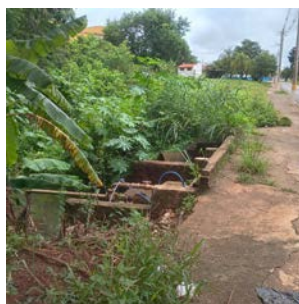
Foto 5 - Local de captação do sistema de retorno.
