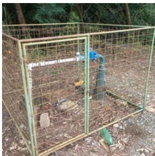
Foto 1 - Grade de proteção sem parte superior.
