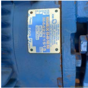
Foto 11 - Placa de especificações técnicas da bomba do equipamento 2.
