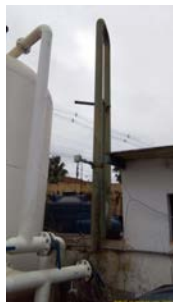
Foto 17 - Entrada de água no reservatório de água tratada
