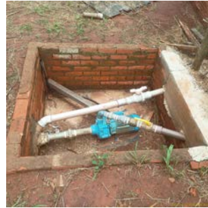
Foto 2 - Vista geral do equipamento 1.
