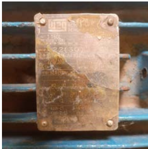
Foto 19 - Placa de especificações técnicas do motor do conjunto motobomba do Pombal.
