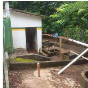
Foto 6 - Vista parcial interna da EEE.
