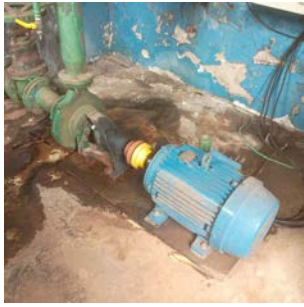
Foto 3 - Piso molhado próximo ao equipamento do Pombal.
