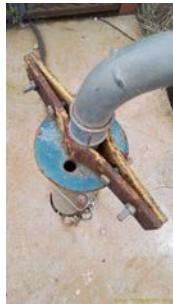
Foto 1 - Ausência de tubo de medição de nível
