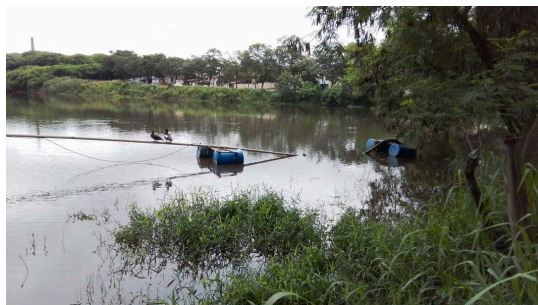
Foto 1 - Tubulação de recalque
