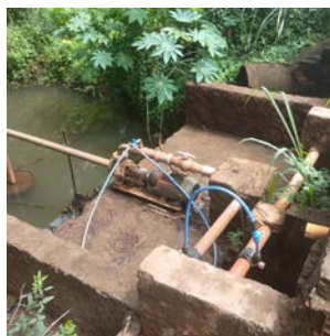
Foto 6 - Local de captação do sistema de retorno.
