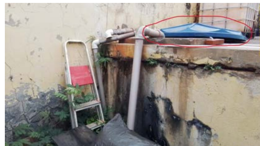
Foto 2 - Tampa de caixa d'água como tampa de inspeção (irregular)
