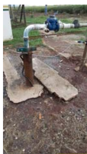
Foto 1 - Laje de proteção deficitária
