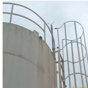
Foto 2 - Detalhe da haste do captor Franklin e a não interligação com a estrutura metálica do reservatório ou sistema de descida do SPDA.
