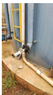
Foto 1 - Local onde deveria ser o tubo extravasador
