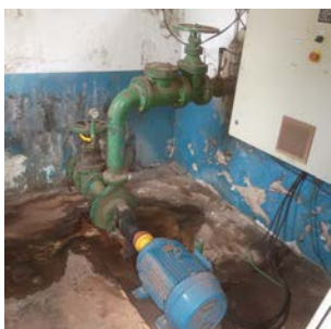
Foto 13 - Conjunto motobomba do Pombal.
