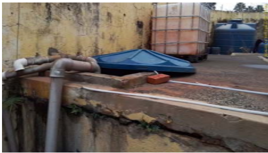
Foto 3 - Tampa de caixa d'água como tampa de inspeção (irregular)
