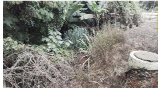
Foto 2 - Ponto do córrego atrás da ETA em que o lodo é descartado de forma irregular
