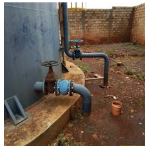
Foto 4 - Válvulas de saída e de entrada
