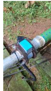
Foto 10 - Medidor de vazão
