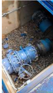
Foto 3 - Saída do reservatório e registro
