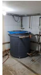
Foto 17 - Armazenamento de PAC
