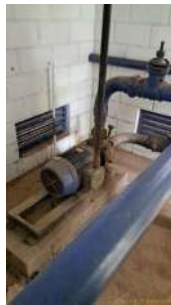
Foto 1 - Bomba em funcionamento
