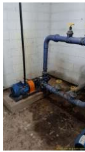
Foto 1 - Sistema de bombeamento da elevatória
