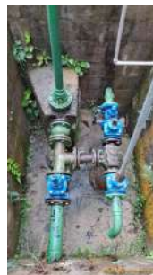
Foto 2 - Tubulação e registro do poço Santa Fé
