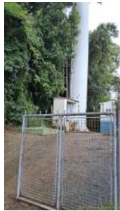
Foto 1 - Ausência de placa de identificação
