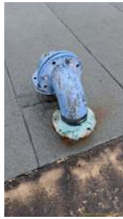
Foto 5 - Tubulação com rede de proteção contra insetos
