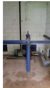
Foto 4 - Sistema de bombeamento
