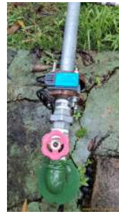
Foto 2 - Medidor de vazão
