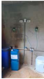
Foto 5 - Dosadores de cloro e flúor
