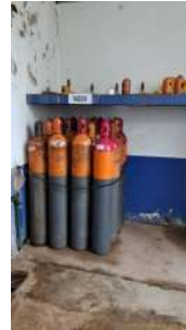
Foto 27 - Cilindros de cloro gás
