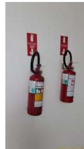
Foto 12 - Extintores de incêndio disponíveis
