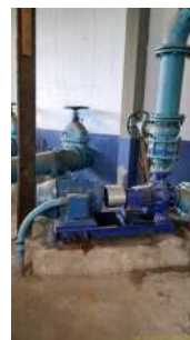
Foto 2 - Sistema de bombeamento da elevatória
