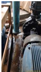
Foto 1 - Drenagem inadequada na bomba que recalca a água para o Reservatório Mirante
