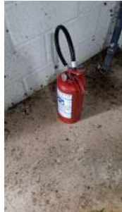
Foto 3 - Extintor de incêndio disponível na elevatória
