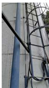
Foto 3 - Para-raios do reservatório
