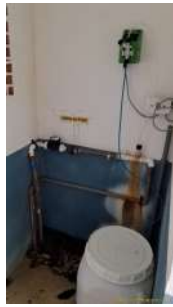
Foto 5 - Armazenamento de produto químico
