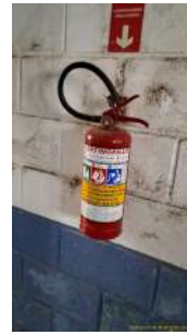
Foto 6 - Extintor de incêndio disponível
