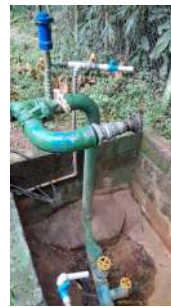
Foto 2 - Tubulação do poço
