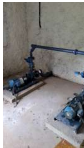
Foto 3 - Sistema de bombeamento da elevatória
