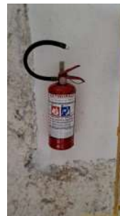
Foto 6 - Extintor de incêndio disponível
