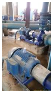
Foto 1 - Sistema de bombeamento da elevatória
