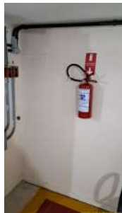
Foto 18 - Extintor de incêndio disponível
