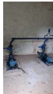
Foto 8 - Sistema de bombeamento da elevatória
