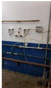
Foto 20 - Dosadores de produtos químicos
