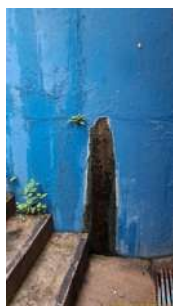
Foto 1 - Vazamento na lateral do reservatório
