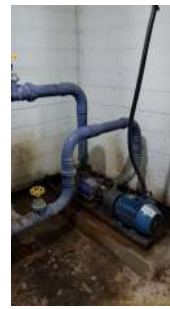
Foto 2 - Sistema de bombeamento da elevatória
