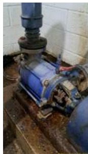
Foto 1 - Drenagem inadequada da água das gaxetas
