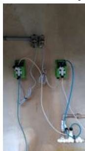
Foto 3 - Dosadores de cloro e flúor
