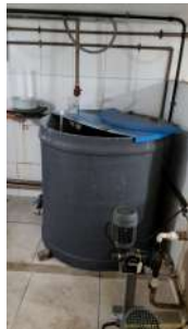
Foto 16 - Armazenamento de PAC
