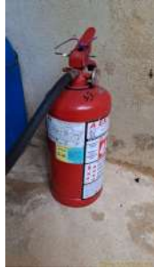
Foto 7 - Extintor de incêndio disponível
