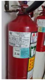
Foto 13 - Destaque para a validade do extintor (abril/2026)
