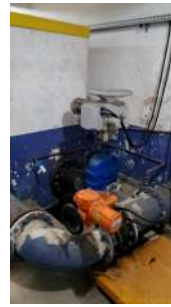
Foto 23 - Bomba dos filtros
