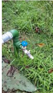
Foto 3 - Ponto para tomada de água
