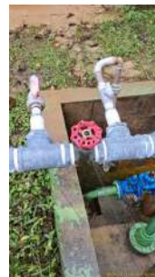
Foto 2 - Vazamento no registro do poço
