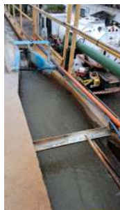
Foto 1 - Chegada da água bruta (Captação do Capivari e Bom Jardim)
