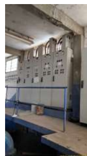
Foto 4 - Painéis elétricos da elevatória
