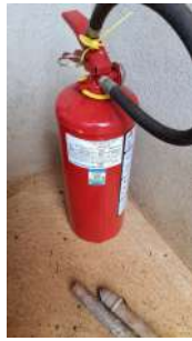
Foto 5 - Extintor disponível no local
