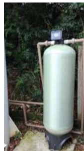
Foto 2 - Filtro ao lado do reservatório
