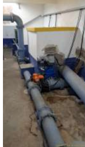
Foto 24 - Sistema de bombeamento
