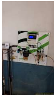
Foto 3 - Dosadores de cloro e fluor
