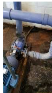
Foto 2 - Drenagem inadequada da água das gaxetas
