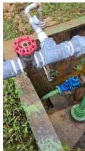
Foto 1 - Vazamento no registro do poço
