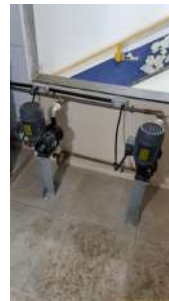
Foto 19 - Conjunto de bombas dosadoras
