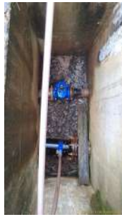
Foto 5 - Tubulação de saída e registro
