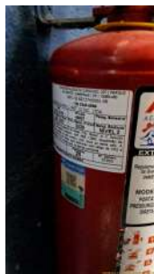
Foto 3 - Destaque para etiqueta com a validade do extintor (junho/2027)
