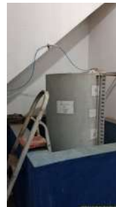
Foto 21 - Dosador de flúor
