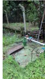
Foto 4 - Poço Santa Fé 3
