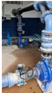
Foto 1 - Sistema de bombeamento da elevatória
