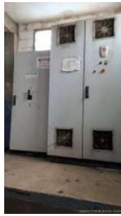
Foto 5 - Painéis elétricos da elevatória
