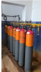
Foto 26 - Cilindros de cloro gás
