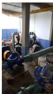
Foto 3 - Sistema de bombeamento da elevatória
