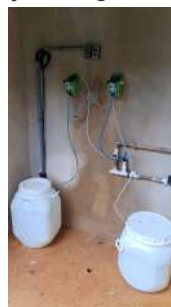
Foto 4 - Dosadores e tanque de armazenamento de produtos químicos
