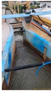
Foto 3 - Macromedidor de entrada
