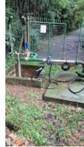
Foto 8 - Poço Santa Fé 1
