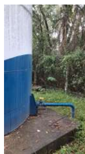
Foto 4 - Tubulação de saída do reservatório e registro
