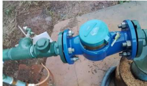
Foto 2 - Cavalete do poço e tomada para coleta de água bruta ao fundo.
