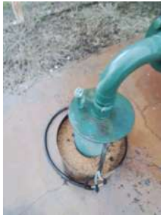
Foto 1 - Tubo de medição do nível do poço.
