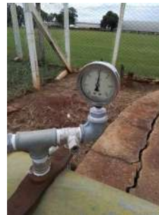
Foto 2 - Manômetro na base do reservatório.
