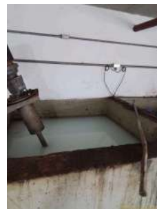
Foto 18 - Detalhe do tanque de polímero.
