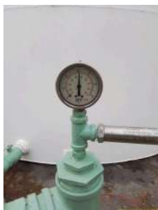
Foto 3 - Manômetro na base do reservatório.
