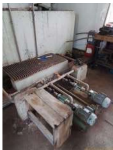
Foto 17 - Abrigo do polímero e bombas auxiliares - sob a centrífuga.
