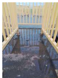
Foto 2 - Detalhe do acúmulo de efluente na passarela.
