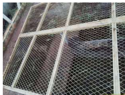
Foto 2 - Chegada da água bruta, atualmente sem qualquer escoamento.
