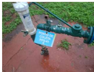
Foto 2 - Tomada para coleta de água.
