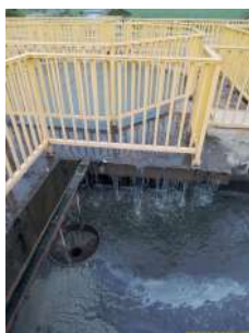
Foto 3 - Extravasamento de lodo.
