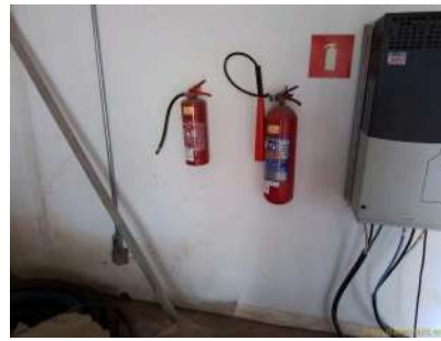
Foto 9 - Extintores no local.
