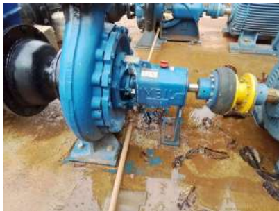
Foto 3 - Detalhe do conjunto motobomba 1.
