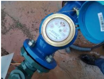
Foto 3 - Detalhe do macromedidor.
