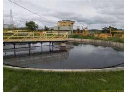
Foto 13 - Decantador após os filtros.
