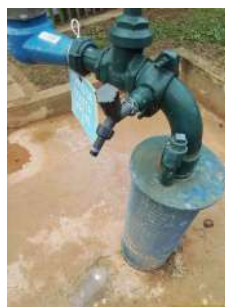
Foto 2 - Torneira para coleta de água bruta.
