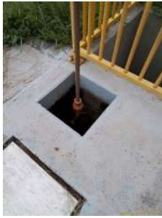
Foto 7 - Local próximo aos decantadores com abertura, representando risco aos operadores.
