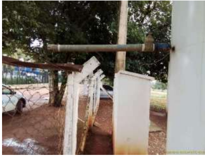
Foto 1 - Detalhe da tubulação com vazamento aparente.
