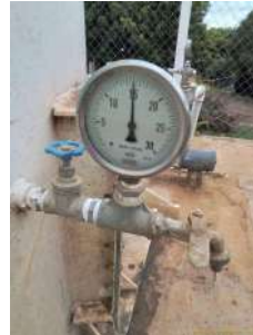
Foto 4 - Manômetro na base do reservatório 1.
