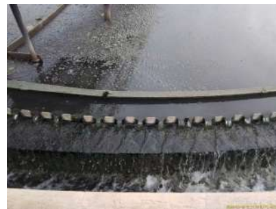
Foto 14 - Detalhe do decantador.
