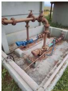
Foto 15 - Bombas (1+1) utilizadas na aplicação de polímero para secagem do lodo.
