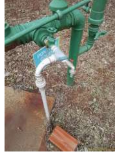
Foto 4 - Ponto para coleta de água bruta.
