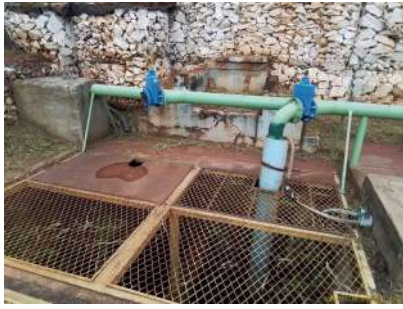
Foto 3 - Tubulações de recalque inativas.
