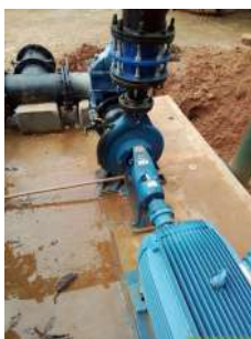
Foto 5 - Detalhe do conjunto motobomba 2.
