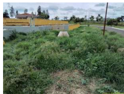
Foto 4 - Próximo aos tanques de lodo ativado foram constatados indícios de extravasamento e crescimento excessivo de vegetação, possivelmente em detrimento dos nutrientes extravasados.
