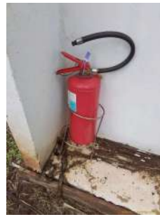
Foto 2 - Extintor disponível no local.
