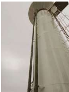
Foto 3 - Detalhe das tubulações do reservatório.
