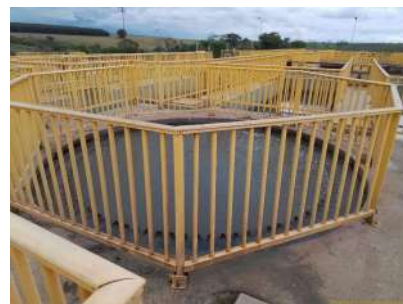
Foto 9 - Tanques de lodo ativado.
