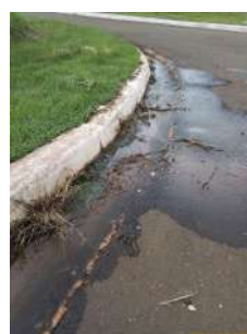
Foto 6 - Extravasamento nas sarjetas da ETE.
