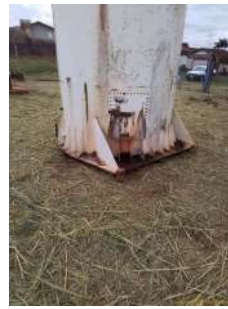
Foto 2 - Detalhe 1 do estado de conservação.
