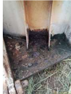
Foto 3 - Detalhe 2 do estado de conservação da base do reservatório.
