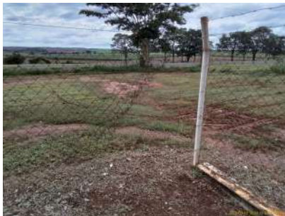
Foto 1 - Detalhe da abertura constatada durante a fiscalização.
