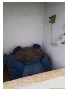
Foto 4 - Abrigo da bomba e produto químico.
