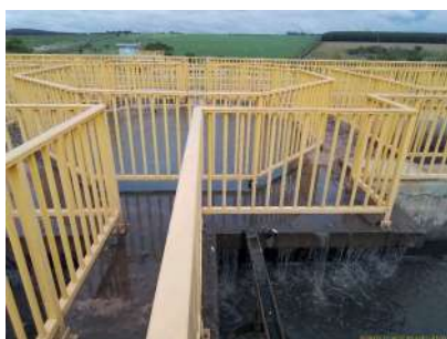
Foto 1 - Extravasamento no tanque de lodo ativado.
