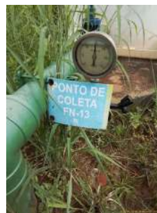
Foto 2 - Manômetro na base do reservatório.
