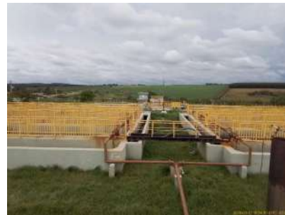
Foto 7 - Vista dos tanques de lodo ativado.
