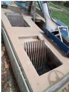
Foto 5 - Tratamento preliminar - gradeamento, utilizado quando é feita manutenção na rosca infinita.
