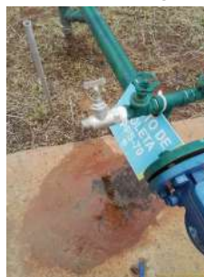
Foto 4 - Torneira para coleta de água bruta.
