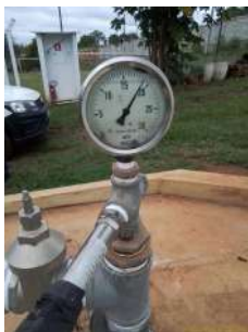
Foto 5 - Manômetro na base do reservatório 2.
