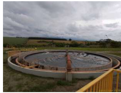
Foto 11 - Filtro 2 após os tanques de lodo ativado.
