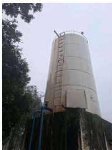
Foto 1 - O reservatório não dispõe de guarda-corpos junto à escada.
