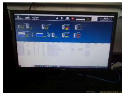
Foto 8 - Detalhe do supervisório com indicação de níveis de reservatórios.
