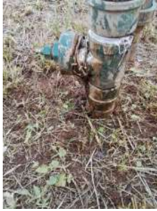
Foto 1 - Detalhe 1 do vazamento.
