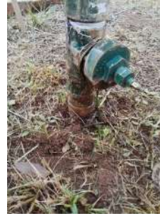
Foto 2 - Detalhe 2 do vazamento.
