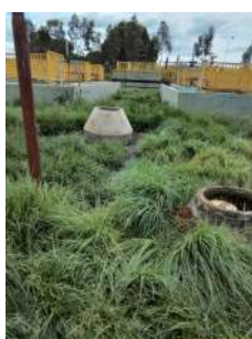
Foto 5 - Detalhe do acúmulo de vegetação junto ao ponto de extravasamento.
