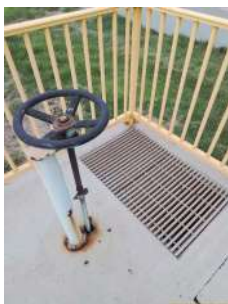
Foto 8 - Registro para controle do fluxo que chega aos tanques de lodo ativado.
