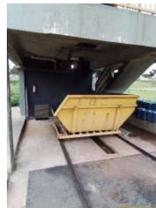
Foto 16 - Caçamba para recebimento de lodo seco.
