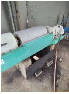
Foto 19 - Centrífuga usada na secagem do lodo.
