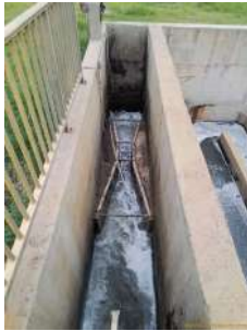
Foto 1 - Detalhe da saída do efluente tratado.
