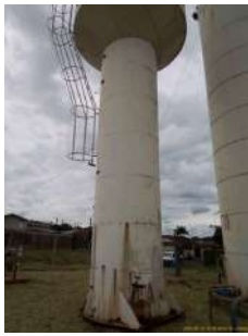
Foto 1 - Reservatório com indícios de conservação prejudicada.
