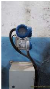
Foto 7 - Macromedidor das saídas dos reservatórios
