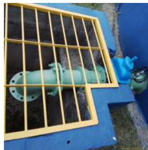
Foto 5 - Tubulação de descarga
