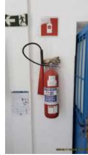
Foto 39 - Extintor na ETA
