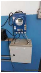
Foto 10 - Medidor de vazão da entrada da ETA
