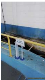
Foto 14 - Calha parshall na entrada
