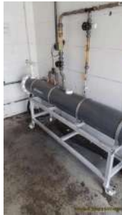
Foto 3 - Gerador de hipoclorito.
