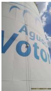
Foto 1 - Medidor de nível
