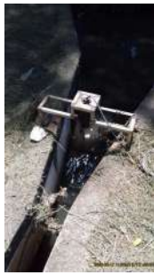
Foto 3 - Medidor de vazão no tratamento preliminar
