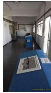
Foto 12 - Mesas de comando dos filtros
