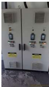
Foto 1 - Painel de comando da elevatória de esgoto tratado.
