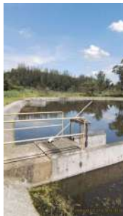
Foto 26 - Saídas da lagoa de decantação.
