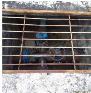
Foto 2 - Válvulas de fechamento
