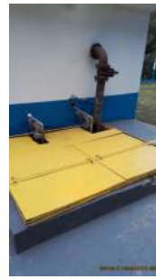
Foto 10 - Sucção das bombas
