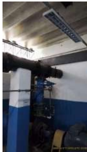
Foto 9 - Tubulação de recalque
