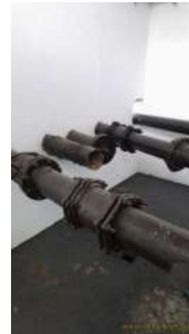
Foto 3 - Recalque das bombas
