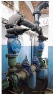
Foto 10 - Recalque para reservatório elevado.
