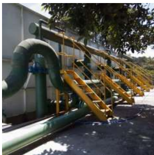
Foto 7 - Saída de água dos filtros
