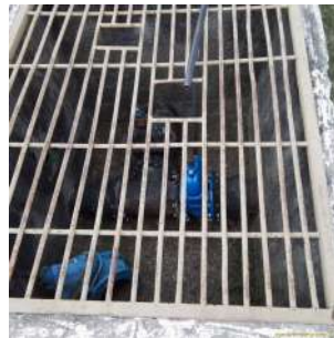
Foto 3 - Válvulas de fechamento
