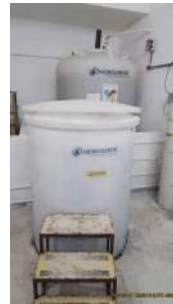
Foto 13 - Cloreto de sódio para geração de hipoclorito
