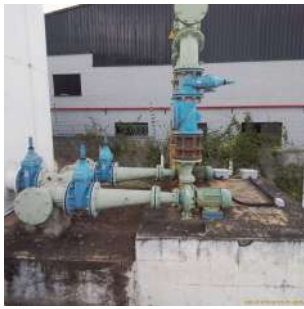
Foto 1 - Vista geral do barrilete e conjunto motobomba
