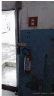
Foto 1 - Extintor na casa de bombas
