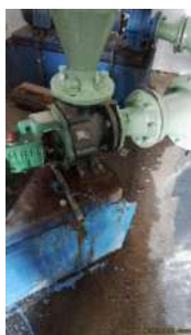
Foto 1 - Drenagem de água de lubrificação.
