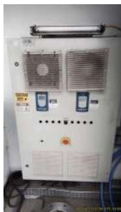
Foto 7 - Painéis de comando das bombas.
