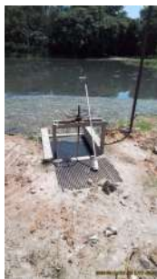
Foto 16 - Saída da lagoa anaeróbia com destino à lagoa aerada.
