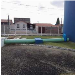
Foto 6 - Tubulação conectado ao reservatório
