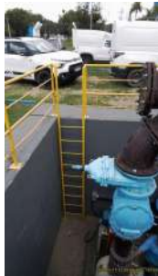
Foto 1 - Escada para acessar as bombas.
