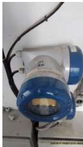
Foto 9 - Macromedidores das saídas dos reservatórios.
