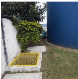
Foto 4 - Saída de água do reservatório
