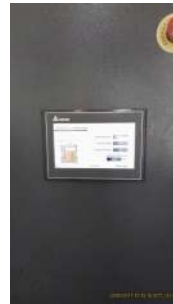
Foto 6 - Display do sistema de geração de hipoclorito
