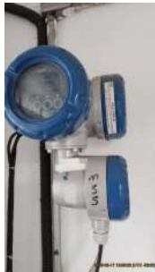
Foto 7 - Macromedidores das saídas dos reservatórios.
