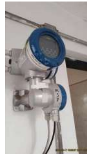
Foto 8 - Macromedidores das saídas dos reservatórios.
