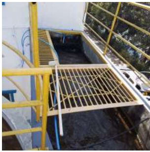
Foto 3 - Entrada de água bruta
