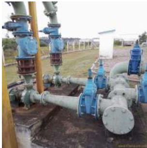
Foto 4 - Vista geral do barrilete e conjunto motobomba
