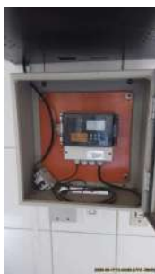
Foto 1 - Display do medidor de vazão da entrada.
