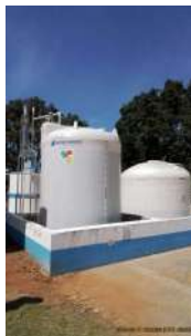
Foto 7 - Armazenamento de hipoclorito de sódio
