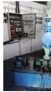
Foto 4 - Bombas que recalcam para o reservatório elevado.
