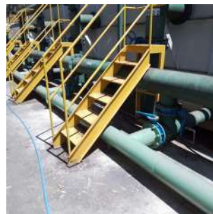
Foto 12 - Tubulação de saída de água da lavagem dos filtros e água tratada
