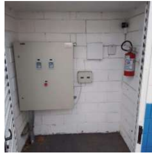
Foto 6 - Vista interna da casa do painel elétrico
