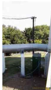
Foto 26 - Entrada de água bruta na ETA
