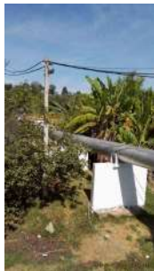
Foto 25 - Tubulação de água bruta
