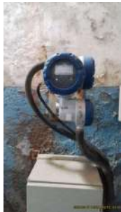
Foto 5 - Macromedidor das saídas dos reservatórios
