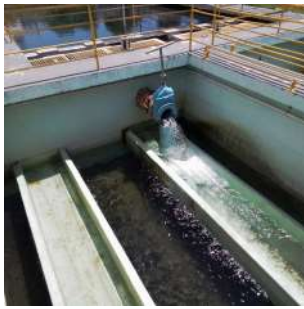
Foto 13 - Entrada de água para os filtros
