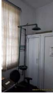
Foto 38 - Chuveiro de emergência no laboratório
