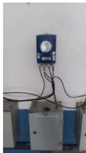
Foto 3 - Medidor de vazão da saída.
