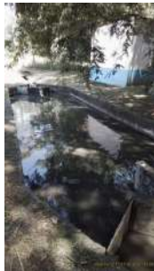
Foto 8 - Caixa de areia.
