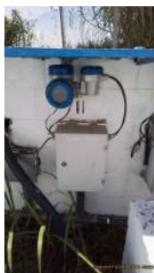
Foto 6 - Medidor de vazão da saída.
