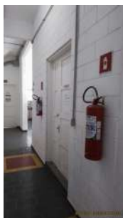
Foto 1 - Extintores na ETA
