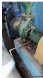
Foto 9 - Drenagem de água de lubrificação
