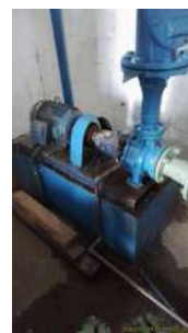
Foto 2 - Drenagem da água de lubrificação
