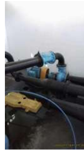
Foto 2 - Recalque da bomba submersível.
