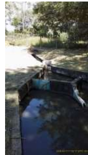
Foto 9 - Caixa de areia
