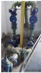
Foto 3 - Bombas que recalcam para o condomínio Conquista.
