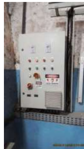
Foto 8 - Painel de comando bombas
