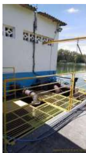
Foto 1 - Elevatória que bombeia esgoto tratado da lagoa de maturação para posterior lançamento.
