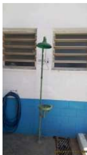
Foto 1 - Chuveiro de emergência
