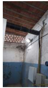
Foto 11 - Tubulação de recalque
