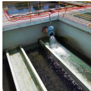
Foto 2 - Passarela entre os decantador e o filtro está sem guarda-corpo
