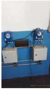
Foto 3 - Macromedidores da água bruta
