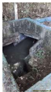
Foto 2 - Entrada de efluente
