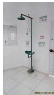
Foto 2 - Chuveiro de emergência no laboratório
