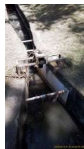
Foto 2 - Calha parshal e medidor ultrassônico.
