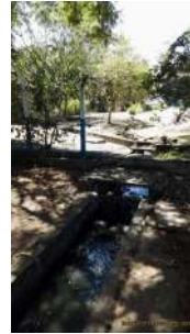
Foto 5 - Chegada de efluente bruto.
