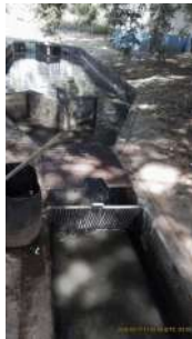
Foto 6 - Gradeamento no tratamento preliminar
