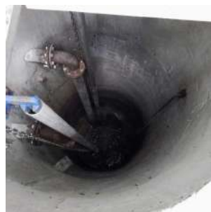
Foto 4 - Bomba submersa para recalque do esgoto
