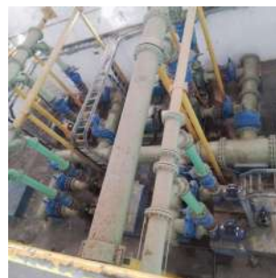
Foto 10 - Foto geral da casa de bombas
