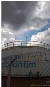
Foto 1 - Para raios no reservatório metálico
