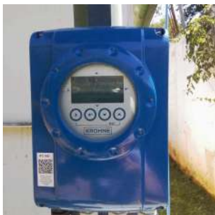
Foto 11 - Macromedidor de vazão
