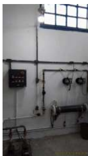
Foto 14 - Gerador de hipoclorito de sódio
