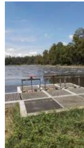
Foto 18 - Entrada na lagoa aerada
