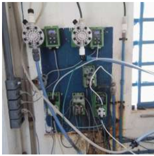
Foto 13 - Bombas dosadoras de produtos químicos
