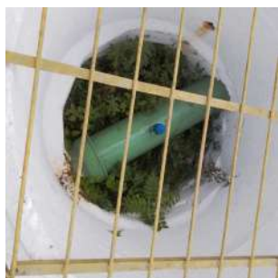
Foto 5 - Válvula eliminadora de ar (Ventosa)
