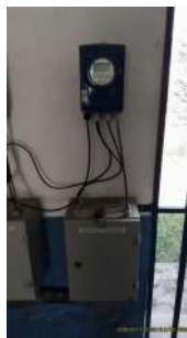
Foto 2 - Medidor de vazão da saída.
