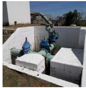
Foto 8 - Tubulações e registro
