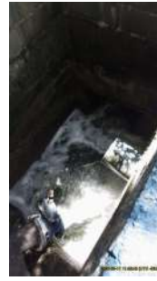
Foto 4 - Saída de efluente tratado.
