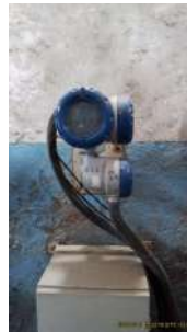
Foto 6 - Macromedidor das saídas dos reservatórios
