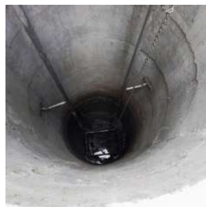
Foto 2 - Cesto para remoção de material grosseiro
