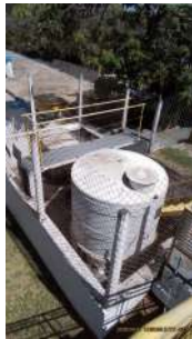
Foto 1 - Armazenamento de flúor
