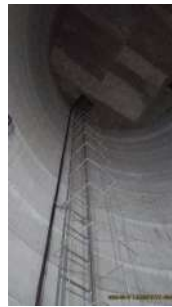
Foto 2 - Escada para manutenção
