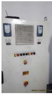
Foto 9 - Painel das bombas
