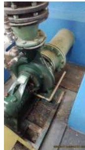
Foto 8 - Drenagem de água de lubrificação
