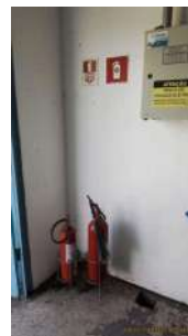
Foto 2 - Extintor na elevatória.
