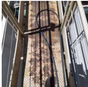
Foto 1 - Passarela metálica entre os decantadores apresenta pontos de corrosão, com potencial comprometimento da integridade estrutural e risco de acidentes por queda.
