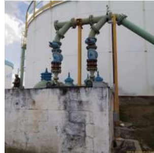
Foto 3 - Vista geral do barrilete de saída
