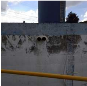
Foto 1 - Sem tela de proteção, permitindo o acesso de insetos e pequenos animais.
