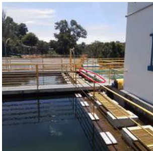
Foto 1 - Passarela entre os decantador e o filtro está sem guarda-corpo
