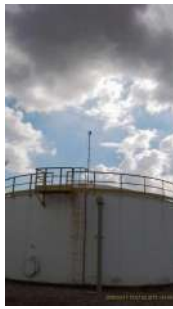
Foto 1 - Ventilação na cobertura do metálico
