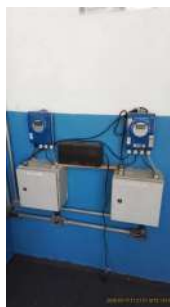
Foto 9 - Medidores de vazão da entrada, situados na captação.
