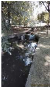
Foto 10 - Caixa de areia
