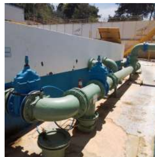
Foto 8 - Condução da água da ETA no reservatório
