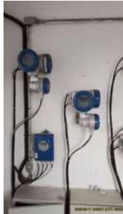
Foto 5 - Macromedidores das saídas dos reservatórios.
