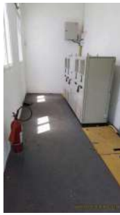
Foto 21 - Extintor junto aos painéis dos sopradores
