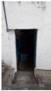
Foto 1 - Entrada de casa de bombas.
