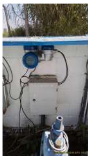
Foto 8 - Medidor de vazão da saída.
