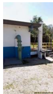
Foto 2 - Tubulação de recalque para a ETA
