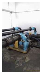
Foto 2 - Duas bombas centrífugas e uma submersível.
