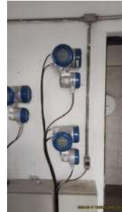
Foto 6 - Macromedidores das saídas dos reservatórios.
