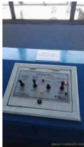
Foto 26 - Mesa de controle de um dos filtros
