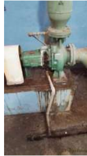
Foto 4 - Drenagem de água de lubrificação
