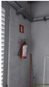
Foto 1 - Extintor na elevatória
