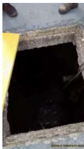
Foto 4 - Poço úmido da elevatória com cesto peneira
