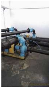
Foto 1 - Duas bombas centrífugas e uma submersível.
