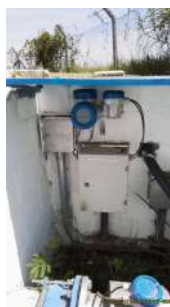
Foto 5 - Medidor de vazão da saída.
