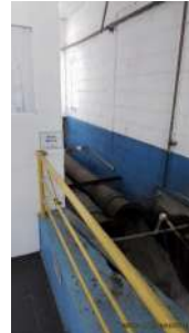
Foto 13 - Entrada de água bruta
