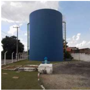
Foto 1 - Foto geral do reservatório (entrada, saída e tubo extravasador)
