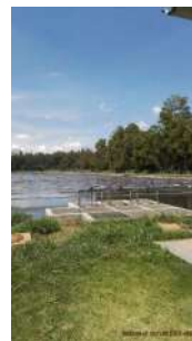
Foto 17 - Entrada do efluente na lagoa aerada.
