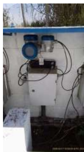
Foto 7 - Medidor de vazão da saída.
