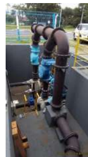
Foto 5 - Bombas e recalque.
