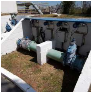
Foto 7 - Tubulações e macromedidores
