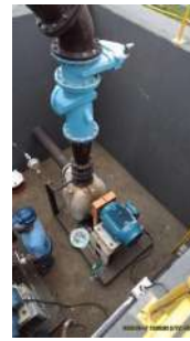
Foto 2 - Bomba centrífuga da elevatória
