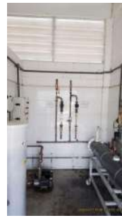
Foto 2 - Gerador de hipoclorito de sódio para desinfecção
