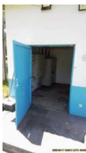
Foto 3 - Entrada da elevatória de esgoto tratado.
