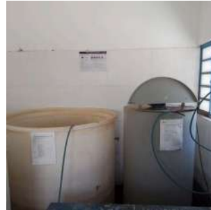
Foto 15 - Reservatório de hipoclorito de sódio
