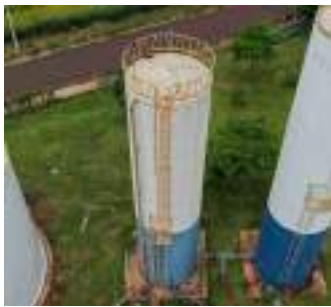
Foto 7 - Reservatório 1 - Escadas de acesso e guarda-corpos do topo do reservatório. À esquerda da escada se encontra a tubulação de entrada da água captada no Poço Habitacional.
