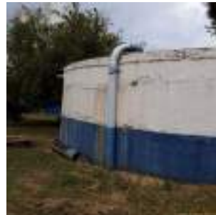
Foto 8 - Adutora do Poço Habitacional.
