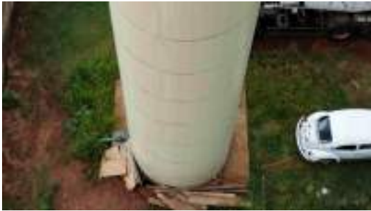
Foto 1 - Entulho depositado na base do reservatório.
