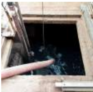
Foto 27 - Caixa de homogeneização do lodo.
