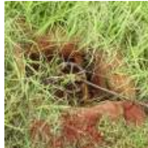
Foto 4 - Detalhe da caixa de registro da tubulação que conduz água tratada ao Reservatório Caixa de Ferro. Observa-se que a caixa não possui proteção nas bordas, as quais se encontram ao nível do solo, representando risco de acidentes.
