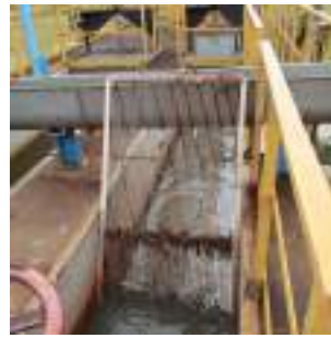
Foto 4 - Detalhe do gradeamento na entrada do tratamento preliminar. Trata-se de gradeamento mecanizado que está inoperante no momento, a limpeza da grade é realizada manualmente pelos operadores.
