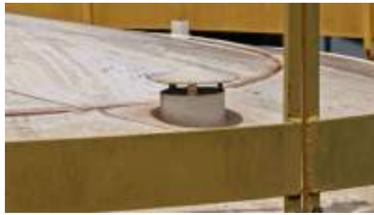
Foto 8 - Tubo de ventilação no topo do reservatório.
