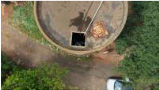
Foto 1 - Tampa da abertura de inspeção deteriorada.
