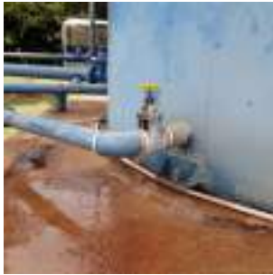
Foto 1 - Detalhe do vazamento existente na tubulação de saída do primeiro reservatório.
