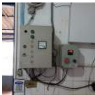
Foto 12 - Medidor de nível instalado na sala dos operadores.
