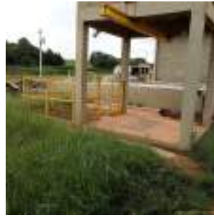
Foto 30 - Caixa de recalque da água do tratamento de lodo para o tratamento preliminar.
