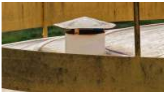
Foto 8 - Detalhe do tubo de ventilação no topo do reservatório.
