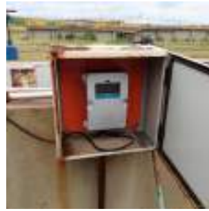
Foto 4 - Tratamento terciário: O macromedidor ultrassônico não está funcionando.
