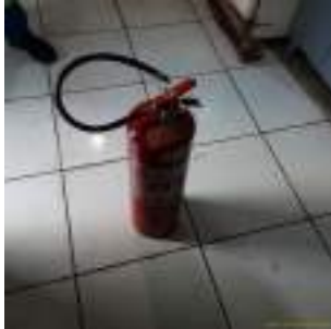
Foto 15 - Extintor de incêndio instalado na sala de operação.
