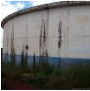
Foto 5 - Pontos de vazamento na parede do reservatório.
