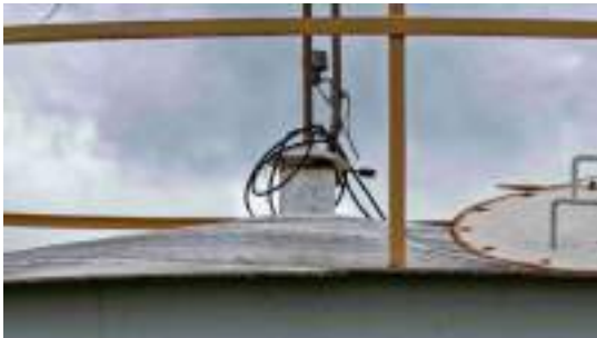
Foto 8 - Tubo de ventilação no topo do reservatório.
