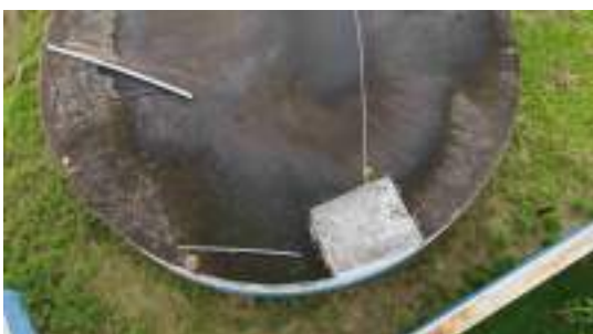
Foto 1 - Detalhe da tampa de inspeção danificada.
