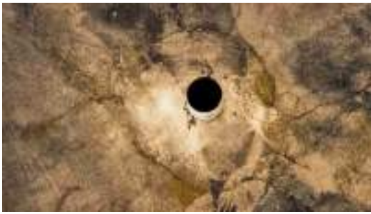
Foto 1 - Tubo de ventilação sem tela no topo do reservatório.
