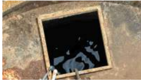
Foto 2 - Abertura de inspeção sem qualquer proteção, com a água tratada exposta ao ambiente.
