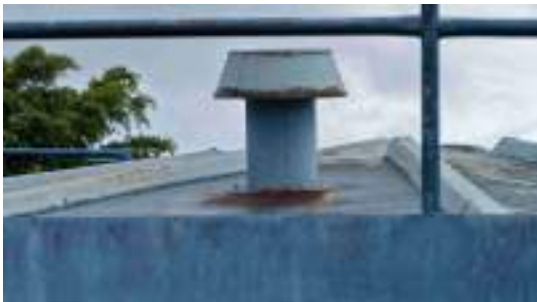
Foto 9 - Tubo de ventilação 1 no topo do reservatório.
