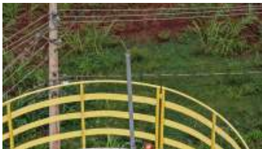
Foto 8 - Haste do para-raios no topo do reservatório.
