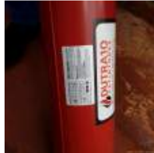
Foto 17 - Detalhe da etiqueta de controle de manutenções do extintor.
