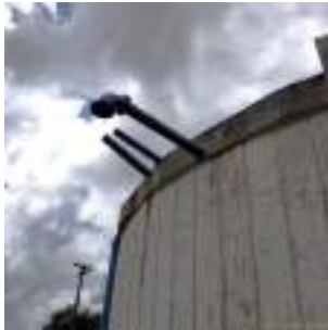
Foto 3 - Tubo extravasor sem tela de proteção.
