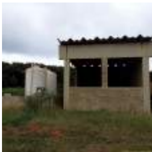
Foto 35 - Estruturas do sistemas de dosagem de Hipoclorito de Sódio no efluente tratado. Este sistema não está em funcionamento.
