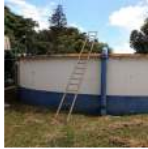
Foto 2 - Escada inadequada apoiada na parede do reservatório.
