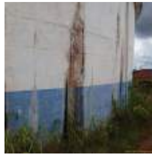
Foto 2 - Pontos de vazamento na parede do reservatório.
