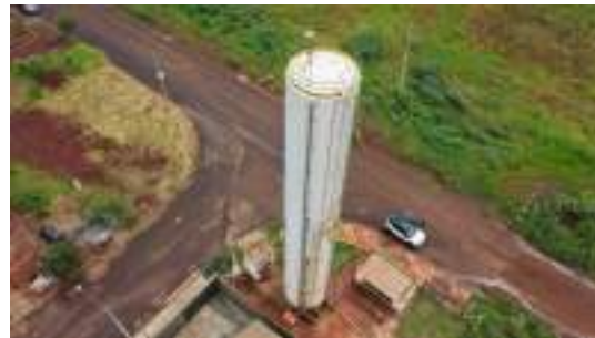
Foto 4 - Vista geral do reservatório. É possível observar a escada de acesso ao topo do reservatório e a sua esquerda, o tubo extravasador.
