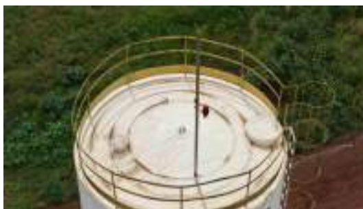
Foto 7 - Detalhe da haste do para-raios.
