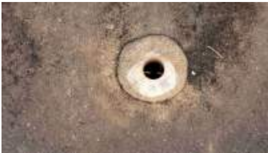
Foto 1 - Tubo de ventilação sem tela de proteção.
