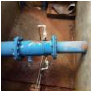
Foto 9 - Vista da tubulação no interior da caixa, neste ponto ocorre aplicação de cloro e flúor na água bruta.
