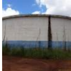
Foto 4 - Pontos de vazamento na parede do reservatório.
