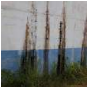
Foto 1 - Pontos de vazamento na parede do reservatório.
