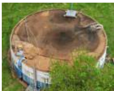
Foto 1 - Ausência de guarda-corpos.
