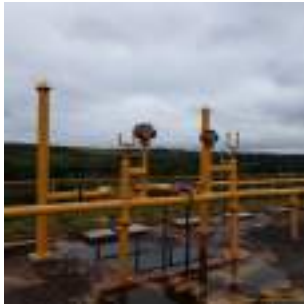
Foto 3 - Tratamento Secundário: As válvulas corta-fogo não estão funcionando, falta manômetros e manutenção.
