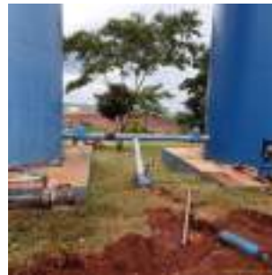
Foto 6 - Detalhe da tubulação de comunicação dos reservatórios.
