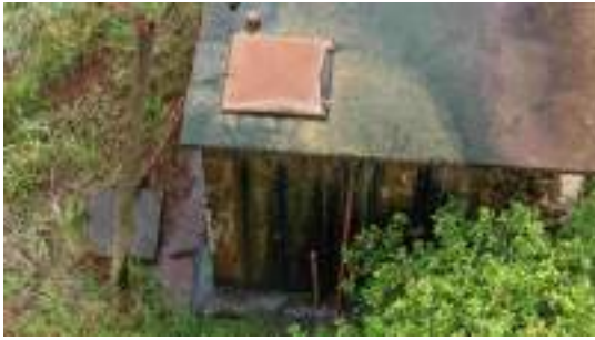
Foto 1 - Detalhe do extravasamento.
