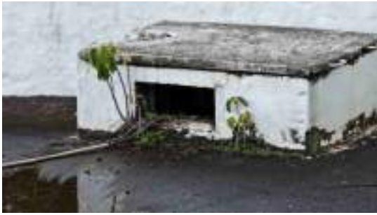
Foto 2 - Detalhe da estrutura de sustentação da tampa com abertura sem proteção.
