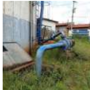
Foto 10 - Bomba que permite a adução de água do Reservatório 750 para o Reservatório São Domingos.
