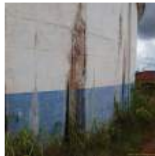
Foto 2 - Pontos de vazamento na parede do reservatório.
