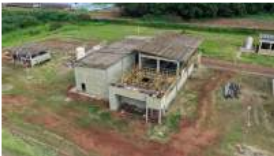
Foto 14 - Vista aérea do tratamento terciário, composto por dois floculadores e dois flotadores.
