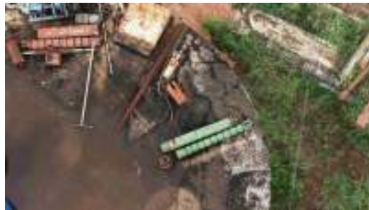
Foto 4 - Reservatório 2 - Detalhe do material depositado sobre o reservatório.
