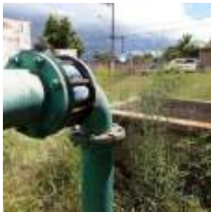
Foto 1 - Detalhe do ponto da tubulação onde está o vazamento.
