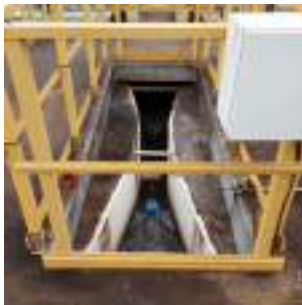
Foto 7 - Calha Parshal para medição da vazão na entrada do tratamento.
