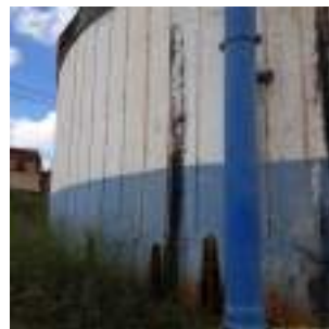
Foto 2 - Pontos de vazamento na parede do reservatório.
