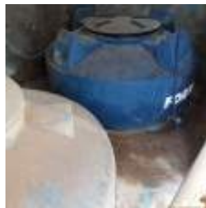
Foto 13 - Tanques de cloro e flúor.
