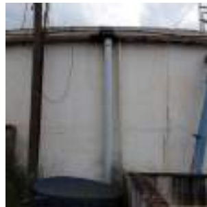
Foto 10 - Adutora da água captada no Poço Sonho Nosso V.
