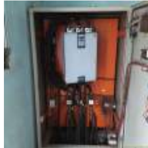
Foto 8 - Detalhe do painel elétrico do poço.
