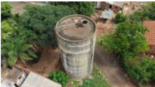
Foto 1 - Topo do reservatório sem guarda-corpos ou qualquer tipo de proteção.
