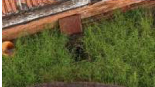
Foto 7 - Detalhe de caixa com a tampa aberta, representando risco de acidentes.
