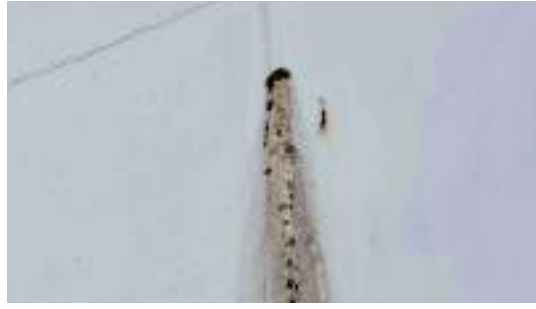
Foto 2 - Detalhe do ponto com vazamento.
