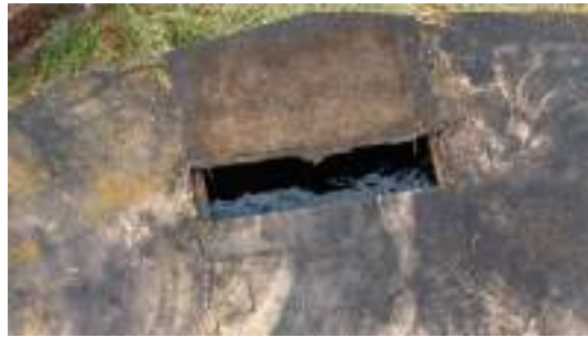
Foto 2 - Tampa de concreto aparentemente desativada, que se encontra danificada.
