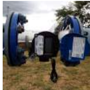
Foto 8 - Macromedidor de vazão.
