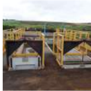
Foto 6 - Vista geral das calhas de entrada do efluente. À direita deveria estar instalado o equipamento para gradeamento automatizado.
