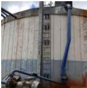
Foto 1 - Medidor de nível danificado.
