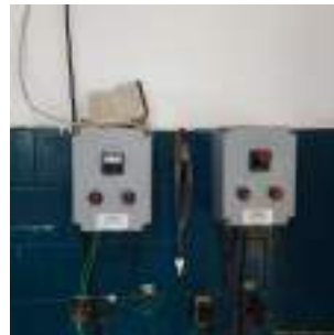
Foto 21 - Medidor do nível dos reservatórios vaso comunicantes (à esquerda).
