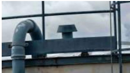
Foto 10 - Tubo de ventilação 2 no topo do reservatório.
