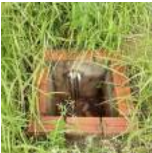
Foto 3 - Detalhe de caixa de passagem de tubulação. Observa-se que a caixa não possui proteção nas bordas, as quais se encontram ao nível do solo, representando risco de acidentes.
