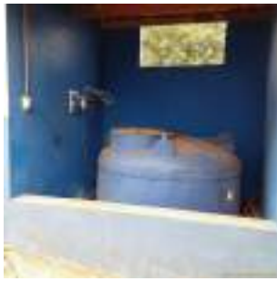
Foto 13 - Tanque e bomba dosadora de flúor.
