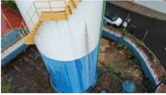
Foto 1 - Vista geral do ponto com vazamento.
