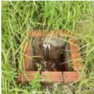
Foto 3 - Detalhe de caixa de passagem de tubulação. Observa-se que a caixa não possui proteção nas bordas, as quais se encontram ao nível do solo, representando risco de acidentes.
