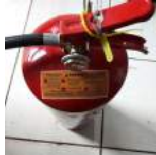
Foto 16 - Detalhe da etiqueta de controle de manutenções do extintor.
