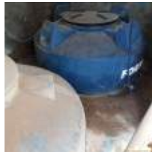
Foto 3 - Tanques de produtos químicos sem dique de contenção.
