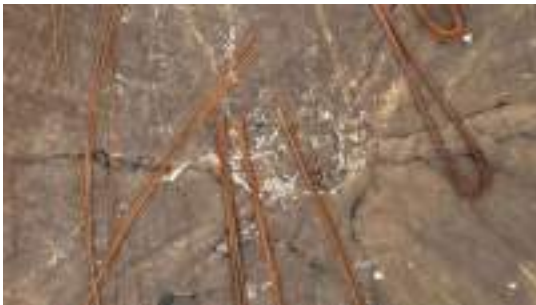
Foto 1 - Reservatório 1 - Detalhe do material depositado sobre o reservatório.
