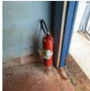
Foto 9 - Extintor de incêndio instalado no interior da edificação.
