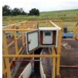
Foto 2 - Tratamento preliminar: O macromedidor ultrassônico não está funcionando.
