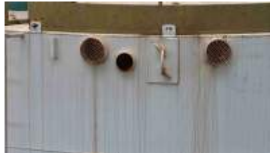
Foto 17 - Reservatório 2 - Tubos extravasores e de ventilação.
