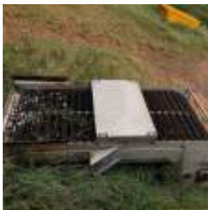
Foto 1 - Tratamento preliminar: O gradeamento mecanizado não está funcionando, a grade está depositada sobre o solo.
