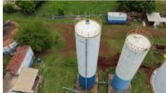
Foto 15 - Reservatório 2 - Tubulação de entrada da água captada no Poço Quinta do Vale.
