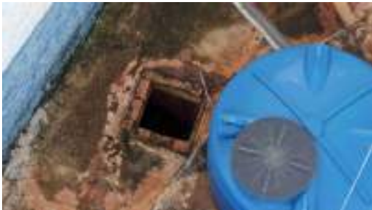
Foto 8 - Detalhe de caixa sem proteção, representando risco de acidentes.
