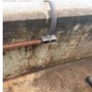
Foto 5 - Tratamento terciário: O macromedidor ultrassônico da calha Parshal de saída do efluente tratado foi removido.
