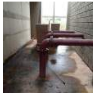
Foto 26 - Caixa de homogeneização do lodo.
