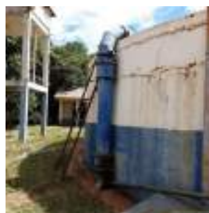
Foto 2 - Escada inadequada apoiada na parede do reservatório.
