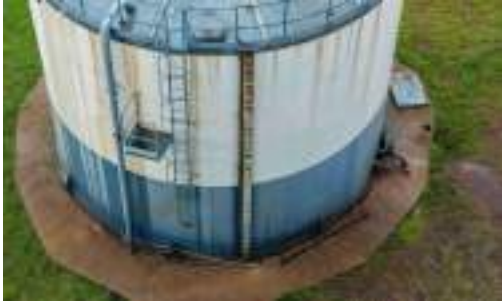
Foto 1 - Detalhe da régua de medição de nível instalada na parede do reservatório.
