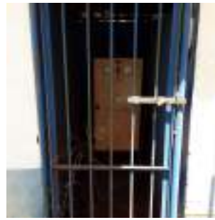
Foto 15 - Painel elétrico das bombas dosadoras.
