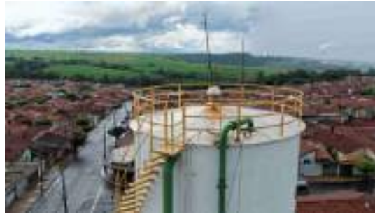
Foto 6 - Detalhe da haste do para-raios no topo do reservatório.
