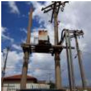
Foto 1 - Transformador de energia instalado sobre suporte de madeira.
