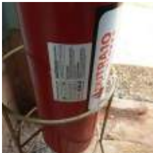
Foto 10 - Detalhe da etiqueta de controle de manutenções do extintor.
