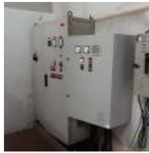
Foto 14 - Detalhe dos painéis elétricos.
