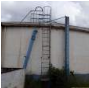
Foto 9 - Escada de acesso ao topo do reservatório. À esquerda da escada, a adutora da água captada no Poço São Domingos, à direita, o medidor de nível original do reservatório que não está em funcionamento.
