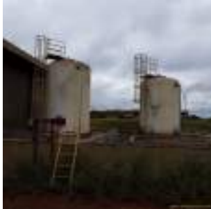
Foto 31 - Tanque de armazenamento de PAC, o outro está desativado.
