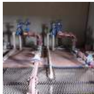
Foto 28 - Tubulação das bombas do sistema de tratamento de lodo.
