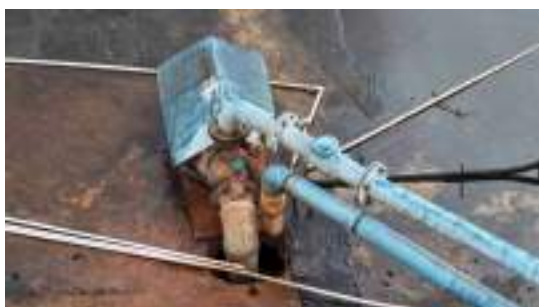
Foto 1 - Bomba instalada no topo do reservatório, em ponto sem proteção.
