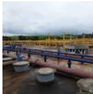
Foto 13 - A tubulação amarela é destinada à condução do biogás, já a azul, para gases odoríferos.
