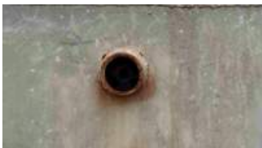
Foto 1 - Tubo extravasor sem tela de proteção
