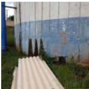
Foto 1 - Pontos de vazamento na parede do reservatório.
