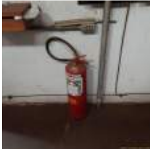
Foto 15 - Extintor instalado no interior da edificação.
