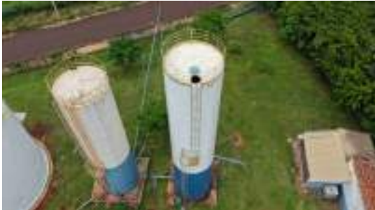
Foto 14 - Reservatório 2 - Escadas de acesso e guarda-corpos do topo do reservatório.
