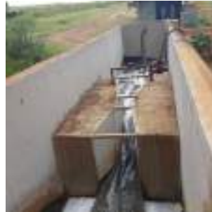
Foto 34 - Calha Parshal de passagem do efluente tratado.
