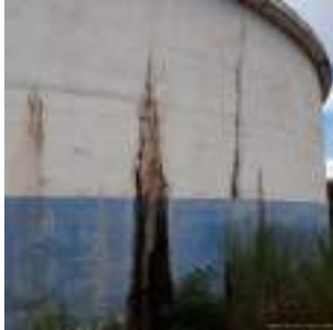
Foto 3 - Pontos de vazamento na parede do reservatório.
