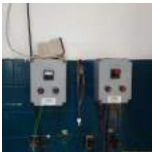
Foto 9 - Medidor do nível do reservatório (à direita).
