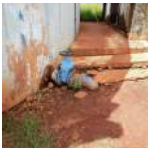
Foto 12 - Tubulação de saída para abastecimento.
