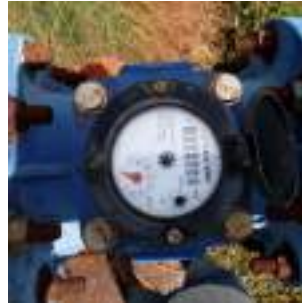
Foto 6 - Macromedidor de vazão.
