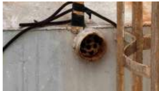
Foto 9 - Reservatório 1 - Tubo de ventilação.
