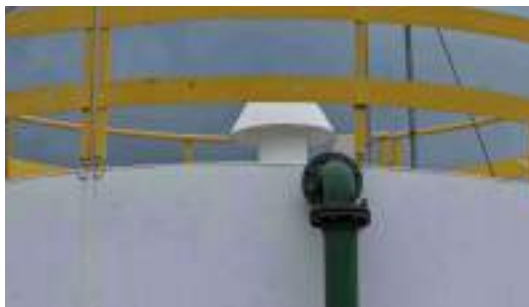
Foto 9 - Tubo de ventilação no topo do reservatório.
