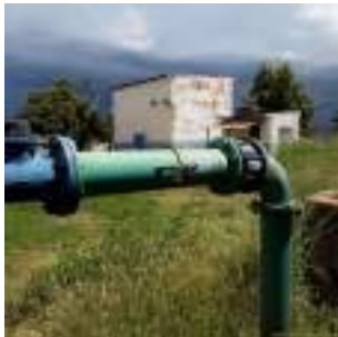
Foto 7 - Torneira para coleta de água bruta.
