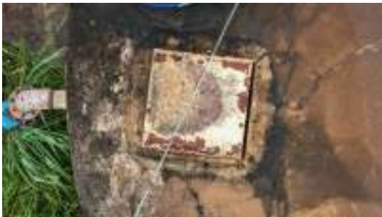
Foto 1 - Reservatório 2 - Detalhe da tampa de inspeção.
