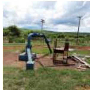
Foto 2 - Entulho depositado no entorno do poço.
