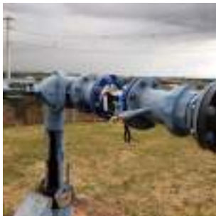
Foto 9 - Torneira para coleta de água bruta.
