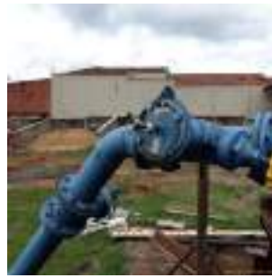
Foto 6 - Torneira para coleta de água bruta.
