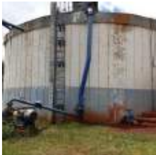
Foto 9 - Escada de acesso ao topo do reservatório. À esquerda da escada, o medidor de nível original do reservatório que não funciona, à direita, a adutora da água que vem do Reservatório São Domingos.
