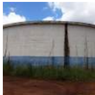
Foto 4 - Pontos de vazamento na parede do reservatório.
