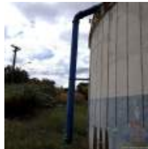
Foto 11 - Adutora da água captada no Poço 2004.
