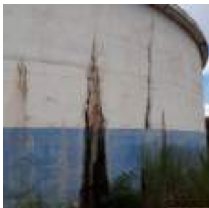
Foto 3 - Pontos de vazamento na parede do reservatório.
