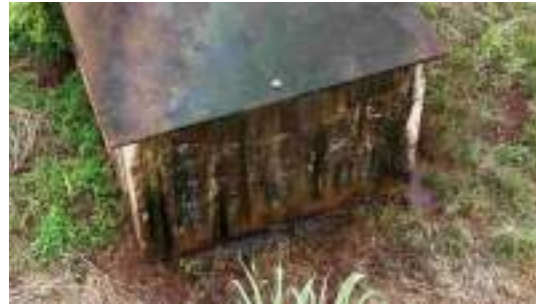
Foto 2 - Detalhe do extravasamento.
