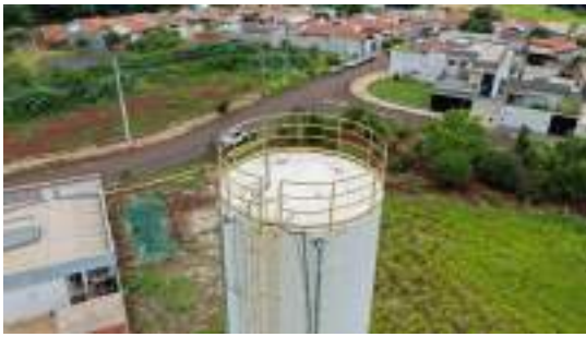
Foto 7 - Haste do para-raios no topo do reservatório.
