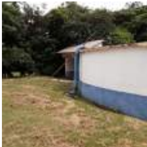
Foto 7 - Adutora do Poço Santa Luiza.
