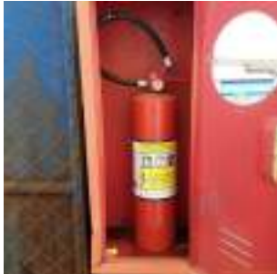
Foto 16 - Extintor instalado na parede externa da edificação.
