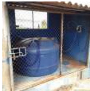
Foto 12 - Tanque e bomba dosadora de cloro.
