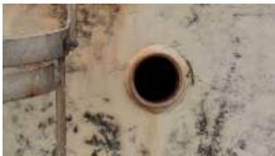
Foto 1 - Detalhe do tubo extravasor sem tela de proteção.
