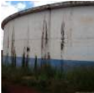
Foto 5 - Pontos de vazamento na parede do reservatório.
