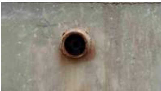
Foto 10 - Reservatório 1 - Tubo extravasor.
