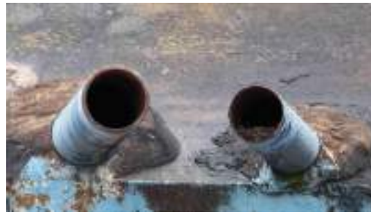
Foto 2 - Tubulações aparentemente desativadas. Caso não sejam mais utilizadas, providenciar sua remoção ou proteção das extremidades.
