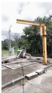
Foto 5 - Vista geral interna (estrutura de içamento e bomba).
