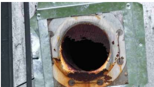
Foto 1 - Tela de proteção danificada.
