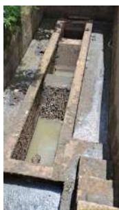
Foto 1 - Gradeamento grosseiro com grades obstruídas, dificultando a passagem do efluente.
