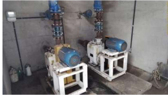
Foto 8 - Conjunto de motobombas, sendo uma unidade reserva.
