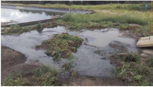
Foto 1 - Transbordamento de esgoto durante a passagem entre as lagoas, decorrente de obstrução na tubulação de interligação.
