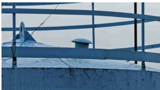
Foto 9 - Tubo de ventilação.
