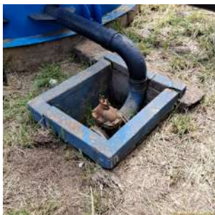
Foto 5 - Tubulação para distribuição de água.
