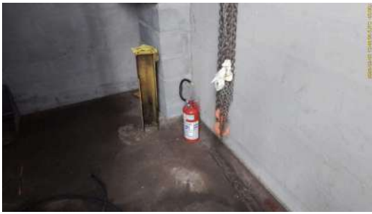
Foto 5 - Extintor de incêndio
