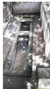
Foto 2 - Acúmulo de resíduos sólidos nas grades, comprometendo o escoamento do efluente.
