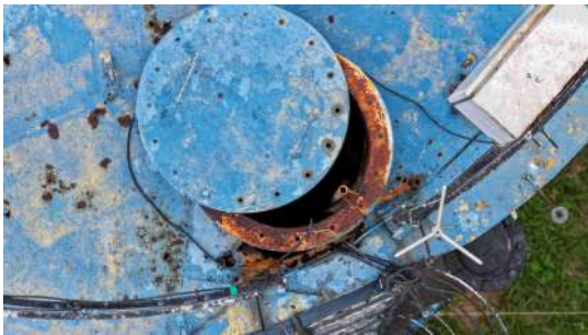
Foto 3 - Presença de aberturas no topo do reservatório, decorrentes de processo corrosivo na estrutura.
