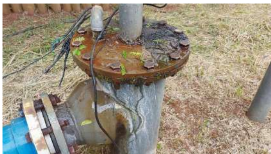
Foto 1 - Falha de vedação na conexão do niple, com ocorrência de vazamento.
