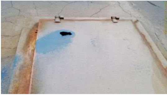
Foto 1 - Perfuração na tampa de inspeção decorrente de corrosão.
