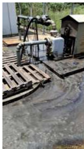
Foto 3 - Vazamento observado na moto bomba.
