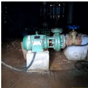
Foto 1 - Conjunto de moto bombas.
