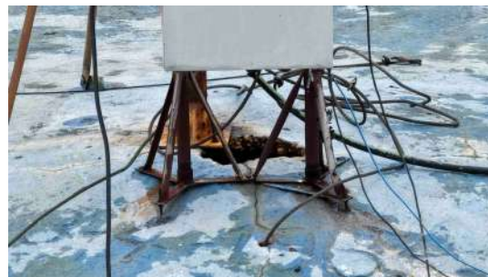
Foto 2 - Abertura decorrente de dano estrutural no reservatório.
