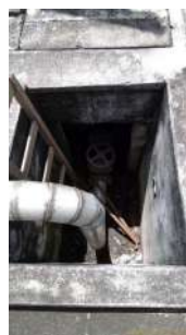
Foto 4 - Tubulação de recalque.
