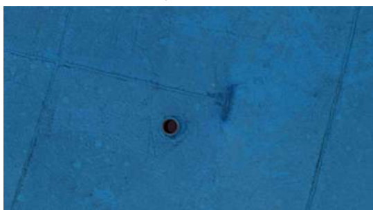
Foto 5 - Tubo de ventilação.
