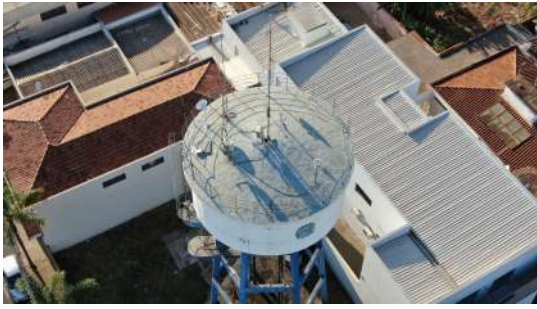
Foto 3 - Imagem do topo do reservatório (2024), evidenciando a presença de fenda já existente à época.
