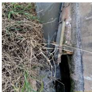
Foto 1 - Calha Parshall sem marcação e com estrutura danificada.
