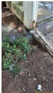
Foto 1 - Extravasamento de esgoto para a área externa da estação elevatória.
