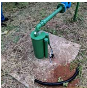
Foto 1 - Fios cortados nas proximidades do poço.
