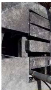
Foto 1 - Aberturas sem proteção.
