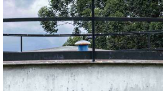
Foto 4 - Tubo de ventilação.
