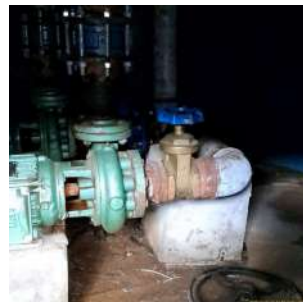
Foto 2 - Conjunto de moto bombas.
