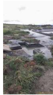
Foto 3 - Extravasamento de esgoto entre as lagoas.
