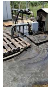
Foto 2 - Moto bomba em operação.
