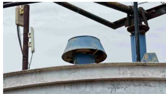
Foto 6 - Tubo de respiro com tampa de proteção.
