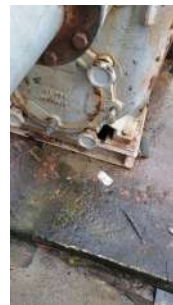
Foto 4 - Motobomba em condições regulares de vedação após manutenção (imagem cedida pelo prestador).
