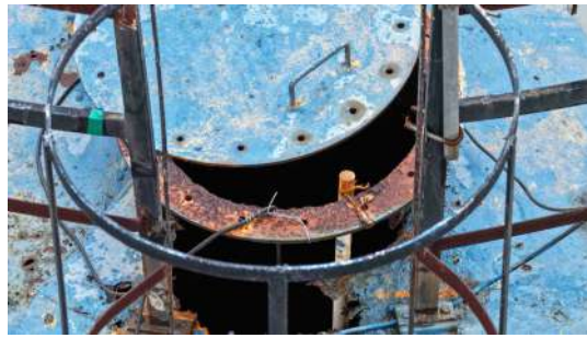
Foto 2 - Presença de aberturas no topo do reservatório, decorrentes de processo corrosivo na estrutura.
