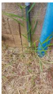
Foto 1 - Ausência de conexão entre o para-raios e o sistema de aterramento.
