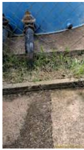
Foto 5 - Tubulação para distribuição de água.
