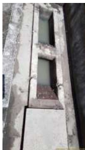
Foto 1 - Acúmulo de resíduos sólidos nas grades, comprometendo o escoamento do efluente.
