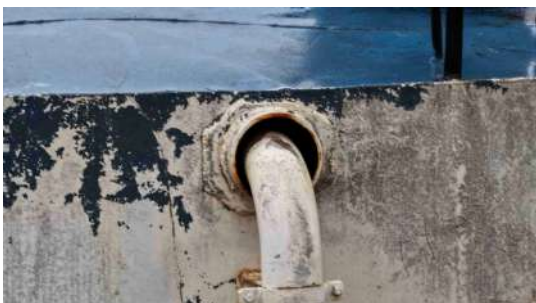
Foto 1 - Vão existente entre a tubulação e a parede do reservatório.
