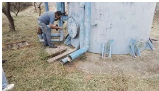
Foto 4 - Abertura do tubo extravasor.
