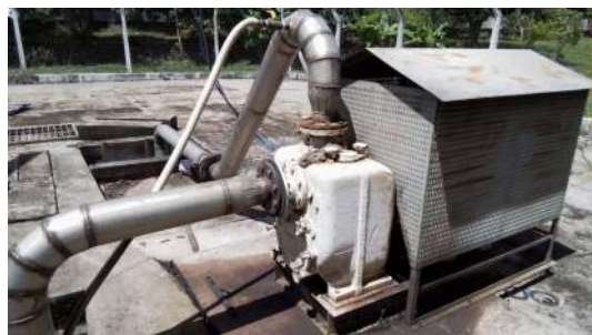
Foto 9 - Bomba de esgoto.
