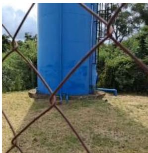
Foto 2 - Base do reservatório.
