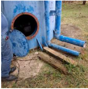
Foto 3 - Local de instalação das motobombas, situado abaixo do reservatório.
