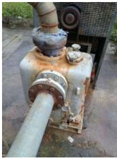
Foto 5 - Motobomba em condições regulares de vedação após manutenção (imagem cedida pelo prestador).
