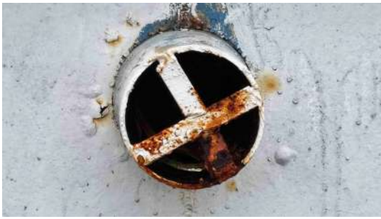
Foto 1 - Abertura do tubo extravasor sem proteção.
