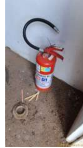
Foto 4 - Extintor de incêndio.
