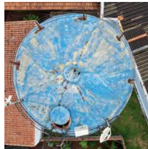
Foto 4 - Presença de aberturas no topo do reservatório, decorrentes de processo corrosivo na estrutura.
