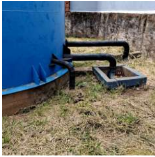
Foto 7 - Tubulação para distribuição de água.
