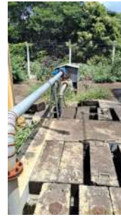
Foto 2 - Vista geral da bomba e tubulação de sucção.
