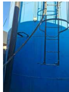
Foto 8 - Medidor de nível.
