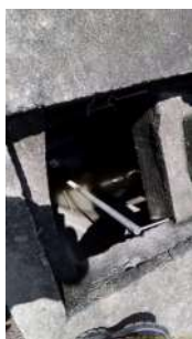
Foto 3 - Reservatório para bombeamento.
