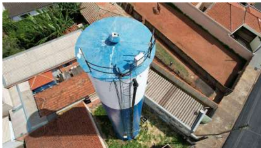
Foto 5 - Imagem fotográfica do topo do reservatório, registrada em 2023, evidenciando as mesmas inconformidades.
