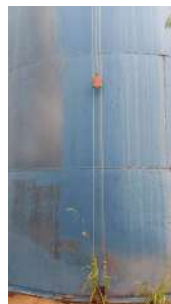
Foto 2 - Medidor de nível.
