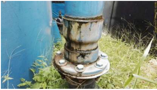
Foto 1 - Vazamento identificado entre as conexões flangeadas.
