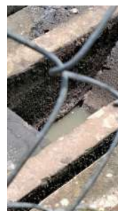
Foto 2 - Abertura lateral na estrutura adjacente ao gradeamento, permitindo a passagem do efluente.
