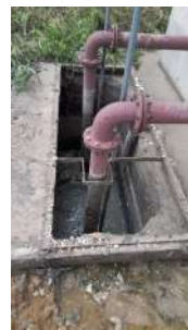
Foto 4 - Poço de recalque.
