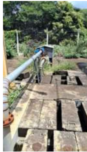
Foto 1 - Aberturas observadas na região do poço de sucção.
