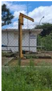
Foto 9 - Vista geral da estação elevatória de esgoto bruto.
