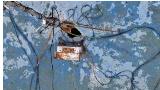
Foto 2 - Abertura decorrente de dano estrutural no reservatório.
