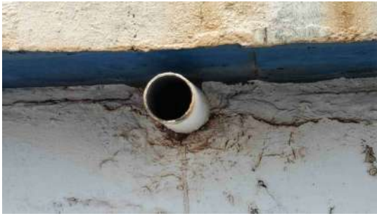
Foto 1 - Tubo extravasor sem tela de proteção.
