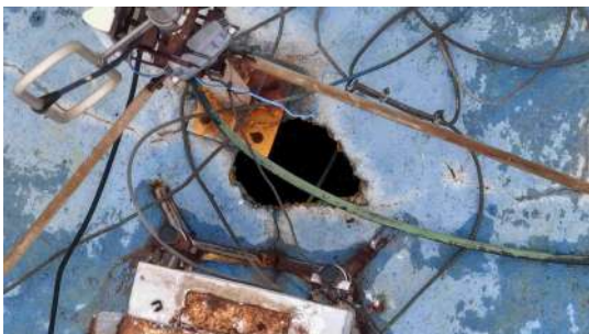
Foto 1 - Abertura decorrente de dano estrutural no reservatório.
