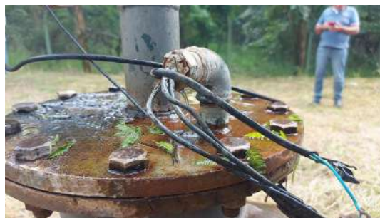
Foto 2 - Falha de vedação na conexão do niple, com ocorrência de vazamento.
