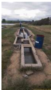
Foto 1 - Vista geral do gradeamento Grosseiro
