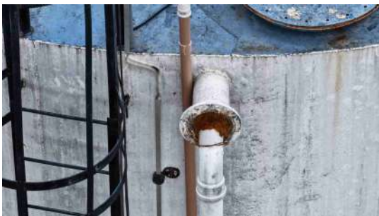
Foto 7 - Tubulação de entrada de água no reservatório.
