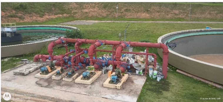
Foto 6 – Sistema de bombeamento dos decantadores.
