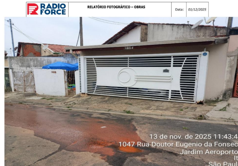
Foto 2 – Exemplo do ponto com vazamento identificado. Fonte: Relatório RadioForce (01/12/2025).
