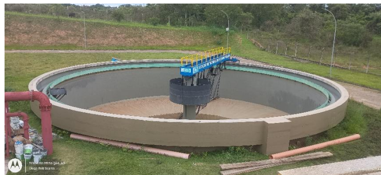
Foto 7 – Vista de um dos decantadores.
