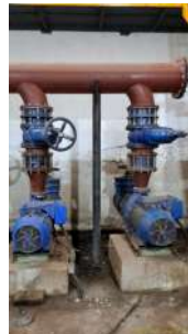
Foto 8 - Destaque para as bombas
