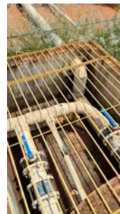
Foto 4 - Tubulação que encaminha o esgoto para os tanques
