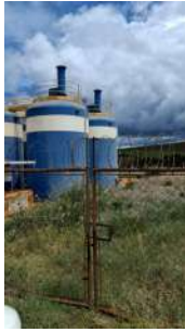
Foto 1 - Vista da Estação de Tratamento de Esgoto Compacta
