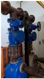
Foto 5 - Bombas da elevatória (só uma instalada)
