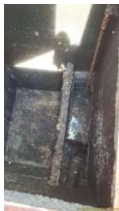
Foto 1 - Gradeamento necessitando limpeza
