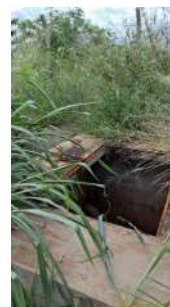
Foto 2 - Ausência de tampa no poço
