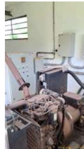
Foto 4 - Gerador e painéis elétricos
