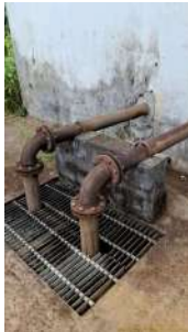
Foto 3 - Tubulação de recalque
