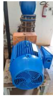
Foto 6 - Destaque para a bomba que está em funcionamento
