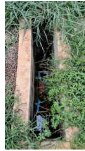
Foto 2 - Calha de saída do efluente
