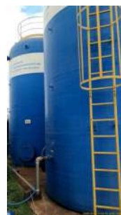
Foto 8 - Módulos de tratamento (UASB)
