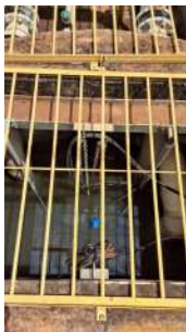
Foto 3 - Chegada do esgoto
