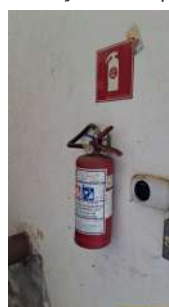
Foto 4 - Extintor de incêndio
