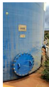
Foto 8 - Módulo de tratamento (UASB)
