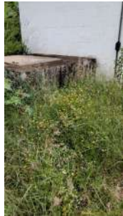
Foto 3 - Necessária a realização de roçagem no terreno
