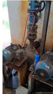
Foto 6 - Destaque para as bombas
