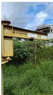
Foto 1 - Necessária a instalação de uma nova talha, a que havia no local foi furtada, impossibilitando manutenções na EEE
