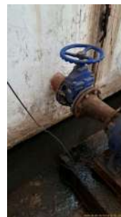
Foto 4 - Destaque para o registro e empoçamento de água devido ao vazamento
