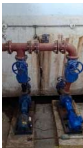
Foto 3 - Sistema de bombeamento
