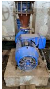
Foto 10 - Destaque para a bomba
