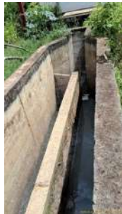
Foto 3 - Calha de entrada do esgoto bruto
