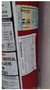
Foto 1 - Extintor de incêndio com manutenção prevista para 02/2023
