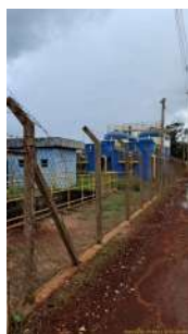
Foto 1 - Cercamento com pontos danificados
