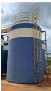
Foto 7 - Módulo de tratamento (UASB)
