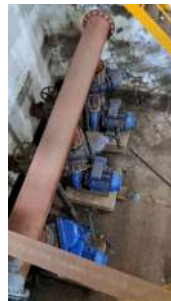
Foto 11 - Vista geral do sistema de bombeamento
