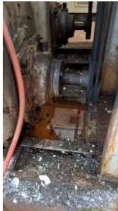
Foto 1 - Água empoçada devido a vazamento na elevatória
