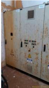
Foto 5 - Painéis elétricos da elevatória
