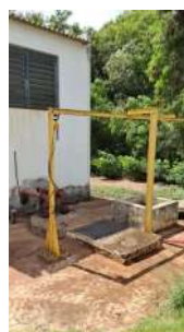
Foto 2 - Sistema de içamento para manutenções
