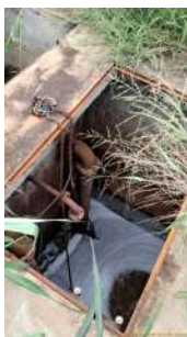
Foto 1 - Ausência de tampa no poço
