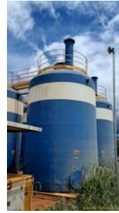
Foto 2 - Vista da Estação de Tratamento de Esgoto Compacta
