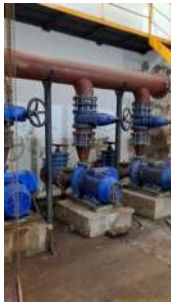
Foto 9 - Três bombas instaladas, funcionam com revezamento (exceto quando o tanque está muito cheio, nesse cenário as três são acionadas)
