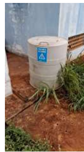
Foto 10 - Tanque de armazenamento de Policloreto de Alumínio
