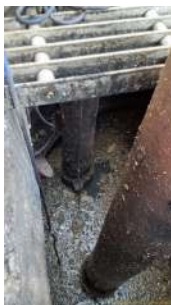
Foto 1 - Necessidade de limpeza do gradeamento
