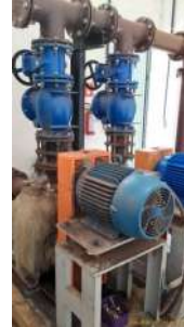
Foto 8 - Bombas da elevatória (só uma instalada)
