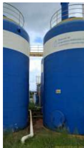
Foto 11 - Módulos de tratamento (UASB)
