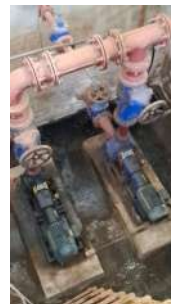
Foto 6 - Bombas da elevatória
