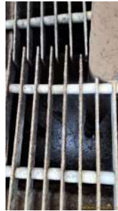
Foto 2 - Entrada do esgoto bruto
