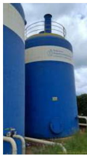
Foto 9 - Módulos de tratamento (UASB)
