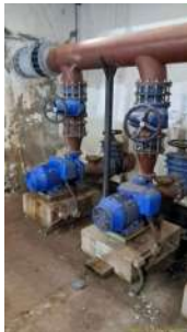
Foto 7 - Destaque para as bombas
