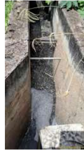
Foto 2 - Calha de entrada do esgoto bruto
