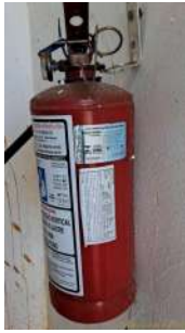
Foto 1 - Extintor de incêndio com manutenção prevista para 02/2023
