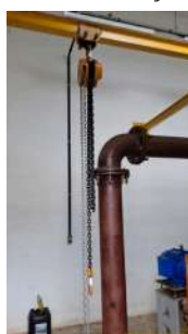
Foto 3 - Sistema de içamento para manutenções
