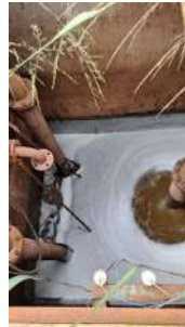
Foto 2 - Chegada do esgoto
