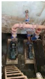
Foto 5 - Bombas da elevatória
