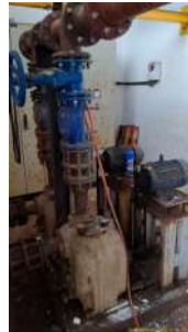
Foto 4 - Sistema de bombeamento
