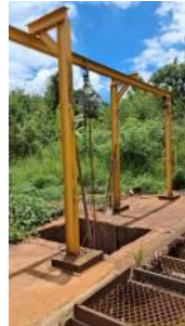
Foto 6 - Sistema de içamento para manutenção
