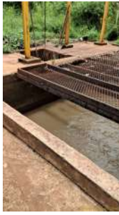
Foto 1 - Ausência de tampa no local
