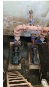
Foto 4 - Escada de acesso às bombas de madeira sem guarda-corpo
