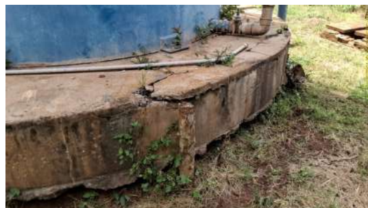
Foto 5 - Rachaduras na base de alvenaria do reservatório.
