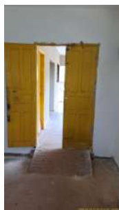
Foto 1 - Porta de acesso ao recinto onde está instalada a EEA.
