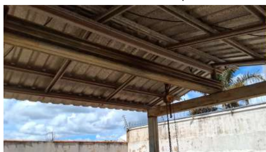
Foto 8 - Viga metálica e talha para auxílio em manutenções, montado sob o abrigo que protege o poço de sucção e bombas.
