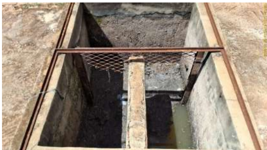
Foto 1 - Gradeamento totalmente corroído, em caixa de passagem na entrada da unidade,
