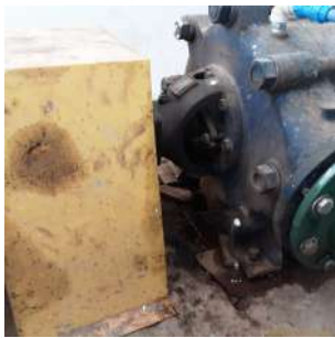
Foto 5 - Interface entre motor e bomba.
