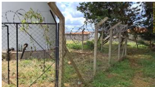
Foto 3 - Vista externa da unidade, a partir do passeio público. O prestador informou que a queda de uma árvore danificou o alambrado.
