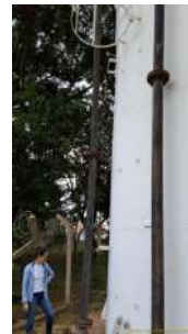
Foto 2 - O segmento inicial da escada e guarda corpo instalados no reservatório está ausente. Observa-se que os pontos originais para apoio da peça permanecem em posição.
