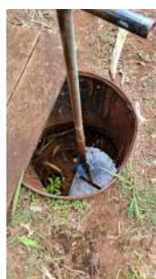
Foto 1 - Vazamento em registro localizado em caixa de passagem adjacente ao reservatório.
