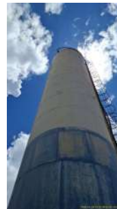
Foto 6 - Tubulação de extravasão descendo junto à escada.
