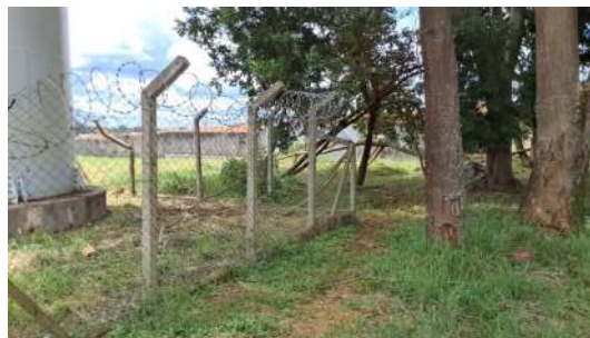
Foto 4 - Vista externa da unidade, a partir do passeio público. O prestador informou que a queda de uma árvore danificou o alambrado.
