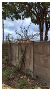
Foto 1 - Obstáculo de arame farpado instalado sobre o muro, comprometido pelo crescimento da
