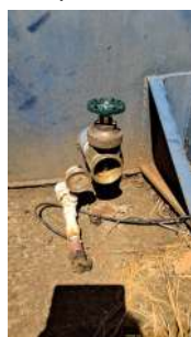
Foto 12 - Manômetro e sensor de pressão interligado à telemetria, para medição de nível do reservatório.
