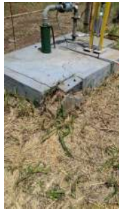
Foto 1 - Dano na extremidade e trincas na laje de proteção do poço.
