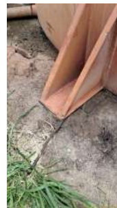
Foto 6 - Condutor para aterramento da estrutura.
