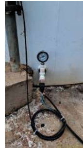
Foto 4 - Manômetro e sensor de pressão interligado ao sistema de telemetria, para medição de nível do reservatório.
