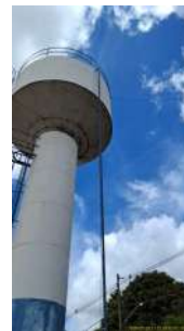
Foto 3 - Tubo extravasador do reservatório.
