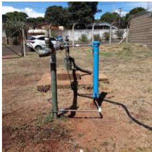
Foto 7 - Dispositivo para cloração e fluoretação da água, utilizando reagentes sólidos.
