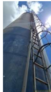
Foto 4 - Tubulação de extravasão descendo junto à escada.
