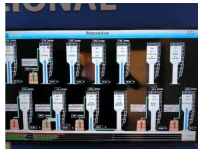
Foto 11 - Painel no CCO exibindo nível dos reservatórios.
