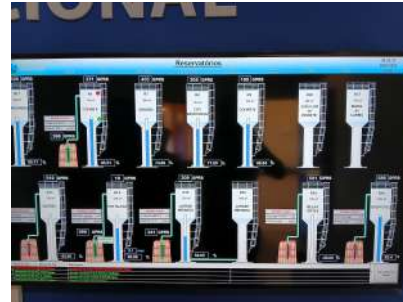
Foto 8 - Painel no CCO exibindo nível dos reservatórios.
