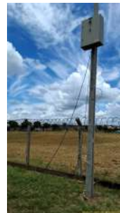
Foto 8 - Poste de alvenaria com abrigo para equipamentos de telemetria. Cercamento com alambrado e concertina no perímetro da área.
