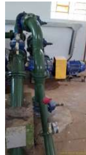
Foto 2 - Detalhe mostrando a tubulação de recalque da EEA, com interligação à linha de recalque da EEA Recalque Contendas 2 (vulgo "recalque 6"), instalada ao lado.
