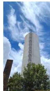
Foto 2 - Não há guarda corpo no topo do reservatório, próximo à saída da escada.
