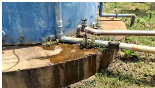
Foto 2 - Base de alvenaria molhada em razão do vazamento.
