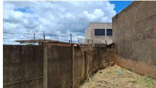
Foto 5 - Obstáculo de arame farpado instalado sobre o muro colapsado. Pedacos de madeira e tela instalados servem como barreira.
