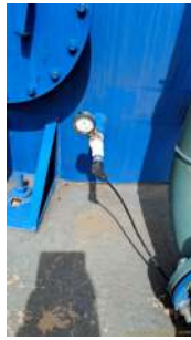
Foto 3 - Manômetro (quebrado) e sensor de pressão interligado à telemetria, para medição de nível do reservatório.
