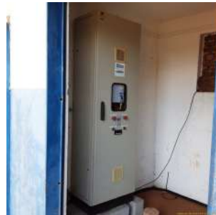
Foto 8 - Painel elétrico instalado no interior de edificação ao lado do poço.
