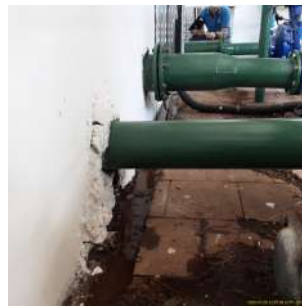
Foto 6 - Linhas de alimentação das três EEAs existentes no local.
