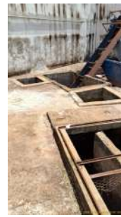
Foto 4 - Caixas de passagem na entrada da EEE sem tampa ou outro tipo de proteção, havendo risco de acidente. Providenciar fechamento adequado.
