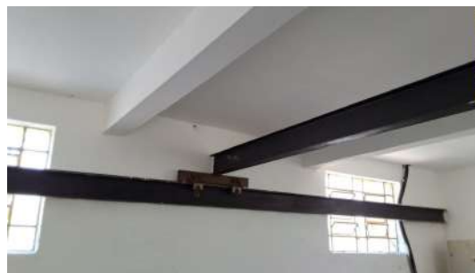
Foto 14 - Ponte rolante instalada na edificação para auxílio em procedimentos de manutenção dos equipamentos.
