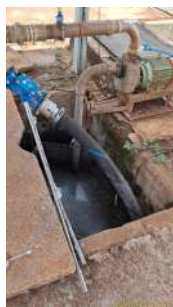
Foto 1 - Poço de sucção sem tampa (a tampa de concreto armado está colocada ao lado do poço, como evidenciado na foto seguinte), havendo risco de acidente.
