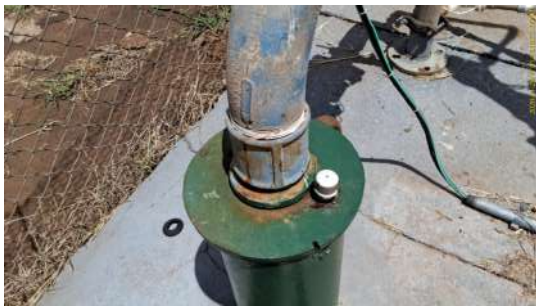
Foto 7 - Tubo de medição de nível.
