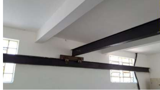
Foto 6 - Ponte rolante instalada na edificação para auxílio em procedimentos de manutenção dos equipamentos.
