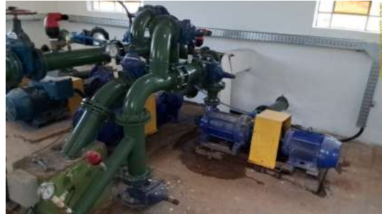
Foto 9 - Vista ampliada do conjunto motobomba
