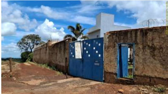
Foto 5 - Há um segmento do portão de acesso a veículos sem fechamento. Segundo informação do prestador, o dano foi causado pelo vento. Observa-se também que a concertina sobre o muro colapsou, não atendendo à função de proteção que se destina.
