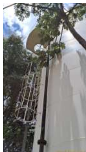
Foto 3 - Árvore adjacente ao reservatório já interfere com a estrutura.
