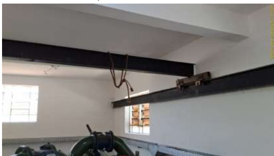
Foto 13 - Ponte rolante instalada na edificação para auxílio em procedimentos de manutenção dos equipamentos.
