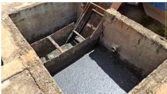
Foto 3 - Caixa de passagem na entrada da unidade, não há gradeamento. A esteira para remoção de sólidos que se acumulam na câmara delimitada pelos anteparos verticais permaneceu desligada durante a fiscalização.
