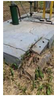
Foto 2 - Dano na extremidade e trincas na laje de proteção do poço.
