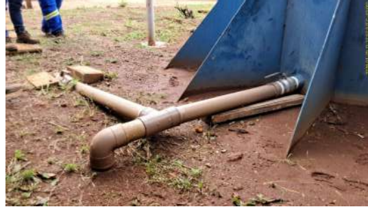
Foto 9 - Tubulação de saída do reservatório.
