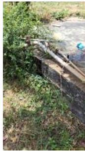
Foto 1 - Vazamento em tubulação que sai do reservatório.
