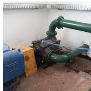
Foto 4 - Vista da bomba e linhas de alimentação e recalque.
