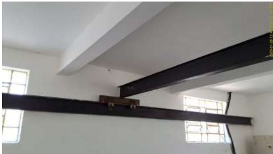
Foto 12 - Ponte rolante instalada na edificação para auxílio em atividades de manutenção dos equipamentos.
