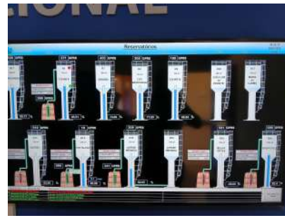
Foto 6 - Painel no CCO exibindo nível dos reservatórios.
