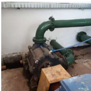
Foto 3 - Vista da bomba e linhas de alimentação e recalque.
