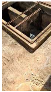
Foto 3 - Caixa de passagem adjacente ao poço de sucção sem tampa ou outro tipo de proteção, havendo risco de acidente. Providenciar fechamento adequado.
