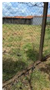
Foto 3 - Rompimento na tela do alambrado.
