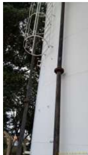
Foto 1 - O segmento inicial da escada e guarda corpo instalados no reservatório está ausente. Observa-se que os pontos originais para apoio da peça permanecem em posição.
