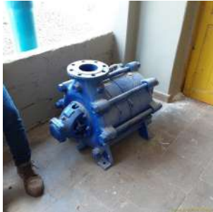
Foto 1 - Bomba avulsa, existente no local. O prestador informou que, em caso de necessidade, há motor reserva na unidade Distrito Industrial.
