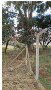
Foto 1 - Mourão de concreto quebrado e alambrado parcialmente colapsado, apoiado com pedaços de madeira.
