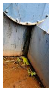
Foto 2 - Vazamento próximo à tampa de acesso para manutenção, na parte inferior do reservatório.
