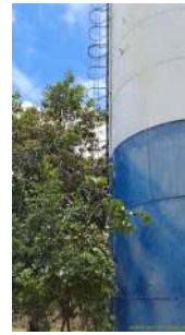
Foto 3 - Vegetação em interferência com a estrutura do reservatório.
