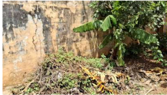
Foto 2 - Material oriundo de poda / corte de vegetação, depositado ao lado do reservatório.
