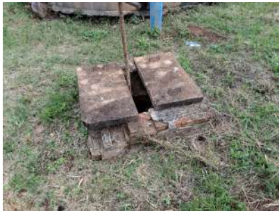
Foto 6 - Caixa de passagem com integridade comprometida.
