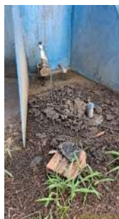
Foto 3 - Acúmulo de resíduos próximo à base do reservatório 2.
