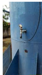
Foto 5 - Sensor de pressão para medição de nível, integrado em sistema de telemetria.
