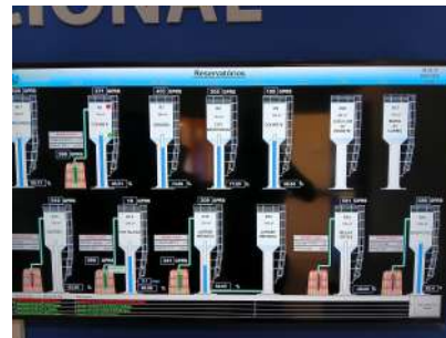
Foto 9 - Painel no CCO exibindo nível dos reservatórios.
