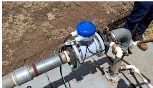
Foto 8 - Macromedidor instalado na captação. Ao lado dele há uma torneira para coleta de água bruta.
