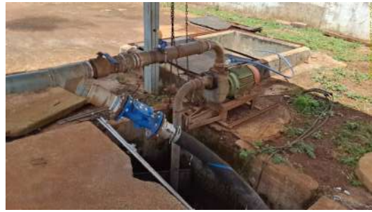
Foto 10 - Conjuntos motobomba instalados na unidade. Há uma bomba submersa e uma localizada no nível do solo, acima do poço de sucção.
