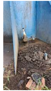
Foto 6 - Sensor do medidor de nível instalado, integrado com sistema de telemetria.
