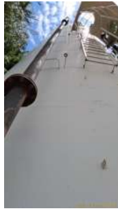
Foto 1 - Descida do SPDA com ausência do condutor.
