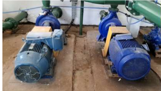
Foto 2 - Conjuntos motobomba instalados em paralelo, na EEA.
