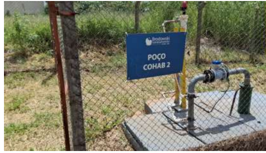
Foto 4 - Placa de identificação afixada no cercamento da unidade.
