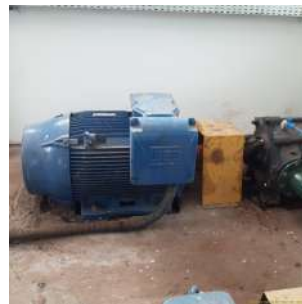
Foto 2 - Conjunto moto bomba da EEA "recalque 8".
