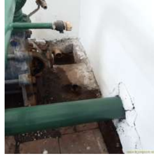
Foto 2 - Vazamento na parte posterior da bomba. O piso está molhado em razão desse vazamento.
