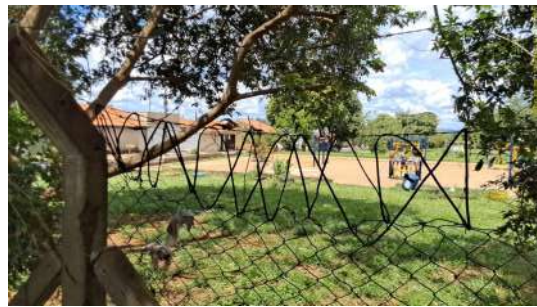
Foto 2 - Reparo improvisado no cercamento.
