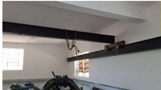
Foto 11 - Ponte rolante instalada na edificação para auxílio em atividades de manutenção dos equipamentos.
