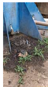
Foto 2 - Acúmulo de resíduos próximo à base do reservatório 2.
