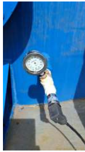
Foto 1 - Manômetro para leitura de nível no reservatório danificado (ponteiro está solto, fora da posição correta).
