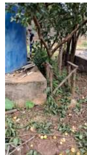
Foto 2 - Vegetação cresce adjacente ao reservatório, e interfere com a estrutura.
