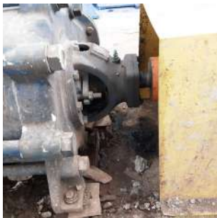
Foto 7 - Interface entre motor e bomba.
