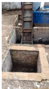
Foto 2 - Caixa de passagem por onde o efluente chega na unidade.
