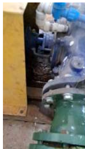
Foto 3 - Drenagem da água de lubrificação de gaixeta.
