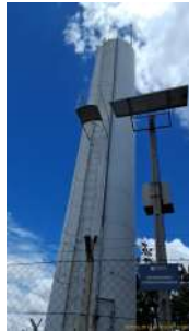
Foto 3 - Vista geral do reservatório, evidenciando escada e guarda corpo instalados na estrutura.
