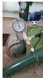
Foto 6 - Manômetro instalado na linha de recalque da EEA.
