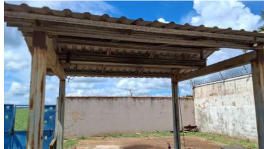
Foto 6 - Estrutura metálica com cobertura sobre o poço de sucção apresenta corrosão em estado avançado. É necessário realizar o tratamento da corrosão e a pintura para proteção das peças.
