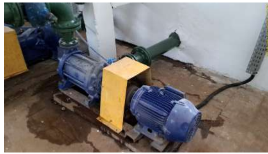
Foto 8 - Conjunto motobomba da EEA
