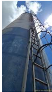
Foto 1 - Ausência de condutor nos suportes e ilhoses do SPDA.
