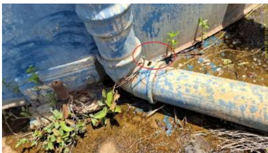
Foto 1 - Vazamento na conexão de 90° em tubulação adjacente ao reservatório.
