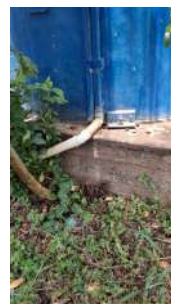
Foto 4 - Tubo extravasor do reservatório.
