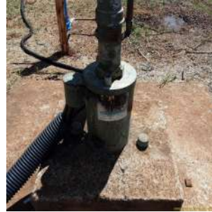
Foto 4 - Tubo para medição de nível do poço.
