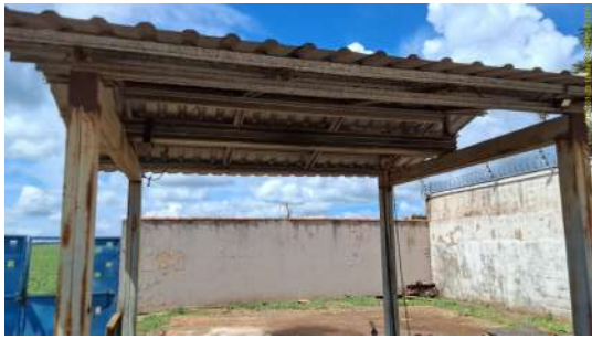
Foto 9 - Abrigo sobre o poço de sucção e conjuntos motobomba.
