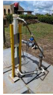
Foto 2 - Dispositivo para cloração e fluoretação da água com o uso de reagentes sólidos.
