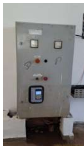
Foto 5 - Painel elétrico da EEA
