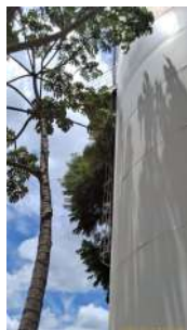
Foto 1 - Árvore adjacente ao reservatório já interfere com a estrutura.
