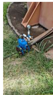
Foto 4 - Medidor de nível utilizando telemetria, instalado no reservatório.
