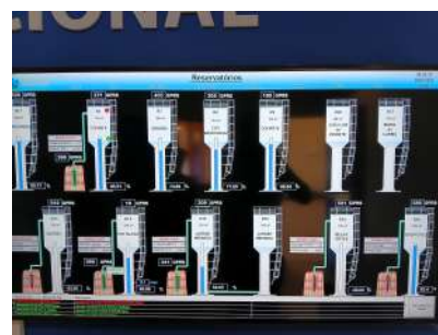
Foto 7 - Painel no CCO exibindo nível dos reservatórios.
