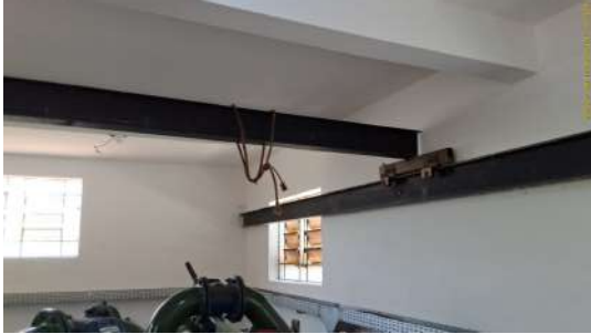
Foto 5 - Ponte rolante instalada na edificação para auxílio em procedimentos de manutenção dos equipamentos.
