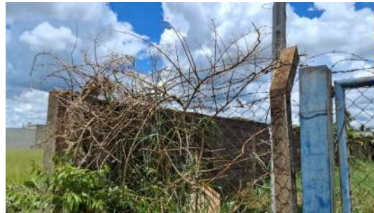
Foto 4 - Vegetação crescendo sobre o alambrado.
