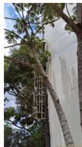
Foto 2 - Árvore adjacente ao reservatório já interfere com a estrutura.
