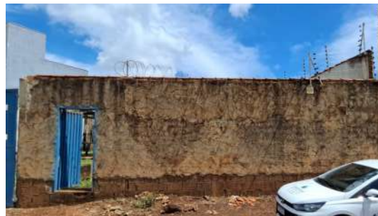
Foto 7 - A concertina sobre o muro colapsou, não atendendo à função de proteção que se destina.
