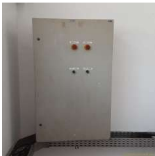
Foto 9 - Painel de comando da EEA
