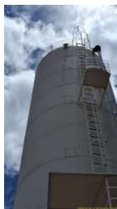
Foto 3 - Tubo extravasador do reservatório, à esquerda da escada.
