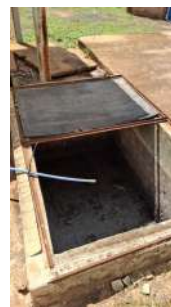
Foto 2 - Caixa de passagem adjacente ao poço de sucção com tampa em condição precária, havendo risco de acidente. Providenciar fechamento adequado.
