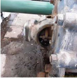
Foto 1 - Vazamento na parte posterior da bomba.
