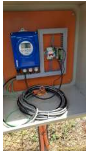
Foto 3 - Painel de telemetria com os dados do macromedidor da captação.
