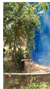
Foto 2 - Vegetação em interferência com a estrutura do reservatório.
