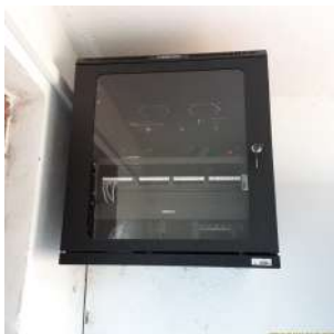
Foto 9 - Equipamentos para transmissão de sinal de telemetria.
