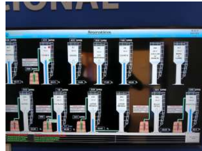
Foto 11 - Painel no CCO exibindo nível dos reservatórios.
