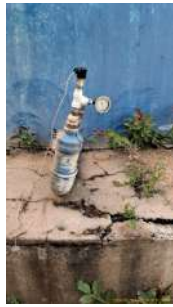
Foto 7 - Manômetro e sensor de pressão interligado à telemetria para medição de nível do reservatório.
