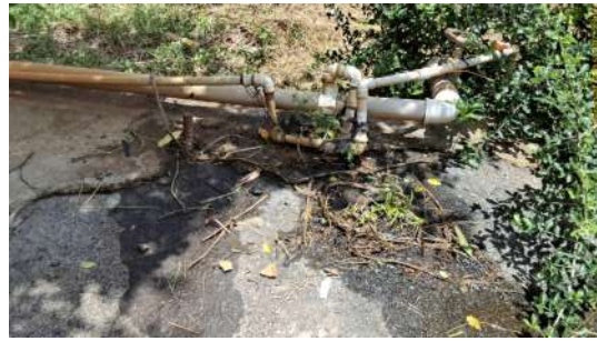
Foto 2 - Vazamento em tubulação que sai do reservatório.
