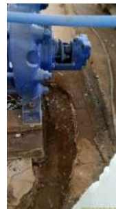
Foto 4 - Canaleta cortada no piso para escoamento da água de lubrificação de gaixeta.
