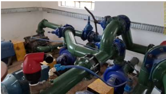
Foto 7 - Detalhe mostrando tubulações de recalque, interligadas, das três EEAs instaladas no local.
