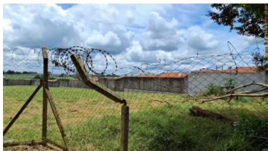
Foto 4 - Mourão de concreto quebrado.
