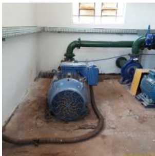
Foto 1 - Conjunto moto bomba da EEA "recalque 8".
