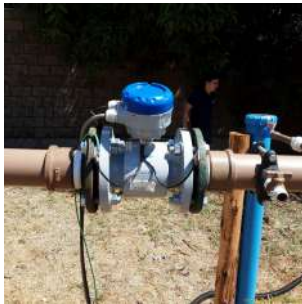
Foto 5 - Macromedidor instalado na captação.
