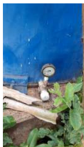
Foto 3 - Medidor de nível tipo manômetro instalado no reservatório.
