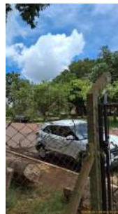
Foto 2 - Alambrado e concertina parcialmente colapsados, ao lado do portão da unidade.
