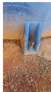
Foto 4 - Cabo de aterramento da estrutura.
