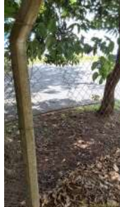
Foto 1 - Rompimento na tela do alambrado.
