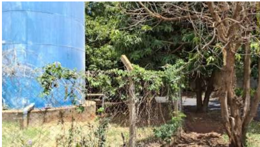
Foto 3 - Vegetação crescendo sobre o alambrado. O obstáculo de arame farpado na parte superior da cerca já colapsou.
