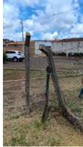
Foto 1 - Dano no cercamento da área.
