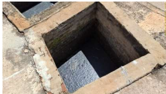
Foto 2 - Caixa de passagem na entrada da unidade, não há gradeamento.
