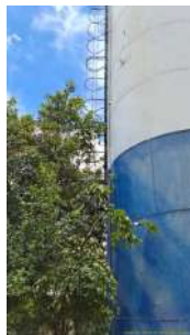
Foto 1 - Vegetação em contato com o reservatório dificulta o acesso através da escada.
