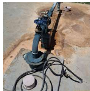
Foto 2 - Tubo de nível do poço sem tampa de proteção.
