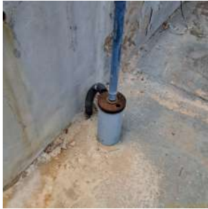
Foto 1 - Tubo de nível presente, porém localizado no interior da estrutura.
