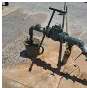
Foto 3 - Tubo de nível e laje de proteção.
