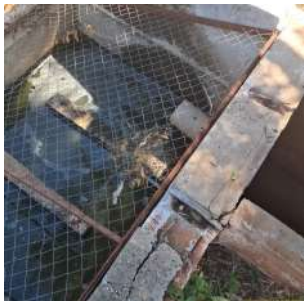
Foto 11 - Ponto de entrada do esgoto tratado no tanque de contato, onde é realizada a dosagem de hipoclorito de sódio.
