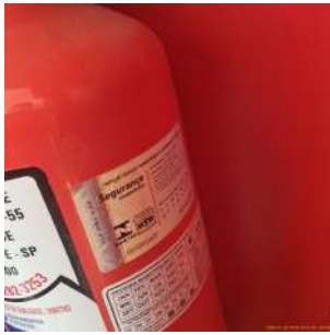
Foto 12 - Extintor de incêndio.
