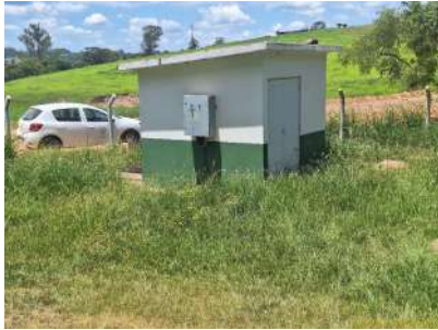
Foto 1 - Vista geral do abrigo no qual se encontra o poço de sucção.
