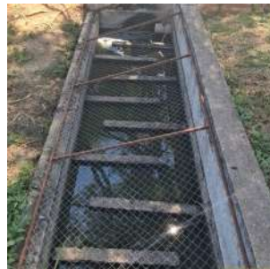
Foto 12 - Tanque de contato.
