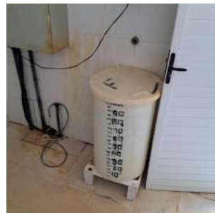
Foto 8 - Tanque de armazenamento de produto químico e bombas dosadoras.
