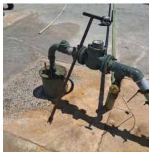
Foto 2 - Tubo de nível sem tampa de proteção.
