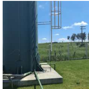
Foto 4 - Tubulação de distribuição de água.
