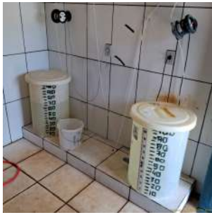
Foto 1 - Tanques de armazenamento de produtos químicos sem diques de contenção ou estruturas de proteção e sem identificação.
