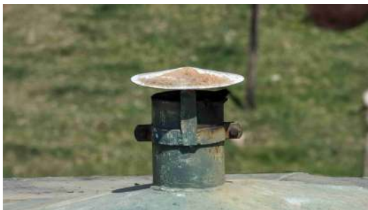
Foto 8 - Tubo de ventilação.
