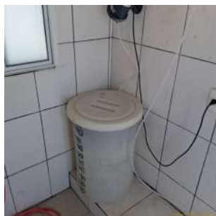
Foto 1 - Tanque de armazenamento de produto químico sem dique de contenção ou estrutura de proteção e sem identificação.
