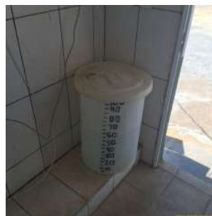
Foto 9 - Tanque de armazenamento de produto químico.
