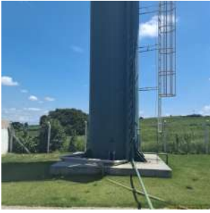
Foto 1 - Base do reservatório.
