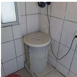
Foto 8 - Tanque de armazenamento de produto químico.
