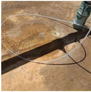
Foto 1 - Acúmulo de água sob o poço, indicando vazamento.
