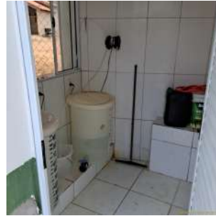
Foto 2 - Tanques de armazenamento de produtos químicos sem diques de contenção ou estruturas de proteção e sem identificação.
