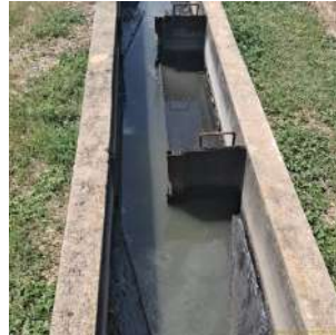
Foto 6 - Tanque de areia.
