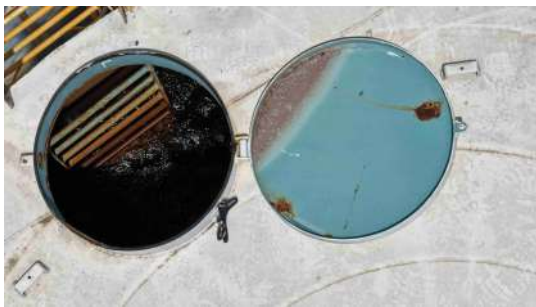
Foto 1 - Tampa de inspeção aberta durante a fiscalização.
