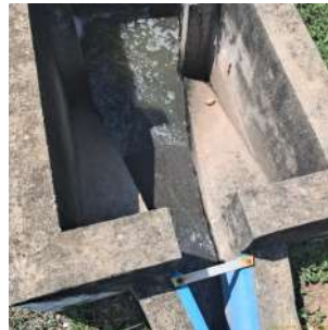
Foto 8 - Canal de passagem do esgoto bruto, após o gradeamento, em direção às lagoas.
