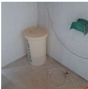
Foto 5 - Tanque de armazenamento de produto químico.
