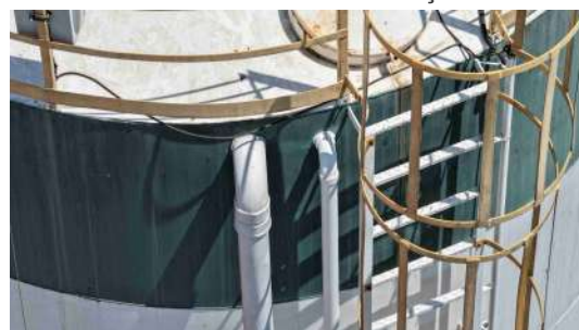
Foto 9 - Tubulação de entrada de água no reservatório.
