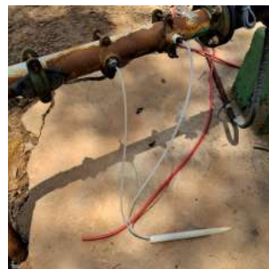
Foto 2 - Tubulação apresentando alto grau de corrosão.
