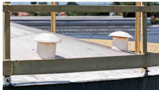
Foto 8 - Tubos de ventilação.
