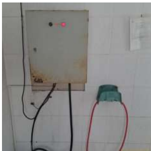
Foto 10 - Pannel elétrico para funcionamento do poço.
