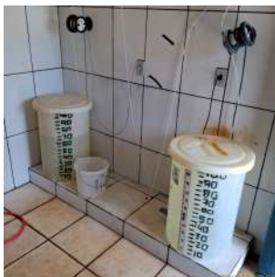
Foto 7 - Tanques de armazenamento de produto químico e bombas dosadoras.
