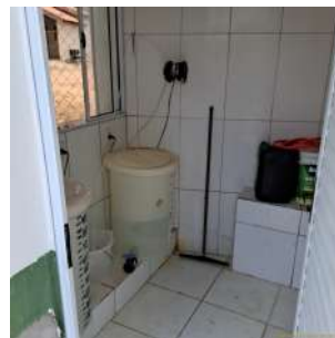
Foto 10 - Abrigo dos tanques e das bombas dosadoras de produtos químicos.
