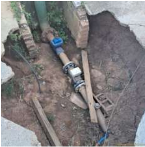
Foto 1 - Vala aberta na entrada do reservatório, sem a devida sinalização.
