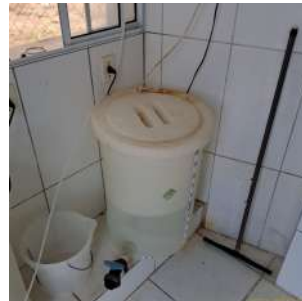
Foto 8 - Tanque de armazenamento de produto químico.
