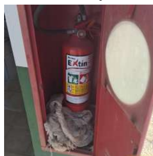
Foto 7 - Extintor de incêndio.
