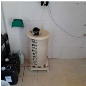
Foto 7 - Tanque de armazenamento de produto químico e bombas dosadoras.
