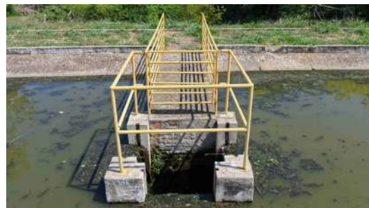
Foto 22 - Estrutura de saída da lagoa facultativa com caixa de passagem e vertedouro, dotada de passarela e guarda-corpo metálico para acesso operacional e controle do nível do efluente.
