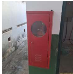
Foto 11 - Extintor de incêndio.
