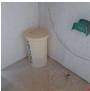
Foto 1 - Tanque de armazenamento de produto químico sem dique de contenção ou estrutura de proteção e sem identificação.
