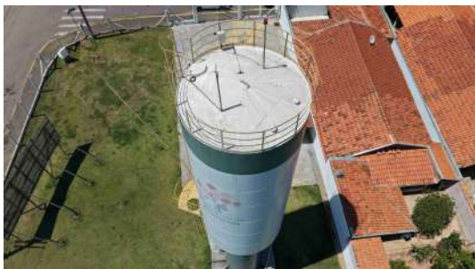
Foto 7 - Para-raios, tampa de inspeção e guarda-corpo na parte superior do reservatório.
