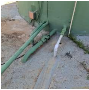
Foto 3 - Tubulação de distribuição de água.
