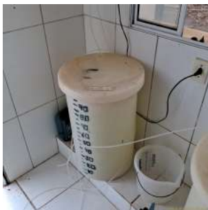
Foto 9 - Tanque de armazenamento de produto químico.
