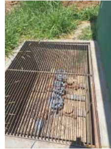
Foto 2 - Linha de recalque do esgoto.
