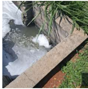
Foto 4 - Entrada de esgoto bruto.
