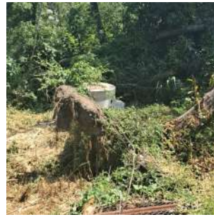
Foto 14 - Ponto de inspeção do emissário final, responsável pelo lançamento do efluente tratado.
