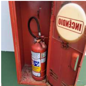
Foto 7 - Extintor de incêndio.
