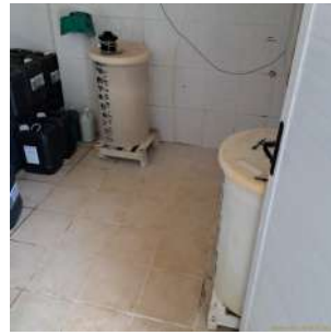
Foto 10 - Tanques de armazenamento de produto químico.
