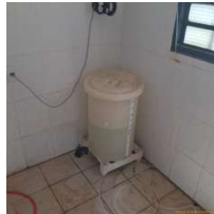
Foto 7 - Tanque de armazenamento de produto químico.
