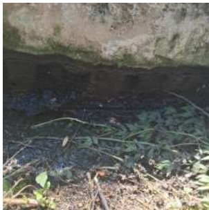
Foto 1 - Vazamento de esgoto no tanque de contato.
