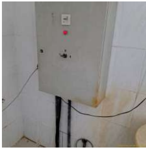
Foto 9 - Painel elétrico do controle da bomba.
