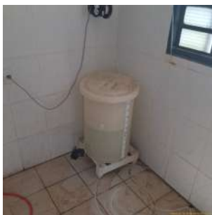
Foto 1 - Tanques de armazenamento de produtos químicos sem diques de contenção ou estruturas de proteção e sem identificação.
