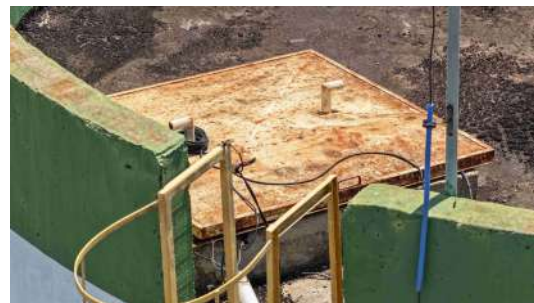
Foto 12 - Tubo de ventilação.
