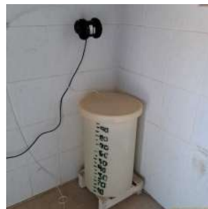
Foto 6 - Tanque de armazenamento de produto químico.
