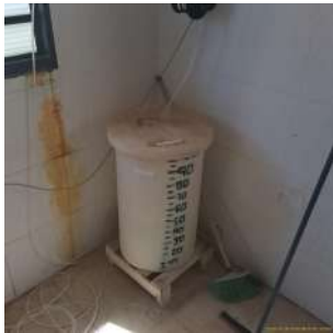
Foto 8 - Tanque de armazenamento de produto químico.
