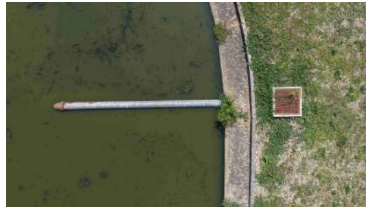
Foto 20 - Ponto de entrada do esgoto.
