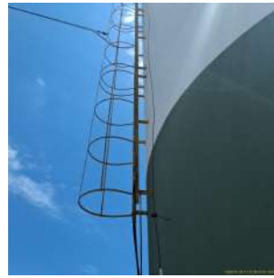
Foto 4 - Fiação do pra-raios e escada de acesso.
