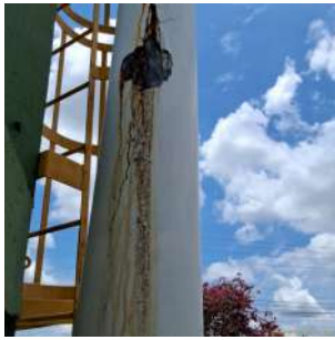
Foto 1 - Vazamento constatado na tubulação de distribuição de água.
