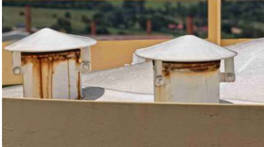
Foto 7 - Tubulação de ventilação.
