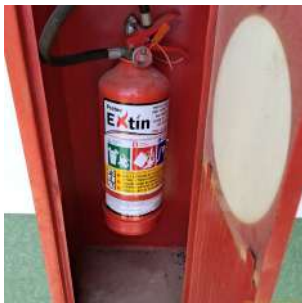
Foto 5 - Extintor de incêndio,
