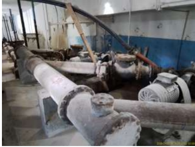
Foto 1 - Bombas centrífugas e tubulação de bomba submersa
