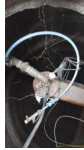
Foto 4 - Parte interna do poço com a elevatória
