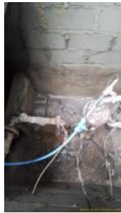
Foto 1 - Tubulações e fiação da EEAT
