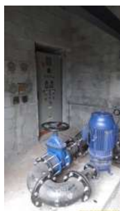
Foto 1 - Bomba do booster
