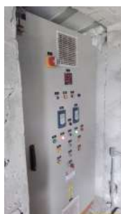
Foto 3 - painel elétrico do booster
