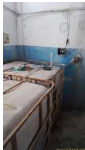
Foto 17 - Tanque de armazenamento e dosador de fluor
