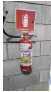
Foto 6 - Extintor de incêndio disponível
