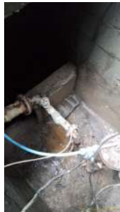
Foto 3 - Tubulações e fiação da EEAT
