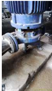
Foto 1 - Vazamento na bomba 2
