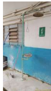
Foto 18 - Chuveiro de emergência
