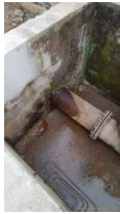
Foto 1 - Vazamento entrada de água do reservatório
