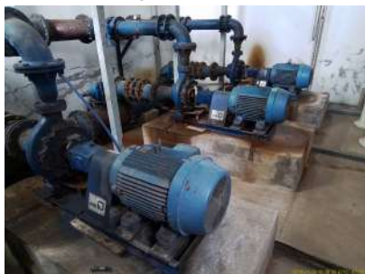
Foto 3 - Vista lateral dos equipamentos
