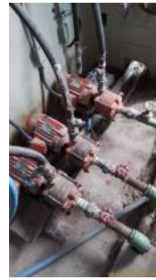
Foto 20 - Bombas da ETA Central
