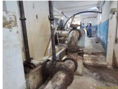
Foto 3 - Conjunto de tubulações de recalque
