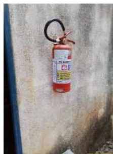
Foto 4 - Extintor de incêndio
