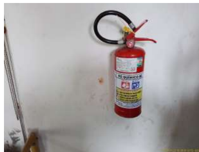
Foto 2 - Extintor de incêndio
