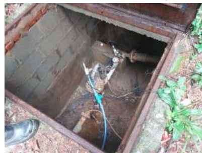
Foto 8 - Vista geral interna da EEAT
