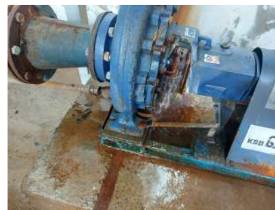
Foto 2 - Vazamento excessivo de água de lubrificação das gaxetas
