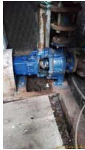
Foto 1 - Drenagem inadequada da água de lubrificação das gaxetas
