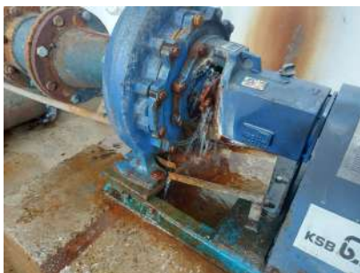
Foto 1 - Vazamento excessivo de água de lubrificação das gaxetas
