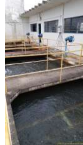
Foto 12 - Filtros (quatro de cada um dos lados do prédio administrativo da ETA)
