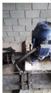
Foto 4 - Destaque para a bomba
