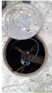
Foto 5 - Poço com a elevatória
