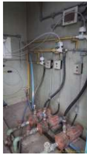
Foto 19 - Dosador de cloro
