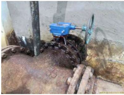
Foto 1 - Vazamento grande na válvula
