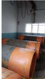
Foto 21 - Talhas para manutenção
