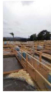
Foto 10 - Tanques de floculação
