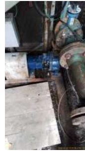
Foto 2 - Drenagem inadequada da água de lubrificação das gaxetas
