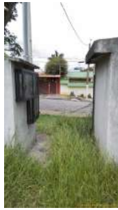
Foto 1 - Cerca de delimitação do local danificada
