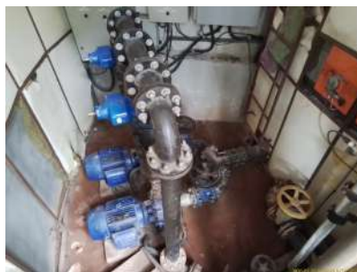
Foto 2 - Vista geral interna da EEAT
