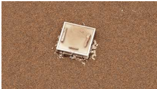
Foto 3 - Tampa com as laterais quebradas
