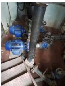
Foto 1 - Necessária a limpeza geral da casa de bombas (muita terra)
