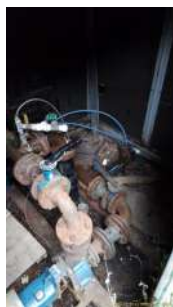
Foto 1 - Tubulações do booster
