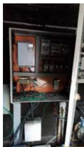
Foto 3 - Painel elétrico do booster
