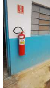
Foto 22 - Extintor de incêndio disponível
