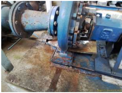
Foto 5 - Vazamento normal da água de lubrificação das gaxetas da bomba 2
