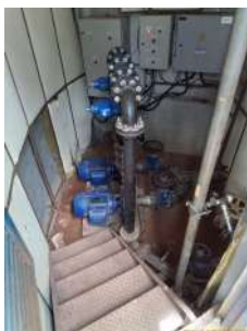
Foto 1 - Vista geral interna da EEAT
