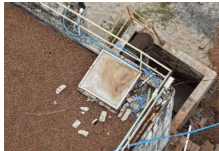
Foto 2 - Tampa com as laterais quebradas e material elétrico exposto
