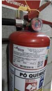
Foto 7 - Destaque para a etiqueta do extintor
