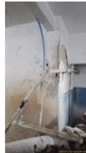
Foto 24 - Mangueira de aplicação do cloro
