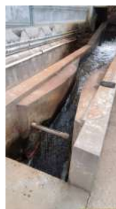
Foto 6 - Calha entrada com aplicação de sulfato de alumínio
