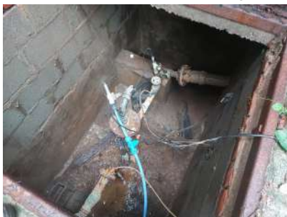
Foto 7 - Vista geral interna da EEAT
