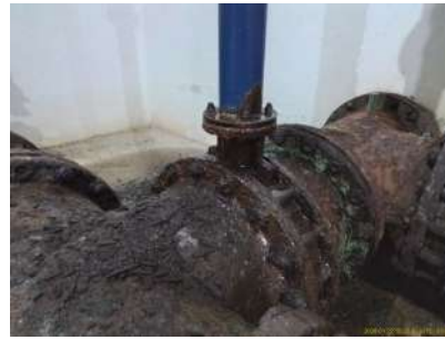
Foto 2 - Vazamento na flange das tubulações
