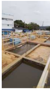
Foto 9 - Tanques de floculação
