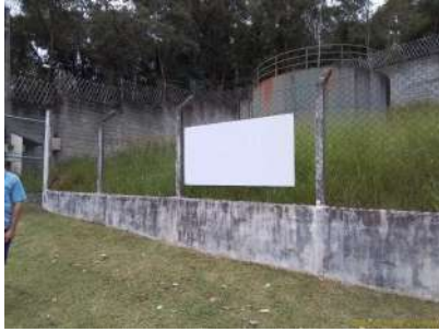
Foto 1 - Placa gasta, não identifica a área
