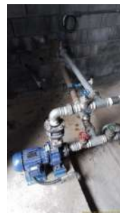
Foto 4 - Bombas do booster
