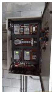
Foto 3 - Destaque para a parte interna do painel elétrico
