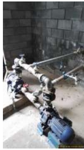
Foto 5 - Bombas do booster
