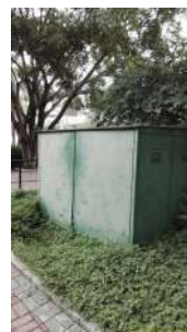
Foto 4 - Vista externa do booster
