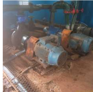
Foto 10 - EEAT ao lado, com calhas na drenagem da gaxeta. A Sanor informou que adotará a mesma solução para a EEAB.
