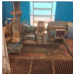
Foto 2 - Ausência da tampa da caixa de ligação elétrica do motor
