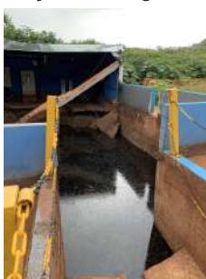
Foto 8 - Condição da antiga EEE colapsada.
