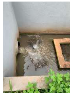
Foto 2 - Canal da chegada 2 do esgoto bruto.
