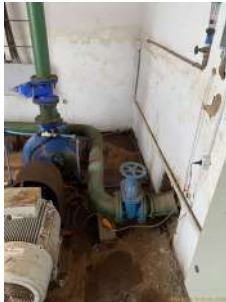
Foto 6 - Saída da mangueira de drenagem em nível superior ao da EEAT.
