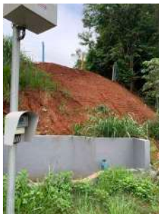
Foto 1 - Barranco do apontamento refeito.
