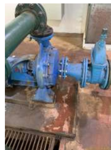
Foto 2 - Água no entorno da bomba.
