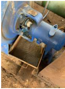
Foto 3 - Drenagem da água de lubrificação da gaxeta.
