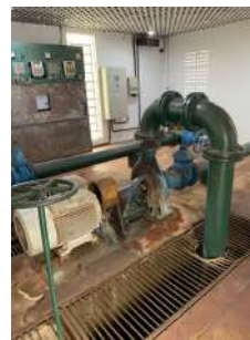
Foto 2 - Vazamento na bomba 1.
