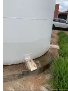
Foto 2 - Vazamentos na base do reservatório.
