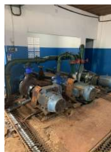
Foto 2 - Vista interna da EEAT.
