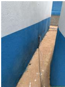
Foto 8 - Vista externa da mangueira de drenagem em nível superior ao da EEAT.
