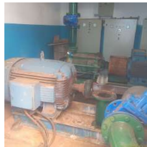
Foto 4 - Vista interna da casa de bombas.
