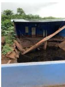
Foto 6 - Condição da antiga EEE colapsada.
