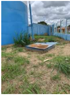
Foto 1 - Tampa de proteção.
