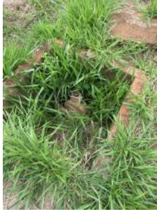
Foto 1 - Caixa de válvula sem proteção contra queda.
