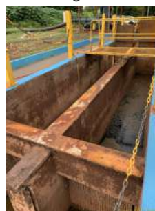
Foto 7 - Condição da antiga EEE colapsada.
