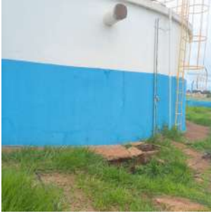
Foto 1 - Local da caixa de válvula aberta e sem tampa contra queda.
