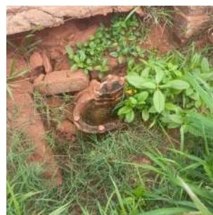
Foto 2 - Vazamento no registro.
