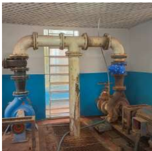
Foto 1 - Ausência de motor reserva.
