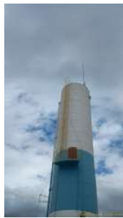
Foto 1 - Topo do reservatório sem guarda-corpo.
