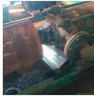
Foto 8 - Calha para a drenagem da água de lubrificação.
