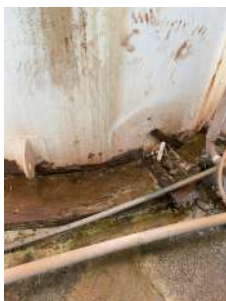
Foto 1 - Diversos pontos com oxidação e corrosão.
