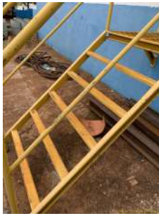
Foto 1 - Degraus da escada de acesso sem profundidade mínima.
