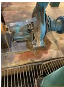
Foto 1 - Água no entorno da bomba.
