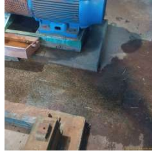
Foto 10 - Piso molhado pela falta de drenagem adequada.
