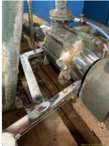
Foto 7 - Vazamento da bomba oposta à porta corrigido.
