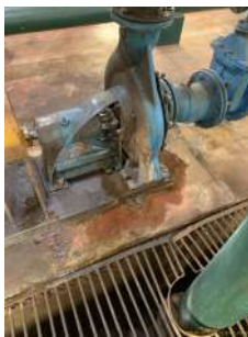
Foto 1 - Vazamento na bomba 1.
