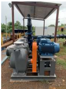
Foto 1 - Dois conjuntos moto bombas adquiridos pela prestadora.
