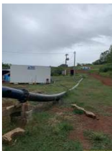
Foto 3 - Tubulação de recalque do efluente até a ETE.
