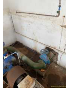
Foto 5 - Saída da mangueira de drenagem em nível superior ao da EEAT.
