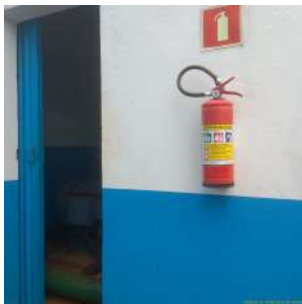
Foto 3 - Extintor do local.
