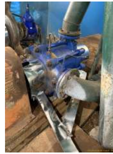
Foto 6 - Sistema de drenagem da bomba central.
