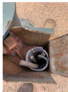
Foto 2 - Cabos elétricos cortados.
