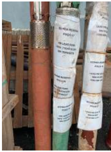
Foto 1 - Bomba reserva para os poços 06, 17 e 18.
