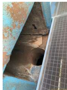
Foto 10 - Extravasor na lateral direita sem proteção.
