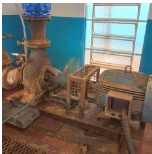
Foto 1 - Ausência da tampa da caixa de ligação elétrica do motor
