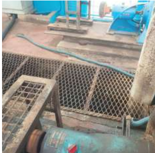
Foto 7 - Drenagem da água de lubrificação de gaxetas, conduzida até ralo próximo.
