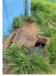
Foto 2 - Caixa de válvula sem proteção contra queda.
