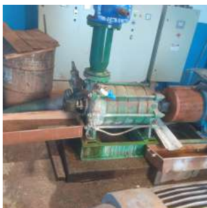
Foto 5 - Ausência de drenagem adequada.
