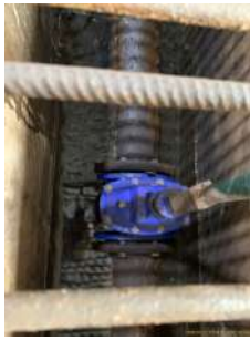
Foto 3 - Água acumulada no canal de passagem da adutora de recalque. Deve ser drenada.
