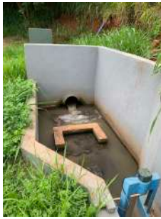
Foto 3 - Canal da chegada 2 do esgoto bruto.
