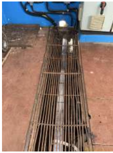
Foto 5 - Calha de transporte instalada sob o gradil do piso.
