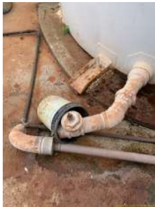
Foto 3 - Vazamento no registro.
