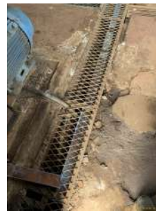
Foto 2 - Calha de transporte instalada sob o gradil do piso.
