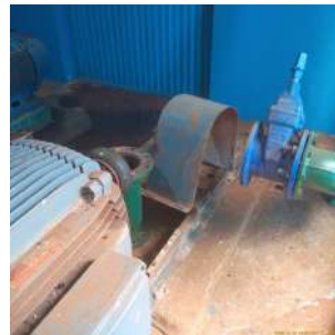
Foto 2 - Ausência da bomba reserva.
