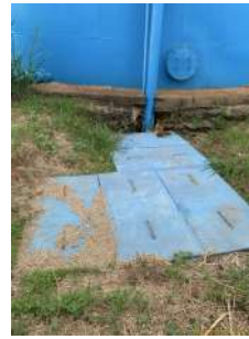
Foto 2 - Tampa de proteção.
