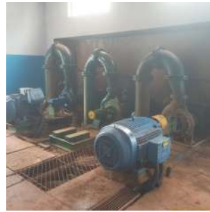
Foto 2 - Vista interna da casa de bombas.
