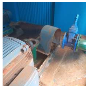
Foto 6 - Ausência da bomba reserva.
