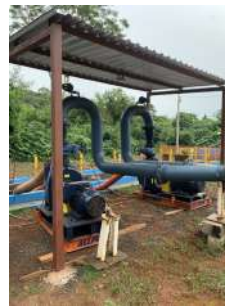
Foto 2 - Dois conjuntos moto bombas alugados pela prestadora.
