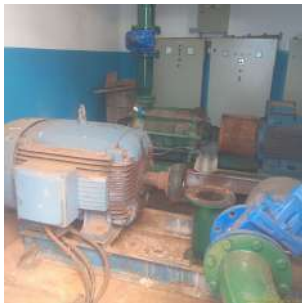
Foto 1 - Presença do motor reserva, mas ausência da bomba.
