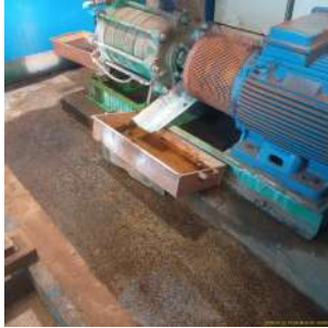
Foto 9 - Caixa para reservação da água de drenagem.
