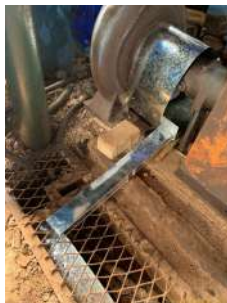
Foto 3 - Sistema de drenagem da água de liberação das gaxetas.
