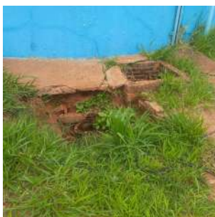
Foto 1 - Vazamento no registro.
