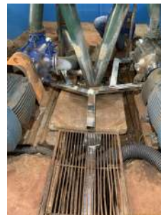
Foto 4 - Sistema de drenagem das bombas central e oposta à porta.
