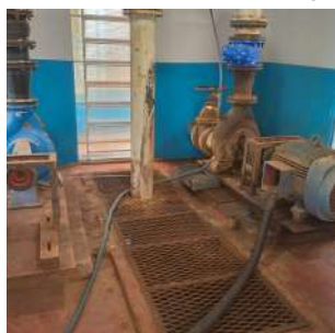
Foto 3 - Vista interna da casa de bombas.
