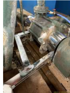
Foto 7 - Sistema de drenagem da bomba oposta à porta com vazamento que deve ser consertado.
