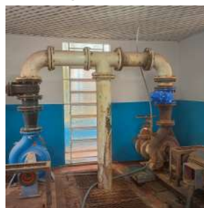
Foto 4 - Conjunto motobomba instalado (direita) e motor ausente do conjunto reserva.
