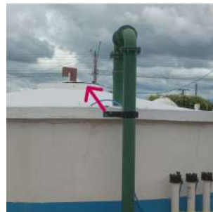
Foto 2 - Indicação do trecho sem vedação.
