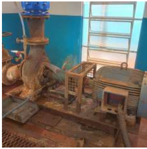
Foto 1 - Tubulação de drenagem.
