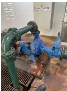
Foto 3 - Vazamento na bomba 2.
