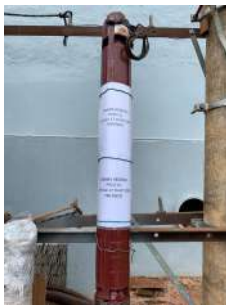
Foto 1 - Bomba reserva para os poços 12 e 15.
