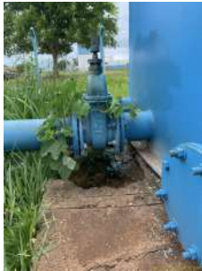
Foto 1 - Registro com vazamento.
