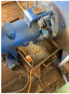
Foto 3 - Drenagem da água de gaxeta com pequena bomba elétrica de ar-condicionado (laranja).
