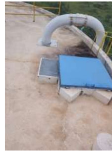
Foto 2 - Tubulações de ventilação com tela.
