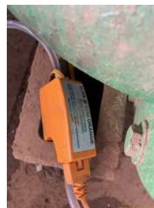
Foto 2 - Bomba elétrica de ar-condicionado.
