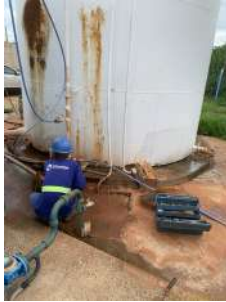
Foto 1 - Vazamentos na base do reservatório.
