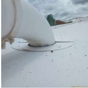
Foto 9 - Segunda entrada de água na laje do reservatório.
