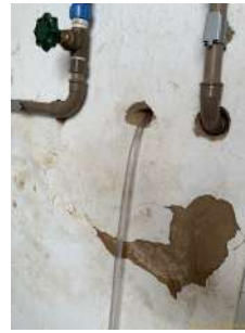
Foto 4 - Saída da mangueira de drenagem em nível superior ao da EEAT.
