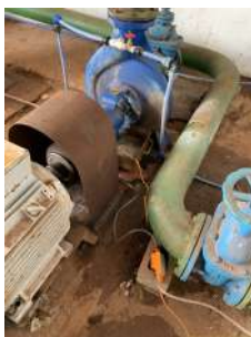
Foto 1 - Drenagem da água de gaxeta com pequena bomba elétrica de ar-condicionado (laranja).
