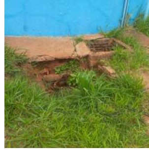
Foto 2 - Caixa de válvula aberta e sem tampa contra queda.
