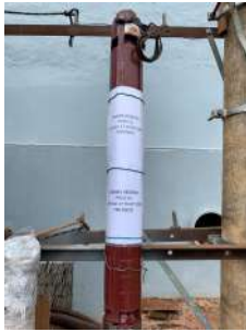
Foto 1 - Bomba reserva para os poços 12 e 15.
