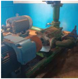
Foto 7 - Piso molhado pela ausência de drenagem.
