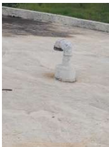
Foto 9 - Tubulações de ventilação com tela.
