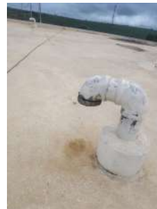
Foto 8 - Tubulações de ventilação com tela.
