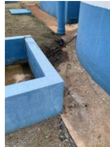
Foto 7 - Vista externa da mangueira de drenagem em nível superior ao da EEAT.
