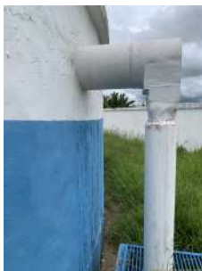
Foto 5 - Local do apontamento do vazamento no Novo Item Fiscalizado 11.751. Ausência de vazamento.
