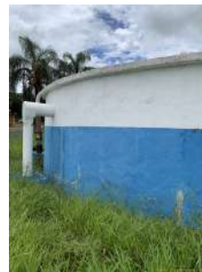
Foto 8 - Local do apontamento do vazamento no Novo Item Fiscalizado 11.751. Ausência de vazamento.
