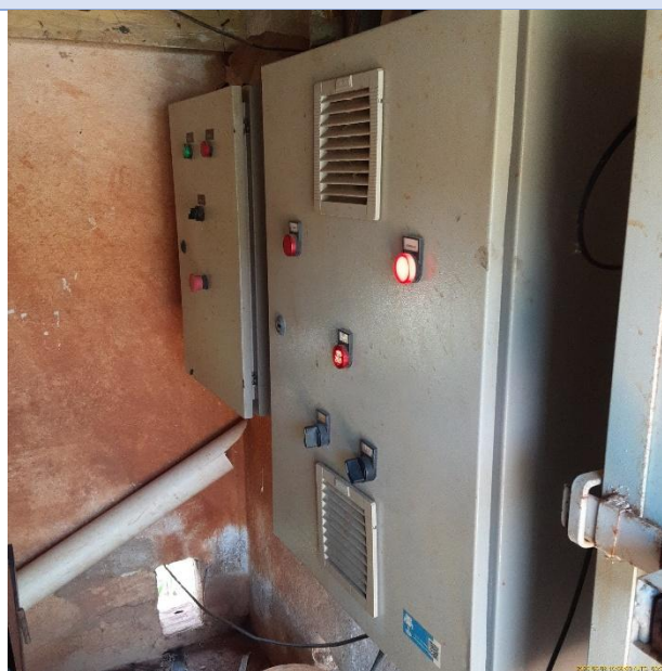
Foto 2 – Painéis elétricos da captação.
