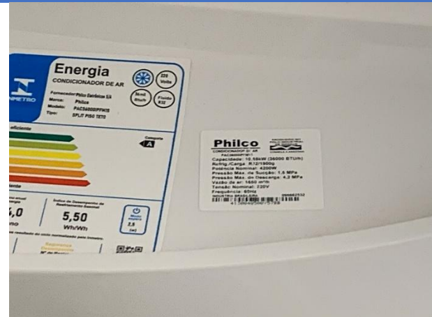
Figura 54 - Ar-condicionado 36.000 BTU gerência de manutenção.
