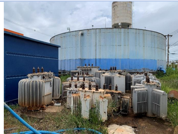
Figura 72 - Estoque de transformadores.
