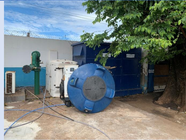
Figura 14 - Abrigo PRFV instalado na Pernambuco.
