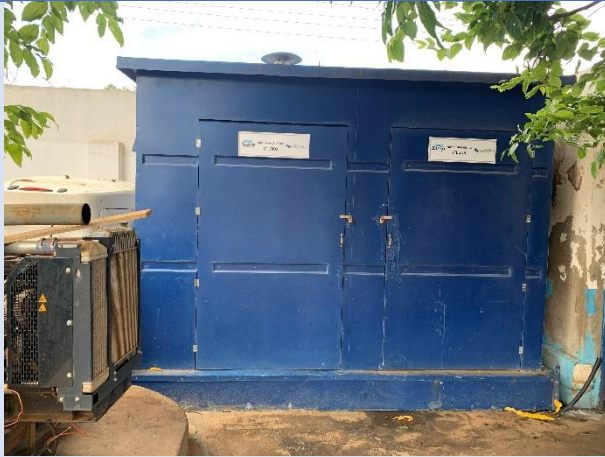
Figura 13 - Abrigo PRFV instalado na Pernambuco.
