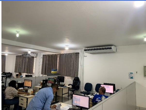
Figura 53 - Equipamentos de ar-condicionado gerência de manutenção.
