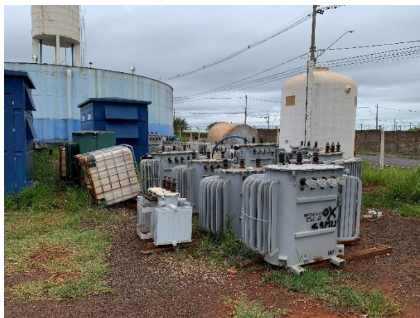
Figura 71 - Estoque de transformadores.
