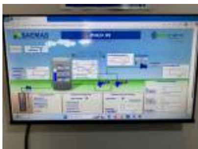
Foto 14 - CCO P39 - Pressão e vazão de saída da EEA.
