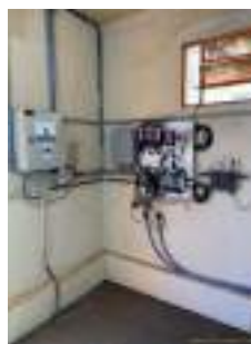
Foto 15 - Sistema de dosagem de produtos químicos.
