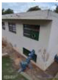
Foto 13 - Tubulação de recalque com macromedidor.
