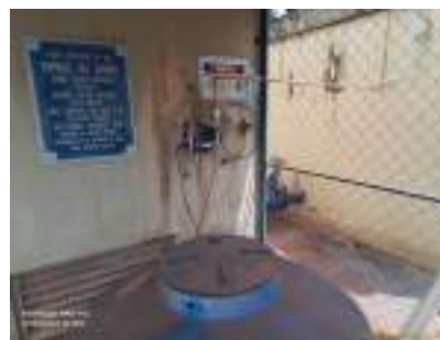
Foto 7 - Tanque de armazenamento e dosadora de Ácido Fluossilícico. Placa de identificação.
