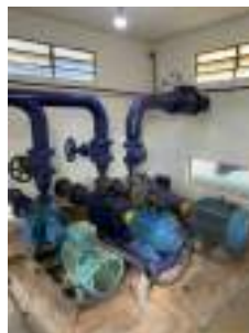
Foto 6 - Vista do interior da edificação com duas EEAs.
