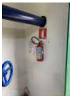
Foto 8 - Extintores na EEA do local.
