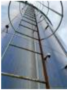
Foto 1 - Escada com pontos de corrosão no reservatório 2.
