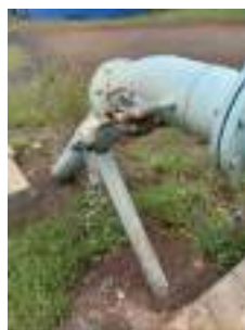
Foto 8 - Torneira para tomada de água bruta.
