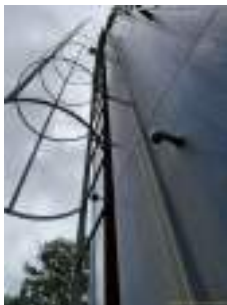
Foto 3 - Escada com pontos de corrosão no reservatório 2.
