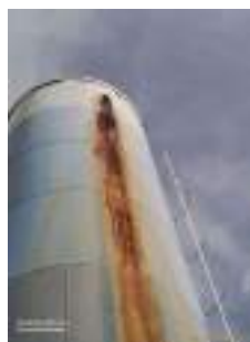
Foto 4 - Extravasor danificado por corrosão.
