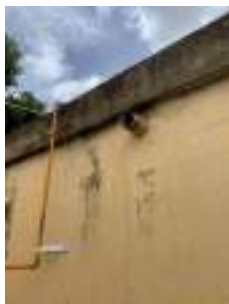
Foto 1 - Extravasador sem tela de proteção.
