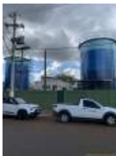
Foto 1 - Vista de dois reservatórios vaso comunicantes.
