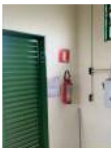
Foto 13 - Extintores na EEA do local.
