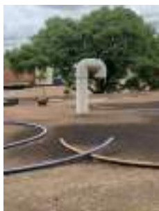
Foto 8 - Tubulação de respiro.
