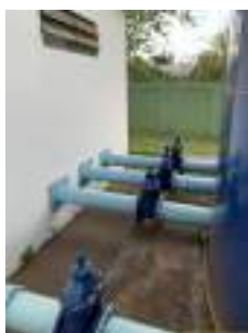
Foto 3 - Tubulação de sucção.
