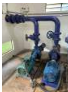
Foto 8 - Moto bombas 1 e 2 EEA São João.
