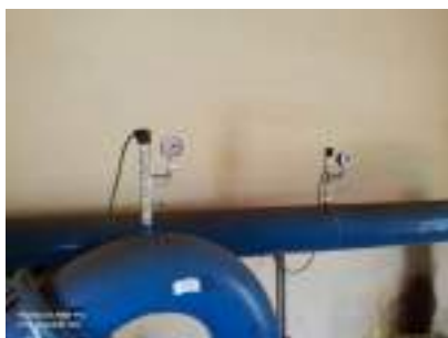
Foto 6 - Manômetros das linhas de recalque.
