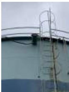
Foto 15 - Extrapasor do reservatório 2.
