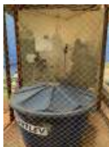
Foto 16 - Tanque de armazenamento e dosadora de Hipoclorito de Sódio.
