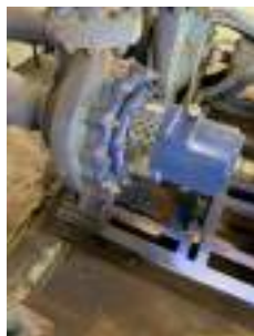
Foto 17 - Drenagem da água da gaxeta bomba 2.
