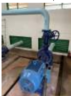
Foto 7 - Conjunto moto bomba 1. Pressurização da rede de abastecimento.
