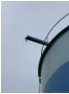
Foto 1 - Extravasor com proteção de vedação comprometida.
