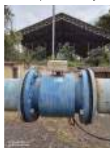
Foto 3 - Macromedidor instalado na tubulação do poço.
