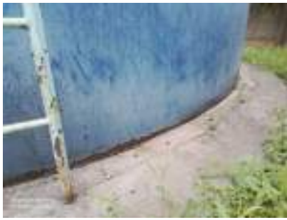
Foto 5 - Pontos de corrosão na escada e base do reservatório.
