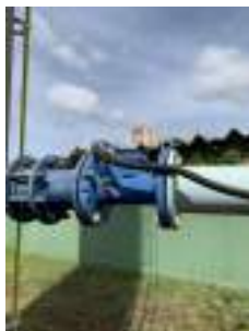
Foto 7 - Macromedidor instalado na tubulação do poço.
