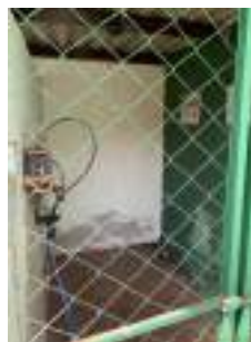
Foto 12 - Dosadora de Hipoclorito de Sódio no compartimento ao lado.
