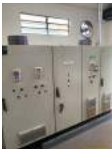
Foto 13 - Painéis elétricos da EEA. Recomenda-se a identificação adequada dos comandos do painel.
