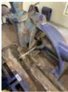
Foto 18 - Drenagem da água da gaxeta bomba 3.
