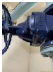
Foto 2 - Detalhe do registro de manobra com vazamento.
