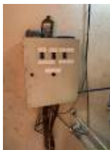
Foto 14 - Painelelétrico da EEE. Recomenda-se a identificação adequada dos comandos do painel.
