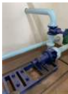
Foto 11 - Bomba 3 sem motor. Reserva da EEA do reservatório de concreto elevado.
