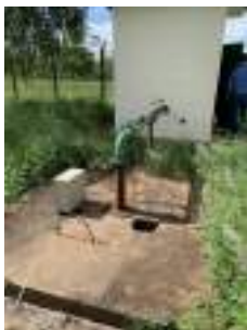
Foto 5 - Tubulação de sucção da bomba 2.
