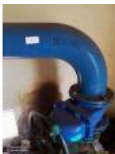
Foto 11 - Tubulação de recalque para o Batalhão.
