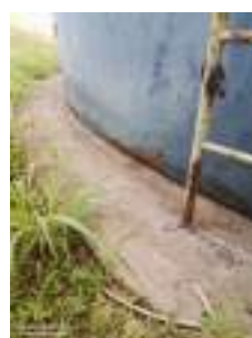
Foto 4 - Pontos de corrosão na escada e base do reservatório.
