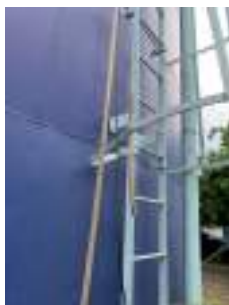
Foto 7 - Mangueira de nível pendurada e vazando.
