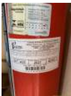
Foto 10 - Extintor com validade expirada.
