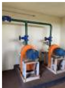
Foto 8 - Conjuntos moto bombas de recalque.
