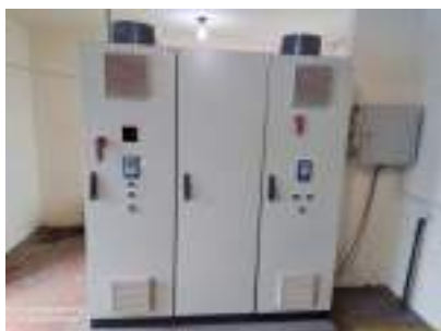
Foto 5 - Painéis elétricos da EEA. Recomenda-se a identificação adequada dos comandos do painel.
