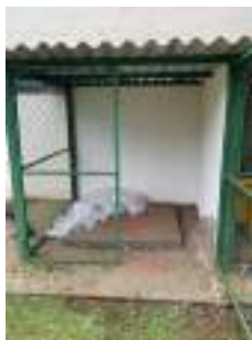
Foto 1 - Ausência de tanque de ácido fluossilícico.
