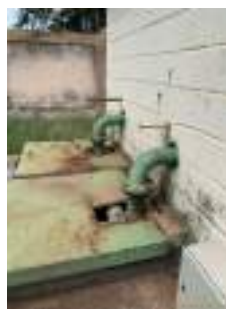
Foto 18 - Tubulação de sucção.
