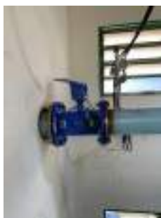
Foto 11 - Macromedidor de saída da EEA.
