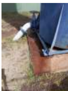
Foto 1 - Vazamento no registro de manobra.
