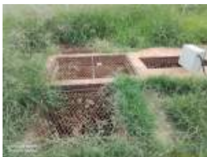
Foto 3 - Caixas de válvulas e recalque.
