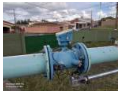
Foto 4 - Macromedidor instalado na tubulação do poço.
