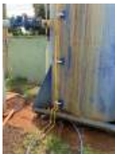
Foto 1 - Mangueras de aplicação de Ácido Fluossilícico e Hipoclorito de Sódio no reservatório.
