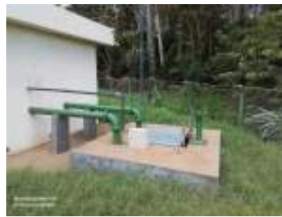
Foto 2 - Caixas de chegada.
