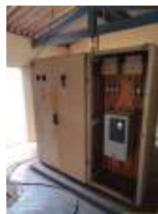
Foto 7 - Painéis elétricos da EEA. Recomenda-se a identificação adequada dos comandos do painel.
