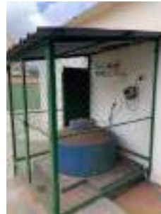
Foto 12 - Tanque de armazenamento e dosadora de Ácido Fluossilícico.
