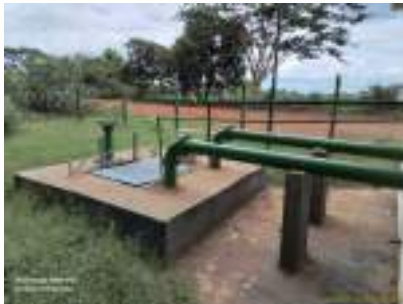
Foto 14 - Tubulação de sucção.
