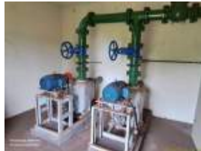
Foto 4 - Conjuntos moto bombas de recalque.
