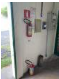
Foto 14 - Extintores na EEA do local.
