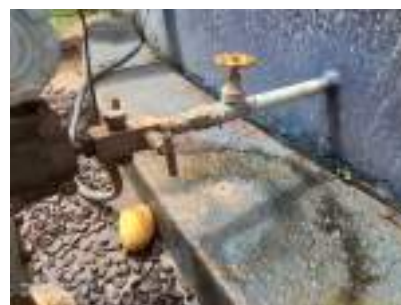
Foto 2 - Vazamento no registro amarelo.
