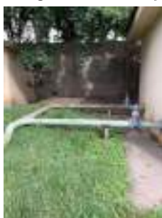
Foto 3 - Tubulação de sucção.
