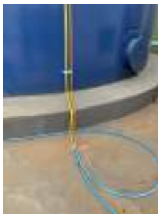
Foto 9 - Mangueiras de aplicação de Ácido Fluossilícico e Hipoclorito de Sódio no reservatório.
