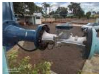
Foto 6 - Macromedidor instalado na tubulação do poço.
