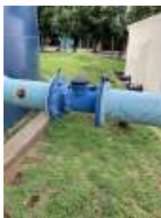
Foto 7 - Macromedidor instalado na tubulação do poço
