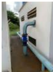
Foto 2 - Tubulação de recalque com macromedidor para o bairro Bandeirante e outros.
