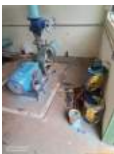
Foto 1 - Remover material de construção depositado no interior da EEA.
