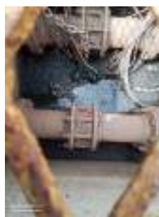
Foto 2 - Caixa de válvulas com esgoto proveniente do extravasamento.
