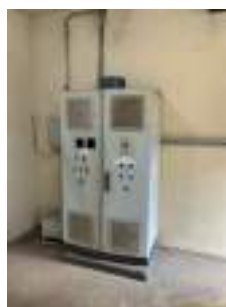
Foto 8 - Painéis elétricos da EEA. Recomenda-se a identificação adequada dos comandos do painel.
