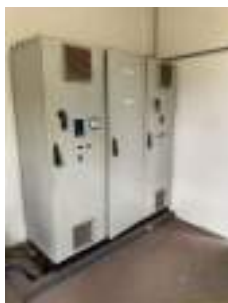
Foto 19 - Painéis elétricos da EEA. Recomenda-se a identificação adequada dos comandos do painel.
