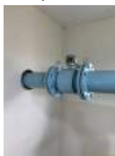
Foto 10 - Macromedidor na linha de recalque.
