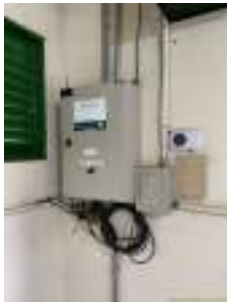
Foto 17 - Painéis elétricos do poço P44. Recomenda-se a identificação adequada dos comandos do painel.
