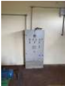
Foto 5 - Painel elétrico da EEA.
