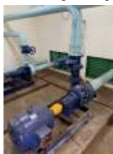
Foto 9 - Conjunto moto bomba 2. Pressurização da rede de abastecimento.
