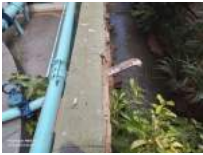
Foto 3 - Vazamento interno sendo lançado no córrego.
