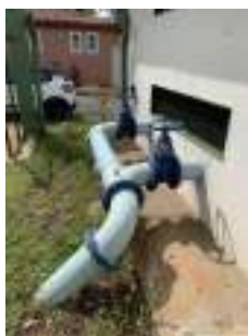
Foto 3 - Tubulação de sucção.
