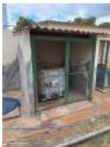
Foto 7 - Tanque de armazenamento de Hipoclorito de Sódio
