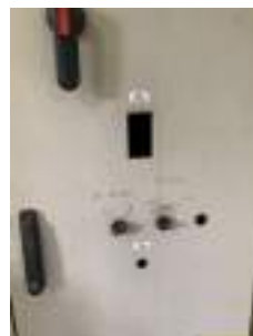
Foto 23 - Painéis elétricos da EEA. Recomenda-se a identificação adequada dos comandos do painel.
