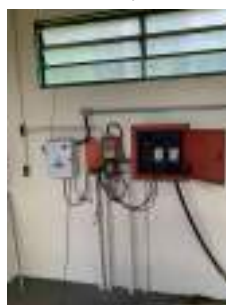
Foto 12 - Painelelétrico da EEA. Recomenda-se a identificação adequada dos comandos do painel
