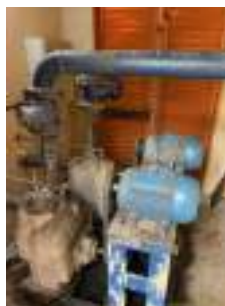
Foto 12 - Conjuntos moto bombas de recalque.
