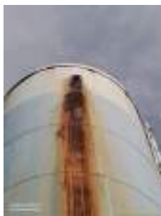
Foto 3 - Consertar o extravasor. O extravasor deve seguir as orientações do item
