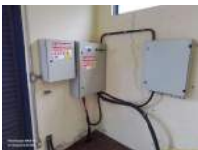
Foto 15 - Painéis elétricos da EEE. Recomenda-se a identificação adequada dos comandos do painel.
