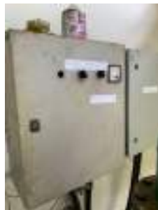
Foto 18 - Paineleltrico da bomba 2 da EEE. Recomenda-se a identificação adequada dos comandos do painel.
