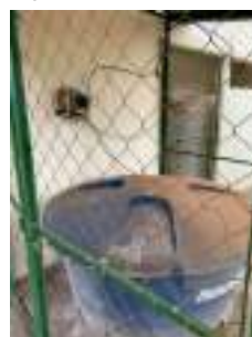
Foto 13 - Tanque de armazenamento e dosadora de Ácido Fluossilícico.
