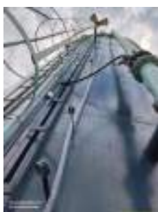
Foto 1 - Isoladores do SPDA sem cabeamento.
