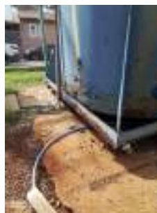
Foto 4 - Sanar integralmente os pontos de corrosão identificados na base do reservatório metálico, garantindo a integridade estrutural e a durabilidade do equipamento.
