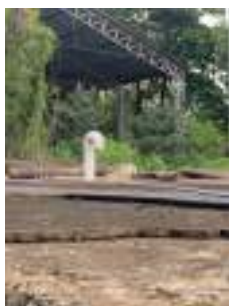
Foto 3 - Tubulação de ventilação sem tela de proteção.
