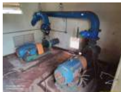
Foto 2 - Vista do interior da edificação da EEA. Bomna da esquerda para o Centro. Bomba da
