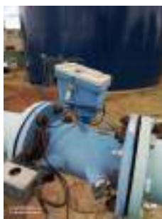
Foto 4 - Macromedidor instalado na tubulação do poço.
