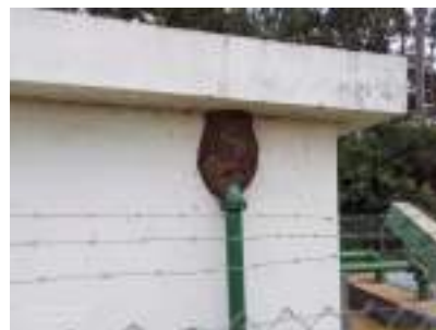
Foto 4 - Remover coméia de abelhas da tubulação de recalque.
