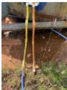
Foto 3 - Ausência de aplicação de flúor.
