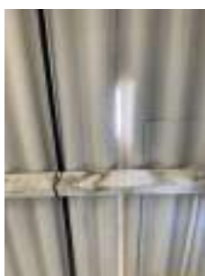
Foto 1 - Substituir telha danificada com abertura.
