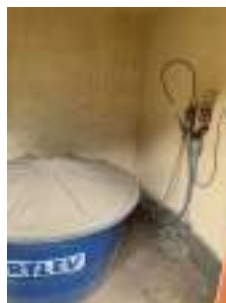
Foto 9 - Tanque e dosadora de hipoclorito de sódio.
