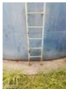
Foto 2 - Pontos de corrosão na escada e base do reservatório.
