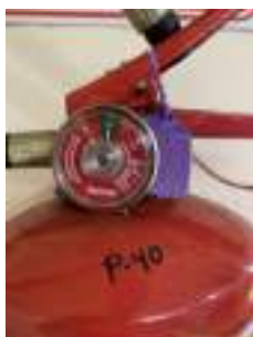
Foto 9 - Extintor sem pressão.
