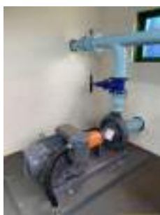
Foto 7 - Conjunto moto bomba 1.
