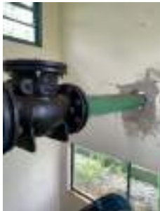
Foto 13 - Tubulação de recalque da bomba 2.
