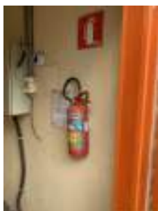
Foto 10 - Extintor na EEA do local.
