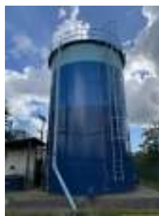
Foto 5 - Medição de nível e extravasor do reservatório 1.
