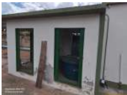
Foto 9 - Abrigo dos tanques de produtos químicos.
