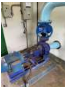
Foto 11 - Conjunto moto bomba 1.
