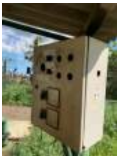
Foto 19 - Paineleltrico da bomba 1 da EEE. Recomenda-se a identificação adequada dos comandos do painel.
