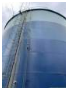
Foto 16 - Medidor de nível do reservatório 2.
