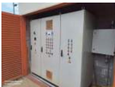
Foto 7 - Painéis elétricos da EEE. Recomenda-se a identificação adequada dos comandos do painel.
