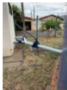
Foto 2 - Tubulação de sucção.
