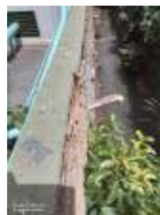
Foto 2 - Vazamento interno sendo lançado no córrego.
