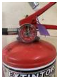
Foto 14 - Pressão do extintor.
