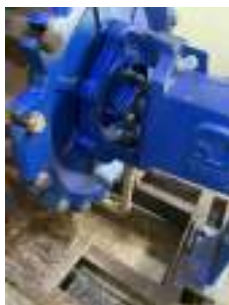
Foto 7 - Drenagem da gaxeta.
