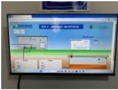
Foto 15 - CCO EEE2 - Nível da caixa de esgoto.
