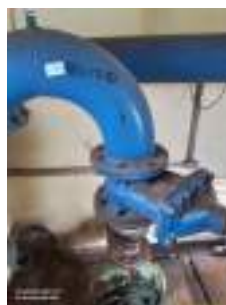
Foto 12 - Tubulação de recalque para o Centro.
