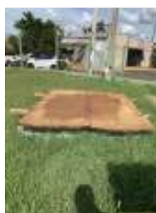
Foto 2 - Adequar as tampas enferrujadas e soltas.
