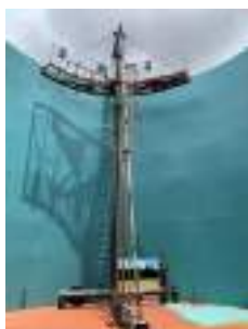
Foto 18 - Interior do novo reservatório P47.
