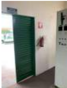
Foto 13 - Extintor na EEA do local.
