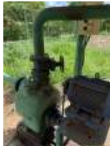
Foto 14 - Conjunto moto bomba 1.
