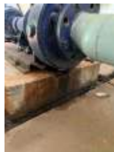
Foto 4 - Drenagem da bomba 1.
