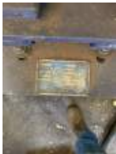
Foto 13 - Identificação da bomba2.
