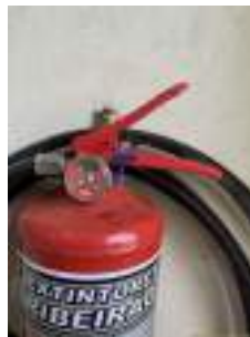
Foto 8 - Pressão do extintor.
