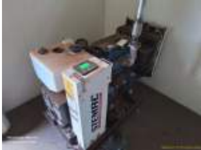
Foto 12 - Gerador da EEE.
