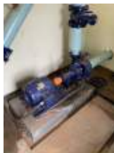
Foto 8 - Conjunto moto bomba 2.
