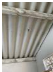
Foto 2 - Substituir telha danificada com abertura.
