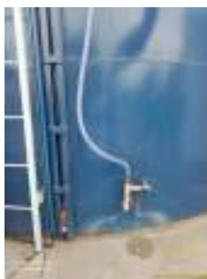
Foto 3 - Medidor de nível
