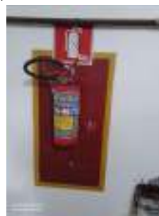
Foto 8 - Extintor na EEA do local.
