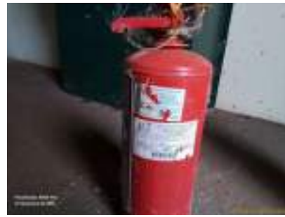
Foto 11 - Validade do 2º extintor. Vencido e removido no dia pelo prestador.
