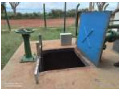
Foto 3 - Tampa solta e sem fixação.
