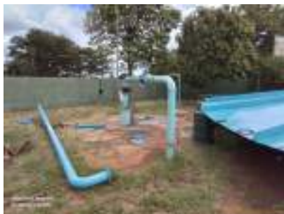
Foto 1 - Vista geral do poço e cercamento. Recomenda-se retirar o material de construção da entorno do poço.
