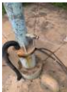
Foto 4 - Torneira para tomada de água bruta.
