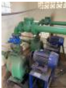
Foto 11 - Conjuntos moto bombas de recalque.
