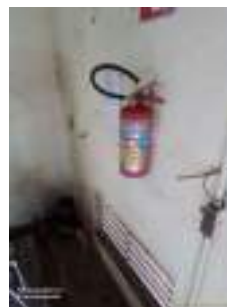
Foto 9 - Extintor na EEA do local.
