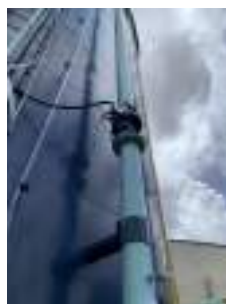
Foto 8 - Macromedidor instalado na tubulação do poço.
