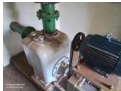
Foto 5 - Conjunto moto bomba 1.
