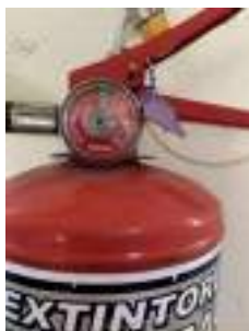
Foto 18 - Pressão do extintor.
