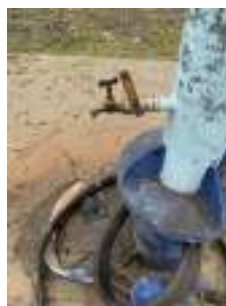
Foto 6 - Torneira para tomada de água bruta.
