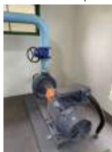
Foto 8 - Conjunto moto bomba 2.
