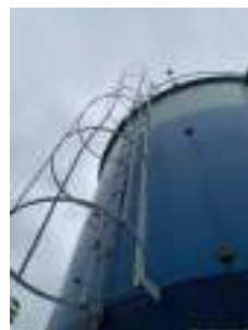
Foto 4 - Guarda-corpo e descida do SPDA.
