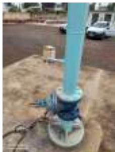
Foto 3 - Torneira para tomada de água bruta.
