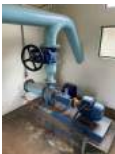
Foto 13 - Conjunto moto bomba 2.
