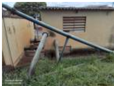
Foto 14 - Tubulações de recalque.
