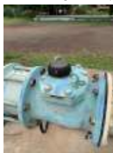
Foto 6 - Macromedidor instalado na tubulação do poço
