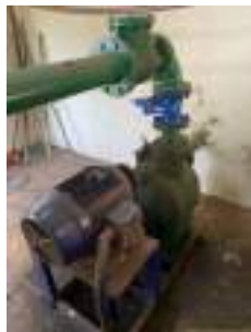
Foto 14 - Conjunto moto bomba 1.
