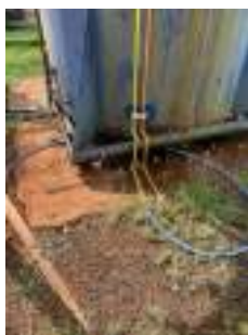
Foto 9 - Mangueras de aplicação de Ácido Fluossilícico e Hipoclorito de Sódio no reservatório.
