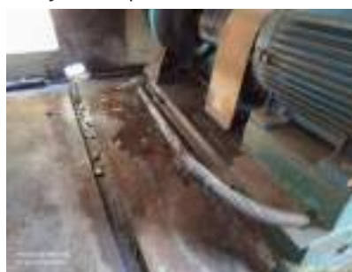
Foto 9 - Canaleta de drenagem.
