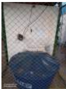
Foto 7 - Tanque e dosadora de hipoclorito de sódio.
