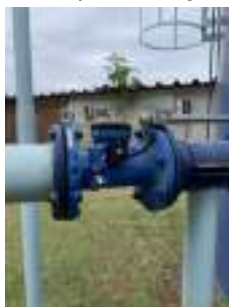
Foto 7 - Macromedidor instalado na tubulação do poço.
