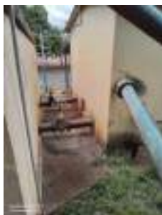
Foto 13 - Tubulações de sucção.
