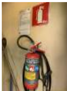
Foto 8 - Extintor na EEE do local.
