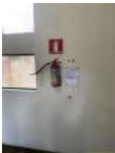
Foto 15 - Extintores na EEA do local.
