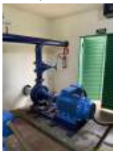
Foto 5 - Conjunto moto bomba 2.
