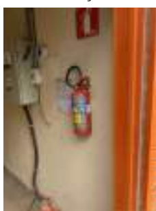
Foto 5 - Extintores na EEA do local.
