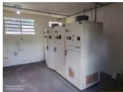
Foto 4 - Painéis elétricos da EEA. Recomenda-se a identificação adequada dos comandos do painel.
