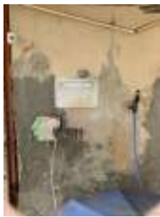
Foto 1 - Placa de identificação apagada.
