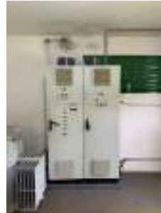
Foto 16 - Painéis elétricos da EEA. Recomenda-se a identificação adequada dos comandos do painel.
