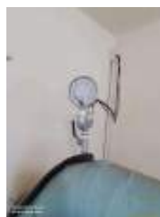
Foto 4 - Substituir o manômetro danificado.
