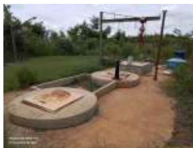
Foto 2 - Caixas de chegada e poço de sucção.
