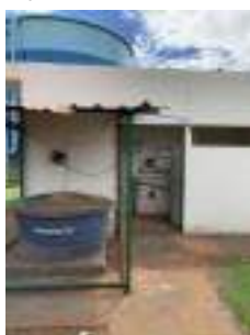
Foto 12 - Tanques e dosadoras de produtos químicos.
