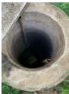
Foto 5 - Poço de chegada com ausência de cesto.
