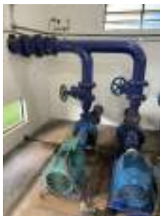
Foto 9 - Moto bombas 1 e 2 EEA São João.
