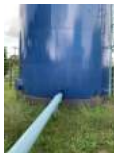
Foto 12 - Tubulação vaso comunicante no reservatório 2.
