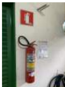
Foto 8 - Extintor na EEA do local (ficha 13.734).
