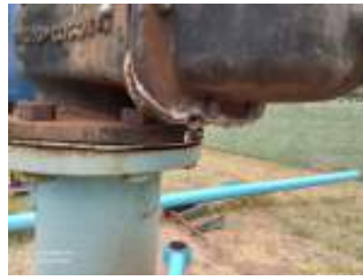
Foto 2 - Registro de manobra com vazamento.
