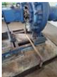
Foto 10 - Drenagem da gaxeta.
