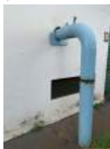
Foto 4 - Tubulação de recalque para o São João.
