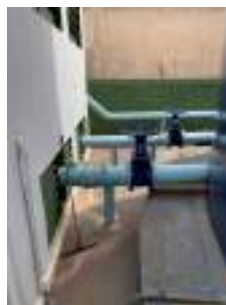
Foto 16 - Tubulação de sucção.
