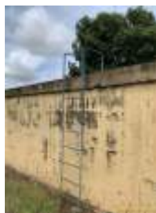
Foto 2 - Escada sem guarda-corpo.
