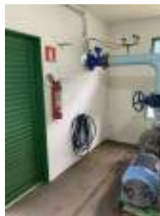
Foto 13 - Extintor na EEA do local.
