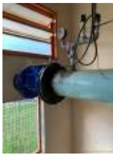
Foto 11 - Macromedidor e medição de pressão na tubulação de recalque.
