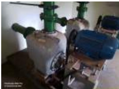
Foto 6 - Conjunto moto bomba 2.
