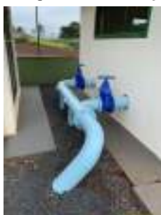
Foto 3 - Tubulação de sucção.
