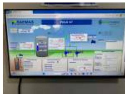
Foto 19 - CCO P47 - Nível, altura e volume do reservatório.
