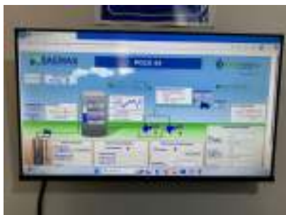
Foto 5 - CCO P44 - Nível, altura e volume do reservatório.
