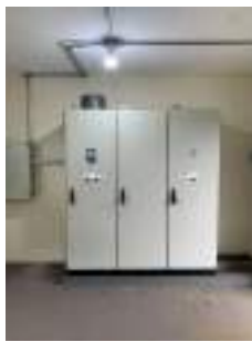
Foto 11 - Painéis elétricos da EEA. Recomenda-se a identificação adequada dos comandos do painel.
