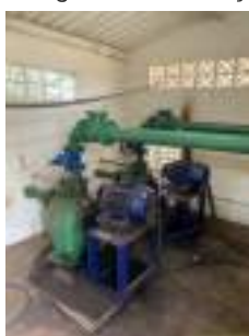
Foto 5 - Conjuntos moto bombas de recalque.
