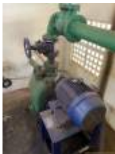
Foto 15 - Conjunto moto bomba 2.
