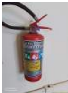
Foto 13 - Extintor na EEA do local e indicador de pressão.
