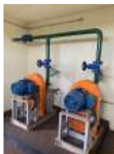
Foto 10 - Conjuntos moto bombas de recalque.
