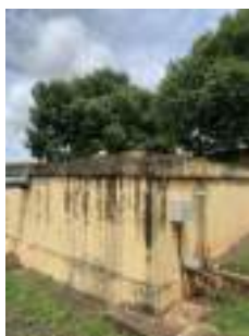
Foto 1 - Beirada das tampas de inspeção sem guarda-corpo.
