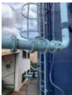
Foto 7 - Macromedidor antigo desativado.
