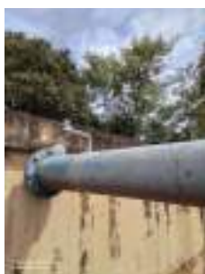
Foto 4 - Torneira para tomada de água bruta.
