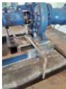
Foto 11 - Drenagem da gaxeta.
