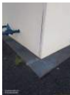
Foto 9 - SPDA da edificação da EEA.
