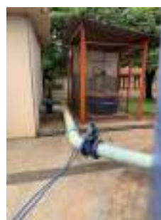
Foto 2 - Tubulação de sucção.
