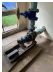
Foto 10 - Conjunto moto bomba 2 sem motor.
