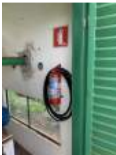
Foto 7 - Extintor na EEE do local.
