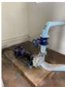
Foto 12 - Conjunto moto bomba 4. EEA do reservatorio de concreto.
