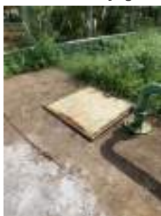
Foto 3 - Adequar as tampas enferrujadas e soltas.
