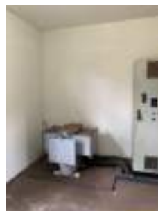
Foto 20 - Transformador no interior da EEA.
