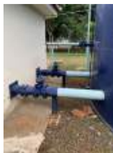
Foto 15 - Tubulação de sucção.
