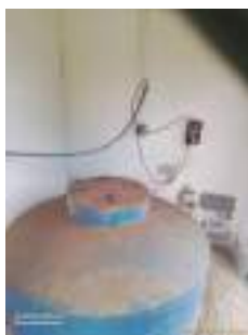
Foto 7 - Tanque e dosadora de cloro ou fluor.
