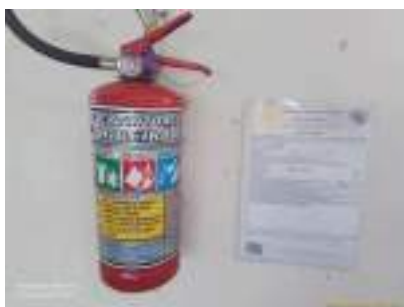
Foto 12 - Extintores na EEA do local.
