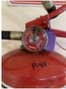
Foto 1 - Extintor sem pressão.
