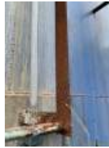
Foto 2 - Escada com pontos de corrosão no reservatório 2.
