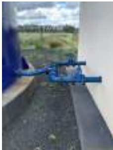
Foto 7 - Tubulação de sucção.
