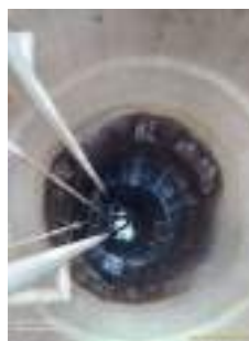
Foto 12 - Poço de chegada com cesto sem proteção superior e resíduos flutuando.
