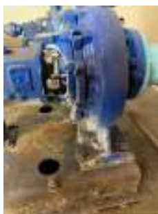
Foto 5 - Drenagem da água de lubrificação da gaxeta da bomba 1.
