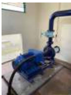
Foto 3 - Conjunto moto bomba 1.
