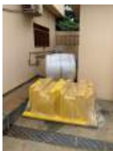
Foto 17 - No sistema de armazenagem de produtos químicos a ser instalado.
