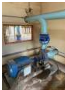
Foto 6 - Conjunto moto bomba 2.
