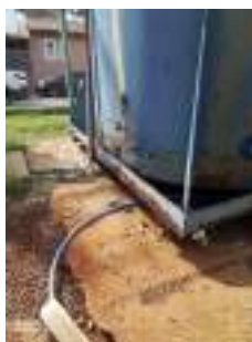
Foto 3 - Vazamento no cordão de solda da base da estrutura metálica.
