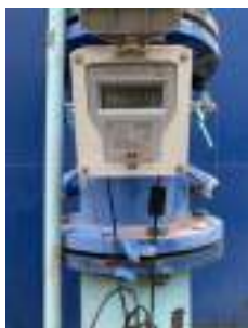
Foto 19 - Macromedidor na adutora de chegada do reservatório 2.
