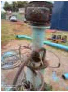
Foto 1 - Registro de manobra com vazamento.
