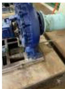
Foto 8 - Drenagem da gaxeta.
