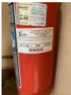
Foto 1 - Extintor com validade expirada.
