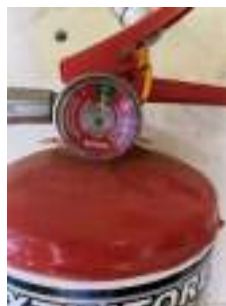
Foto 15 - Pressão do 1º extintor.
