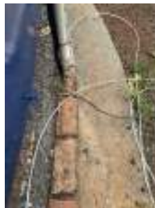
Foto 2 - Cabo de aterramento solto.
