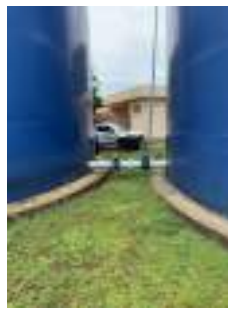
Foto 8 - Tubulação vaso comunicante.
