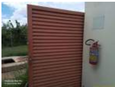
Foto 9 - Extintor na EEE do local.
