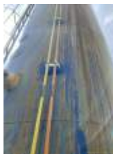
Foto 10 - Mangueras de aplicação de Ácido Fluossilícico e Hipoclorito de Sódio no reservatório.
