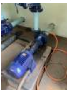
Foto 5 - Conjunto moto bomba 1.
