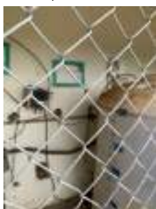
Foto 14 - Tanque de armazenamento e dosadora de Hipoclorito de Sódio.
