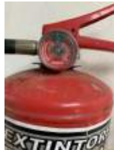
Foto 14 - Pressão do extintor.
