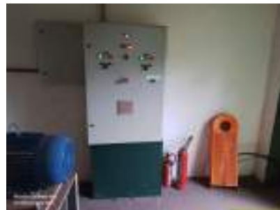
Foto 7 - Painel elétrico da EEE. Recomenda-se a identificação adequada dos comandos do painel.
