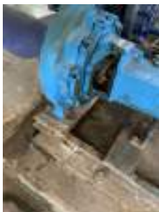
Foto 16 - Drenagem da água da gaxeta bomba 1.
