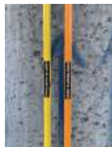
Foto 2 - Mangueiras de aplicação de Ácido Fluossilícico e Hipoclorito de Sódio no reservatório.
