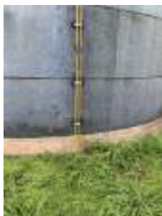
Foto 8 - Mangueiras de aplicação de Ácido Fluossilícico e Hipoclorito de Sódio no reservatório.
