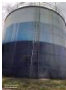
Foto 2 - Tubo de medição de nível e guarda-corpo da escada e topo.
