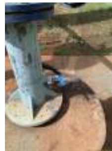
Foto 6 - Torneira para tomada de água bruta.
