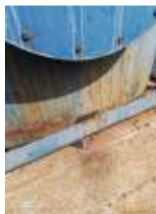
Foto 4 - Vazamento no cordão de solda da base da estrutura metálica.
