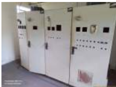
Foto 7 - Painéis elétricos da EEA. Recomenda-se a identificação adequada dos comandos do painel.
