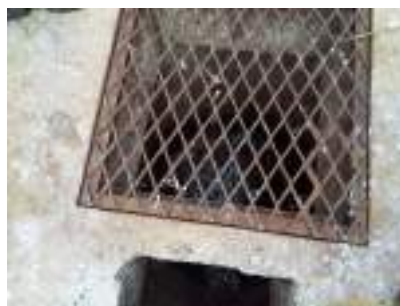
Foto 4 - Caixa de chegada.
