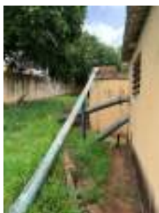
Foto 14 - Tubulação de recalque do poço P40 para o reservatório P22.
