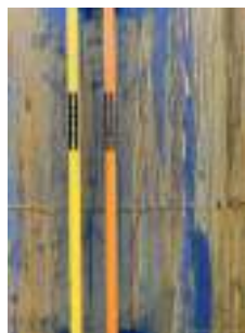
Foto 2 - Mangueras de aplicação de Ácido Fluossilícico e Hipoclorito de Sódio no reservatório.
