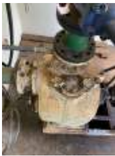
Foto 11 - Conjunto moto bomba 2.
