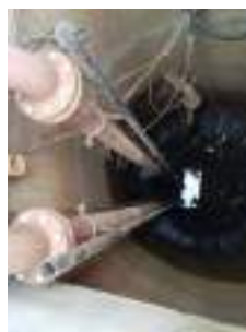
Foto 6 - Poço de sucção com duas bombas e resíduos flutuando.
