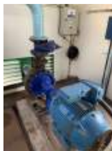
Foto 6 - Conjunto moto bomba 1.
