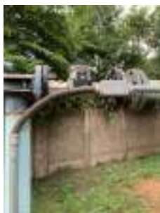
Foto 5 - Macromedidor instalado na tubulação do poço.
