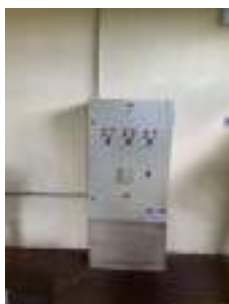
Foto 9 - Painel elétrico da EEE.
