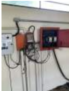
Foto 1 - Adequar as instalações elétricas dos painéis da EEA.
