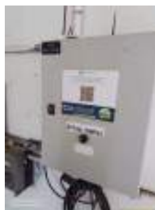
Foto 6 - Painéis elétricos da EEA. Recomenda-se a identificação adequada dos comandos do painel.
