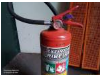
Foto 8 - Pressão do 1º extintor.
