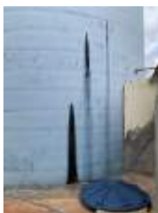
Foto 1 - Vazamentos na estrutura de alvenaria.
