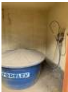
Foto 1 - Providenciar e instalar placa de identificação dos produtos químicos.
