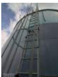
Foto 3 - Pontos de corrosão na escada.
