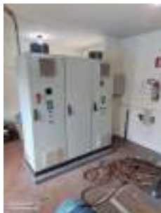
Foto 3 - Painéis elétricos da EEA.
