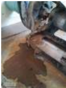
Foto 1 - Vazamento da drenagem.
