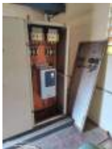
Foto 1 - Painel elétrico com a porta quebrada.
