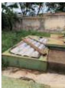
Foto 17 - Tampas de proteção improvisadas.
