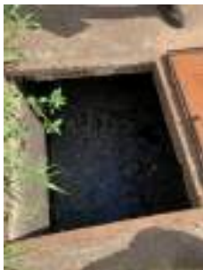
Foto 3 - Caixa de chegada.
