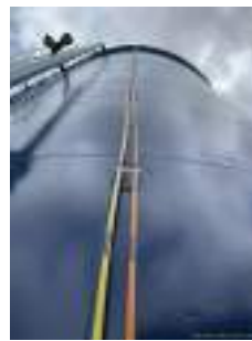
Foto 10 - Mangueiras de aplicação de Ácido Fluossilícico e Hipoclorito de Sódio no reservatório.
