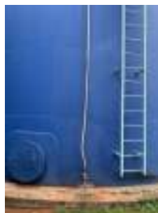
Foto 3 - Mangueira de medição de nível do reservatório 1.
