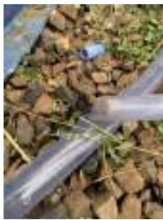
Foto 3 - Vazamento pela mangueira de nível.
