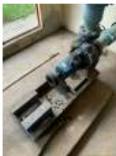
Foto 1 - Bomba 2 sem motor.
