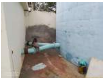
Foto 7 - Tubulação de sucção.
