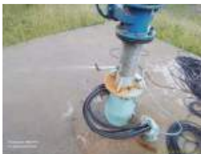
Foto 3 - Torneira para tomada de água bruta.
