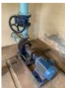
Foto 9 - Conjunto moto bomba 1.
