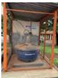
Foto 15 - Tanque de armazenamento e dosadora de Ácido Fluossilícico.
