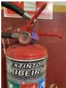
Foto 11 - Pressão do extintor.
