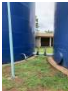
Foto 20 - Tubulação vaso comunicante.
