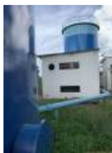
Foto 14 - Tubulação vaso comunicante no reservatório 2 (frente) para reservatório 1 (fundo).
