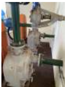
Foto 11 - Tubulação de sucção.
