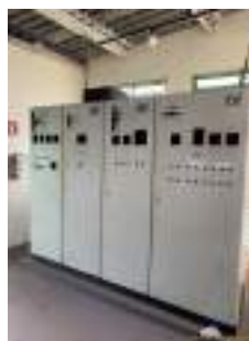
Foto 12 - Painéis elétricos da EEA. Recomenda-se a identificação adequada dos comandos do painel.
