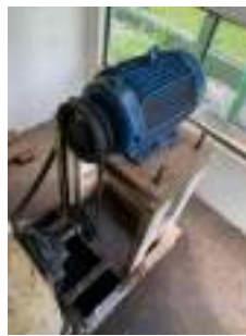
Foto 12 - Motor da bomba 2.
