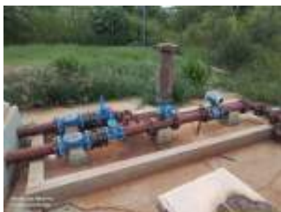
Foto 5 - Válvulas para manobras.
