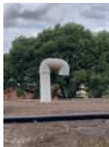
Foto 2 - Tubulação de ventilação sem tela de proteção.
