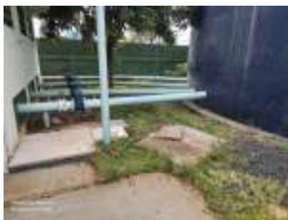
Foto 3 - Tubulação de sucção da EEA P33.
