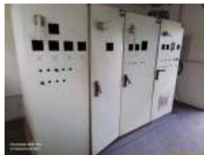
Foto 8 - Painéis elétricos da EEA. Recomenda-se a identificação adequada dos comandos do painel.
