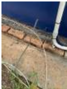
Foto 1 - Cabo de aterramento solto.
