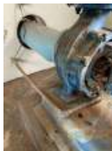
Foto 14 - Drenagem da gaxeta.
