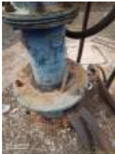
Foto 1 - Tubo aberto e desprotegido.
