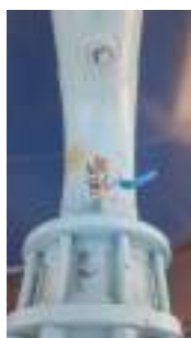
Foto 1 - Torneira instalada pelo prestador (E-mail de 20/01/2026).
