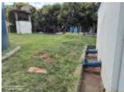
Foto 3 - Tubulação de sucção.
