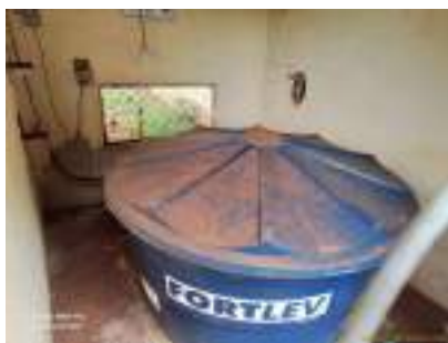
Foto 6 - Tanque de armazenamento e dosadora de Hipoclorito de Sódio
