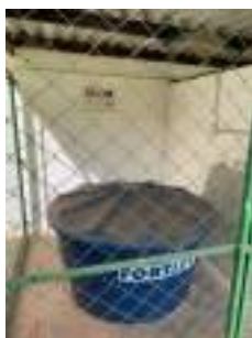
Foto 1 - Tanque de hipoclorito de sódio. Identificação incorreta do produto químico.
