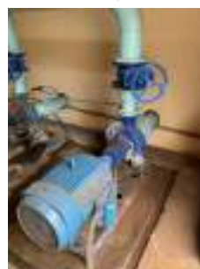
Foto 4 - Conjunto moto bomba 1.
