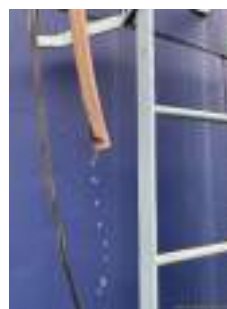
Foto 2 - Vazamento pela mangueira de nível.
