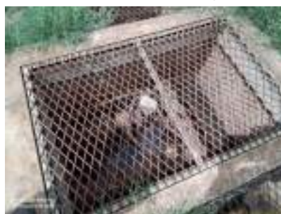
Foto 6 - Caixa de válvulas.
