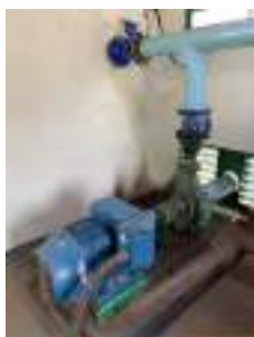
Foto 9 - Conjunto moto bomba 2.
