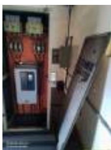
Foto 8 - Painéis elétricos da EEA com porta quebrada.
