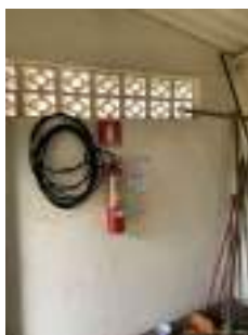
Foto 7 - Extintor na EEE do local.
