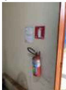
Foto 9 - Extintores na EEA do local.
