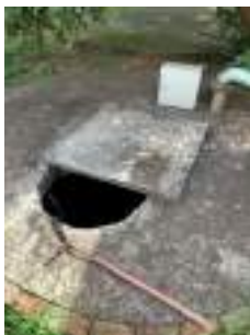
Foto 4 - Poço de sucção.
