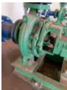
Foto 1 - Ausência de tubo de drenagem e canaleta.
