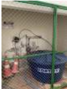
Foto 11 - Tanque de armazenamento e dosadora de Hipoclorito de Sódio.
