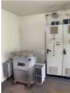
Foto 15 - Transformador instalado no interior da edificação.
