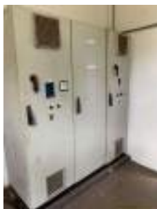
Foto 22 - Painéis elétricos da EEA. Recomenda-se a identificação adequada dos comandos do painel.
