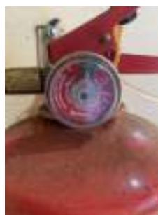
Foto 11 - Pressão do extintor.
