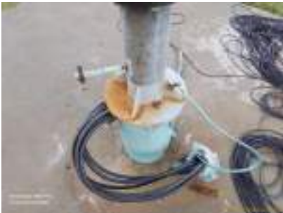
Foto 2 - Tubo para medição de nível sem proteção.
