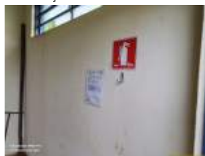
Foto 12 - Ausência de extintor.
