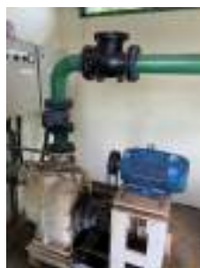
Foto 10 - Conjunto moto bomba 2.
