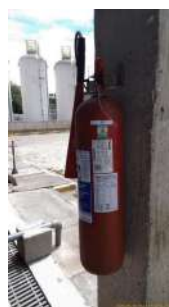
Foto 34 - Extintor de incêndio disponível
