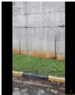
Foto 3 - Vazamento nos fundos do tanque anóxico
