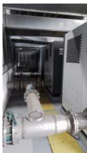
Foto 21 - Sala dos sopradores
