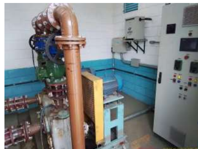
Foto 4 - Dentro da casa de bombas (painel elétrico)
