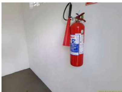
Foto 7 - Extintor de incêndio
