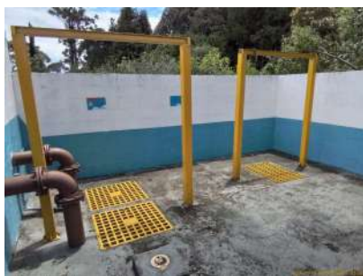
Foto 3 - Estrutura de içamento para manutenção das bombas
