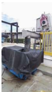
Foto 5 - Caçamba para material retido no gradeamento
