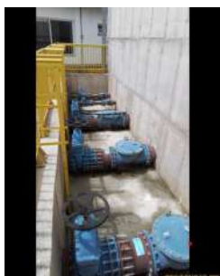
Foto 26 - Bombas da recirculação do lodo (1 em funcionamento e 1 reserva)
