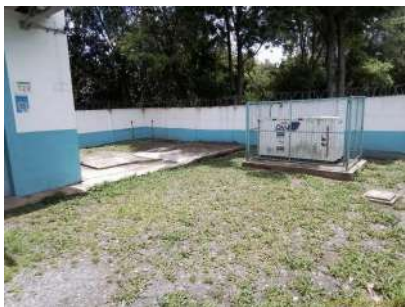
Foto 2 - Área interna e gerador de energia elétrica
