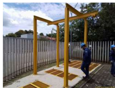
Foto 4 - Estrutura de içamento para manutenção das bombas
