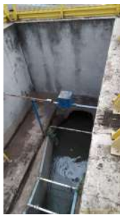
Foto 1 - Macromedidor de entrada
