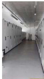
Foto 25 - Painéis elétricos da ETE
