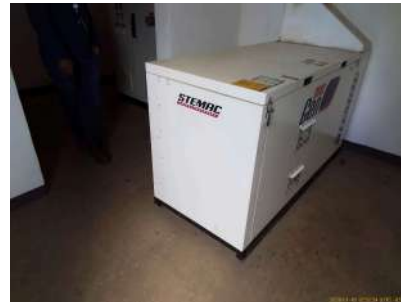
Foto 6 - Gerador da elevatória
