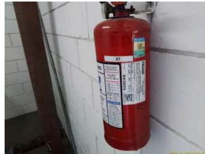
Foto 8 - Validade do extintor de incêndio
