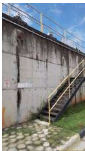
Foto 5 - Vazamento na lateral dos tanques
