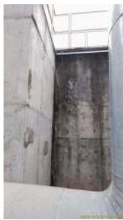
Foto 1 - Vazamento visível no tanque do tratamento biológico
