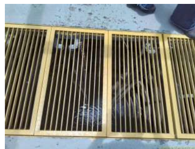
Foto 6 - Local das bombas submersas
