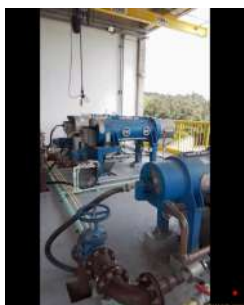
Foto 37 - Centrifugas, sendo uma em funcionamento, uma reserva e uma para utilização futura após ampliações
