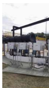
Foto 7 - Painel elétrico das bombas (3 em funcionamento + 1 reserva)
