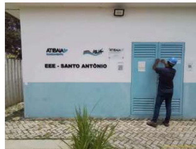
Foto 2 - Casa de máquinas
