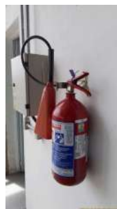
Foto 39 - Extintor de incêndio disponível na secagem do lodo
