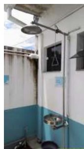
Foto 41 - Chuveiro de emergência ao lado do laboratório
