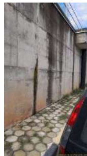
Foto 4 - Vazamento na lateral dos aeradores
