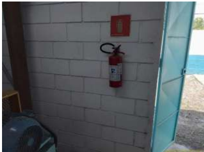
Foto 7 - Extintor de incêndio
