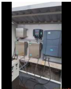
Foto 17 - Painéis elétricos dos aeradores
