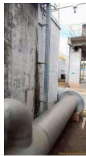
Foto 2 - Vazamento visível no tanque do tratamento biológico
