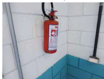
Foto 6 - Extintor de incêndio
