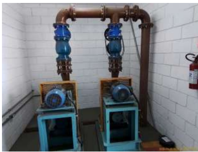
Foto 5 - Conjunto de motobomba e reserva
