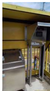
Foto 32 - Painel elétrico do tratamento terciário
