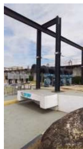
Foto 6 - Sistema de bombeamento
