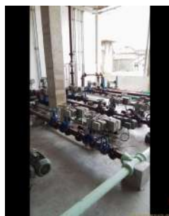
Foto 36 - Bombas no sistema de secagem do lodo
