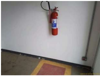
Foto 7 - Extintor de incêndio
