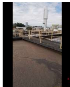
Foto 16 - Tanque de aerção
