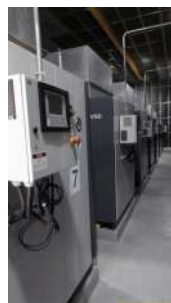
Foto 22 - Sopradores funcionam em revezamento
