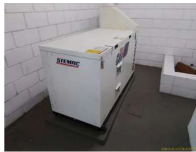
Foto 6 - Gerador da elevatória
