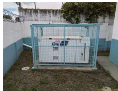
Foto 4 - Gerador de energia elétrica
