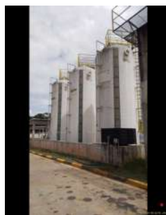
Foto 29 - Tanque de água de reúso e os demais não estão em utilização
