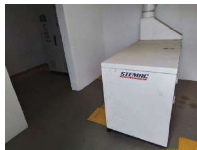
Foto 8 - Gerador de energia elétrica
