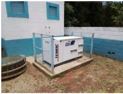
Foto 7 - Gerador de energia elétrica
