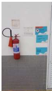
Foto 23 - Extintor de incêndio disponível na sala dos sopradores
