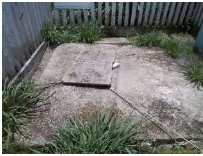
Foto 3 - Acesso ao gradeamento grosseiro e a bomba submersa
