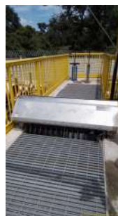
Foto 31 - Tratamento terciário com UV
