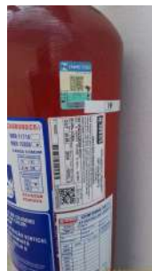
Foto 24 - Detalhe do extintor de incêndio
