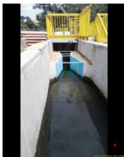
Foto 30 - Macromedidor de saída do efluente tratado
