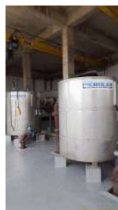
Foto 38 - Equipamentos para utilização futura, após ampliações
