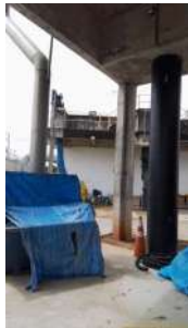
Foto 12 - Caçamba para material retido no gradeamento e tubulação de passagem do efluente
