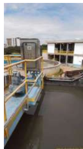
Foto 14 - Painel elétrico do desarenador
