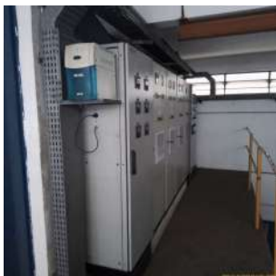
Foto 18 - Painel de Comando e Controle
