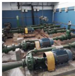
Foto 2 - Vista geral dos barriletes e conjunto motobombas
