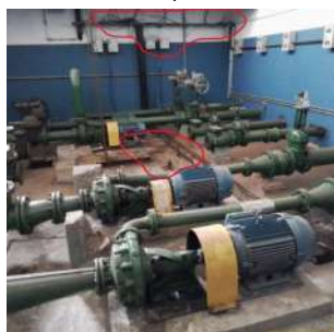
Foto 3 - Fiação exposta, espelhada pelo chão e pela parede (sem conduíte ou eletrocalha).
