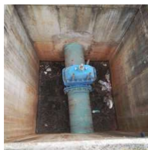
Foto 2 - Caixa de inspeção com lixo
