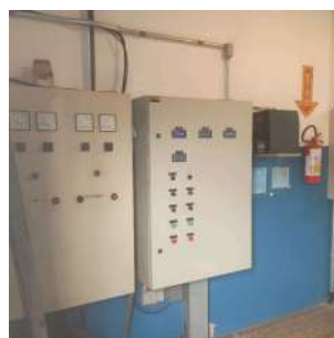
Foto 2 - Painel elétrico e de comando da EEAT.
