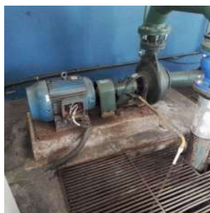
Foto 2 - Fiação elétrica exposta, sem tampa de proteção
