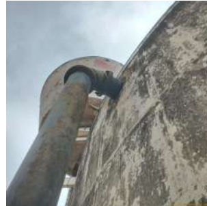
Foto 2 - Tubo extravasor com corrosão.
