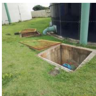
Foto 1 - Tampa de inspeção tomada pela grama
