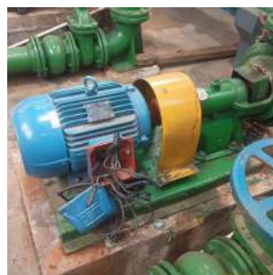
Foto 5 - Conjunto motobomba 1, com fios expostos na caixa de ligação elétrica.
