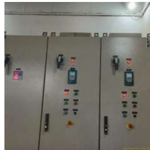
Foto 14 - Painéis elétricos e de comando.
