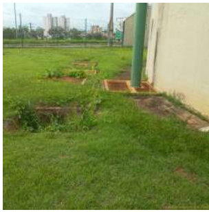
Foto 1 - Caixa de registro sem proteção horizontal.
