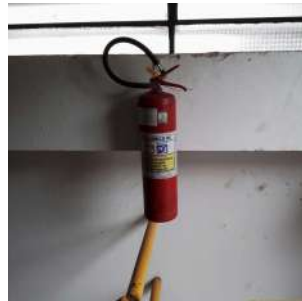
Foto 17 - Extintor de incêndio
