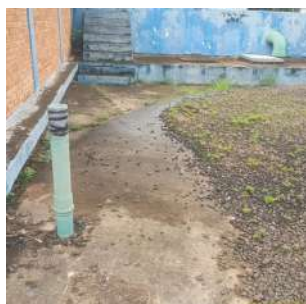
Foto 1 - Tubo de ventilação com extremidade voltada para cima.
