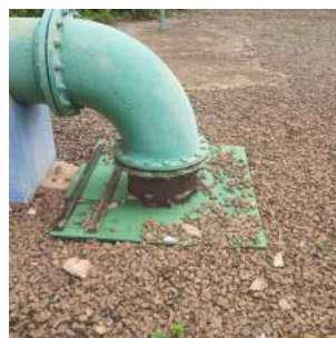
Foto 2 - Tampa com vãos próximos ao piso.
