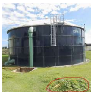
Foto 4 - Tampa de inspeção tomada pelo mato
