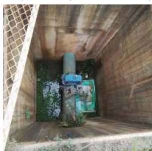
Foto 3 - Caixa de inspeção com lixo e vegetação
