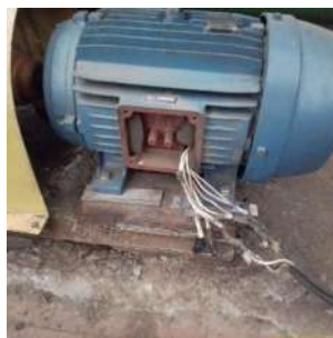
Foto 2 - Fiação exposta, sem tampa da caixa de ligação elétrica do motor.
