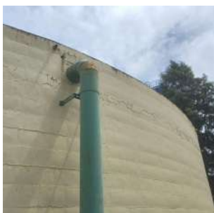
Foto 3 - Trecho do tubo com corrosão.
