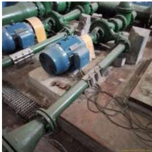
Foto 9 - Vista lateral do conjunto motobomba 1 e 2
