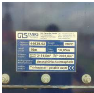
Foto 3 - Placa de especificações técnicas do reservatório.
