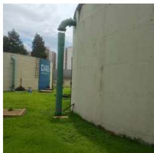
Foto 4 - Tubo extravasor corroído.
