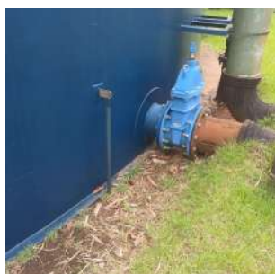
Foto 5 - Sistema de aterramento do reservatório.
