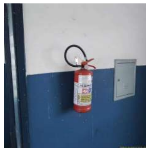
Foto 2 - Extintor de incêndio
