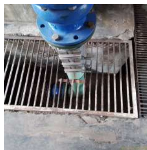
Foto 4 - Drenagem obstruída impedindo o escoamento da água de lubrificação das gaxetas
