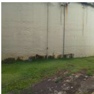
Foto 3 - Vazamento na lateral do reservatório, próximo ao nível do terreno.
