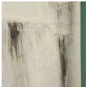
Foto 2 - Vazamento na lateral do reservatório, entre o lodo do DAE e tubulação.
