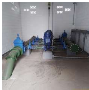
Foto 4 - Vista geral interna da casa de máquinas
