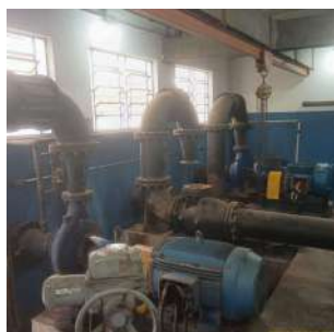
Foto 5 - Conjuntos motobomba da EEAT.
