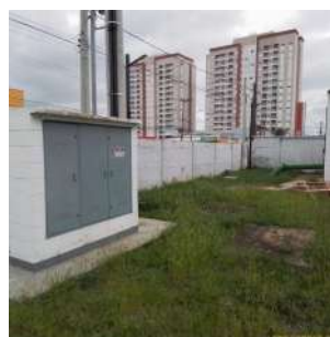
Foto 2 - Vista geral do Centro de Reservação
