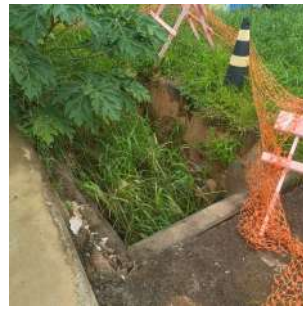
Foto 2 - Vegetação no interior da caixa e ausência de tampa ou proteção.
