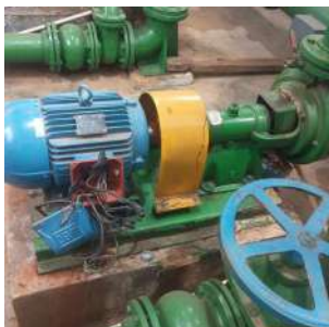
Foto 1 - Motor do conjunto motobomba sem tampa e exposição de fios elétricos.
