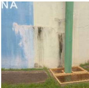
Foto 1 - Vazamento na lateral do reservatório, entre o lodo do DAE e tubulação.
