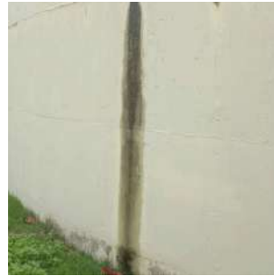
Foto 2 - Vazamento na lateral do reservatório.
