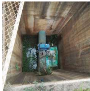
Foto 6 - Caixa de registro.
