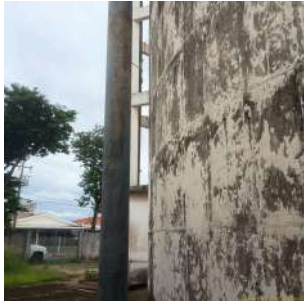
Foto 1 - Tubo extravasor com corrosão.
