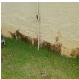
Foto 5 - Vazamento na lateral do reservatório, próximo ao nível do terreno.
