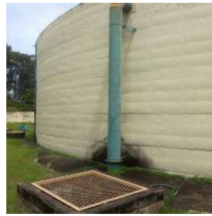
Foto 4 - Vista lateral e tubo extravasor.
