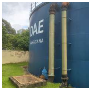
Foto 3 - Tubulação de abastecimento e extravasor do reservatório.
