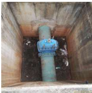
Foto 7 - Caixa de registro.
