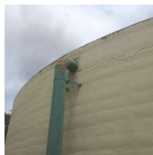
Foto 2 - Trecho do tubo com corrosão.
