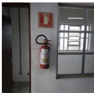
Foto 7 - Extintor de incêndio
