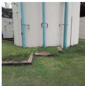
Foto 4 - Conjunto de tubulações do reservatório e tubo extravasor
