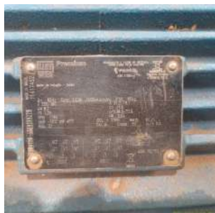
Foto 6 - Placa de especificações técnicas do motor do conjunto 1.
