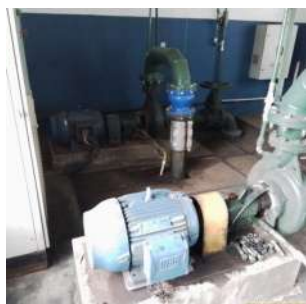
Foto 1 - Conjunto motobomba 2 (ao fundo), sem tampa da caixa de ligação elétrica.
