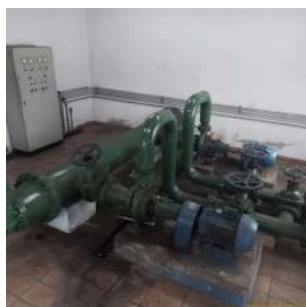
Foto 1 - Área interna da elevatória (barrilete e conjunto motobomba)
