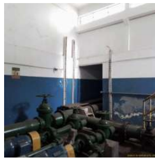
Foto 15 - Vista geral barrilete
