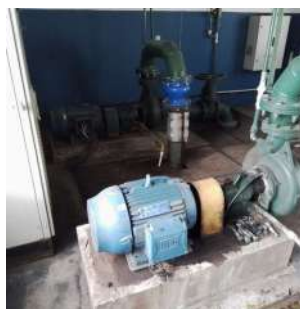
Foto 8 - Conjunto moto bomba e barrilete
