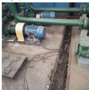
Foto 4 - Fiação exposta, espelhada pelo chão e pela canaleta de drenagem (local inadequado)
