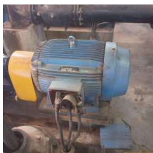
Foto 1 - Situação do motor do conjunto motobomba 1.
