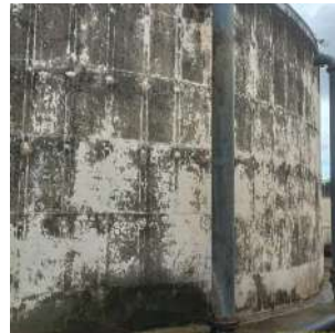
Foto 4 - Tubo extravasor com corrosão.
