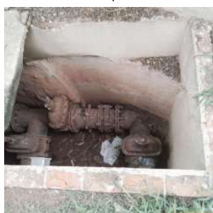
Foto 3 - Caixa de Inspeção de Válvulas Gaveta
