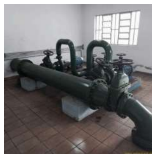
Foto 2 - Área interna da elevatória (barrilete e conjunto motobomba)
