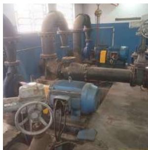
Foto 4 - Vista interna da EEAT.
