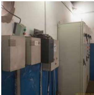
Foto 13 - Painéis elétricos e de comando.
