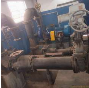
Foto 9 - Conjuntos motobomba da EAT.
