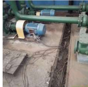
Foto 8 - Vista lateral do conjunto motobomba 3 e 4
