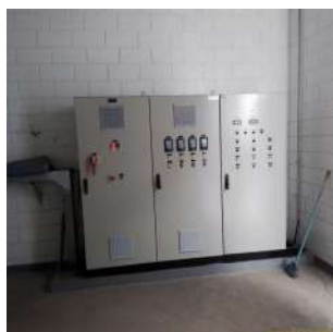
Foto 5 - Painel de Controle e Comando
