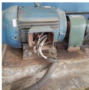
Foto 3 - Fiação elétrica exposta, sem tampa de proteção
