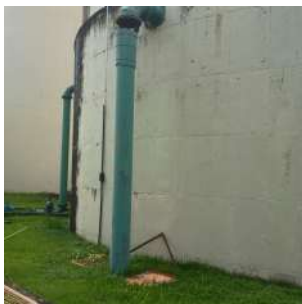
Foto 1 - Tubo extravasor com corrosão.
