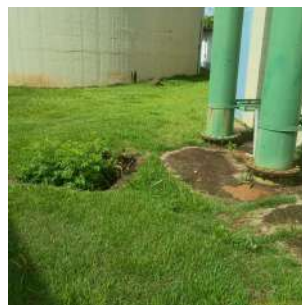
Foto 2 - Caixa de registro sem proteção horizontal.
