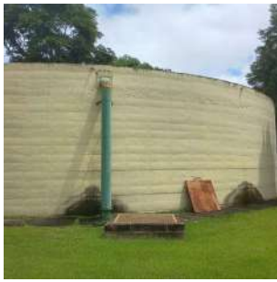
Foto 3 - Vista lateral e tubo extravasor.
