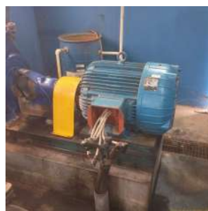
Foto 2 - Situação do motor do conjunto motobomba 2.
