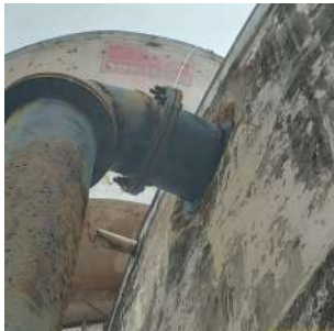
Foto 3 - Detalhe do ponto com corrosão no tubo extravasor.
