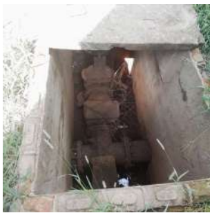
Foto 5 - Caixa de Inspeção de Válvulas Gaveta 2
