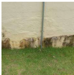
Foto 4 - Vazamento na lateral do reservatório, próximo ao nível do terreno.
