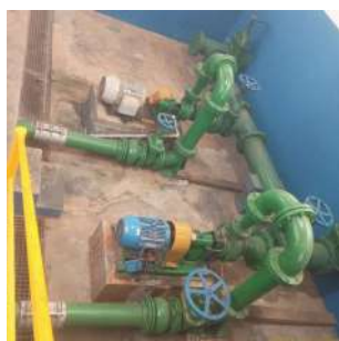
Foto 3 - Conjuntos motobomba, apenas pra recalcar para o reservatório elevado.
