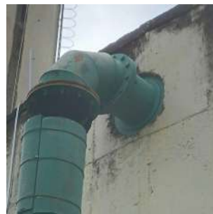
Foto 2 - Tubo extravasor com corrosão.
