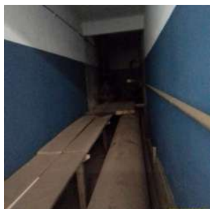
Foto 1 - Local sem iluminação e com passarela inadequada.
