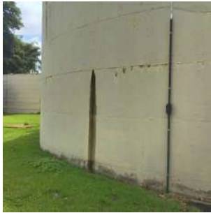
Foto 1 - Vazamento na lateral do reservatório.
