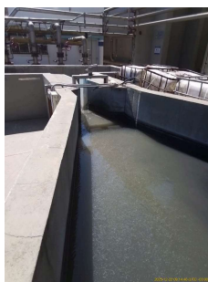
Foto 6 - Calha Parshall com medidor de vazão acoplado na parte superior e área para aplicação de biorremediador.
