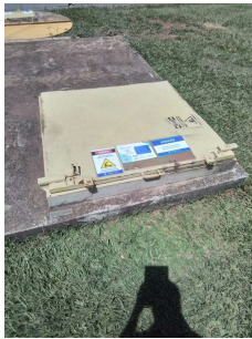
Foto 1 - Ponto de acesso às bombas de recalque.
