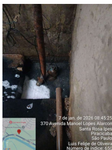
Foto 5 - Bomba de sucção do poço seco. (Foto cedida pelo prestador)
