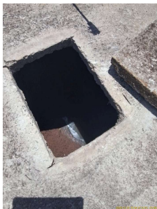
Foto 3 - Entrada do esgoto bruto.
