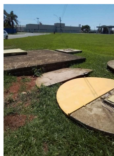
Foto 6 - Vista geral da elevatória.
