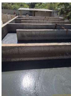
Foto 33 - Tanque de contato.
