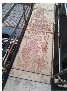
Foto 2 - Passagem entre as câmaras com elevado estado de oxidação.
