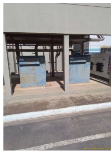
Foto 25 - Conjunto de sopradores.
