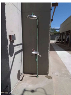
Foto 22 - Chuveiro de emergência.
