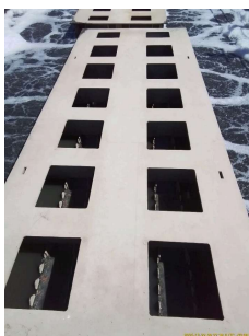
Foto 20 - Detalhe das calhas do decantador, responsáveis pela coleta e direcionamento do efluente clarificado.
