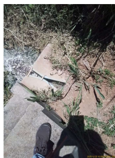
Foto 6 - Lançamento do efluente tratado.
