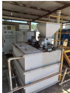
Foto 27 - Equipamento para desidratação de lodo.
