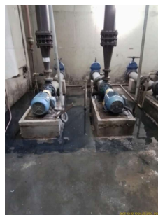
Foto 4 - Acúmulo de água em decorrência de drenagem inadequada.
