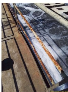
Foto 1 - Guarda-corpo com diversos pontos de oxidação, incluindo áreas com corrosão.
