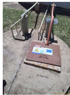
Foto 7 - Tampa de proteção do acesso à bomba submersa e à peneira.
