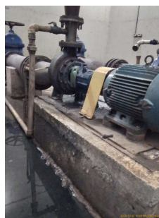
Foto 2 - Acúmulo de água em decorrência de drenagem inadequada.
