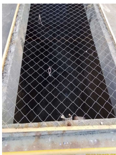
Foto 6 - Entrada de esgoto bruto proveniente da rede de esgotamento sanitário do município.
