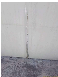
Foto 1 - Vazamento identificado na parede do tanque de contato.
