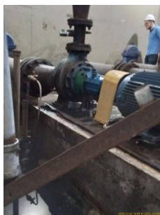
Foto 3 - Acúmulo de água em decorrência de drenagem inadequada.
