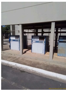
Foto 24 - Conjunto de sopradores.
