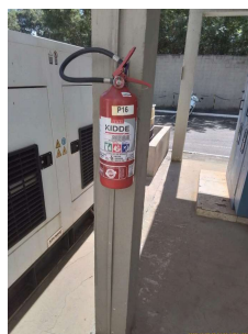
Foto 23 - Extintor próximo aos sopradores.
