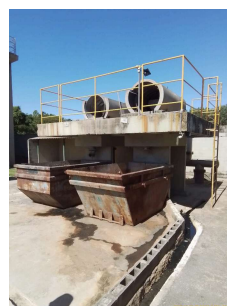
Foto 3 - Centrífugas para secagem de lodo.
