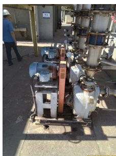
Foto 9 - Motobombas utilizadas no recalque do esgoto bruto para tratamento.
