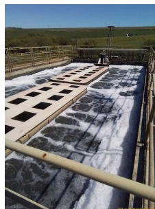
Foto 19 - Câmara de aeração do sistema de lodos ativados, com destaque para a calha central do decantador secundário destinada à coleta do efluente clarificado.
