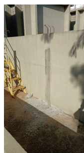
Foto 2 - Vazamento contido pelo prestador. (Foto cedida pelo prestador)
