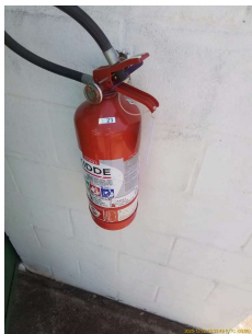
Foto 5 - Extintor de incêndio.
