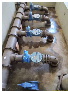
Foto 7 - Linha de recalque.
