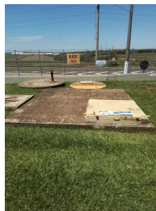
Foto 7 - Vista geral da elevatória.
