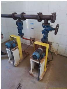
Foto 3 - Conjunto de moto bombas da estação.
