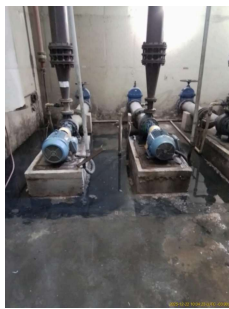
Foto 9 - Conjunto de moto bombas.
