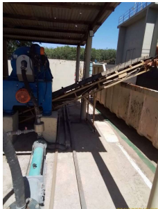
Foto 26 - Equipamento para desidratação de lodo.
