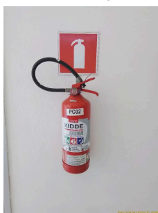
Foto 13 - Extintor localizado no interior do prédio.
