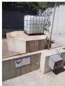
Foto 32 - Tanque de hipoclorito de sódio, utilizado para desinfecção do efluente antes do lançamento no rio.
