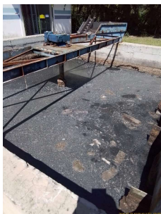
Foto 4 - Esgoto bruto proveniente de fossas, recebido por meio de caminhões limpa-fossa.
