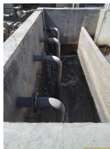
Foto 8 - Sistema de recalque do esgoto bruto para as câmaras de tratamento.
