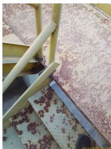
Foto 5 - Escada de acesso ao topo das câmaras de tratamento apresenta elevado grau de oxidação.
