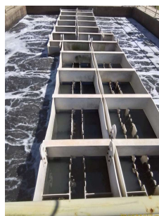
Foto 21 - Vista geral das câmaras de tratamento, onde ocorre a remoção de sólidos e a estabilização do efluente.
