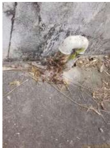
Foto 1 - Tubulação de ventilação sem proteção.
