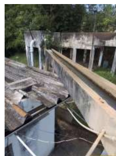
Foto 11 - Passagem da água bruta para início do tratamento.
