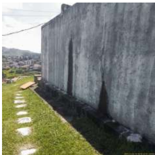
Foto 5 - Vazamento na parede lateral do reservatório.
