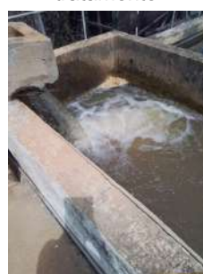
Foto 13 - Entrada da água no floculador.
