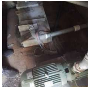
Foto 3 - Fiação ao redor da moto bomba.
