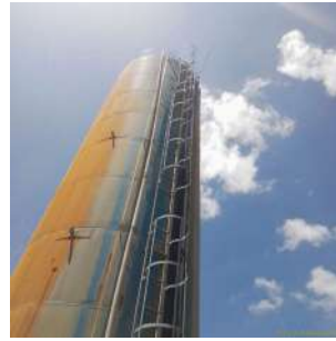
Foto 2 - Vazamento constatado na tubulação durante a vistoria.
