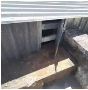
Foto 1 - Abertura na lateral do reservatório.
