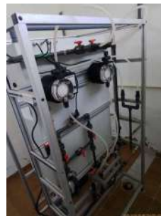
Foto 27 - Equipamento onde ocorre a eletrólise para produção de hipoclorito.
