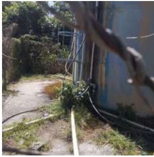
Foto 1 - Acúmulo de água na base do reservatório, decorrente do vazamento constatado no dia da vistoria.
