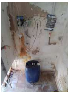
Foto 1 - Tanque de ácido fluossilícico e bomba dosadora.
