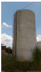
Foto 1 - A escada de acesso ao topo do Reservatório 1 não possui protetor circular, e há ausência de guarda-corpo no topo da estrutura.
