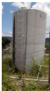
Foto 2 - A escada de acesso ao topo do Reservatório 2 não possui protetor circular, e há ausência de guarda-corpo no topo da estrutura.
