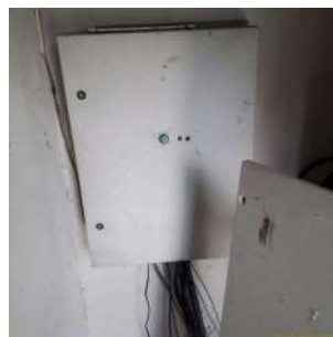
Foto 2 - Painel elétrico e fiação expostos.
