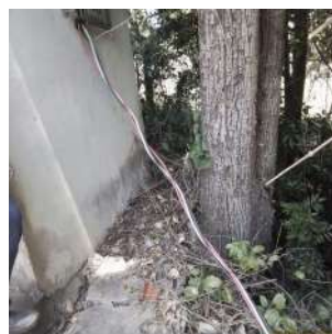
Foto 3 - Na janela da edificação onde se encontra o painel elétrico, observa-se emaranhado de fios saindo sem qualquer tipo de proteção, condição que pode ocasionar acidentes e facilitar a ocorrência de furtos.
