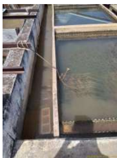
Foto 1 - Colméia do decantador solta, permitindo a passagem de matéria em suspensão pelas canaletas.
