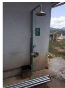
Foto 10 - Chuveiro de emergência.
