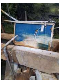
Foto 12 - Ponto de adição de produtos químicos. Neste local é realizada a dosagem de barrilha
