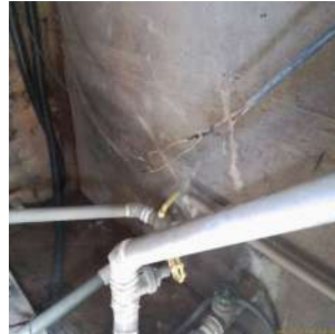
Foto 2 - Fiação ao redor da moto bomba.
