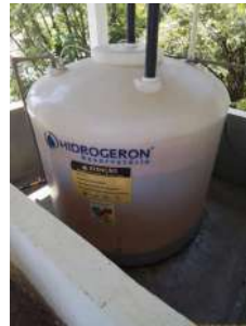
Foto 25 - Tanque de hipoclorito de sódio, produzido por eletrólise.
