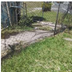
Foto 1 - Abertura na cerca de proteção do reservatório.
