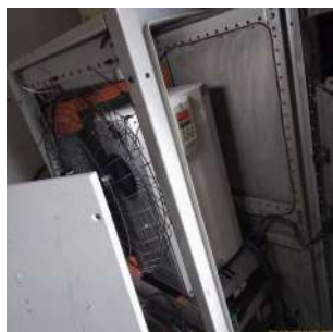
Foto 1 - Painel elétrico sendo resfriado por um ventilador doméstico.
