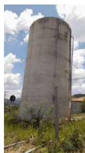
Foto 2 - Ausência de cercamento em torno dos reservatórios.
