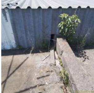
Foto 3 - Abertura na lateral do reservatório.
