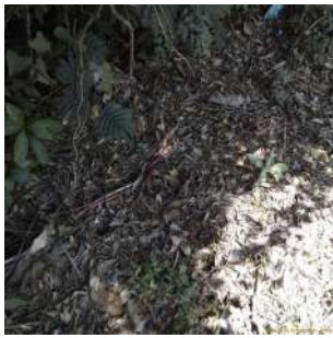
Foto 4 - A fiação percorre todo o terreno, encontrando-se na superfície e sem proteção adequada.
