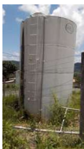
Foto 1 - Ausência de cercamento em torno dos reservatórios.
