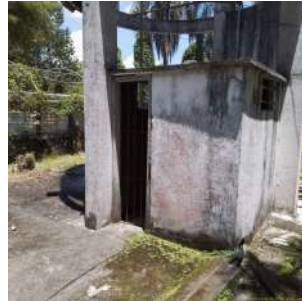
Foto 4 - Entrada para a sala dos painéis elétricos.
