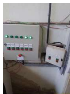
Foto 30 - Painel elétrico das bombas dosadoras de sulfato de alumínio e barrilha
