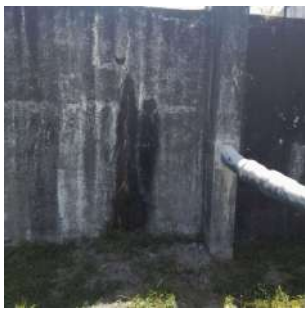
Foto 3 - Vazamento na parede lateral do reservatório.
