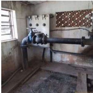
Foto 3 - Tubulação de recalque destinada ao transporte da água para o tratamento.
