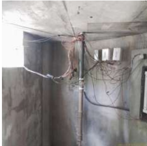
Foto 1 - Fiação exposta na sala em que os painéis elétricos da estação elevatória estão instalados.
