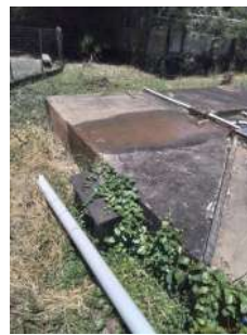
Foto 2 - Acúmulo de água na superfície, com escoamento pela lateral.
