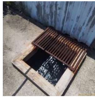
Foto 2 - Entrada de água do reservatório sem proteção adequada.
