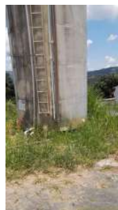
Foto 6 - Tubulação de entrada/saída de água no reservatório 1.
