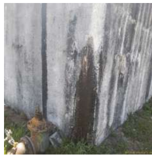
Foto 4 - Vazamento na parede lateral do reservatório.
