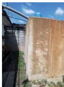
Foto 22 - A água tratada segue para este pequeno reservatório, onde são realizadas as etapas de cloração e fluoretação. Em seguida, a água é direcionada para o reservatório principal e para a estação elevatória para recalque.
