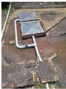
Foto 1 - Entrada de água, onde ocorre extravasamento.
