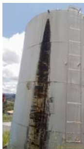
Foto 1 - Vazamento de água aparente pelo tubo extravasor.
