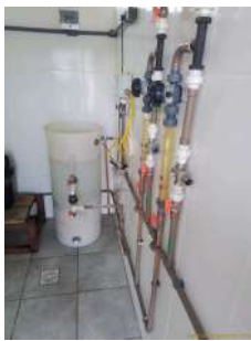
Foto 23 - Área destinada à produção de hipoclorito de sódio por eletrólise, utilizando solução de salmoura. Todos os equipamentos e a manutenção são realizados por uma empresa especializada.
