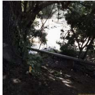
Foto 4 - Tubulação para condução da água bruta em direção às bombas.
