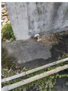
Foto 1 - Tubulação de ventilação.
