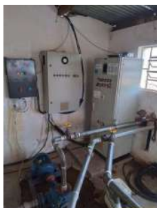
Foto 3 - Vista do interior da estação elevatória presente dentro da ETA.
