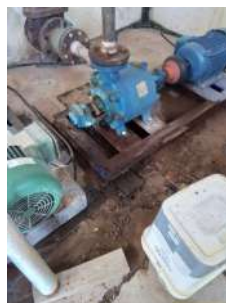
Foto 4 - Conjunto de moto bombas.
