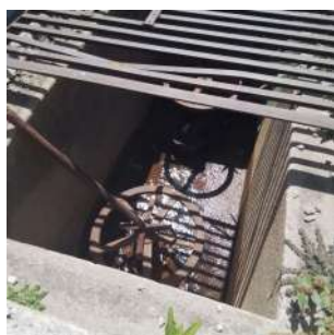
Foto 1 - Vazamento nos registros.
