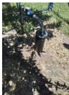
Foto 4 - Laje de proteção e tubo de nível.
