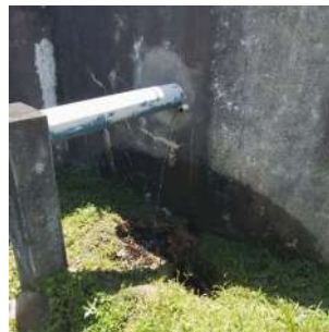
Foto 6 - Abertura destinada ao escoamento da água excedente proveniente de vazamento em um dos registros.
