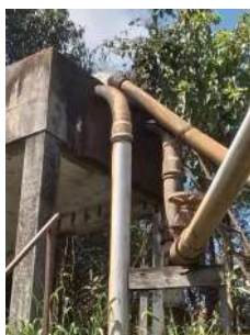
Foto 9 - Entrada de água bruta na estação de tratamento de água.
