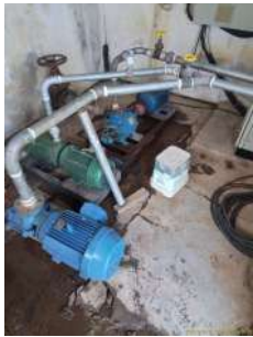
Foto 1 - Acúmulo de água em decorrência de drenagem inadequada.
