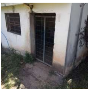
Foto 1 - Área sem identificação.
