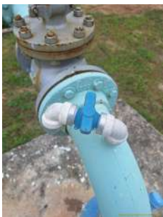
Foto 3 - Tomada de água para coleta de água bruta
