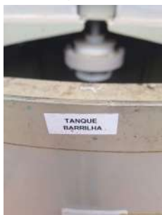
Foto 5 - Tanque de preparo e armazenamento de barrilha
