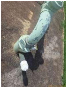
Foto 3 - Tubo medidor de nível
