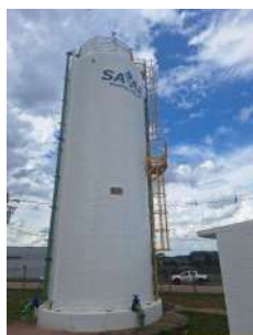
Foto 3 - Reservatório com logo do prestador de serviços
