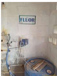
Foto 5 - Dosagem de flúor
