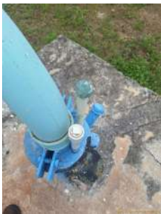
Foto 2 - Tubo medidor de nível
