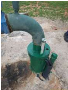
Foto 3 - Tubo medidor de nível
