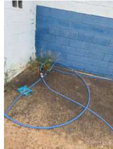
Foto 6 - Tubos para dosagem de produtos químicos
