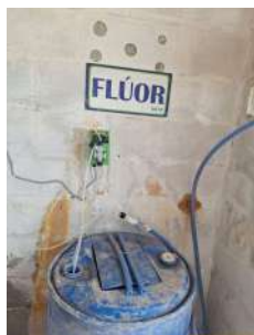
Foto 7 - Dosagem de flúor
