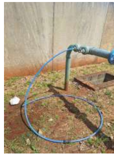
Foto 6 - Tomada de água para coleta de água bruta
