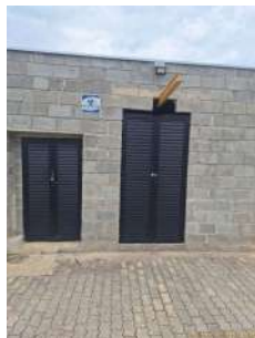
Foto 3 - Face externa do abrigo da casa de bombas e poço de sucção sem ventilação adequada (3)
