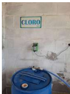
Foto 8 - Dosagem de cloro
