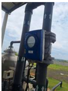
Foto 19 - Conversor de macromedidor - saída
