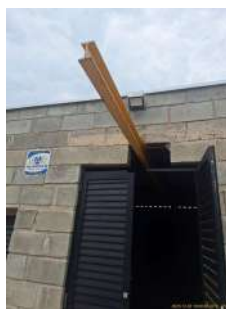
Foto 4 - Içamento monovia para manutenção dos conjuntos motobomba
