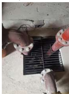
Foto 6 - Poço de sucção
