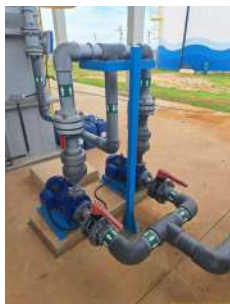
Foto 3 - Conjuntos motobomba para recalque de água bruta
