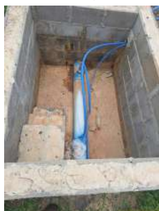
Foto 9 - Linha de dosagem dos produtos químicos
