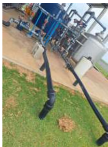
Foto 16 - Tubulação de entrada de água para retrolavagem e saída de água tratada para reservatório
