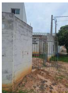
Foto 8 - Portão de entrada sem identificação de área
