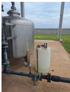
Foto 15 - Dosagem de flúor
