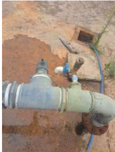
Foto 5 - Tomada de água para coleta de água bruta
