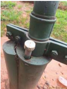
Foto 2 - Tubo medidor de nível
