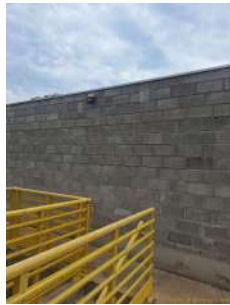
Foto 1 - Face externa do abrigo da casa de bombas e poço de sucção sem ventilação adequada (1)
