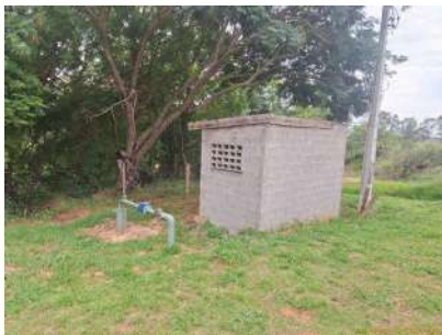
Foto 1 - Ausência de cercamento
