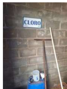
Foto 4 - Casa de química - dosagem de cloro
