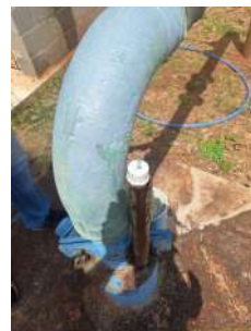
Foto 4 - Tubo medidor de nível
