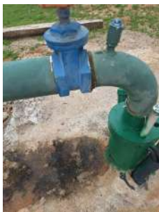
Foto 1 - Chão molhado evidenciando pequeno vazamento nas peças hidráulicas
