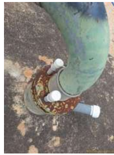
Foto 4 - Tubo medidor de nível
