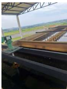
Foto 17 - Visão de cima da ETA compacta - floculadores e decantador
