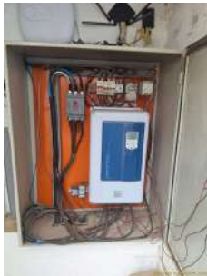
Foto 7 - Painel com inversor de frequência
