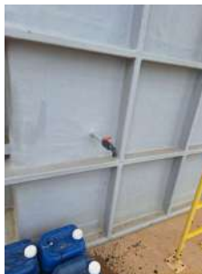
Foto 10 - Ponto de coleta no decantador
