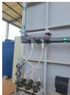
Foto 4 - Bombas peristálticas dosadoras para pré-oxidação, barrilha e PAC
