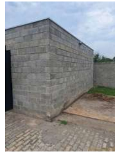
Foto 2 - Face externa do abrigo da casa de bombas e poço de sucção sem ventilação adequada (2)
