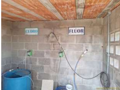
Foto 7 - Dosagem de cloro e flúor
