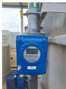
Foto 18 - Conversor de macromedidor - entrada
