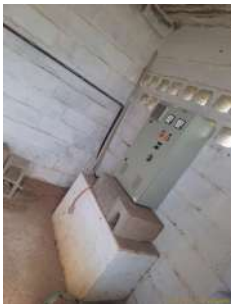
Foto 5 - Painel elétrico do conjunto
