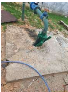
Foto 7 - Laje de proteção e tubo medidor de nível
