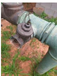
Foto 1 - Registro sem manopla pra manobra de abertura
