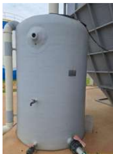
Foto 12 - Tanque de equalização da água decantada
