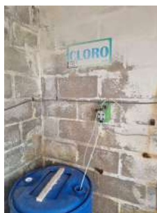
Foto 6 - Dosagem de cloro
