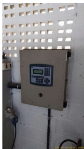
Foto 1 - Display de telemetria, situado dentro da casa de bombas
