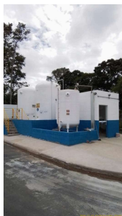
Foto 8 - Tanques para armazenamento de produtos químicos utilizados no tratamento.
