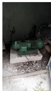
Foto 2 - Bomba da elevatória.
