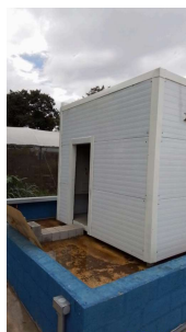
Foto 13 - Modulo de armazenamento e dosagem de Dióxido de cloro, utilizado na pré cloração
