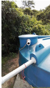
Foto 3 - Tubulação de alimentação do reservatório, a partir de elevatória situado junto ao Reservatório Batovi . Observa-se extravasamento
