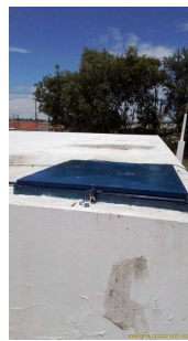
Foto 5 - Tampa de inspeção bem conservada.
