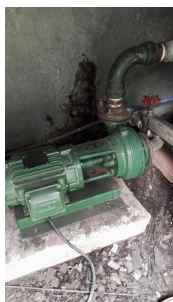
Foto 3 - Bomba da elevatória.
