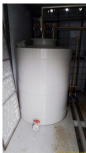
Foto 14 - Armazenamento de dióxido de cloro, utilizado na pré cloração
