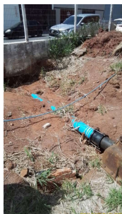
Foto 8 - Tubulação de saída.
