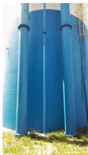
Foto 4 - Tubulações do reservatório.
