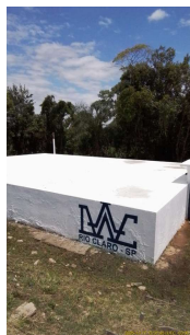
Foto 1 - Visão geral do reservatório. Foi realizada manutenção no reservatório, envolvendo tratamento de fissuras, impermeabilização e pintura.
