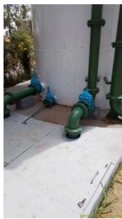
Foto 4 - Tubulações de saída e alimentação do reservatório.
