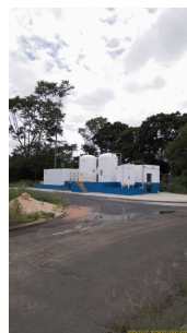
Foto 7 - Novo local para armazenamento e dosagem de produtos químicos.
