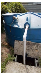
Foto 1 - Vazamento no extravasor.
