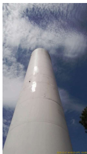
Foto 6 - Nesta foto observa-se reparos executados para combater vazamentos existentes anteriormente.
