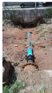
Foto 9 - Tubulação de saída.
