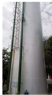
Foto 2 - Visão geral do reservatório, que passou por reformas envolvendo o tratamento de aberturas e fissuras, impermeabilização e pintura. Observa-se remendos executados onde havia pontos de vazamentos.
