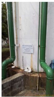
Foto 1 - Placa de identificação do reservatório. Apesar da indicação na placa, trata-se apenas de reservatório.
