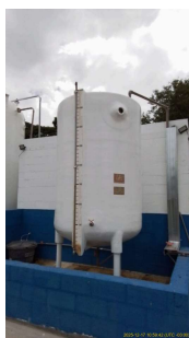
Foto 10 - Armazenamento de Flúor
