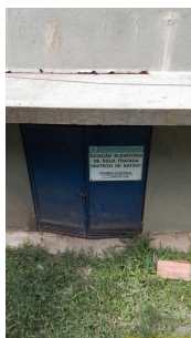
Foto 7 - Elevatória situada junto ao reservatório.
