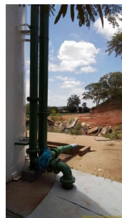
Foto 2 - Ausência de cerca no perímetro. De acordo com funcionário do DAAE, a cerca foi removida por obras de loteamento que estão sendo iniciadas ao lado.
