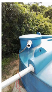
Foto 1 - Necessário instalar tela de proteção no extravasor.
