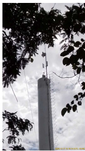
Foto 5 - Para-raios na cobertura
