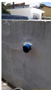
Foto 1 - Necessário instalar tela de proteção
