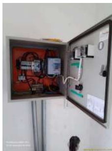
Foto 11 - Quadro de comando elétrico da unidade.
