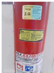
Foto 2 - Extintor de incêndio disponível na unidade, com prazo para manutenção vencido em
