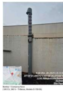
Foto 2 - Bomba reserva para captações subterrâneas, mantida em estoque na garagem municipal. Registro fotográfico apresentado pelo Prestador.
