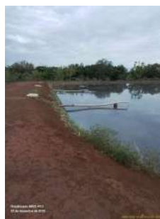
Foto 13 - Entrada de efluente na terceira lagoa da ETE.
