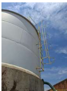
Foto 3 - Escadas e guarda corpos instalados no reservatório.
