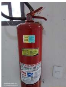
Foto 1 - Extintor de incêndio disponível na unidade, com prazo para manutenção vencido em
