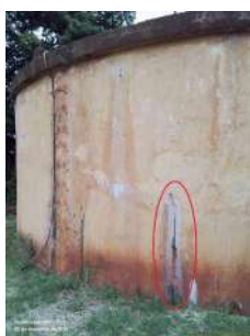
Foto 3 - Vazamento na estrutura do reservatório.
