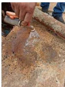
Foto 4 - Torneira para captação de água bruta.
