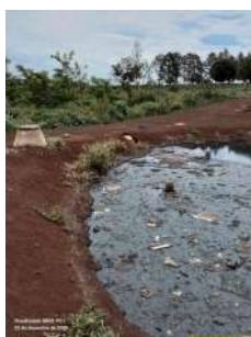
Foto 7 - As duas lagoas anaeróbicas apresentam acúmulo de resíduos na superfície.
