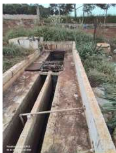
Foto 5 - Crescimento de vegetação junto à estrutura de alvenaria do tratamento preliminar.
