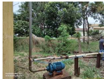
Foto 11 - Bomba para recalque de água do reservatório fiscalizado para outra unidade de reservação, atualmente inativa.
