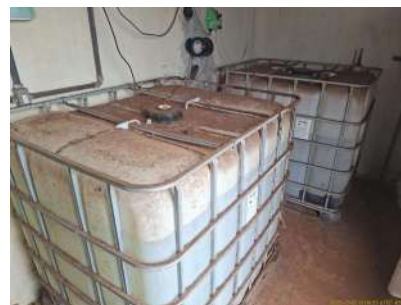
Foto 9 - Reservatório dos produtos químicos utilizados no tratamento da água.
