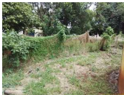
Foto 2 - Trecho do cercamento da área colapsando.
