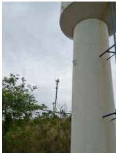
Foto 5 - Manchas descendentes indicando escoamento de água a partir da parte superior do reservatório.
