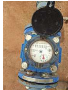
Foto 6 - Macromedidor instalado na captação.
