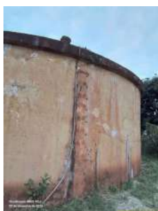
Foto 1 - Ponto onde antes havia uma escada.
