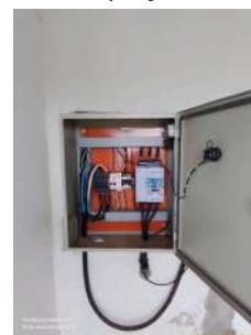
Foto 8 - Quadro de comando elétrico instalado na unidade.
