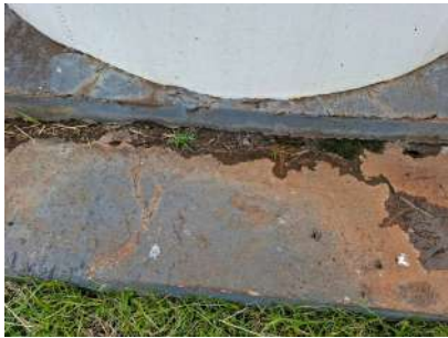
Foto 2 - Vazamento identificado no reservatório.
