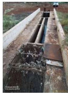
Foto 5 - Gradeamento primário e caixa de desarenação, na entrada da ETE.
