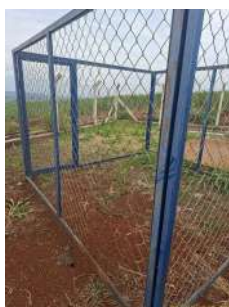
Foto 1 - Cercamento metálico para o poço, fora de posição.
