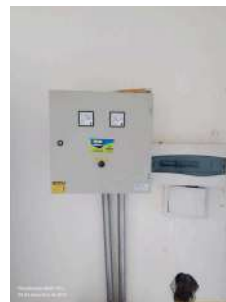
Foto 10 - Quadro de comando elétrico da unidade.
