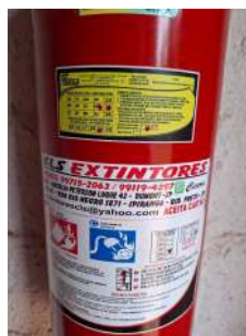
Foto 2 - Extintor de incêndio disponível na unidade, com prazo para manutenção vencido em 08/2025.
