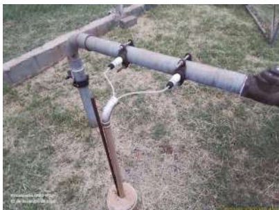
Foto 7 - Pontos para adição de reagentes químicos utilizados no tratamento da água.
