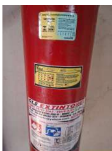
Foto 1 - O extintor de incêndio disponível na unidade está com a manutenção vencida em 08/2025.
