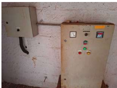
Foto 8 - Quadro de comando elétrico instalado na unidade.
