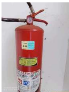
Foto 1 - Extintor disponível na unidade apresenta prazo de validade de manutenção vencido.
