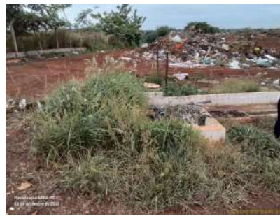
Foto 2 - Área de transbordo de resíduos sólidos adjacente ao tratamento preliminar da ETE, não existindo nenhum tipo de separação entre a ETE e essa área.
