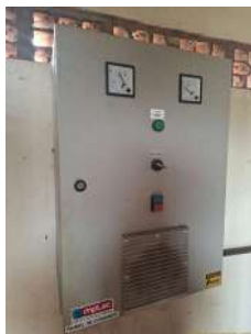
Foto 10 - Quadro de comando elétrico da unidade.
