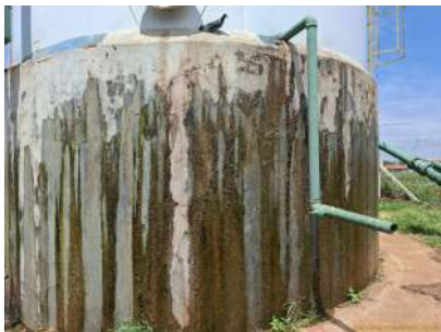
Foto 2 - Vazamentos no reservatório
