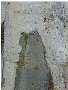
Foto 4 - Vazamentos no reservatório
