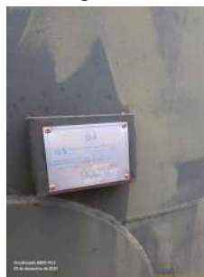
Foto 10 - Placa indicando capacidade do reservatório.
