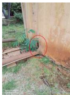
Foto 2 - Vazamento na estrutura do reservatório.
