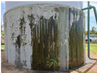
Foto 3 - Vazamentos no reservatório
