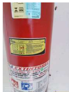
Foto 2 - Extintor disponível na unidade apresenta prazo de validade de manutenção vencido.
