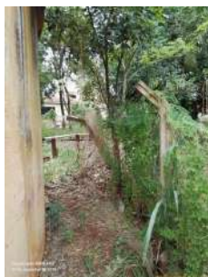
Foto 1 - Trecho do cercamento da área colapsando.
