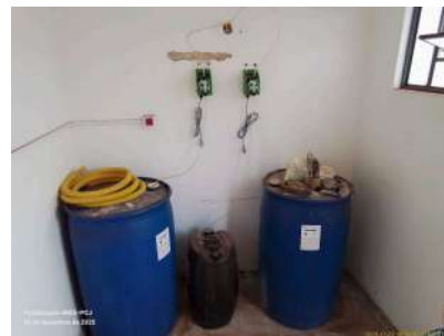
Foto 8 - Reservatório de reagentes químicos e bombas dosadoras dispostos no interior de edificação existente na unidade.
