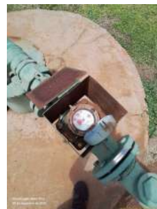
Foto 10 - Macromedidor da captação.
