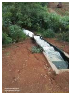
Foto 15 - Canal de alvenaria para aeração e condução do efluente final ao corpo receptor.
