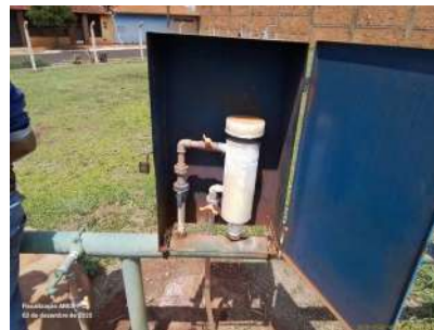
Foto 8 - Dosador de cloro e flúor (pastilhas) da captação.
