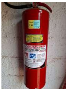
Foto 1 - Extintor de incêndio disponível na unidade, com prazo para manutenção vencido em 08/2025.
