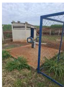
Foto 2 - Cercamento metálico para o poço, fora de posição.
