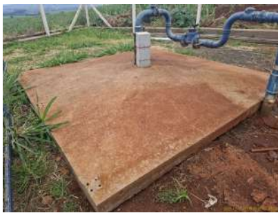
Foto 3 - Vista geral da captação.
