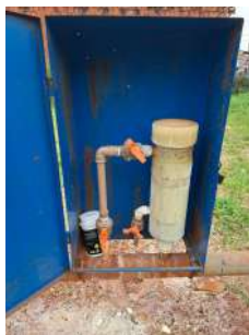
Foto 6 - Equipamento dosador de reagentes para tratamento da água captada.
