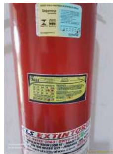
Foto 2 - Extintor de incêndio com validade vencida.
