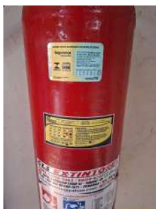
Foto 3 - O extintor de incêndio disponível na unidade está com a manutenção vencida em 08/2025.
