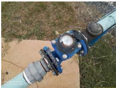
Foto 5 - Macromedidor instalado na captação.
