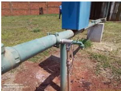
Foto 7 - Torneira para coleta de água bruta da captação.
