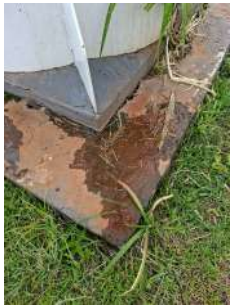
Foto 1 - Vazamento identificado no reservatório.
