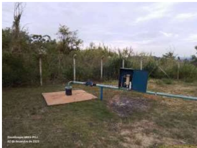
Foto 3 - Vista geral da captação.
