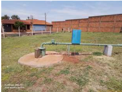
Foto 5 - Vista geral da captação.
