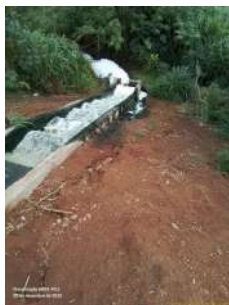
Foto 1 - Vazamento existente no canal que conduz o efluente final ao corpo receptor.
