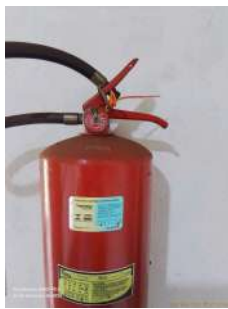
Foto 1 - Extintor de incêndio com validade vencida.
