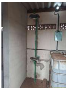
Foto 8 - Chuveiro de emergência instalado no abrigo dos produtos químicos.
