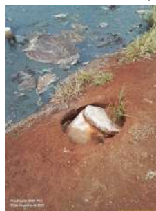
Foto 4 - Caixa de passagem na saída de uma das lagoas colapsou devido à movimentação do terreno (possível vazamento/infiltração).
