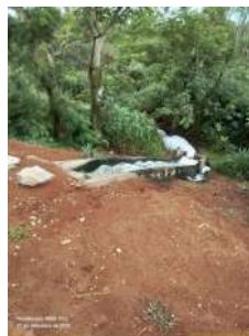
Foto 2 - Vazamento existente no canal que conduz o efluente final ao corpo receptor.
