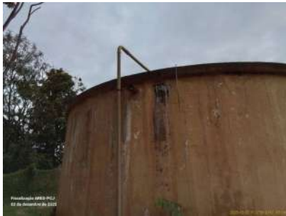
Foto 7 - Tubulação de exaustão próximo ao topo do reservatório.
