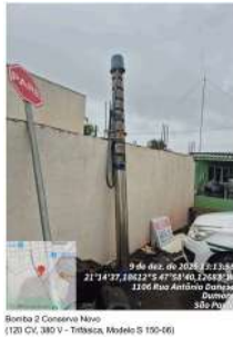
Foto 3 - Bomba reserva para captações subterrâneas, mantida em estoque na garagem municipal. Registro fotográfico apresentado pelo Prestador.
