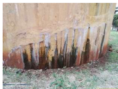
Foto 4 - Vazamento na estrutura do reservatório.
