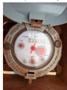
Foto 5 - Macromedidor instalado na captação.
