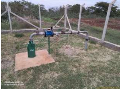
Foto 3 - Vista geral da captação.
