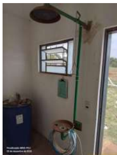
Foto 9 - Chuveiro de emergência instalado próximo aos produtos químicos utilizados no tratamento.
