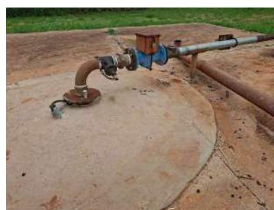
Foto 2 - Vista geral da captação.
