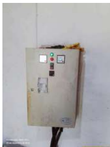
Foto 9 - Pannel de comando da unidade.
