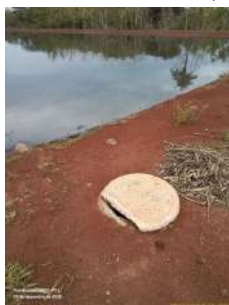
Foto 3 - Caixa de passagem com tampa danificada.
