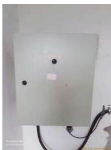
Foto 9 - Quadro de comando elétrico instalado na unidade.
