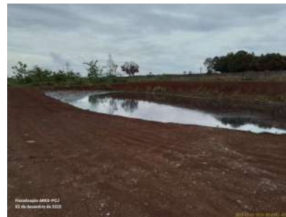
Foto 7 - Lagoa anaeróbica à direita, vista a partir do tratamento primário, em paralelo à outra lagoa anaeróbica.
