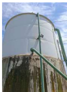
Foto 4 - Tubulações de alimentação e de saída do reservatório.
