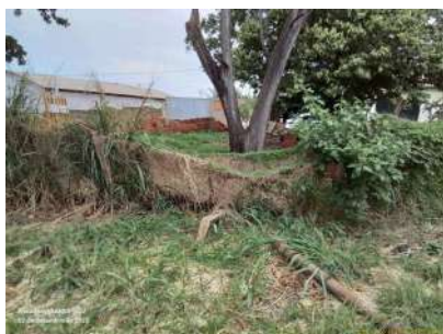
Foto 3 - Trecho do cercamento da área colapsando.
