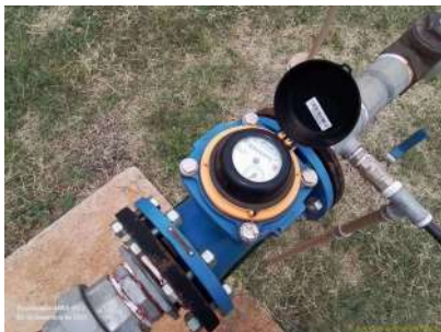
Foto 5 - Macromedidor instalado na captação.
