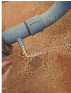
Foto 5 - Torneira para coleta de água bruta da captação.
