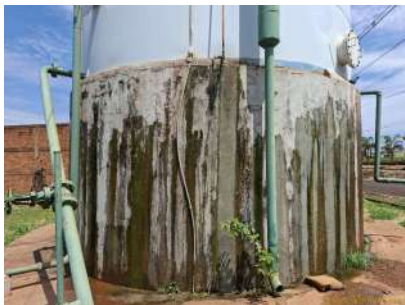
Foto 1 - Vazamentos no reservatório.
