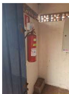
Foto 2 - O extintor de incêndio disponível na unidade está com a manutenção vencida em 08/2025.
