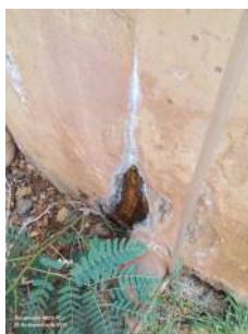
Foto 1 - Vazamento na estrutura do reservatório.
