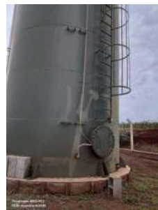
Foto 4 - Vista da base do reservatório, evidenciando mangueira para medição de nível.
