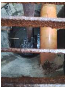
Foto 6 - Gradeamento na entrada do efluente
