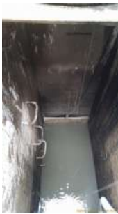
Foto 6 - Entrada da água bruta
