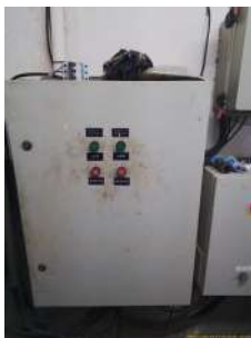
Foto 5 - Painéis elétricos da elevatória
