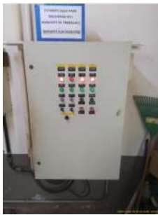
Foto 5 - Painel elétrico da elevatória
