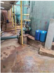
Foto 5 - Base e válvulas do reservatório
