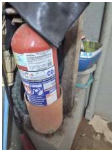
Foto 7 - Extintor de incêndio disponível
