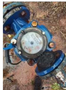
Foto 3 - Medidor instalado no poço
