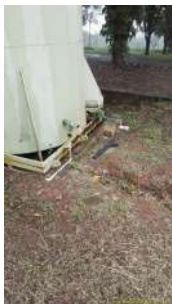
Foto 3 - Tubulação desconectada - Reservatório desativado
