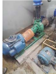
Foto 4 - Sistema de bombeamento
