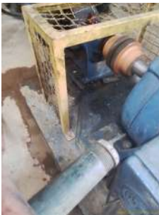
Foto 1 - Executar a drenagem adequada da lubrificação das gaxetas
