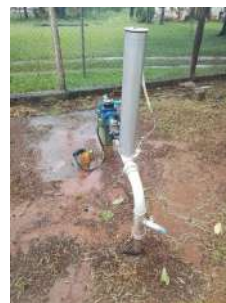
Foto 5 - Torneira de captação de água para análise
