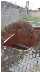
Foto 1 - O local encontrava-se em obras/manutenção, com a presença de um buraco aberto, sendo necessária a colocação de proteção adequada ou o fechamento da área.
