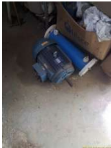
Foto 7 - Bomba reserva disponível no local
