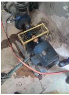
Foto 1 - Bomba em utilização na elevatória
