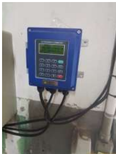
Foto 9 - Medidor de vazão
