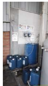
Foto 15 - Dosadores e estoque de produtos químicos
