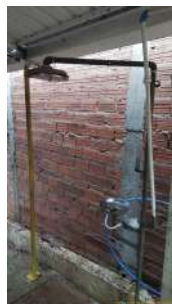
Foto 14 - Chuveiro emergência (em funcionamento)
