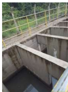
Foto 8 - Entrada da água nos tanques de aeração e decantação
