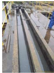
Foto 12 - Tanque de contato
