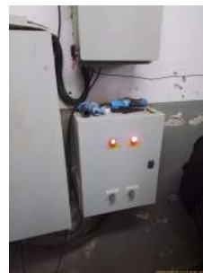
Foto 6 - Painéis elétricos da elevatória
