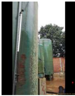
Foto 10 - Reservatório, filtro e decantador
