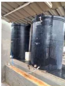
Foto 5 - Tanques de hipoclorito
