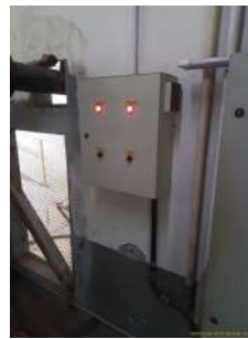
Foto 6 - Painel elétrico da elevatória
