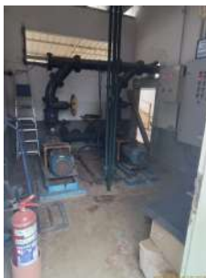
Foto 9 - Estação elevatória de água tratada
