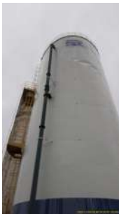
Foto 4 - Reservatório novo com amassado na lateral, prestador informou que foi acianada empresa para fazer a avaliação e não impacta no funcionamento do reservatório
