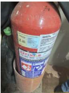
Foto 1 - Extintor de incêndio com manutenção prevista para maio/2024
