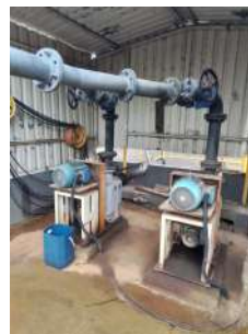
Foto 17 - Estação elevatória que bombeia o efluente para o tratamento
