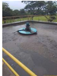
Foto 13 - Tanque em decantação
