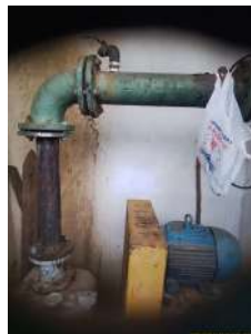
Foto 3 - Bomba em funcionamento
