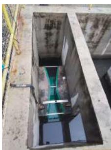
Foto 7 - Calha Parshall na entrada do tratamento
