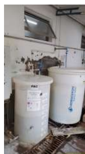
Foto 7 - Dosador cloro e PAC
