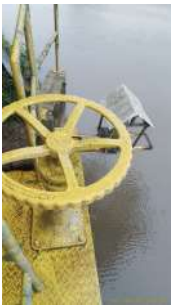
Foto 2 - Ponto de captação
