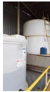
Foto 11 - Reservatórios de produtos químicos
