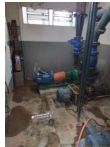
Foto 8 - Instalações da estação elevatória
