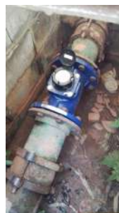
Foto 9 - Macromedidor de saída
