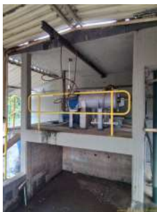
Foto 16 - Centrífuga sem funcionar (lodo transportado para ETE Mogi para seguir com a secagem adequada)
