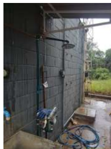
Foto 6 - Chuveiro de emergência em funcionamento
