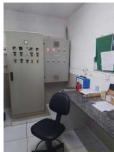
Foto 4 - Painéis elétricos no reservatório
