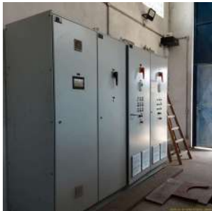
Foto 1 - Painéis elétricos da elevatória.
