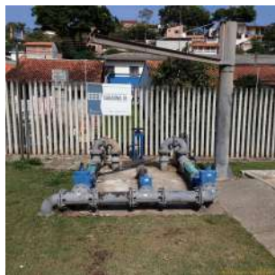
Foto 1 - Vista geral da elevatória.
