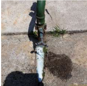
Foto 5 - Torneira para coleta de água bruta.
