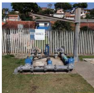
Foto 1 - Vista geral da elevatória.
