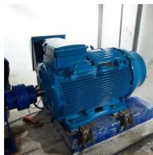
Foto 7 - Detalhe do motor do conjunto motobomba 2.
