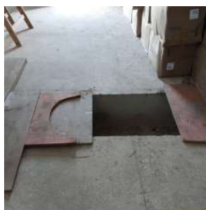
Foto 2 - Abertura no piso em frente ao painel elétrico.
