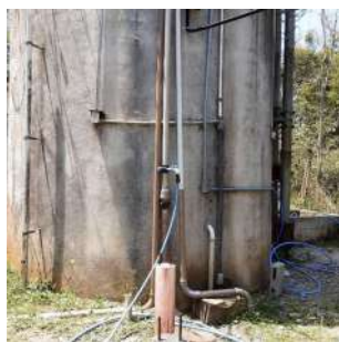
Foto 13 - Detalhe da tubulação de chegada da água captada no Poço Bela Vista I, é possível visualizar o ponto de aplicação de flúor na água bruta (a cloração é realizada na área onde o poço está instalado).
