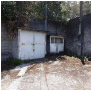
Foto 6 - Abrigo do painel elétrico do poço.
