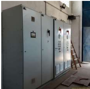
Foto 1 - Painéis elétricos da elevatória.
