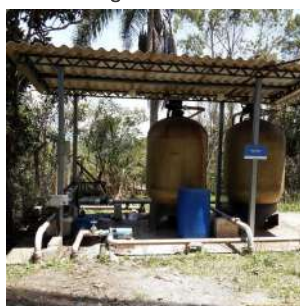
Foto 12 - Filtros empregados para remoção de ferro e manganês da água captada no Poço Boa Vista II.
