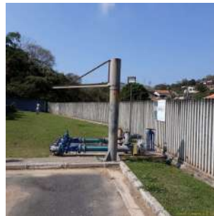
Foto 4 - Vista geral da elevatória.
