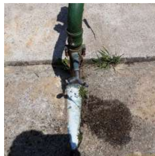
Foto 5 - Torneira para coleta de água bruta.
