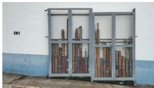
Foto 10 - Bombas reserva dos poços.
