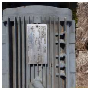
Foto 3 - Detalhe do motor do conjunto moto bomba em funcionamento.
