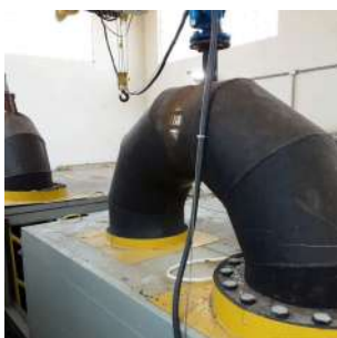
Foto 8 - Tubulações sobre a estrutura de isolamento acústico.
