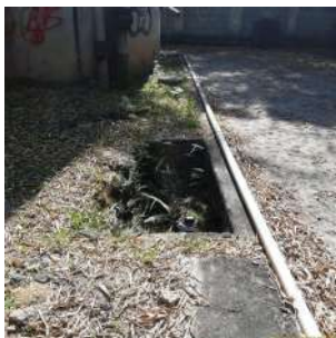
Foto 1 - Abertura no piso próximo ao reservatório.
