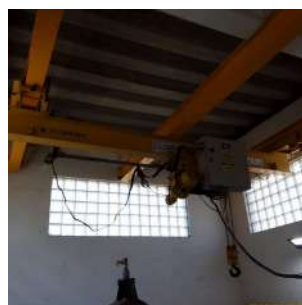
Foto 9 - Talha utilizada para içamento das bombas.
