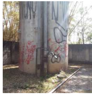
Foto 4 - Tubulações de entrada e saída de água no reservatório.
