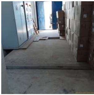
Foto 3 - Abertura no piso próxima ao painel elétrico.
