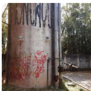
Foto 1 - Detalhe do fio do para raios partido.
