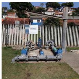
Foto 1 - Vista geral da elevatória.
