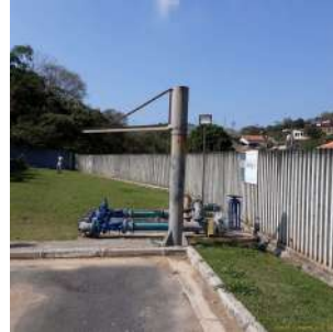
Foto 4 - Vista geral da elevatória.
