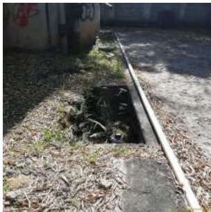
Foto 1 - Abertura no piso próximo ao reservatório.
