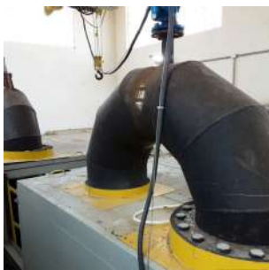
Foto 8 - Tubulações sobre a estrutura de isolamento acústico.
