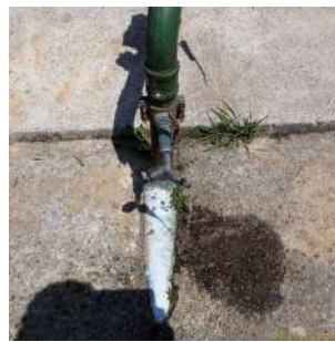
Foto 5 - Torneira para coleta de água bruta.
