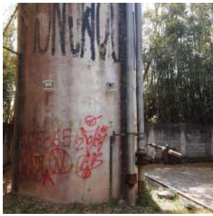
Foto 1 - Detalhe do fio do para raios partido.
