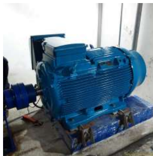
Foto 7 - Detalhe do motor do conjunto motobomba
