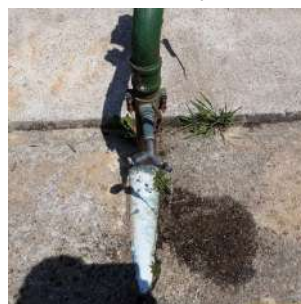
Foto 5 - Torneira para coleta de água bruta.
