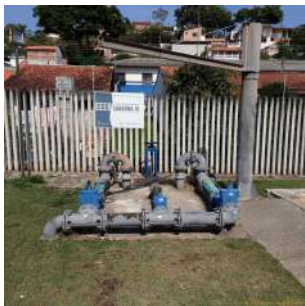
Foto 1 - Vista geral da elevatória.
