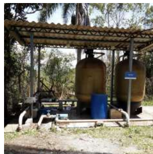
Foto 12 - Filtros empregados para remoção de ferro e manganês da água captada no Poço Boa
