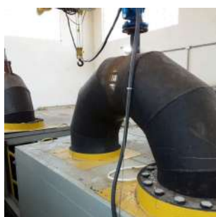
Foto 8 - Tubulações sobre a estrutura de isolamento acústico.
