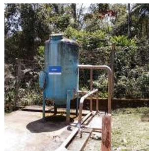
Foto 14 - Filtro empregado para remoção de ferro e manganês da água captada no Poço Boa Vista I.
