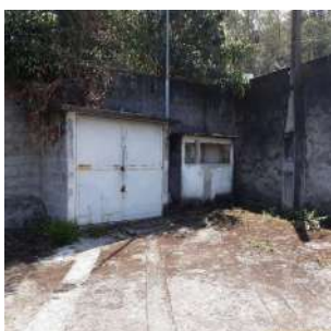
Foto 6 - Abrigo do painel elétrico do poço.
