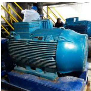
Foto 6 - Detalhe do motor do conjunto motobomba 1.
