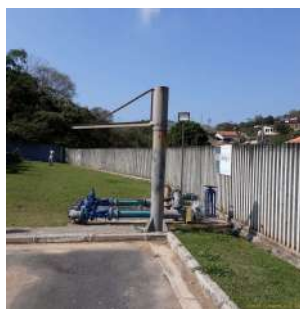
Foto 4 - Vista geral da elevatória.
