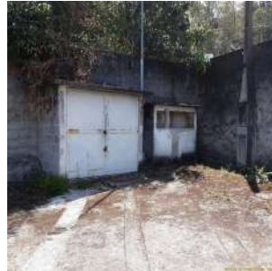
Foto 6 - Abrigo do painel elétrico do poço.
