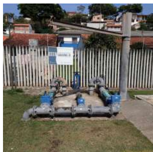
Foto 1 - Vista geral da elevatória.
