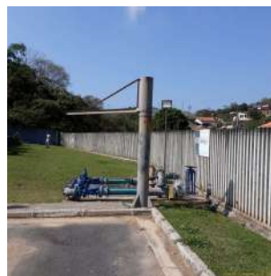
Foto 4 - Vista geral da elevatória.
