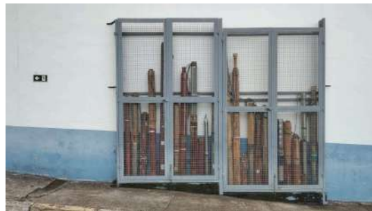
Foto 10 - Bombas reserva dos poços.
