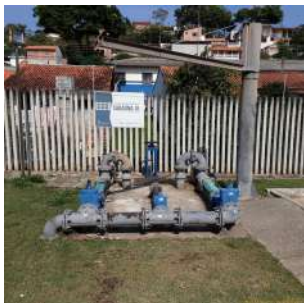
Foto 1 - Vista geral da elevatória.
