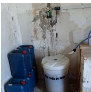
Foto 16 - Bomba dosadora e tanque de Hipoclorito de Sódio.
