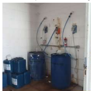
Foto 7 - Bombas dosadoras e tanques de cloro e flúor instaladas na área dos reservatórios Biritiba Ussu.
