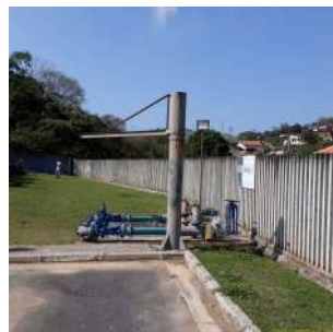
Foto 4 - Vista geral da elevatória.
