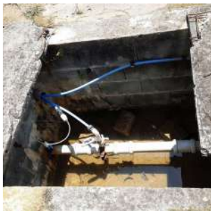
Foto 9 - Detalhe do ponto de aplicação de cloro e flúor na água bruta, localizado na área dos reservatórios.
