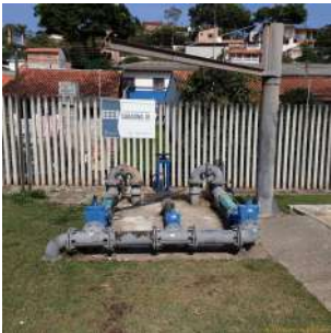
Foto 1 - Vista geral da elevatória.
