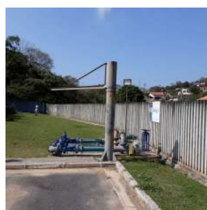
Foto 4 - Vista geral da elevatória.
