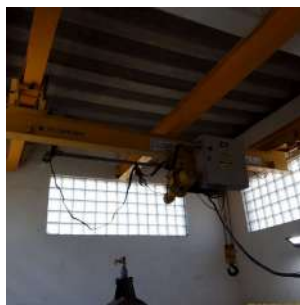
Foto 9 - Talha utilizada para içamento das bombas.
