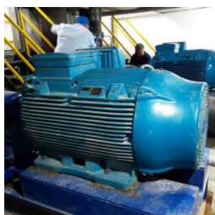
Foto 6 - Detalhe do motor do conjunto motobomba 1.
