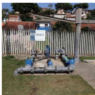
Foto 1 - Vista geral da elevatória.
