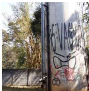
Foto 5 - Detalhe da tubulação de saída da água do reservatório.
