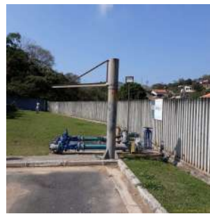
Foto 4 - Vista geral da elevatória.
