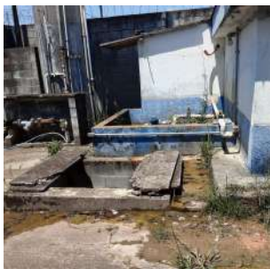
Foto 8 - Ponto aplicação de cloro e flúor na água bruta, localizado na área dos reservatórios, os produtos são aplicados antes da água entrar no reservatório apoiado.
