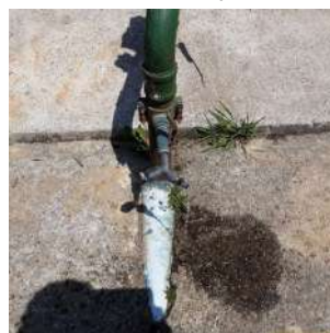
Foto 5 - Torneira para coleta de água bruta.
