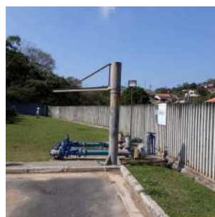
Foto 4 - Vista geral da elevatória.
