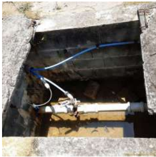
Foto 1 - Detalhe do vazamento na mangueira de aplicação de cloro na água bruta.
