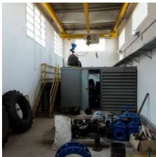
Foto 3 - Os conjuntos motobomba da elevatória estão instalados no interior de uma estrutura de isolamento acústico, para reduzir o incômodo aos moradores vizinhos.
