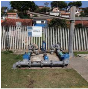
Foto 1 - Vista geral da elevatória.
