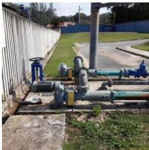
Foto 2 - Há um conjunto moto bomba em funcionamento na elevatória.
