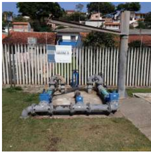
Foto 1 - Vista geral da elevatória.
