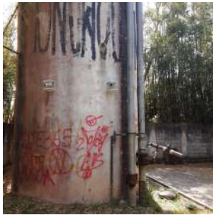
Foto 1 - Detalhe do fio do para raios partido.
