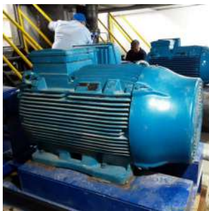
Foto 6 - Detalhe do motor do conjunto motobomba
