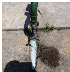
Foto 5 - Torneira para coleta de água bruta.
