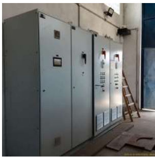
Foto 1 - Painéis elétricos da elevatória.
