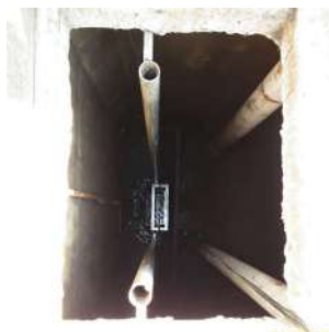
Foto 5 - Vista interna do poço de sucção das bombas. É possível visualizar o gradeamento no ponto de chegada do efluente.
