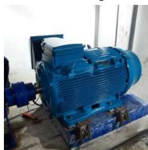
Foto 7 - Detalhe do motor do conjunto motobomba 2.
