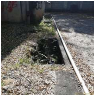
Foto 1 - Abertura no piso próximo ao reservatório.
