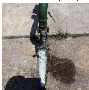
Foto 5 - Torneira para coleta de água bruta.
