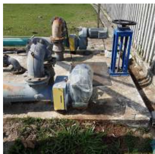
Foto 1 - Detalhe da ausência de conjunto moto bomba reserva no local.
