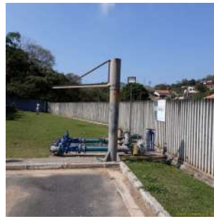
Foto 4 - Vista geral da elevatória.
