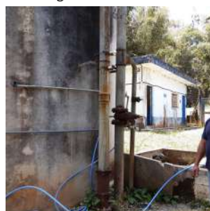
Foto 10 - Detalhe da tubulação de chegada da água captada no Poço Bela Vista II, é possível visualizar os pontos de aplicação de cloro e flúor na água bruta.
