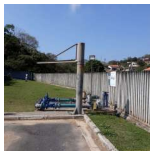
Foto 4 - Vista geral da elevatória.
