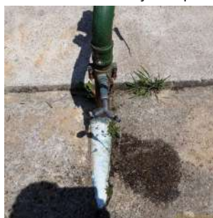
Foto 5 - Torneira para coleta de água bruta.
