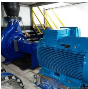
Foto 5 - Há dois conjuntos motobomba instalados, um em funcionamento e o segundo como reserva.
