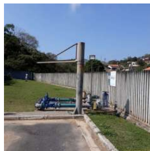
Foto 4 - Vista geral da elevatória.
