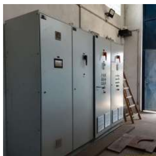
Foto 1 - Painéis elétricos da elevatória.
