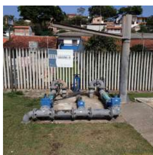
Foto 1 - Vista geral da elevatória.
