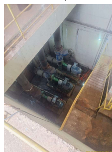
Foto 4 - Três conjuntos motobomba instalados na estação elevatória, sendo um sempre reserva
