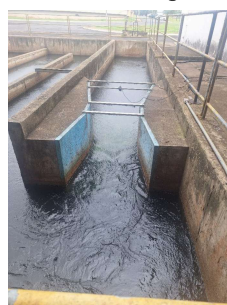
Foto 23 - Sensor de nível do macromedidor de saída
