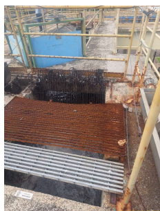
Foto 7 - Tratamento preliminar - gradeamento grosseiro instalado em uma das vias
