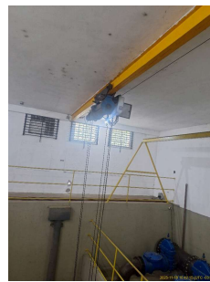
Foto 6 - Talha de içamento monovia
