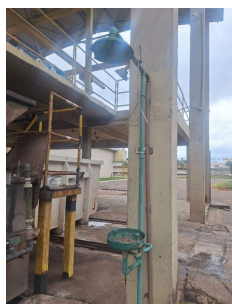
Foto 10 - Chuveiro de emergência
