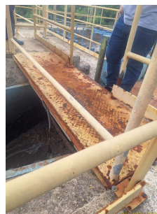
Foto 2 - Rampa de acesso com estado avançado de oxidação
