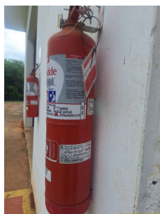
Foto 3 - Extintores área de poço seco - validade regular
