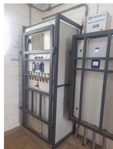
Foto 5 - Pannel com inversor de frequência e pannel de telemetria
