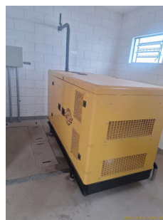
Foto 4 - Gerador de energia
