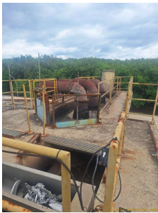
Foto 4 - Ausência de gradeamento na seção esquerda, considerando o sentido do escoamento
