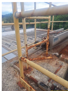
Foto 1 - Guarda corpos com estrutura deteriorada
