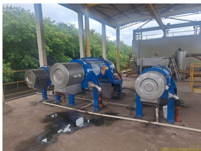
Foto 14 - Centrífugas para desidratação do lodo
