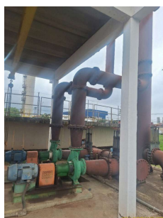
Foto 21 - Recalque de lodo para recirculação a partir de um dos decantadores
