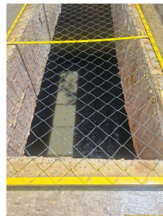
Foto 11 - Chegada do esgoto
