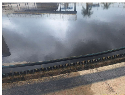
Foto 20 - Vertedor com separação do clarificado para etapa final
