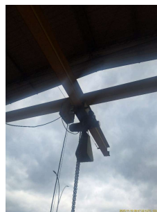
Foto 15 - Ponte rolante com talha para operações de manutenção das centrífugas
