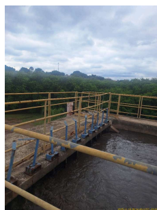
Foto 1 - Ausência de equipamento para transporte de resíduos do desarenador - mangote instalado ocioso
