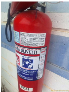
Foto 2 - Extintor de incêndio com validade regular
