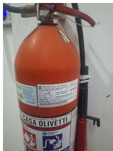
Foto 8 - Extintor de incêndio
