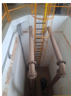
Foto 6 - Linha de recalque dos conjuntos motobomba e escada de acesso
