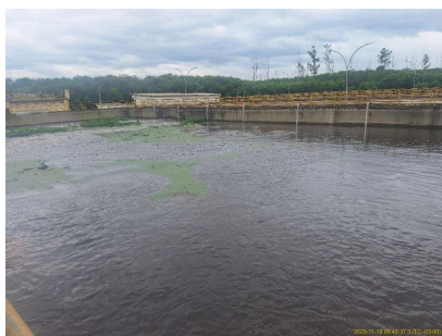
Foto 16 - Reator aerado 1 - módulo não está em uso
