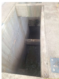
Foto 1 - Poço úmido da estação elevatória de esgoto da estação
