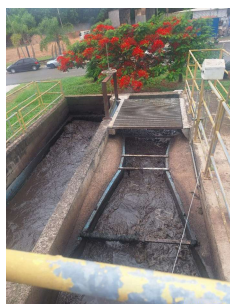
Foto 19 - Caixa para distribuir aos decantadores
