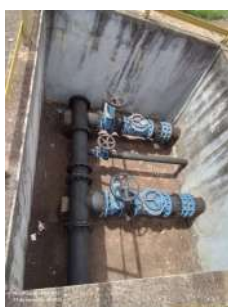
Foto 13 - Estrutura de alvenaria com as tubulações de saída da EEE.
