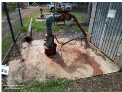
Foto 12 - Vista geral da captação.
