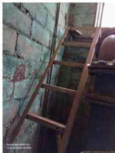
Foto 3 - Escada de acesso ao interior da EEA não possui corrimão. O mesmo foi serrado e posto de lado, no interior da unidade,.
