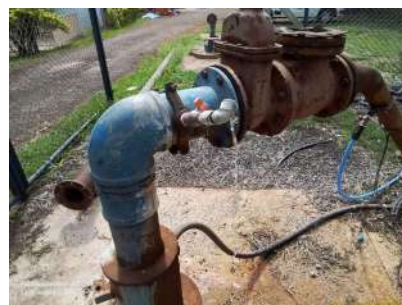
Foto 4 - Torneira para coleta de água bruta da captação.
