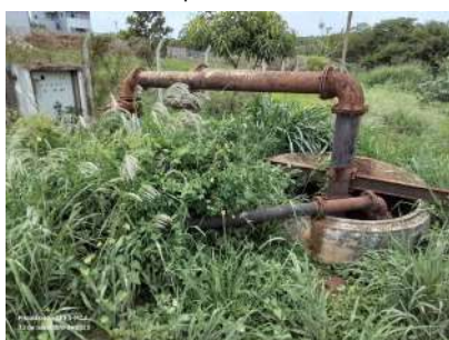
Foto 3 - Poço de sucção da EEE, onde está instalada a bomba.
