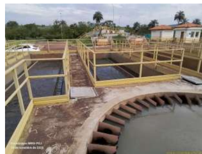
Foto 16 - Sistema separador trifásico do UASB.
