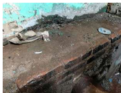
Foto 2 - Foi constatado ponto de vazamento no reservatório, junto à EEA adjacente a ele.
