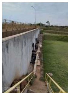
Foto 19 - Tubulações de saída localizadas nos UASBs. Há tubulação para saída do excesso de lodo a partir do fundo do UASB, tubulações para remoção da espuma formada no separador trifásico e tubulações para amostragem do lodo em quatro alturas diferentes (controle do processo).
