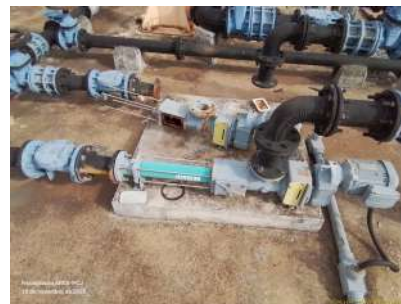
Foto 28 - Bombas helicoidais para direcionamento de lodo ao processo (recirculação) ou ao skid de desidratação (disposição final).
