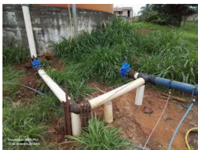
Foto 6 - Tubulação de saída da captação. O prestador informou que realizou um bypass pois em futuro próximo ocorrerá uma reforma no reservatório ao lado do poço, ocasião em que a água do poço será direcionada para a rede.
