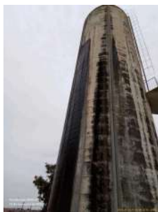
Foto 1 - Reservatório necessita de intervenções contra fissuras e vazamentos
