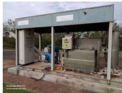
Foto 4 - Unidade tipo skid para desidratação de lodos está inoperante.
