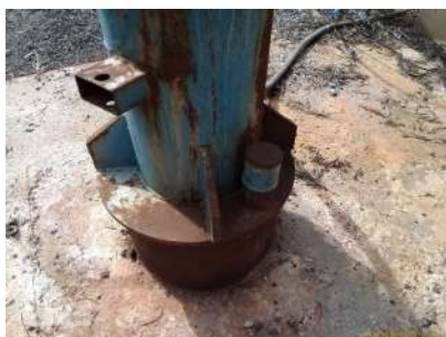
Foto 3 - Tubo para medição de nível da captação.
