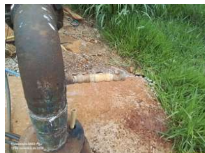
Foto 2 - Torneira para coleta de água bruta na captação.
