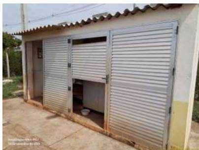
Foto 9 - Vista externa da cabine que abriga os painéis de comando da unidade.
