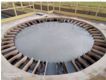
Foto 5 - Distribuidor tipo tulipa na entrada do UASB apresenta divisores obstruídos por ausência de limpeza.
