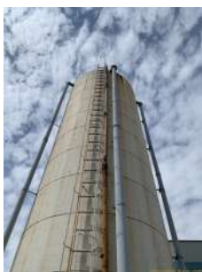
Foto 1 - Corrosão presente na estrutura do reservatório.
