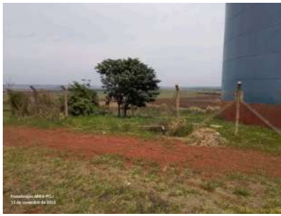
Foto 1 - Trecho em que o alambrado que cerca a área está ausente.
