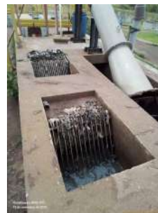
Foto 7 - Gradeamento presente no tratamento preliminar.
