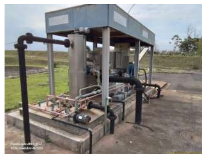
Foto 32 - Unidade skid para desidratação do lodo gerado está inoperante.
