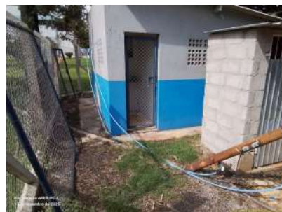
Foto 6 - Vista do abrigo onde estão os reagentes químicos utilizados no tratamento e as dosadoras.
