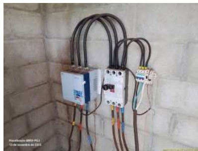
Foto 13 - Comandos elétricos da unidade.
