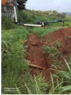
Foto 5 - Tubulação para alimentação do reservatório, a partir de captação em poço adjacente.
