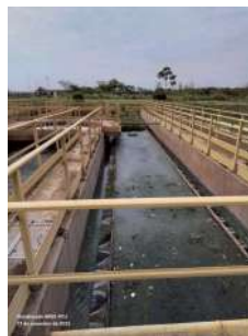
Foto 18 - Crescimento de vegetação no separador de fases do UASB.
