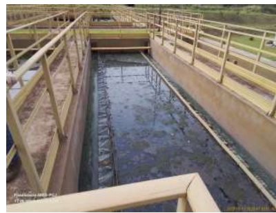
Foto 2 - Há acúmulo de sujeira no separador de fases dos UASBs.
