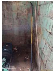
Foto 2 - Corrimão da escada, serrado e apoiado num canto da EEA.
