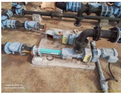
Foto 1 - Elevatória de lodos inoperante. Uma das bombas está quebrada e desmontada.
