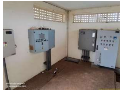
Foto 12 - Casa de controle de motores 1, próximo ao tratamento preliminar, contando com painéis de comando para os equipamentos instalados no tratamento preliminar e para a iluminação da unidade.
