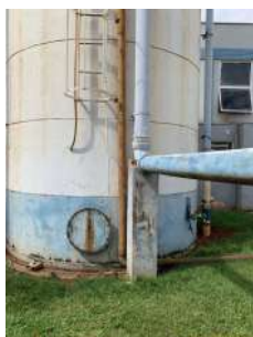
Foto 6 - Tubulação azul serve de extravasor do reservatório, direcionando a água extravasada para o reservatório semi enterrado, localizado ao lado.
