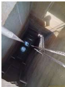
Foto 18 - Vista do gradeamento com cesto na entrada da EEE.
