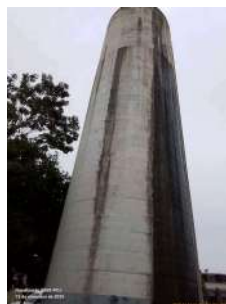
Foto 2 - Vista evidenciando vazamento na estrutura do reservatório.
