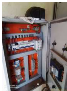
Foto 8 - Quadro de comando 1 instalado na unidade.
