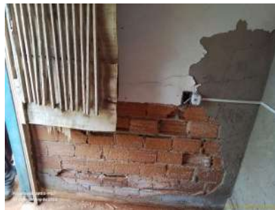
Foto 2 - Vista interna do abrigo para os produtos químicos.
