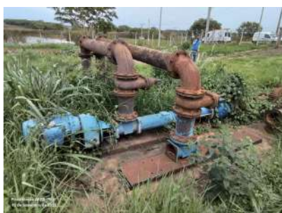
Foto 5 - Tubulações de recalque da EEE. À direita, tubulação onde antes havia a bomba reserva.
