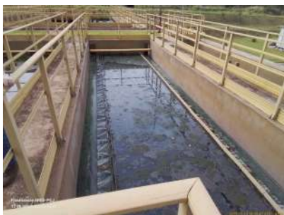
Foto 15 - Sistema separador trifásico dos UASB. A calha com líquido separa o efluente líquido que seguirá no processo da espuma e artefatos flutuantes, que deveriam ser periodicamente removidos.
