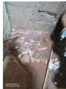
Foto 4 - Sujeira no interior da unidade.
