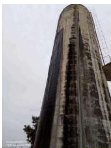
Foto 3 - Vista evidenciando vazamento na estrutura do reservatório.
