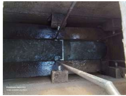
Foto 4 - Entrada do esgoto na estação, evidenciando cestos para retenção de sólidos grosseiros.
