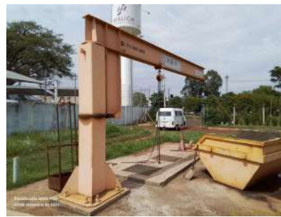
Foto 17 - Braço com talha para auxílio em operações de manutenção da unidade.
