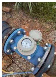
Foto 4 - Macromedidor instalado na captação.
