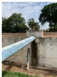
Foto 8 - Tubulação azul serve de extravasor do reservatório, direcionando a água extravasada para o reservatório semi enterrado (foto), localizado ao lado da unidade fiscalizada.
