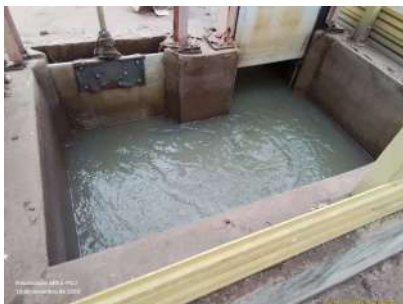
Foto 6 - Caixa de entrada do efluente na unidade.
