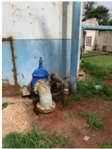
Foto 2 - Tubulação de saída do reservatório.
