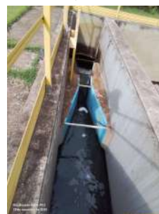
Foto 30 - Calha Parshall na saída da unidade.
