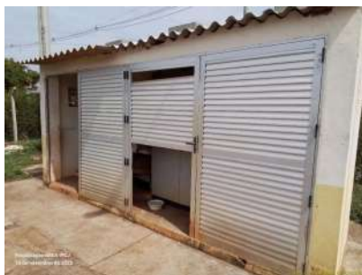
Foto 1 - Abrigo dos quadros de comando da unidade, apresentando portas quebradas.
