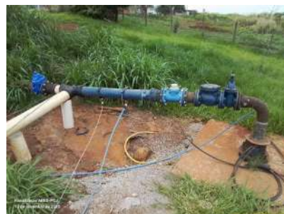
Foto 5 - Vista geral da captação
