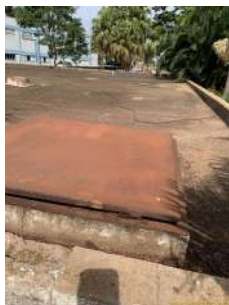
Foto 1 - Tampa de inspeção apresentando corrosão.
