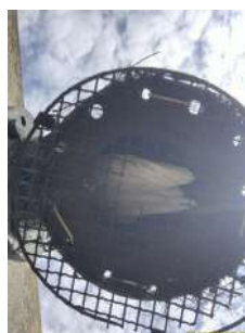
Foto 4 - Tubo extravasor com tela de proteção rompida.
