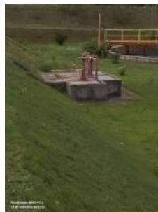
Foto 23 - Caixa de distribuição à jusante dos filtros biológicos.
