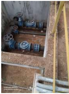
Foto 1 - Há duas bombas instaladas na unidade, porém uma delas está inoperante, aguardando manutenção na válvula de retenção na tubulação de recalque.
