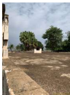
Foto 2 - Estrutura em alvenaria na parte superior do reservatório, possuindo abertura sem proteção com tela.
