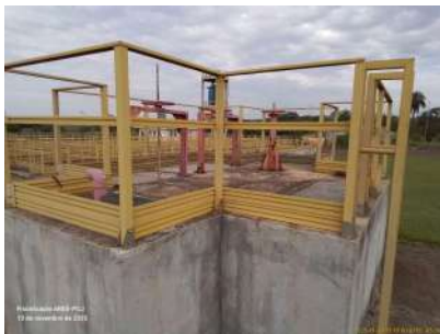
Foto 13 - Caixa de distribuição localizada entre o tratamento preliminar e os reatores UASB.
