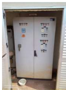
Foto 10 - Quadro de comando 2 instalado na unidade.
