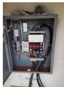
Foto 6 - Quadro de energia instalado na unidade.
