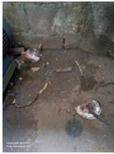
Foto 1 - Sujeira no interior da unidade.
