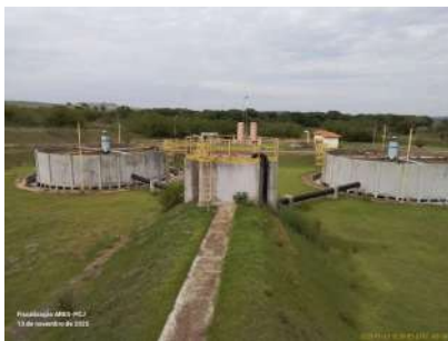
Foto 17 - Vista dos dois filtros biológicos em paralelo, instalados à jusante dos UASBs. No centro da foto, caixa de distribuição entre os UASBs e os filtros percoladores.
