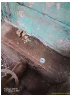
Foto 3 - Vazamento no interior da EEA, na parede que separa a EEA do reservatório semi-enterrado adjacente. Apontamento realizado no Item Fiscalizado 13466.
