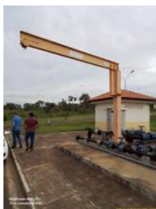
Foto 35 - Estrutura metálica com talha para auxílio nas operações de manutenção da elevatória.
