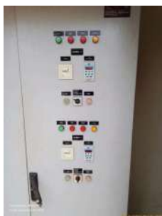
Foto 11 - Quadro de comando 2 instalado na unidade.
