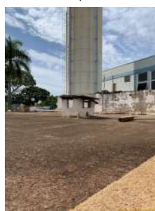
Foto 6 - Estrutura em alvenaria na parte superior do reservatório, possuindo abertura sem proteção com tela.
