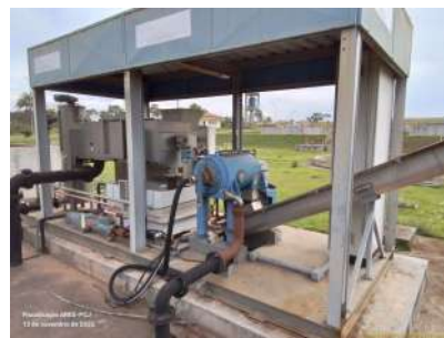
Foto 34 - Unidade skid para desidratação do lodo gerado está inoperante.
