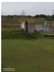
Foto 20 - Caixa de distribuição à jusante do UASB e à montante dos filtros percoladores.
