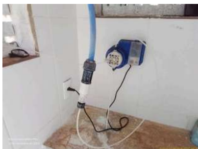
Foto 7 - Bomba dosadora de reagente hipoclorito de sódio.
