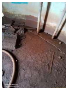
Foto 4 - Vista da parte interna da base do reservatório, evidenciando acúmulo de água sobre o piso em razão dos vazamentos presentes.
