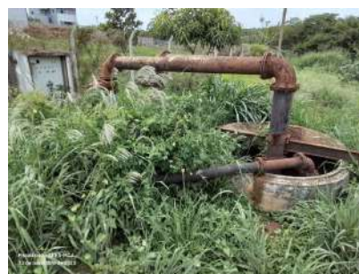
Foto 4 - Mato alto ao redor do poço onde está a bomba da EEE.
