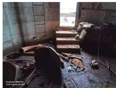
Foto 4 - Sujeira e entulho no interior da base do reservatório.
