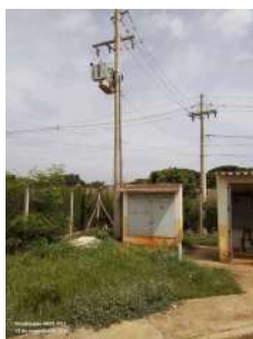
Foto 5 - Entrada de energia da unidade.
