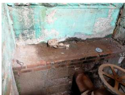
Foto 1 - Foi constatado ponto de vazamento no reservatório, junto à EEA adjacente a ele.
