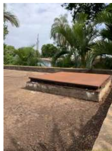
Foto 2 - Tampa de inspeção apresentando corrosão.
