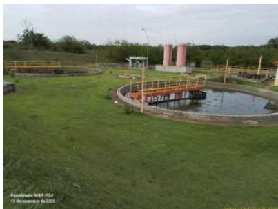
Foto 22 - Decantadores secundários. O braço rotativo para raspagem do decantador está inoperante em ambos decantadores.
