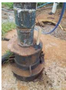
Foto 3 - Tubo para medição de nível da captação; Recomenda-se tampar a extremidade do tubo com um cap.
