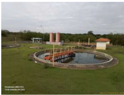
Foto 24 - Decantador secundário em primeiro plano. Ao fundo, skid para secagem do lodo, dois tanques para armazenamento de hipoclorito de sódio, tanque de contato para desinfecção do efluente final e elevatória do lodo gerado no processo (recirculação ou skid).
