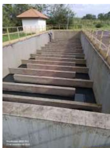
Foto 31 - Tanque de contato para desinfecção do efluente final.
