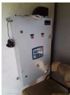
Foto 7 - Quadro de comando 1 instalado na unidade.
