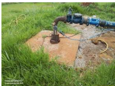
Foto 1 - Vista geral da captação.
