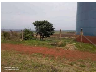
Foto 1 - Trecho em que o alambrado que cerca a área está ausente.
