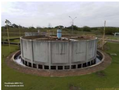
Foto 3 - Os braços rotativos dos dois filtros biológicos percoladores estão inoperantes.
