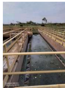
Foto 6 - Crescimento de vegetação dentro dos separadores de fase dos UASBs.
