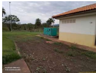
Foto 5 - Gerador instalado próximo à portaria da unidade.
