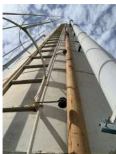
Foto 1 - Ausência de condutor no SPDA instalado na estrutura.
