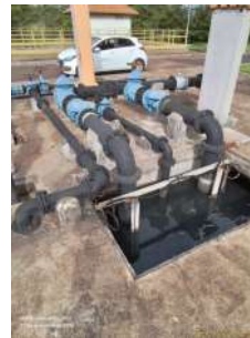
Foto 26 - Estação elevatória para drenados, respingos e sobrenadantes, instalada ao lado da elevatória de lodos.
