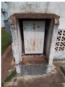
Foto 6 - Painel de comando da EEA.
