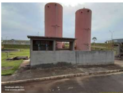
Foto 29 - Tanques de reagente para desinfecção e bombas dosadoras estão inoperantes.
