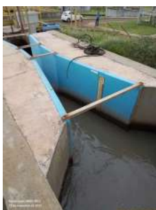
Foto 8 - Calha Parshall na entrada da unidade.
