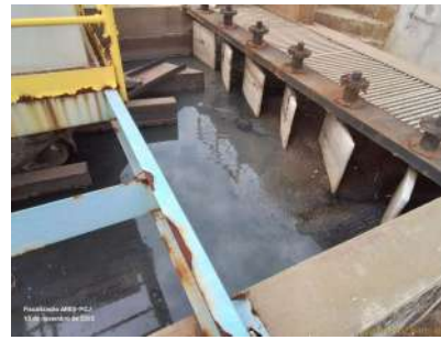
Foto 11 - Acúmulo de areia nos desarenadores.
