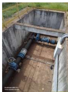
Foto 12 - Estrutura de alvenaria com as tubulações de saída da EEE.
