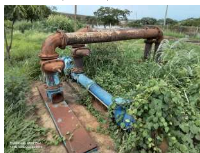
Foto 4 - Tubulações de recalque da EEE. À esquerda, tubulação onde antes havia a bomba reserva.
