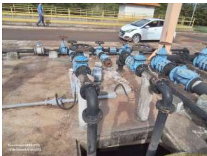
Foto 27 - Elevatória de lodos. São duas bombas helicoidais, sendo que uma está quebrada (à direita, desmontada).
