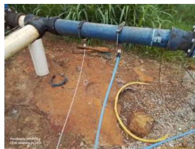
Foto 7 - Pontos em que são adicionados os reagentes para tratamento da água captada.
