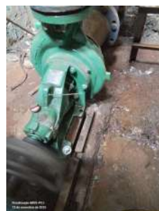
Foto 2 - Acúmulo de água no piso da unidade.
