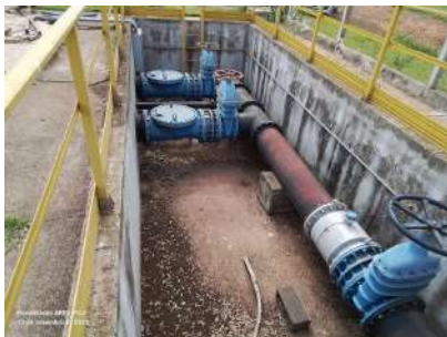
Foto 8 - Tubulação do recalque da unidade.
