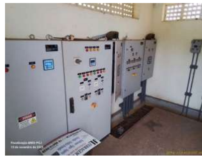
Foto 25 - Casa de comando de motores 2. Painéis de comando dos equipamentos instalados na elevatória de lodos e de drenados, respingos e sobrenadantes.
