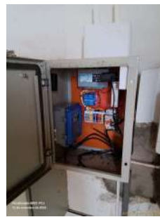
Foto 12 - Painel elétrico da unidade.
