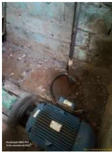
Foto 3 - Acúmulo de água no piso da unidade.
