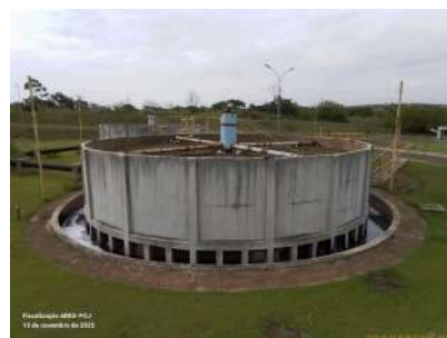
Foto 21 - Filtro biológico de percolação. O braço rotativo deveria girar e distribuir o efluente uniformemente em todo o filtro, porém, está inoperante.
