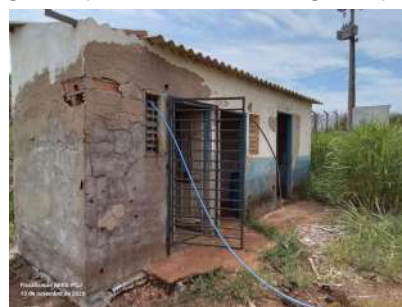
Foto 8 - Abrigo dos produtos químicos utilizados no tratamento da água.
