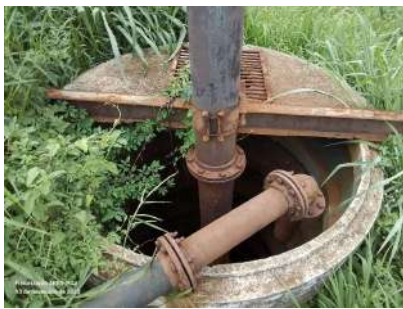
Foto 7 - Poço de sucção da EEE. Vegetação começa a encobrir a estrutura.
