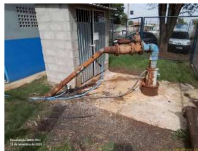
Foto 2 - Vista geral da captação;
