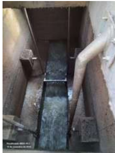
Foto 5 - Entrada do esgoto na estação, evidenciando cestos para retenção de sólidos grosseiros.
