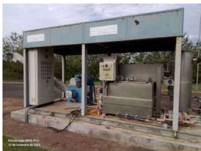
Foto 33 - Unidade skid para desidratação do lodo gerado está inoperante.
