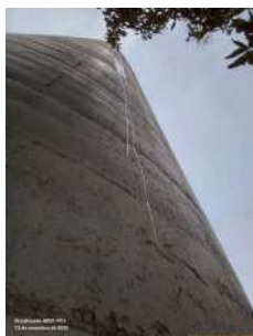
Foto 1 - Vista evidenciando vazamento na estrutura do reservatório.
