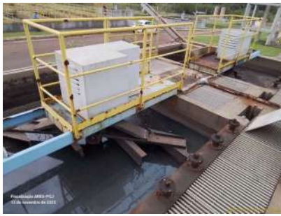
Foto 10 - Dois desarenadores, em paralelo, cada qual com seu raspador rotativo e sistema de rosca sem fim para remoção automatizada do material depositado. Raspadores e sistema de rosca sem fim inoperantes.
