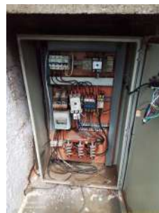
Foto 7 - Painel de comando da EEA.
