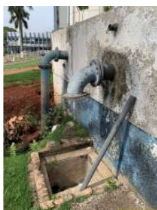
Foto 3 - Tubo extravasor possui tela de proteção, porém ela está rompida.
