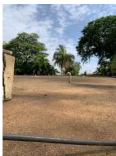
Foto 1 - Tubulação de ventilação sem tela de proteção.
