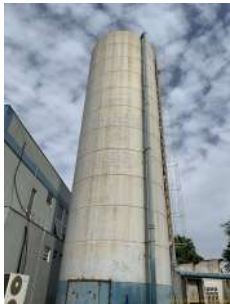
Foto 3 - Identificação gravada na estrutura da unidade.
