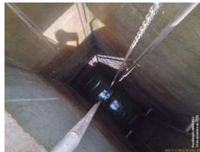
Foto 19 - Vista do gradeamento com cesto na entrada da EEE.
