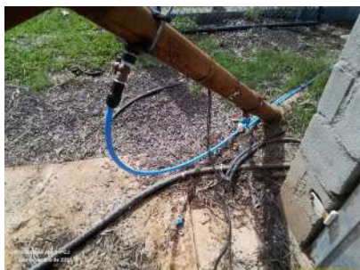
Foto 5 - Pontos para adição de reagentes químicos utilizados no tratamento da água captada.
