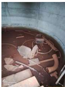
Foto 3 - Sujeira e entulho no interior da base do reservatório.
