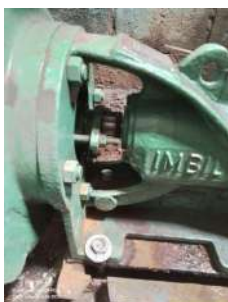
Foto 1 - Água de lubrificação de gaxeta com drenagem inadequada.
