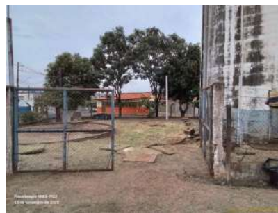
Foto 2 - Portão e ferragens necessitam de pintura; vários pontos do cercamento necessitam reparos, tanto no alambrado de tela quanto nos mourões de alvenaria.
