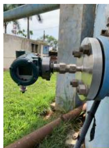
Foto 7 - Medidor de nível instalado no reservatório.
