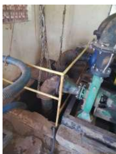
Foto 7 - Entrada da água captada para ser recalçada e distribuída.
