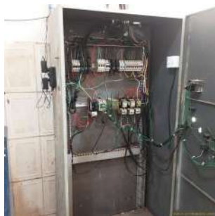
Foto 16 - Interior do painel elétrico.
