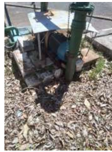
Foto 2 - Vista detalhada da motobomba.
