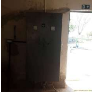
Foto 5 - Painel elétrico para controle de operação da moto bomba.
