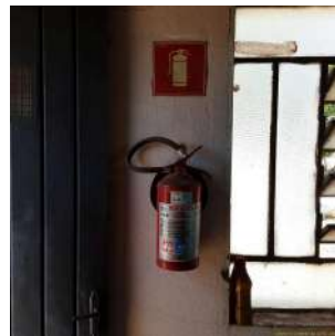
Foto 7 - Extintor de incêndio.
