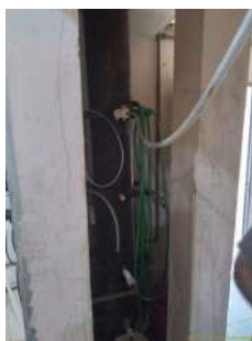
Foto 1 - Entrada da água bruta. Neste momento ocorre a adição de PAC e Aluminato de sódio
