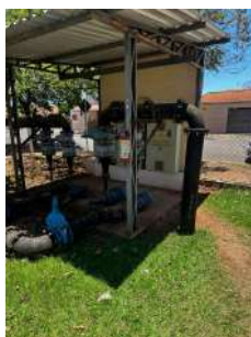
Foto 3 - Vista geral dos conjuntos de motobombas.
