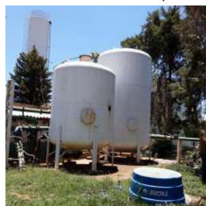
Foto 6 - Tanque menor corresponde ao filtro de areia, já o tanque maior, floculador/decantador.
