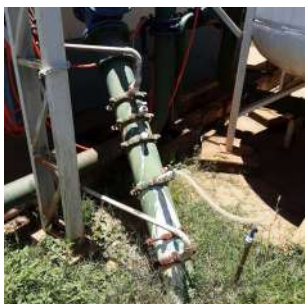
Foto 11 - Na tubulação, os processos são realizados na seguinte sequência, de cima para baixo: aplicação de flúor, correção do pH e adição de cloro.
