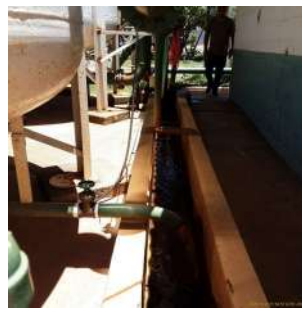
Foto 8 - Canaleta de descarga do floculador/decantador.
