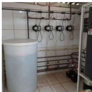
Foto 20 - Produção de hipoclorito de sódio via eletrólise.
