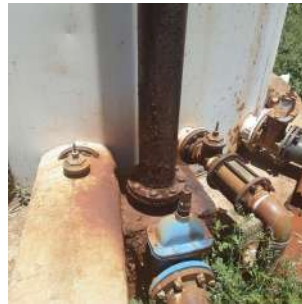
Foto 3 - Ponto de oxidação severa.
