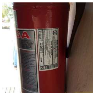
Foto 1 - Extintor de incêndio com prazo de validade expirado desde 2021, conforme etiqueta de identificação.
