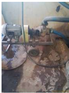
Foto 9 - Bomba utilizada para abastecimento de caminhão pipa.
