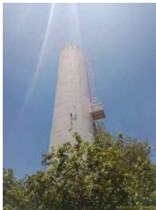
Foto 1 - Reservatório elevado localizado dentro da ETA recebe a água e, a partir dele, é realizada a distribuição para os demais reservatórios. Na imagem, estão em destaque o tubo extravasor, o guarda-corpo e as escadas de acesso ao topo.
