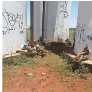
Foto 4 - Base dos três reservatórios.
