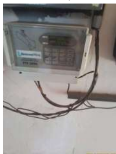
Foto 30 - Medidor de vazão da água na entrada da ETA.
