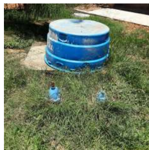
Foto 12 - Registros para controle da distribuição de água tratada.
