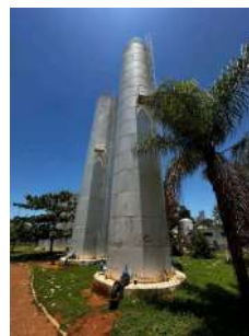
Foto 8 - Vista geral dos reservatórios situados fora da ETA.
