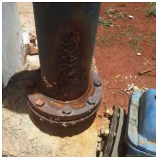
Foto 4 - Ponto de oxidação severa.
