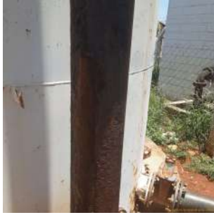
Foto 1 - Tubulação em grau avançado de oxidação.
