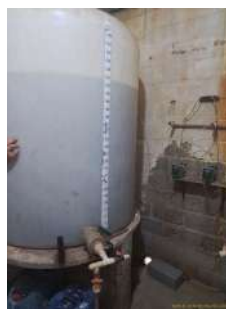
Foto 2 - Tanque de PAC.
