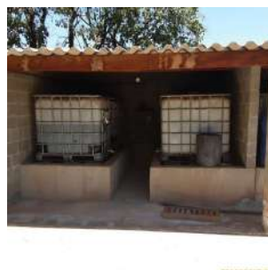
Foto 4 - Tanques de PAC e as respectivas bombas dosadoras de produto.
