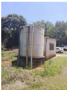
Foto 3 - Reservatório para armazenamento da água bombeada.
