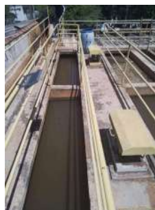
Foto 23 - Câmara de floculação.
