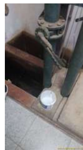
Foto 2 - Aberturas sem proteção.
