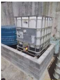
Foto 12 - Tanque de hidróxido de sódio.
