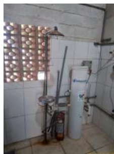
Foto 3 - Chuveiro de emergência.
