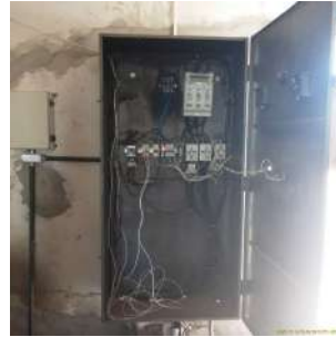
Foto 6 - Interior do painel elétrico.
