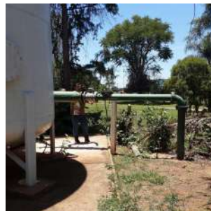
Foto 2 - Passagem da água bruta para o tanque de floculação/decantação. Neste momento ocorre a adição de PAC e Ali
