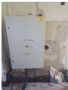
Foto 5 - Painel elétrico de uma das bombas.
