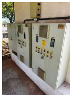
Foto 2 - Pannel elétrico da estação elevatória.
