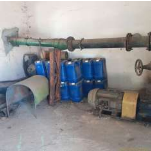
Foto 2 - Linha de recalque equipada com manômetro para monitoramento da pressão de saída da água.
