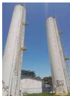
Foto 8 - Vista geral dos dois reservatórios.
