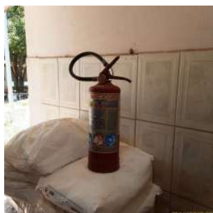
Foto 22 - Extintor de incêndio.
