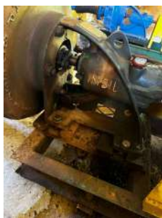
Foto 7 - Drenagem da água de graxeta.
