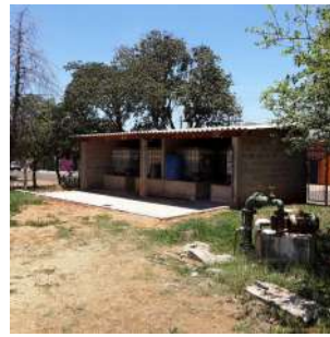
Foto 27 - Tanques de PAC e aluminato de sódio.
