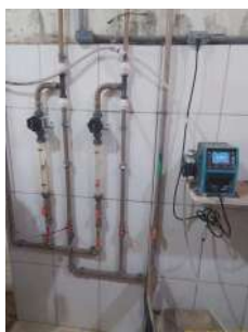
Foto 4 - Bombas dosadoras de PAC e aluminato de sódio.
