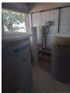
Foto 6 - Área destinada à produção de hipoclorito de sódio por eletrólise, utilizando solução de salmoura. Todos os equipamentos e a manutenção são realizados por uma empresa especializada.
