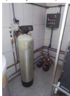
Foto 8 - Painel elétrico e bombas dosadoras da área voltada para a produção de hipoclorito de sódio.
