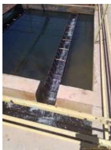
Foto 27 - Imagem de uma das calhas do decantador.
