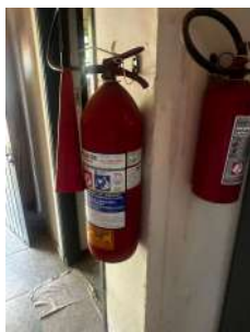
Foto 31 - Extintores de incêndio.
