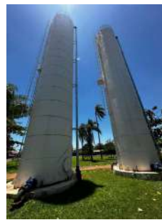
Foto 4 - Conjunto de dois reservatórios situados fora da ETA, alimentados pelo reservatório elevado ou pelo reservatório apoiado.
