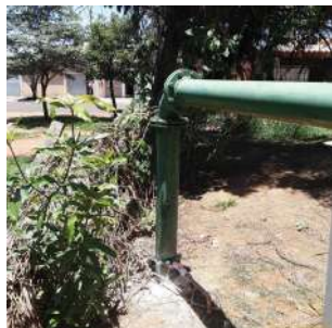
Foto 1 - Entrada da água bruta.
