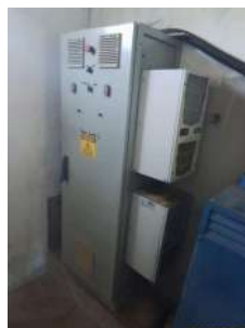
Foto 4 - Painel elétrico de uma das bombas.
