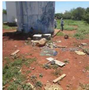
Foto 5 - Acúmulo de sujeira na área do reservatório.
