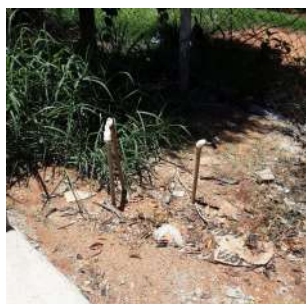
Foto 3 - À esquerda, tubulação para adição do PAC e à direita, torneira para coleta de água bruta.
