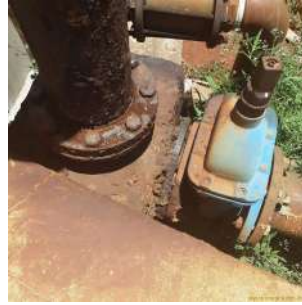
Foto 2 - Ponto de oxidação severa.
