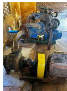
Foto 6 - Conjunto de motobombas, sendo uma em operação e outra em reserva.
