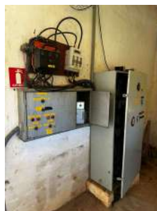
Foto 10 - Pannel eletrônico da casa de motobombas.
