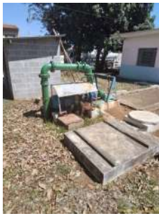
Foto 1 - Espaço reservado para a motobomba reserva.
