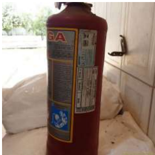
Foto 1 - Extintor de incêndio com prazo de validade expirado desde 2022, conforme etiqueta de identificação.
