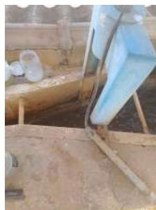
Foto 21 - Calha Parshall e sensor para controle de vazão.
