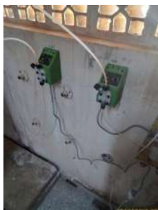
Foto 29 - Bombas dosadoras responsáveis pela aplicação dos produtos de cloração e fluoretação.
