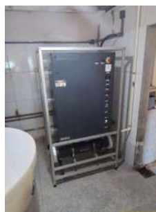
Foto 7 - Equipamento onde ocorre a eletrólise para produção de hipoclorito.
