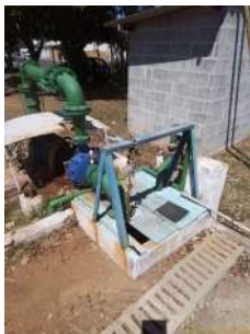
Foto 4 - Vista geral do booster.
