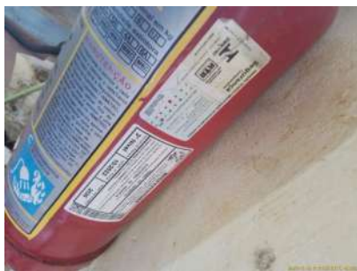
Foto 1 - Extintor de incêndio com prazo de validade expirado desde 2021, conforme etiqueta de identificação.
