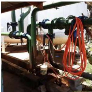
Foto 9 - Tubulação para lavagem de filtro.
