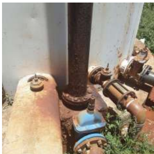
Foto 4 - Entrada de água de um dos reservatórios.
