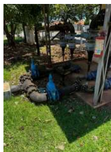
Foto 4 - Vista detalhada dos conjuntos de motobombas.
