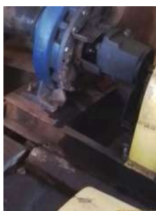
Foto 1 - Área ao redor da motobomba que estava em operação.
