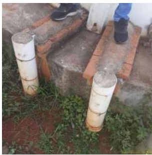
Foto 6 - Tubulação de entrada de água e comunicação com os demais reservatórios.
