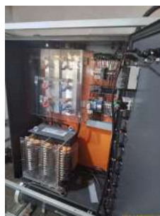
Foto 5 - Painel elétrico do equipamento que realiza a eletrólise para a produção de hipoclorito de sódio.
