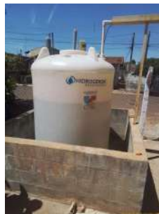
Foto 11 - Tanque de hipoclorito de sódio.
