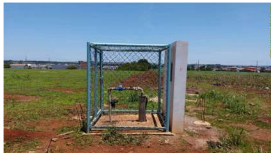
Foto 6 - Vista Geral do ponto de captação subterrânea.
