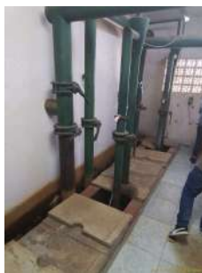
Foto 1 - Aberturas sem proteção.
