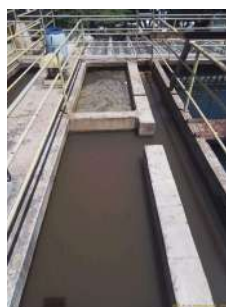
Foto 24 - Passagem da água dos flocladores para os decantadores.
