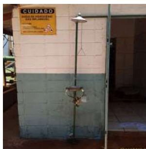
Foto 23 - Chuveiro de emergência.
