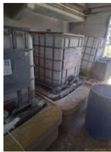
Foto 10 - Tanques de aluminato de sódio.
