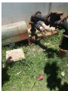
Foto 3 - Moto bomba responsável pelo bombeamento de água para abastecimento dos demais reservatórios.
