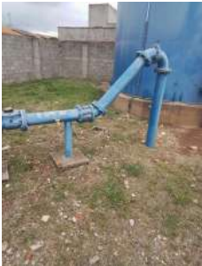
Foto 4 - Trecho de tubulação responsável pelo transporte de água do poço ao reservatório.
