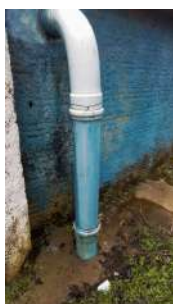
Foto 1 - Vazamento na conexão entre os tubos.
