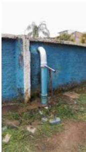
Foto 4 - Saída de água e registro para controle.
