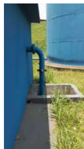
Foto 6 - Tubulação de recalque para o sistema de distribuição.
