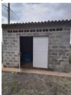
Foto 7 - Casa dos tanques de hipoclorito de sódio e ácido fluossilicato.
