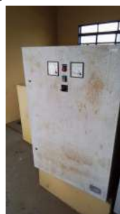
Foto 8 - Painel elétrico da bomba do poço.
