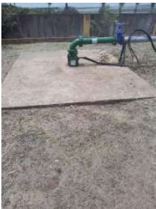
Foto 2 - Laje de proteção e medidor de nível.
