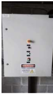
Foto 3 - Painel eletrônico da EEA.
