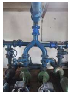
Foto 6 - Tubulaçãode recalque para o sistema de distribuição.
