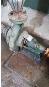
Foto 6 - Detalhe para a bomba centrífuga de uma das motobombas.
