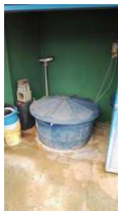
Foto 10 - Tanque de armazenamento de produto químico.
