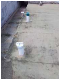
Foto 1 - Tubos de respiros com tampas inadequadas.
