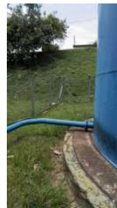
Foto 4 - Tubulação responsável pela condução da água até a estação elevatória.
