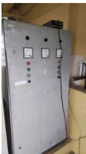
Foto 2 - Painel elétrico da estação elevatória.
