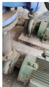
Foto 2 - Imagem com detalhe do conjunto de motobombas.
