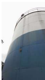
Foto 1 - Medidor de nível.
