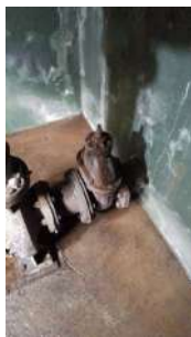
Foto 1 - Vazamento aparente em um dos registros.
