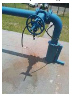
Foto 6 - Torneira para coleta de água.
