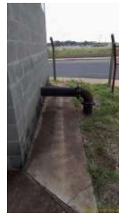
Foto 4 - Tubulação de recalque destinada à distribuição de água.
