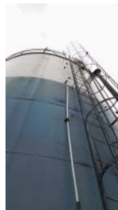
Foto 7 - Cabo de aterramento do para-raio.
