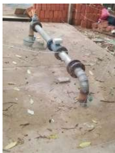
Foto 3 - Laje de proteção e medidor de nível.
