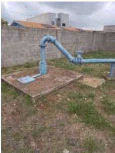
Foto 1 - Laje de proteção e medidor de nível.
