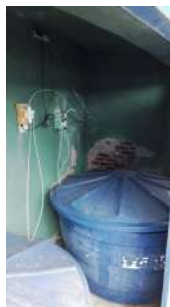
Foto 2 - Tanque contendo produto químico, sem dique ou estrutura de contenção.
