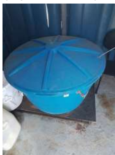
Foto 12 - Tanque de armazenamento de produto químico.
