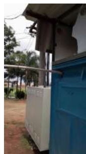
Foto 10 - Tubulação de pequeno diâmetro destinada à condução de produtos químicos.
