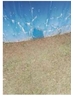
Foto 2 - Vazamento aparente na lateral do reservatório.
