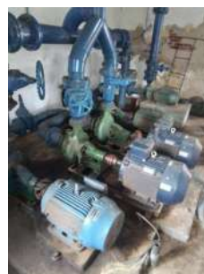
Foto 2 - Conjunto de motobombas (em operação e reserva).
