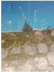
Foto 1 - Vazamento aparente na lateral do reservatório.
