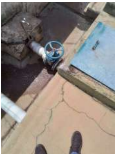
Foto 5 - Saída de água no reservatório.
