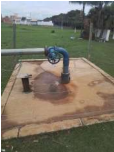
Foto 2 - Laje de proteção e medidor de nível.
