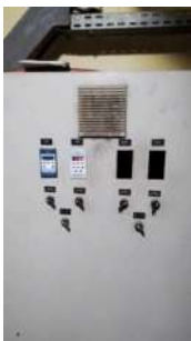
Foto 1 - Painel elétrico (funcionamento das motobombas e bomba submersa no poço).
