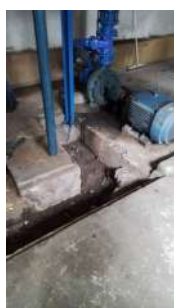
Foto 1 - Aberturas ao redor das bombas representam risco aos operadores. Recomenda-se instalar grades de proteção.
