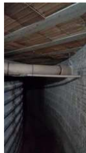
Foto 8 - Tubulação de pequeno diâmetro que adentra o reservatório, localizada próxima à entrada de água destinada à cloração e fluoretação.
