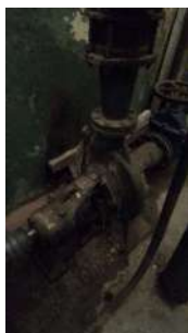
Foto 6 - Tubulação de recalque.
