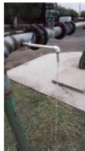
Foto 4 - Torneira instalada para captação de água destinada à realização de análises.
