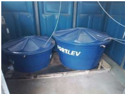
Foto 1 - Tanque contendo produto químico, sem dique ou estrutura de contenção.
