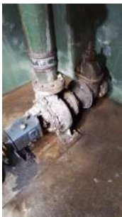
Foto 3 - Tubulação de recalque.
