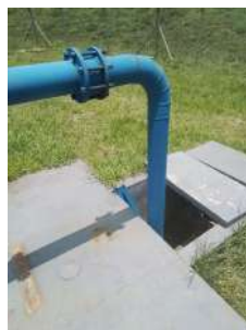
Foto 4 - Tubulação de recalque destinada à distribuição de água.
