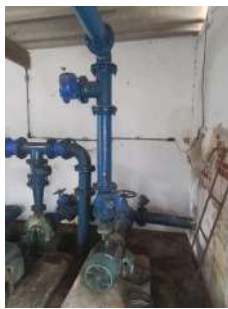
Foto 7 - Tubulação de recalque para o sistema de distribuição.
