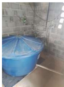
Foto 6 - Tanque de produtos químicos para tratamento. Cloração e fluoretação são aplicadas na água no ponto de entrada do reservatório.
