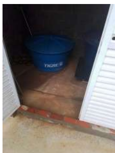
Foto 5 - Tanque de produtos químicos para tratamento. Cloração e fluoretação são aplicadas na água no ponto de entrada do reservatório.
