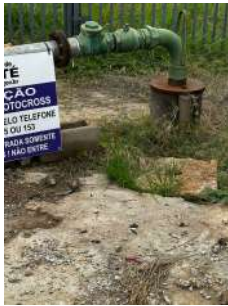
Foto 2 - Laje de proteção apresenta sinais de deterioração superficial.
