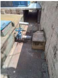
Foto 6 - Saída de água no reservatório.
