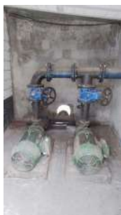
Foto 1 - Conjunto de motobombas da estação elevatória.
