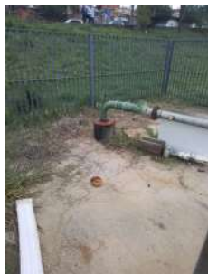
Foto 3 - Laje de proteção, medidor de nível e torneira para coleta de água.
