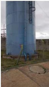
Foto 3 - Tubulação entrada e saída de água do reservatório.
