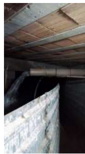
Foto 6 - Entrada de água proveniente diretamente do poço.
