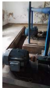
Foto 4 - Imagem detalhada do conjunto de motobombas,
