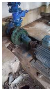
Foto 5 - Detalhe da conexão entre a bomba centrífuga e o motor elétrico.
