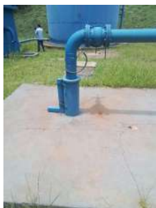
Foto 3 - Laje de proteção e medidor de nível.
