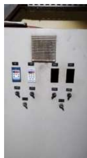
Foto 4 - Painele elétrico (funcionamento das motobombas e bomba submersa no poço).
