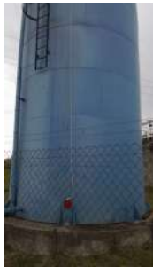
Foto 8 - Medidor de nível.
