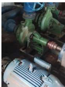
Foto 1 - Conjunto de motobombas (em operação e reserva).
