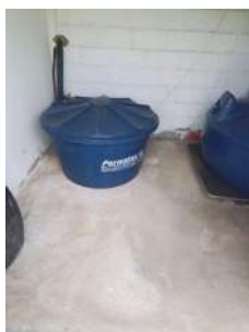
Foto 1 - Tanque contendo produto químico, sem dique ou estrutura de contenção.
