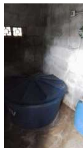
Foto 6 - Tanque de armazenamento de produto químico.
