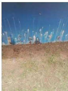
Foto 3 - Vazamento aparente na lateral do reservatório.
