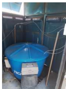
Foto 11 - Tanque de armazenamento de produto químico. A cloração e a fluoretação são realizadas no ponto de entrada do reservatório.
