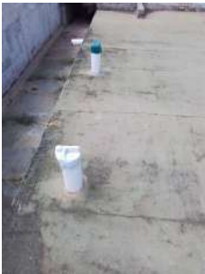
Foto 3 - Tubos de respiro.
