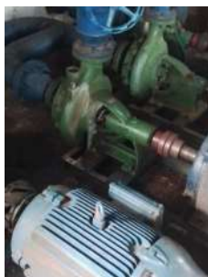
Foto 1 - Drenagem inadequada de água de lubrificação de gaxetas em uma das motobombas.
