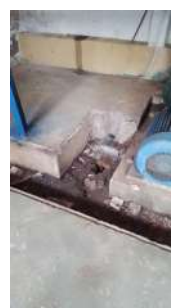
Foto 2 - Aberturas ao redor das bombas representam risco aos operadores. Recomenda-se instalar grades de proteção.
