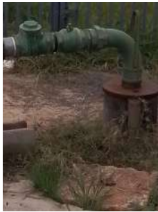
Foto 1 - Presença de vegetação invadindo a área do entorno da tampa de proteção do poço.
