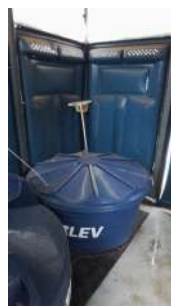
Foto 6 - Tanque de armazenamento de produto químico. A cloração e a fluoretação são realizadas no ponto de entrada do reservatório.
