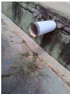
Foto 2 - Tubo extravasor sem tela de proteção.
