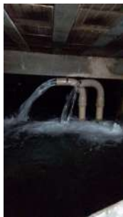
Foto 7 - Entrada de água proveniente diretamente do poço.
