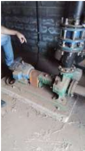
Foto 2 - Moto bomba em operação.
