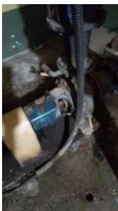
Foto 2 - Uma das motobombas da estação elevatória.
