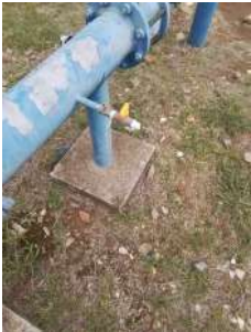
Foto 3 - Torneira para coleta de água.
