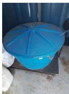
Foto 2 - Tanque contendo produto químico, sem dique ou estrutura de contenção.
