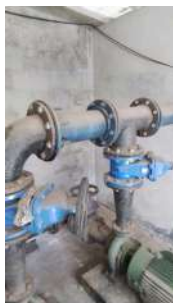
Foto 3 - Tubulação de recalque.
