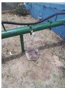
Foto 3 - Torneira para coleta de água.
