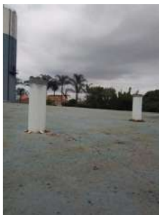
Foto 3 - Tubo de respiro (aberturas tampadas com telas de proteção).
