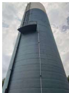
Foto 2 - Escada de acesso ao topo e fiação do para-raio.
