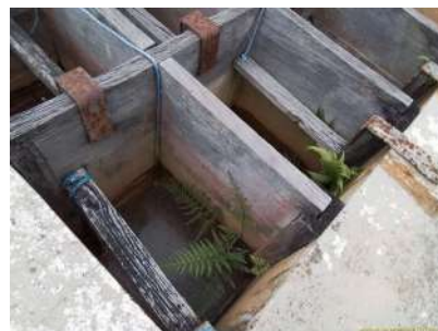
Foto 2 - Floculadores necessitando de limpeza
