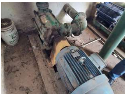
Foto 4 - Destaque para a bomba
