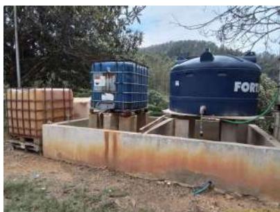
Foto 1 - Tanques de armazenamento de hipoclorito
