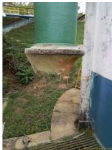
Foto 1 - Tela de proteção danificada
