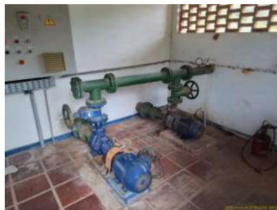
Foto 2 - Vista interna das instalações
