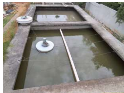
Foto 9 - Aeradores não estão em funcionamento
