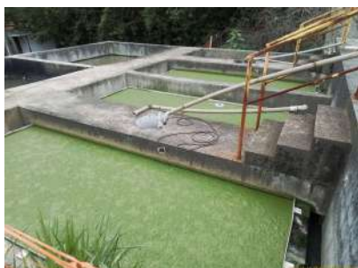
Foto 10 - Tanque de decantação
