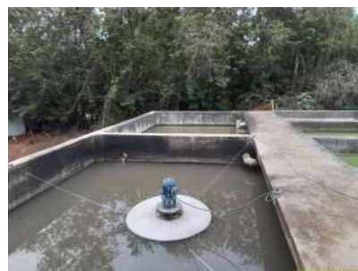
Foto 11 - Tanque de aeração
