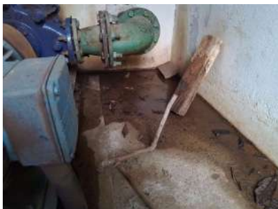
Foto 1 - Vazamento na tubulação da elevatória
