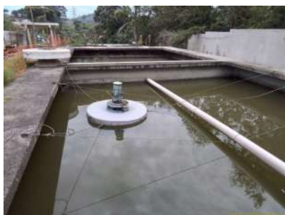
Foto 6 - Aeradores não estão em funcionamento
