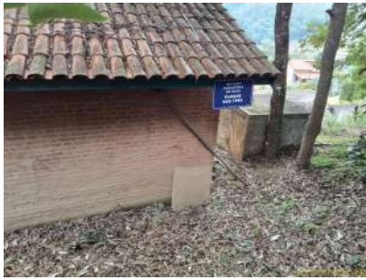
Foto 1 - Placa de identificação da EEAT
