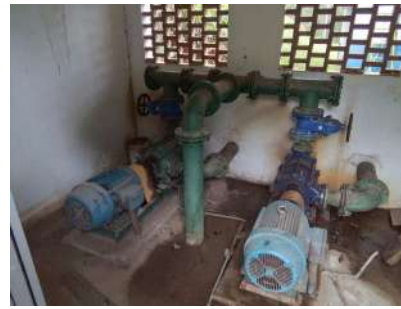
Foto 2 - Vista interna das instalações
