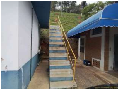
Foto 1 - Ausência de guarda-corpo na escada de acesso aos tanques
