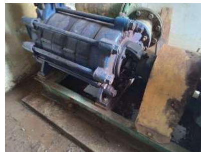
Foto 2 - Vazamento na tubulação da elevatória
