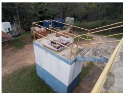
Foto 3 - Tampa do tanque de contato em más condições
