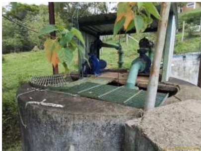
Foto 3 - Vista das bombas
