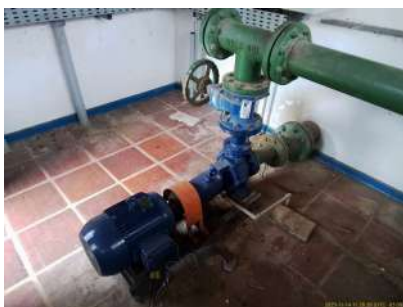
Foto 4 - Vista para uma das bombas
