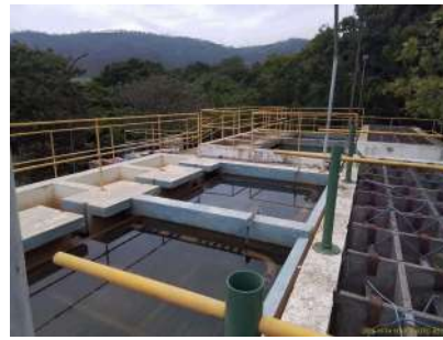
Foto 2 - Ausência de guarda-corpo nos tanques
