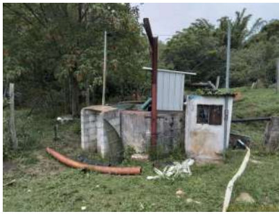
Foto 1 - Área da captação com restos de materiais, tubulações, grelhas, entre outros. Fazer a limpeza da área.
