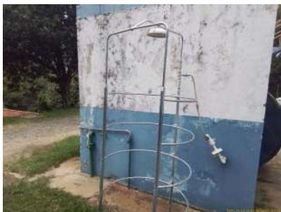
Foto 1 - Chuveiro de emergência necessita de manutenção
