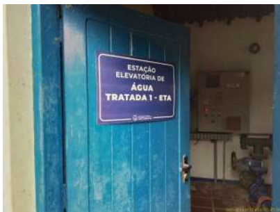
Foto 1 - Placa de identificação da Elevatória de Água
