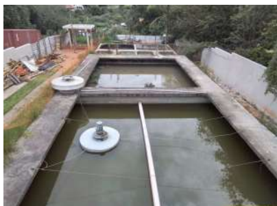
Foto 8 - Aeradores não estão em funcionamento
