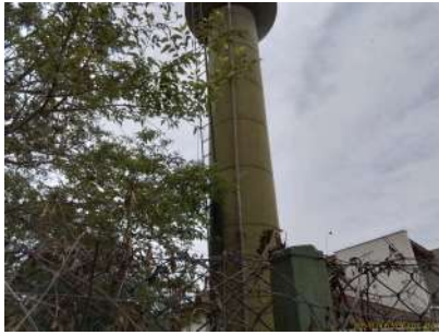
Foto 1 - Ausência de guarda-corpo
