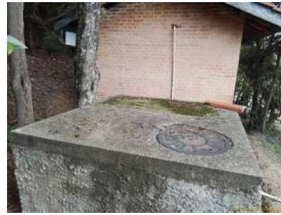
Foto 2 - Parte externa da elevatória
