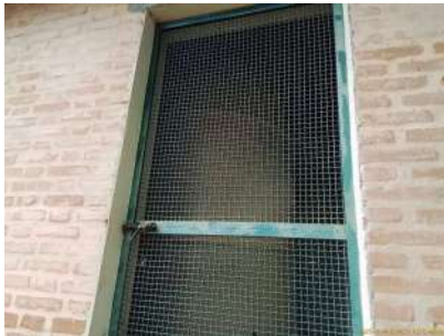
Foto 3 - Sem acesso à parte interna da elevatória para a fiscalização
