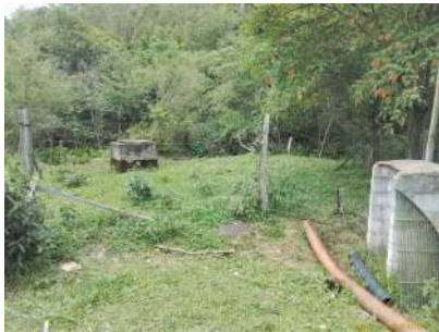
Foto 1 - Cercamento em más condições
