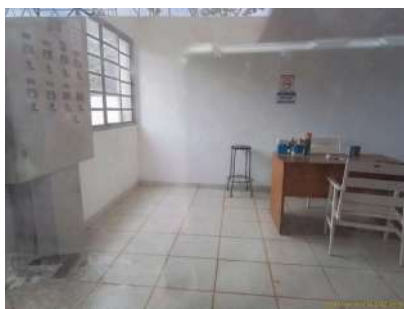
Foto 3 - Painéis elétricos, sala administrativa da ETE e laboratório, sem acesso na data da fiscalização
