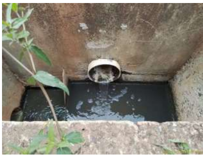
Foto 12 - Saída do esgoto
