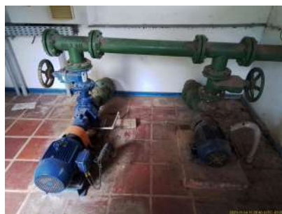
Foto 5 - Bombas da Estação
