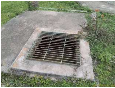
Foto 5 - Entrada da água ao sistema
