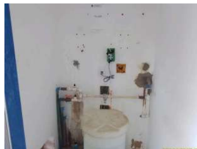
Foto 6 - Tanque de flúor para aplicação
