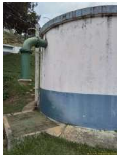
Foto 2 - Tubulação de ventilação do reservatório
