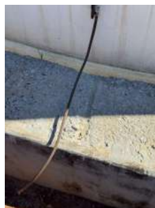
Foto 6 - Condutor de aterramento da estrutura.
