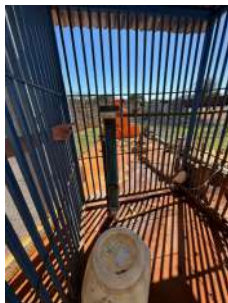
Foto 1 - Foi evidenciado vazamento na dosadora de cloro da unidade.
