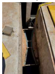
Foto 9 - Calha Parshall na entrada da unidade.
