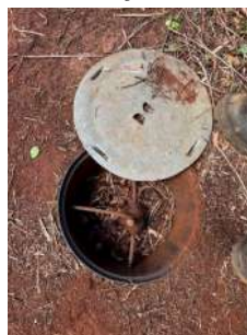
Foto 7 - Hastes de aterramento presentes na unidade.
