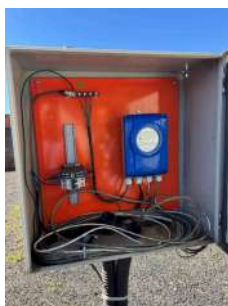
Foto 1 - Painel com mostrador do macromedidor da captação.
