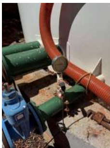
Foto 8 - Manômetro para inferência de nível do reservatório.
