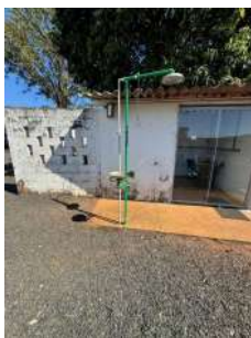
Foto 6 - Chuveiro de emergência instalado próximo ao laboratório da unidade.
