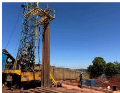
Foto 9 - Durante a fiscalização foi verificado que um novo poço está sendo perfurado no local.
