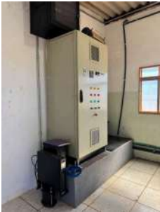
Foto 3 - Painel de comando elétrico da captação.
