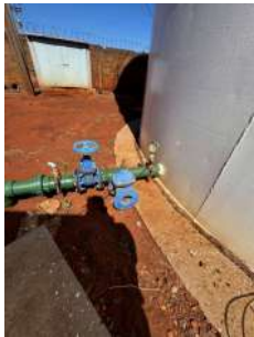
Foto 4 - Manômetro para inferência de nível do reservatório.
