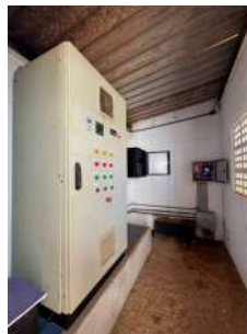
Foto 6 - Quadro de comando elétrico da captação.
