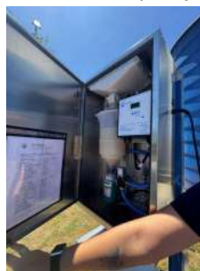
Foto 17 - Equipamento, em testes, para dosagem de microbiota no afluente à lagoa, objetivando maior estabilização da matéria orgânica.
