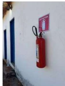
Foto 6 - Extintor disponível na unidade.
