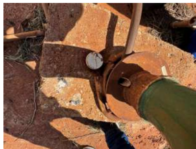
Foto 10 - Tubo para medição de nível do poço. Recomenda-se trocar a extremidade do tubo, que está quebrada, e fechá-la com um cap.
