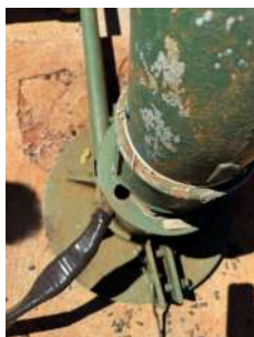
Foto 1 - Detalhe evidenciando a abertura por onde deveria passar o tubo para medição de nível.
