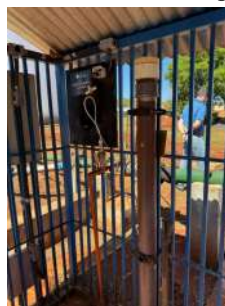
Foto 8 - Dosadora de cloro utilizada no tratamento da água captada.
