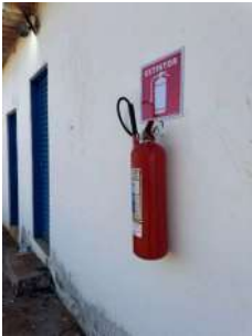
Foto 2 - Extintor de incêndio instalado na unidade.
