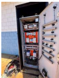
Foto 20 - Quadro de comando elétrico presente na unidade.
