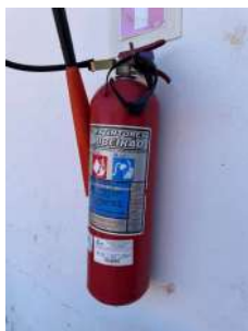
Foto 3 - Extinto de incêndio disponível na unidade.
