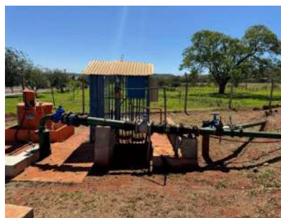
Foto 5 - Vista geral da captação.
