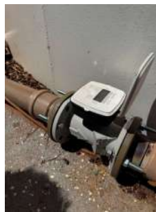
Foto 9 - Macromedidor instalado na unidade.
