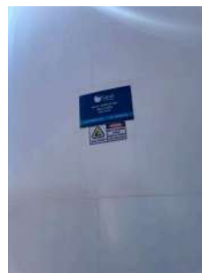
Foto 6 - Identificação da unidade afixada no corpo do reservatório.
