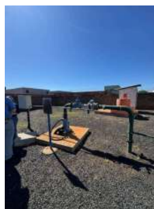
Foto 2 - Vista geral da captação.
