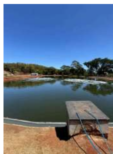
Foto 19 - Vista geral da lagoa de estabilização, aeróbica, no momento da fiscalização dois aeradores em operação.
