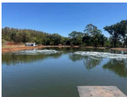
Foto 18 - Vista geral da lagoa de estabilização, aeróbica, no momento da fiscalização dois aeradores em operação.
