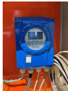
Foto 7 - Painel do macromedidor instalado na unidade.
