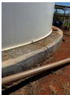
Foto 5 - Condutor de aterramento da estrutura.
