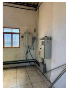
Foto 8 - Quadros de energia presentes na unidade.
