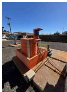
Foto 5 - Reservatório com produto químico para tratamento da água captada, e equipamento dosador..
