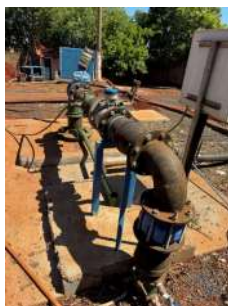
Foto 5 - Vista da captação evidenciando macromedidor e ponto de adição de reagentes utilizados no tratamento da água.
