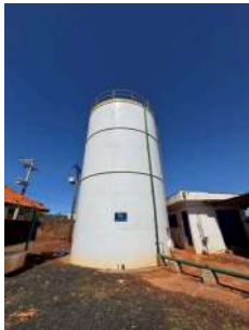
Foto 3 - Vista geral do reservatório, tubulação de alimentação à frente.
