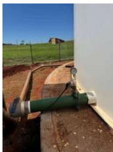
Foto 7 - Manômetro para inferência de nível do reservatório.
