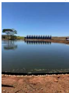
Foto 3 - Vista geral da lagoa aeróbica de estabilização. Ao fundo, reatores tipo UASB, modulares.
