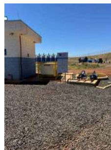
Foto 4 - Gerador e instalação para desidratação de lodo instalados na unidade.
