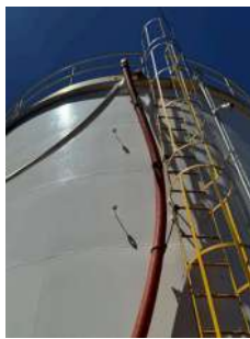
Foto 11 - Tubulação utilizada, temporariamente, em manobra para abastecimento do reservatório enquanto a captação ao lado está sob manutenção.
