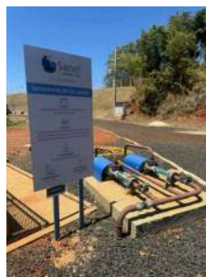
Foto 23 - Unidade para desidratação de lodos.
