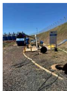
Foto 5 - Tratamento preliminar da unidade.
