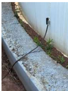
Foto 5 - Condutor de aterramento da estrutura.
