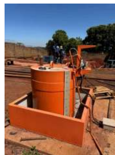
Foto 6 - Reservatório de produto químico e dosadora para tratamento da água captada.
