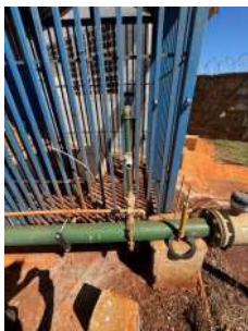
Foto 9 - Ponto de adição de reagente para tratamento da água. À direita, macromedidor instalado na captação.
