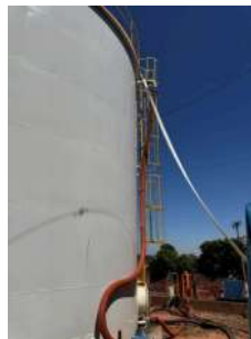
Foto 5 - Alimentação do reservatório,
