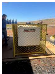
Foto 21 - Gerador de energia elétrica instalado na unidade.
