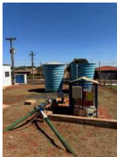
Foto 1 - Vista geral da captação.
