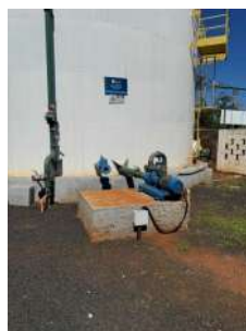
Foto 8 - Tubulação de alimentação do reservatório, à esquerda.
