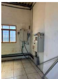
Foto 4 - Quadros de energia instalados em edificação presente na área.
