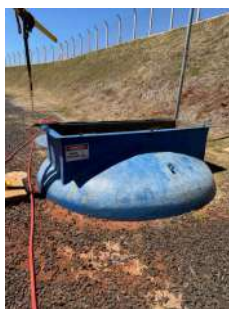
Foto 10 - Tanque de equalização após o tratamento preliminar.
