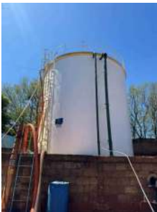
Foto 2 - Vista geral do reservatório, evidenciando tubo de alimentação à esquerda e tubo extravasor à direita.
