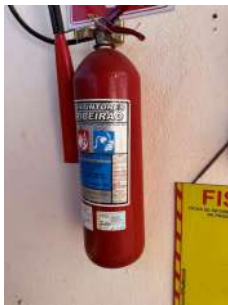
Foto 5 - Extinto de incêndio instalado na unidade.
