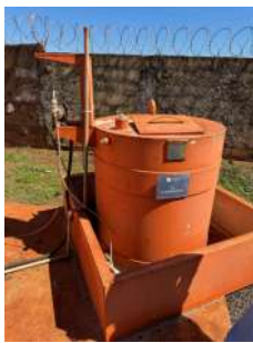
Foto 3 - Reservatório com produto químico para tratamento da água captada.
