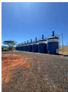
Foto 12 - Reatores UASB responsáveis pelo tratamento do efluente.
