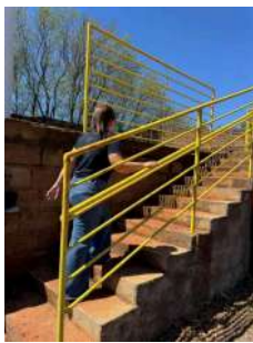
Foto 3 - Escadas e guarda corpos instalados na unidade, no acesso à parte elevada onde está o reservatório.
