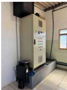
Foto 7 - Quadro de comando elétrico presente na unidade.
