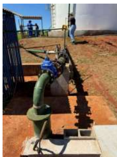
Foto 7 - Detalhe evidenciando tubo de medição e macromedidor da captação.
