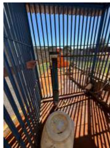
Foto 8 - Dosadora de cloro para tratamento da água captada.
