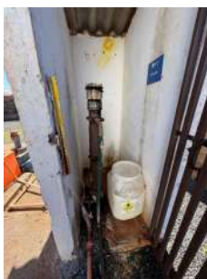
Foto 1 - Foi constatado durante a fiscalização indícios de vazamento no dosador de cloro ativo.
