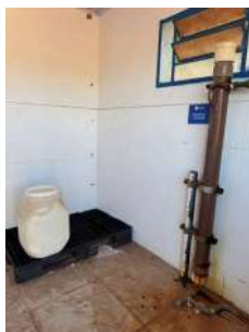
Foto 10 - Dosadora de cloro utilizada no tratamento da água captada.
