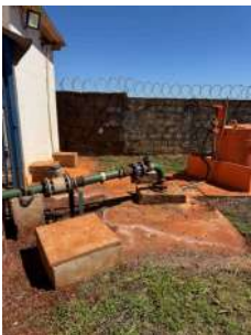
Foto 2 - Vista geral da captação.
