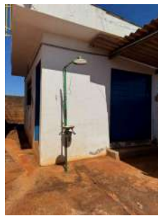
Foto 4 - Chuveiro de emergência instalado na unidade.
