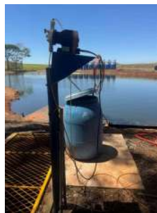
Foto 29 - Tanque de reagente químico e dosadora para adição de desinfetante no efluente final, antes do lançamento.
