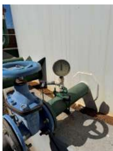
Foto 9 - Manômetro para inferência de nível do reservatório.
