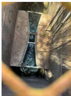
Foto 28 - Calha Parshall na saída da unidade.
