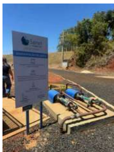
Foto 22 - Unidade para desidratação de lodos.
