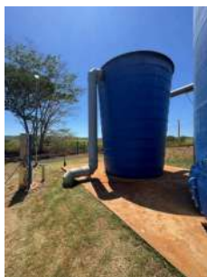
Foto 16 - Tanque de equalização após os UASBs, à montante de lagoa.
