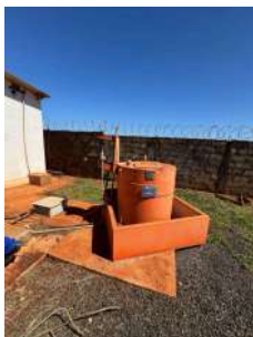
Foto 11 - Tanque de dosadora para fluoretação da água captada.
