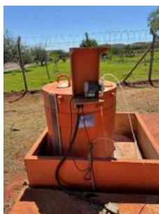
Foto 9 - Reservatório de produto químico e dosadora para tratamento da água captada.
