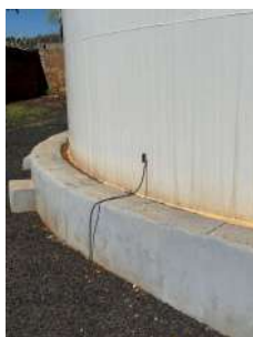
Foto 7 - Condutor de aterramento da estrutura.
