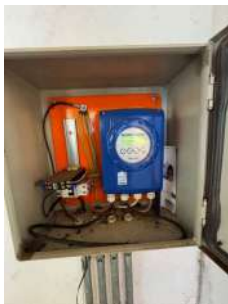
Foto 7 - Painel do macromedidor instalado na unidade.
