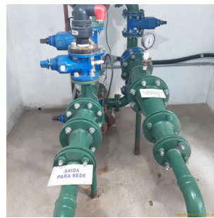
Foto 4 - Tubulação de chegada e saída da água da elevatória.
