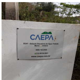
Foto 9 - Placa de identificação afixada na edificação do painel elétrico.
