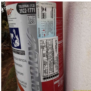
Foto 3 - Detalhe da etiqueta de controle de manutenções do extintor - dentro da validade.
