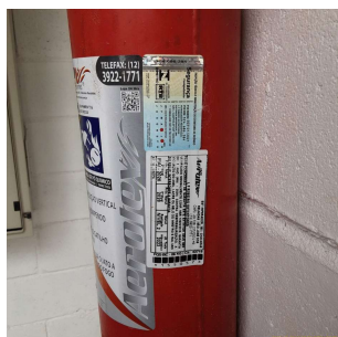
Foto 8 - Detalhe da etiqueta de controle de manutenções do extintor - dentro da validade.
