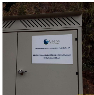
Foto 6 - Placa de identificação afixada na caixa que abriga a elevatória..
