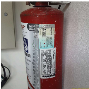
Foto 12 - Detalhe da etiqueta de controle de manutenções do extintor - dentro da validade.
