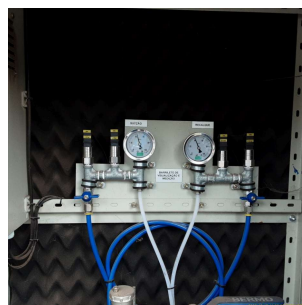
Foto 4 - Medidores de pressão.
