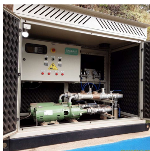
Foto 1 - Vista geral da elevatória.
