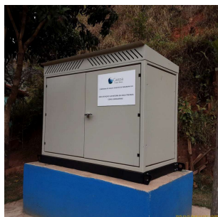
Foto 5 - Vista geral da elevatória compacta. Todos os equipamentos da elevatória estão no interior desta caixa de metal, que permanece trancada.
