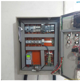
Foto 1 - Detalhe do painel elétrico sem o inversor de frequência.
