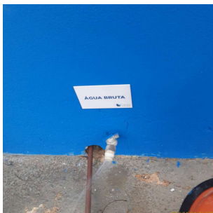
Foto 7 - Torneira para coleta de água bruta.
