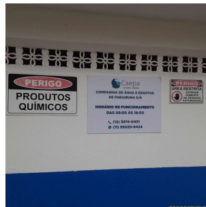
Foto 3 - Placa de identificação do poço, afixada na edificação que abriga os produtos químicos e painéis elétricos.
