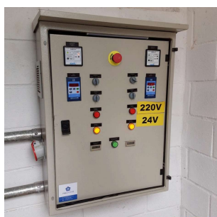
Foto 6 - Painel elétrico das bombas instaladas na elevatória.
