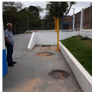
Foto 2 - Vista geral da elevatória.
