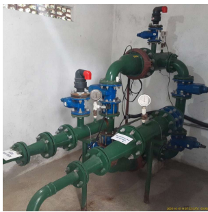
Foto 3 - Vista geral da elevatória. Há dois conjuntos moto bomba instalados na elevatória, um em funcionamento e o segundo como reserva.
