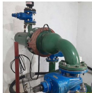
Foto 5 - Detalhe da tubulação onde uma das bombas submersas está instalada.
