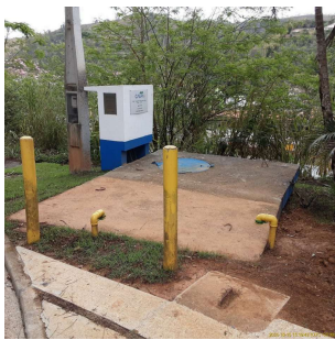
Foto 1 - Vista geral da elevatória, instalada abaixo do nível do terreno.
