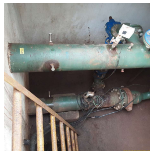
Foto 7 - Tubulação da elevatória.
