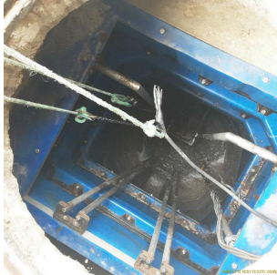
Foto 8 - Vista interna do poço de sucção das bombas. Há duas bombas instaladas no local, uma em funcionamento e a segunda como reserva.
