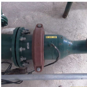
Foto 6 - Detalhe da tubulação onde uma das bombas submersas está instalada.
