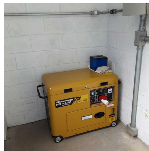
Foto 4 - Gerador de energia.
