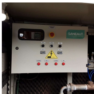
Foto 3 - Painel elétrico da elevatória.
