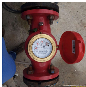
Foto 5 - Macromedidor de vazão.
