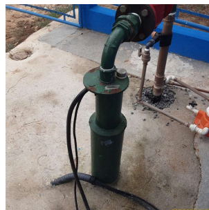
Foto 6 - Tubo de medição de nível.
