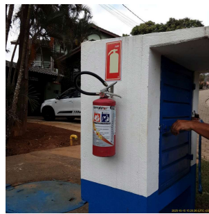
Foto 2 - Extintor de incêndio instalado na edificação que abriga o painel elétrico.
