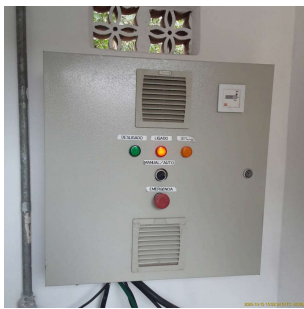
Foto 9 - Painel elétrico instalado no interior da edificação.
