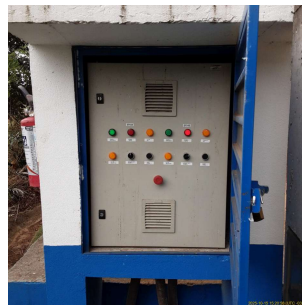
Foto 4 - Detalhe do painel elétrico.
