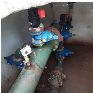
Foto 6 - Vista geral da elevatória. Há dois conjuntos moto bomba instalados (bombas submersas), um em funcionamento e o segundo como reserva.
