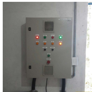
Foto 7 - Pannel elétrico das bombas. Está em falha devido a um inversor de frequência que foi retirado para manutenção.
