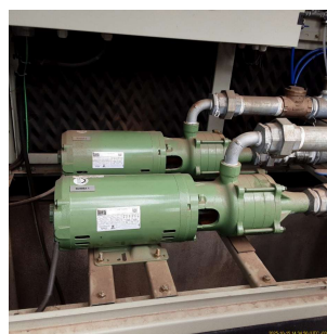
Foto 2 - Há dois conjuntos moto bomba instalados na elevatória, um em funcionamento e o segundo como reserva.
