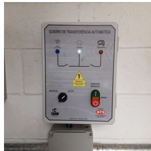
Foto 5 - Painel de controle do gerador de energia.
