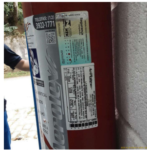
Foto 7 - Detalhe da etiqueta de controle de manutenções do extintor - dentro da validade.
