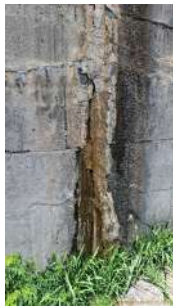
Foto 1 - Vazamento parte traseira do reservatório.
