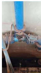
Foto 8 - Vazamento em outra válvula.
