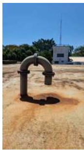
Foto 1 - Tubulação de ventilação sem tela.
