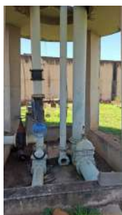
Foto 5 - Tubulações do reservatório.
