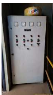
Foto 5 - Painel de controle.
