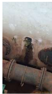
Foto 4 - Vazamento na parede dos filtros.
