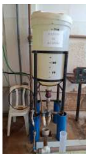
Foto 32 - Dosagem do sulfato de alumínio.
