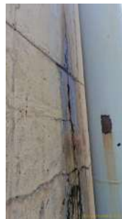
Foto 9 - Detalhe do vazamento frontal.
