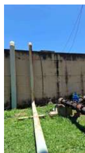
Foto 4 - Tubulações de entrada, saída e extravasor do elevado.
