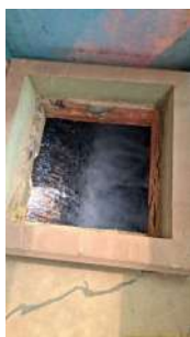
Foto 36 - Saída geral agua tratada.
