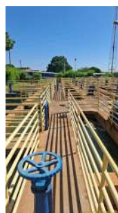
Foto 9 - Vista dos floculadores.
