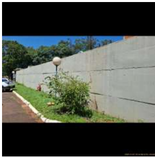
Foto 9 - Parte de trás do reservatório R1.
