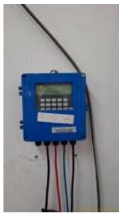
Foto 10 - Display do medidor de vazão.
