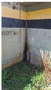
Foto 13 - Vazamento na parede ao lado dos filtros.
