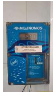
Foto 19 - Medidor de vazão da entrada da água bruta.
