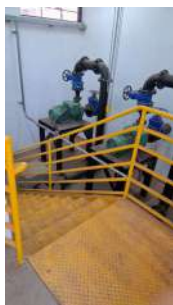
Foto 7 - Escada e, ao fundo, os conjuntos motobombas.
