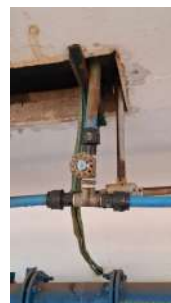
Foto 2 - Vazamentos nos registros do sistema hidráulico dos comandos.
