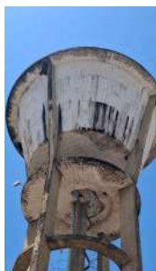
Foto 1 - Vazamentos no reservatório.
