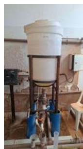
Foto 33 - Dosagem de Hipoclorito de sódio.
