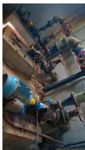
Foto 9 - Vista dos conjuntos motobombas.
