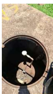
Foto 5 - Tubulação de saída com manômetro.
