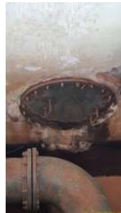
Foto 6 - Vazamento na entrada de inspeção dos filtros.
