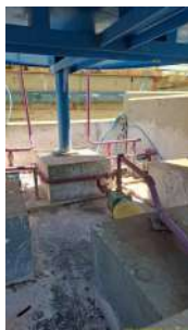
Foto 45 - Bombas doadoras do hidróxido de cálcio.
