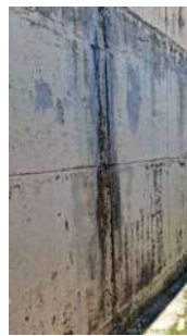
Foto 7 - Mais um vazamento na lateral do reservatório.
