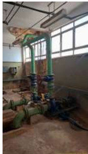
Foto 43 - Bombas de lavagem dos filtros.
