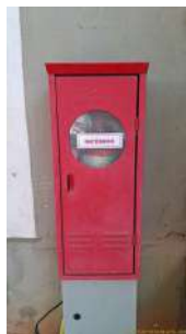
Foto 2 - Abrigo do extintor de incêndio.
