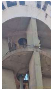
Foto 1 - Acesso à água tratada sem fechamento.
