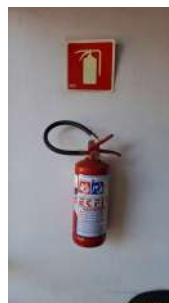
Foto 29 - Extintor de incêndio.
