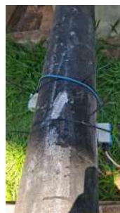
Foto 8 - Medidor de vazão na tubulação de alimentação.
