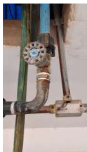
Foto 1 - Vazamento no registro do sistema hidráulico dos comandos.
