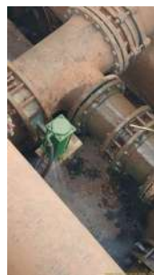
Foto 10 - Vazamento no sistema de lavagem de filtros.
