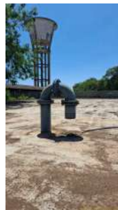
Foto 6 - Detalhe da tubulação de ventilação sem tela.
