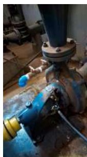
Foto 2 - Detalhe do vazamento.
