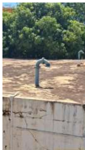
Foto 3 - Tubulação de ventilação sem tela de proteção.
