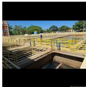
Foto 17 - Sistema de tratamento
