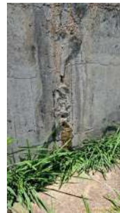
Foto 2 - Outro vazamento na parte de trás do reservatório.
