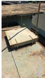
Foto 13 - Caixa de inspeção do extravasor.
