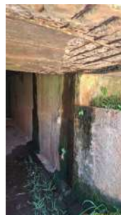
Foto 12 - Vazamento na passagem entre os módulos de tratamento.
