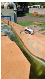
Foto 5 - Medidor de vazão ultrassônico na calha Parshall.
