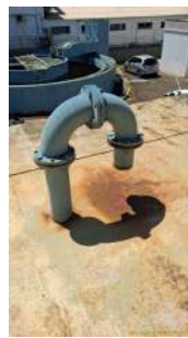
Foto 2 - Outra tubulação de ventilação sem tela.
