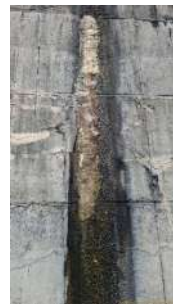
Foto 4 - Detalhe do vazamento.
