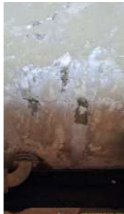
Foto 5 - Outro vazamento na parede dos filtros
