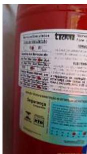
Foto 30 - Validade do extintor de incêndio.
