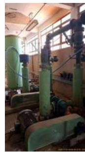
Foto 42 - Sopradores de lavagem dos filtros.
