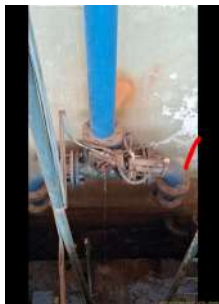
Foto 7 - Vazamento na válvula.
