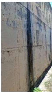
Foto 6 - Outro vazamento na lateral do reservatório.
