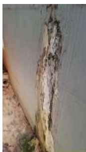
Foto 1 - Vazamento no reservatório localizado ao lado da EEAT do Jardim Rosana.
