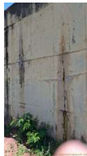
Foto 10 - Mais vazamentos na parte frontal do reservatório.
