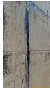
Foto 5 - Vazamento na lateral.
