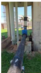
Foto 7 - Tubulação de alimentação.
