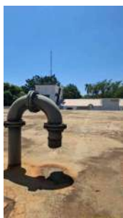
Foto 3 - Tubulação de ventilação.
