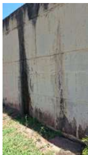
Foto 11 - Mais vazamentos identificados na parede da frente do reservatório.
