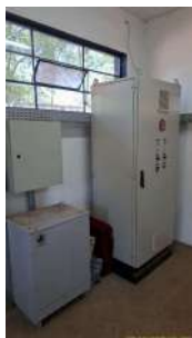
Foto 5 - Painéis de controle e de energia.
