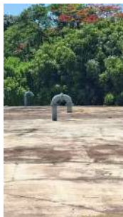
Foto 5 - Ao fundo, tubulação de ventilação sem tela de proteção.
