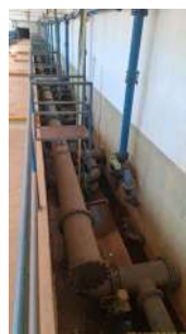
Foto 37 - Tubulação e válvulas da lavagem de filtro e das saídas dos floculadores.
