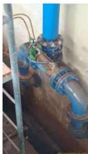
Foto 9 - Vazamentos nas válvulas do sistema de aeração.
