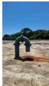
Foto 4 - Tubulação de ventilação desprovida de tela.
