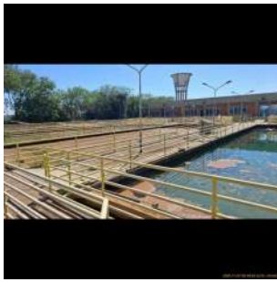
Foto 12 - Vista dos decantadores.
