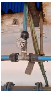
Foto 3 - Mais vazamentos no sistema hidráulico.
