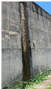
Foto 3 - Mais um vazamento na parte traseira do reservatório.
