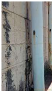
Foto 8 - Vazamento na parte frontal do reservatório, próximo à tubulação.
