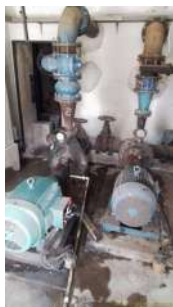
Foto 1 - Duas bombas instaladas
