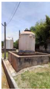
Foto 1 - Tanque para armazenamento de cloro
