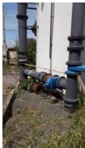
Foto 7 - Atualmente a entrada do reservatório está fechada. Assim, a água que chega é desviada por bypass para a saída do reservatório, para então alimentar a rede de distribuição sem passar pelo reservatório.
