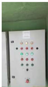
Foto 14 - Pannel do gradeamento mecanizado
