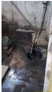
Foto 8 - Caixa que coleta efluente no caso de vazamento e retorna para o poço de sucção
