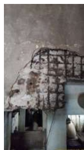
Foto 15 - Grande área com armaduras expostas, sob os filtros.
