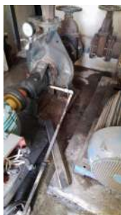
Foto 1 - Tubulação para drenagem de água de lubrificação das gaxetas
