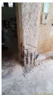
Foto 7 - Desplacamento de concreto em pilar próximo aos filtros.
