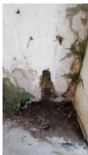
Foto 1 - Infiltração proveniente dos decantadores.
