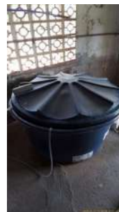
Foto 2 - Armazenamento de hipoclorito de sódio
