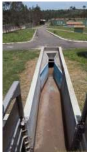
Foto 9 - Calha parshall na saída do tratamento preliminar
