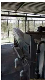
Foto 5 - Centrífuga do tratamento de lodo
