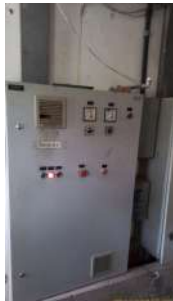
Foto 3 - Painel de comando
