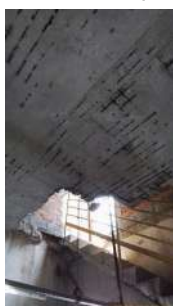
Foto 3 - Armaduras expostas na laje
