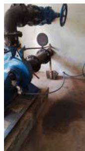
Foto 2 - Tubulação que drena água de lubrificação das gaxetas
