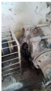
Foto 4 - Vazamento na lubrificação da gaxeta
