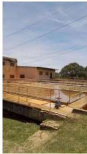
Foto 1 - Visão geral da ETA
