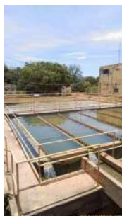
Foto 7 - Decantadores da ETA
