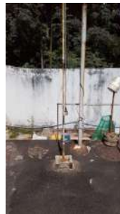
Foto 2 - Medidor de nível
