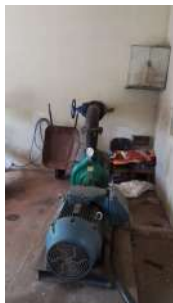
Foto 3 - Bomba instalada em operação
