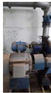
Foto 2 - Bombas de lavagem dos filtros. Apenas uma funcionando, a outra está com o rotor quebrado
