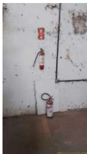
Foto 1 - Extintores na elevatória.
