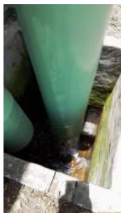
Foto 43 - Saída de efluente tratado após a desinfecção por UV
