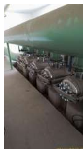
Foto 39 - Apenas alguns módulos em operação, conforme a vazão de efluente que passa pela ETE.
