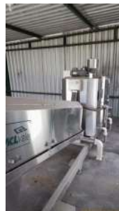
Foto 4 - Centrífuga do tratamento de lodo
