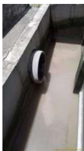
Foto 12 - Entrada de efluente tratamento preliminar
