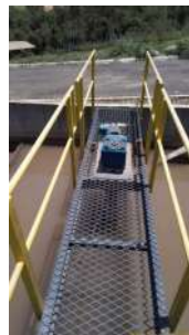
Foto 6 - Equipamento do desarenador
