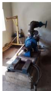
Foto 2 - Ausência de bomba reserva
