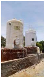
Foto 3 - Armazenamento de cloro
