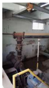
Foto 10 - Interior da elevatória
