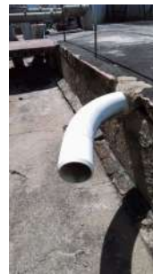
Foto 4 - É necessário vedar esta abertura com tela ou outro dispositivo
