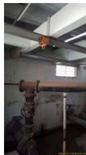
Foto 2 - Ponte rolante para içamento dos equipamentos
