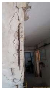
Foto 5 - Fissuras e armaduras aparentes
