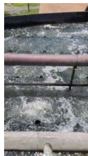
Foto 26 - Etapa aeróbica com aeração
