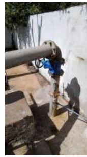
Foto 2 - Vazamento cessado nesta tubulação
