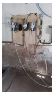
Foto 3 - Bombas dosadoras de cloro
