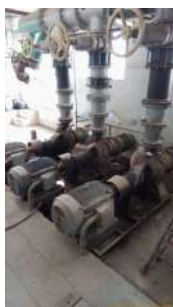
Foto 5 - Bombas da captação
