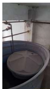
Foto 2 - Tanque para dosagem de flúor
