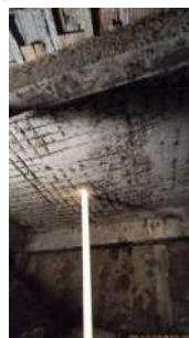
Foto 13 - Laje com armadura exposta
