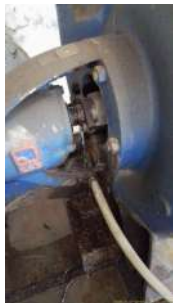
Foto 1 - Drenagem de água de lubrificação.
