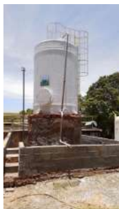
Foto 5 - Armazenamento de cloro
