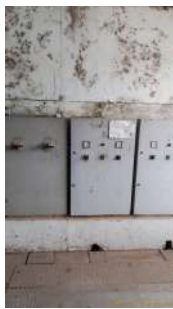
Foto 7 - Painéis de comando
