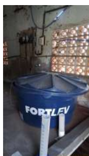
Foto 5 - Armazenamento de hipoclorito de sódio
