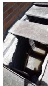
Foto 10 - Poço de sucção
