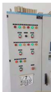
Foto 37 - Painei de comando dos sopradores
