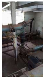
Foto 2 - Visão geral da sala de recalque.
