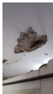
Foto 11 - Desplacamento de concreto em laje
