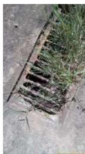
Foto 3 - Bueiro que recebe a água drenada
