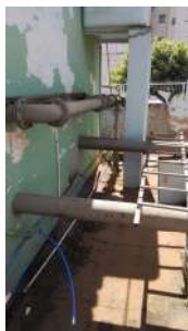
Foto 5 - Tubulação de sucção e recalque
