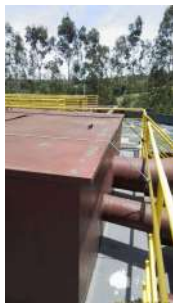
Foto 23 - Caixa de entrada do efluente
