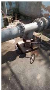
Foto 3 - É necessário vedar esta abertura com tela ou outro dispositivo
