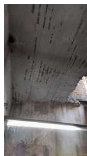
Foto 2 - Armaduras expostas na laje
