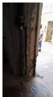
Foto 8 - Desplacamento de concreto.
