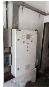
Foto 4 - Painel de comando
