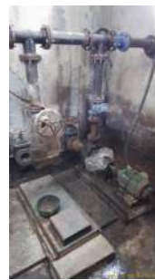
Foto 7 - Apenas uma bomba instalada
