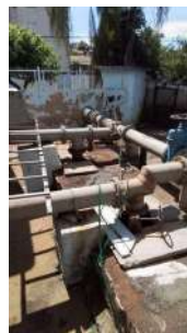
Foto 6 - Elevatória recalca água a partir do reservatório Bosquinho
