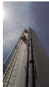
Foto 10 - Tubulações de alimentação e saída
