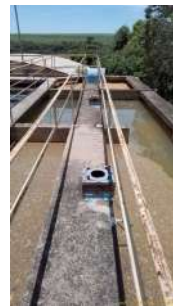
Foto 2 - Nenhum dos quatro misturadores mecânicos estavam funcionando
