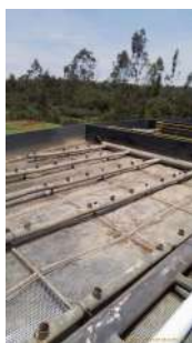
Foto 31 - Parte em manutenção. De acordo com os operadores, como a vazão que chega à ETE é bem inferior à sua capacidade, essa parte inoperante não prejudica o tratamento.
