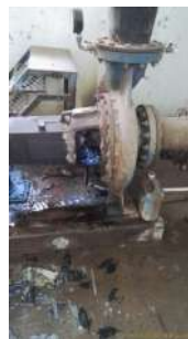
Foto 5 - Vazamento na lubrificação de gaxeta
