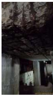
Foto 16 - Grande área com armaduras expostas
