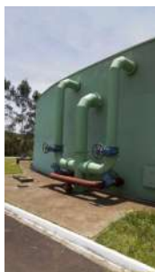
Foto 45 - Saída de efluente do reator, com destino ao tratamento UV.
