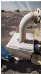
Foto 1 - Tela de proteção instalada em uma das aberturas
