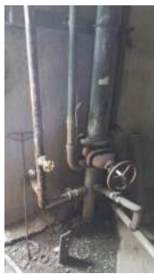
Foto 1 - Havia vazamento constante nessa tubulação. Pelo fato de o reservatório estar desativado, o vazamento cessou.
