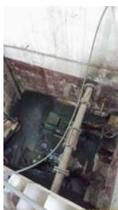
Foto 1 - Vazamento proveniente de infiltrações do poço de sucção. A elevatória estava alagada por efluente.
