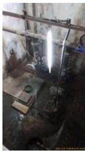
Foto 6 - Observa-se apenas uma bomba instalada
