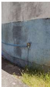
Foto 3 - Manômetro que permite leitura indireta do nível.
