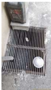
Foto 3 - Poço de sucção
