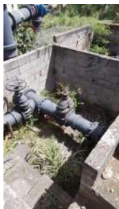
Foto 5 - Tubulações de saída do reservatório.
