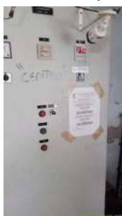
Foto 9 - Painel da bomba do Centro
