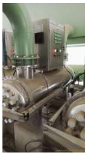
Foto 40 - Detalhe do painel de um dos módulos do tratamento UV
