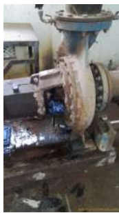
Foto 1 - Apesar de vazar, a água é direcionada a uma canaleta
