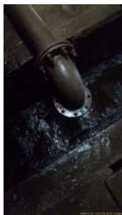
Foto 3 - Vazamentos diversos em tubulações dos filtros.
