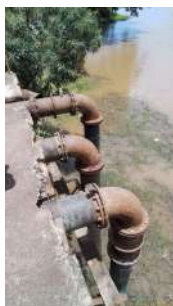
Foto 1 - Sucção da represa Pirapitingui. O nível está visivelmente baixo, devido principalmente à queda da barragem.
