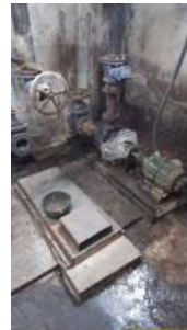
Foto 9 - Uma bomba instalada
