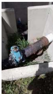
Foto 7 - Tubulação de entrada
