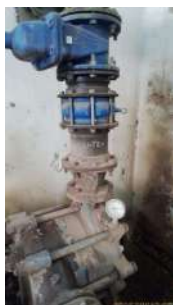
Foto 7 - Identificação do centro como destino de um dos recalques.
