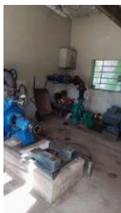
Foto 1 - Apenas uma bomba instalada
