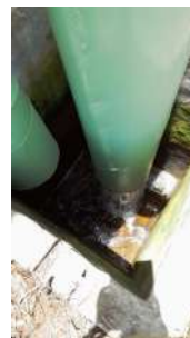
Foto 44 - Saída de efluente tratado após a desinfecção por UV
