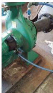
Foto 1 - Tubulação que drena água de lubrificação das gaxetas
