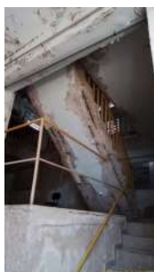
Foto 10 - Armaduras expostas em escada
