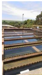
Foto 6 - Decantadores da ETA
