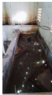
Foto 22 - Entrada de água bruta
