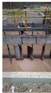
Foto 4 - Haletas no desarenador.
