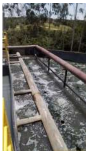
Foto 25 - Etapa aeróbica com aeração
