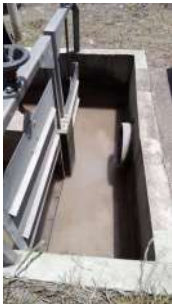
Foto 2 - Esgoto chegando à estação de tratamento
