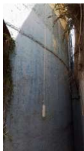
Foto 2 - Medidor de nível
