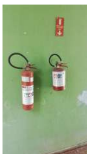
Foto 1 - Extintores na elevatória
