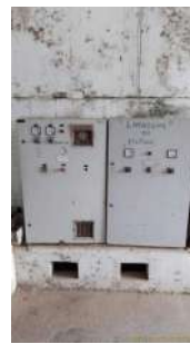
Foto 8 - Painéis de comando
