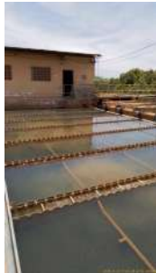
Foto 3 - Decantadores da ETA
