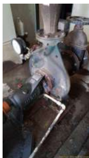
Foto 1 - Lubrificação da gaxeta está vazando. É necessário fazer ajustes para controlar o vazamento
