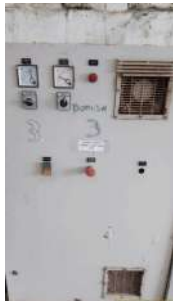
Foto 9 - Painel de comando de uma das bombas
