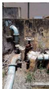
Foto 3 - Vazamento em Registro
