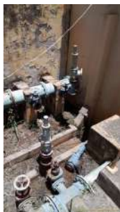
Foto 1 - Vazamentos diversos em tubulações e registros de recalque.
