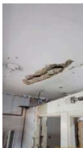
Foto 12 - Desplacamento de concreto em laje
