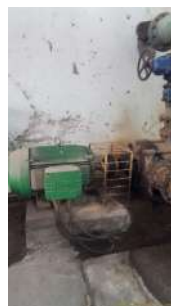
Foto 6 - Bomba que recalca para o Centro
