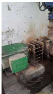
Foto 1 - Apenas uma bomba no sistema de recalque para o centro.
