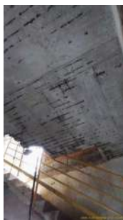
Foto 1 - Armaduras expostas na laje
