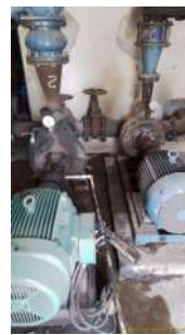
Foto 2 - Bombas da elevatória
