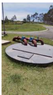
Foto 34 - Recirculação para lavagem
