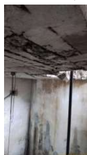
Foto 4 - Detalhe de armaduras aparentes
