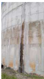
Foto 1 - Vazamento por infiltração
