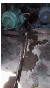
Foto 4 - Canaleta para coletar a água
