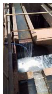
Foto 4 - Aplicação de cloro após a decantação
