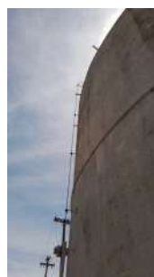
Foto 2 - Descida do aterramento
