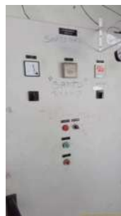
Foto 8 - Painel de comando da bomba do Santo Rizzo
