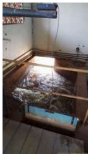
Foto 17 - Água bruta em direção aos decantadores antigos
