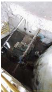
Foto 5 - Interior da elevatória
