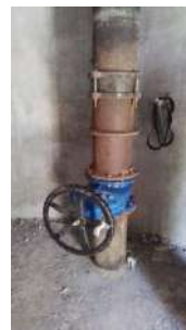
Foto 8 - Tubulação na antecâmara
