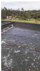
Foto 29 - Aeração no reator
