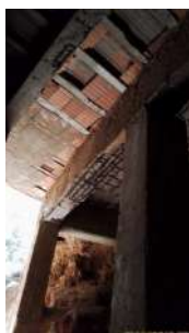
Foto 14 - Armaduras expostas em viga
