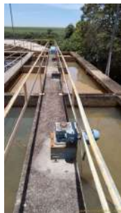
Foto 1 - Misturadores mecânicos dos floculadores permanecem danificados, sem operação
