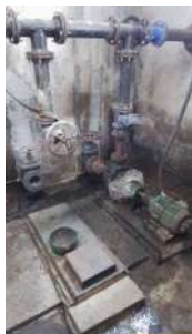
Foto 1 - Apenas uma bomba instalada.
