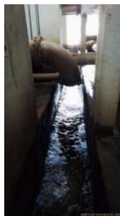
Foto 4 - Vazamentos diversos em tubulações dos filtros.
