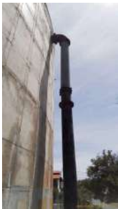
Foto 3 - Abastecimento do reservatório
