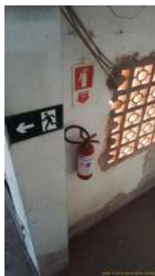
Foto 1 - Um dos extintores instalados na ETA.
