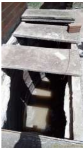
Foto 3 - Poço de sucção
