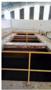
Foto 11 - Filtros da ETA
