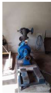
Foto 2 - Ausência de bomba reserva
