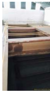
Foto 12 - Filtros da ETA
