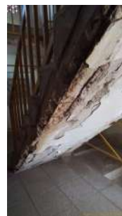
Foto 6 - Armaduras aparentes em escadas.
