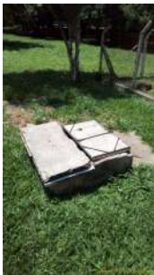
Foto 2 - Caixa que abriga o gradeamento
