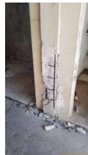
Foto 4 - Armaduras expostas em pilar.
