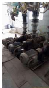
Foto 4 - Bombas da captação
