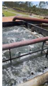
Foto 24 - Etapa aeróbica com aeração
