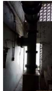
Foto 10 - Recalque de água bruta: a água da represa (tubulação à esquerda) se junta à água bruta do Rio Jaguari (que vem de baixo) para abastecimento da ETA
