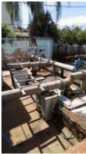
Foto 4 - Tubulações de sucção das bombas
