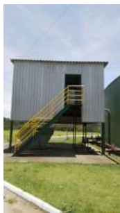
Foto 1 - Unidade de tratamento de lodo
