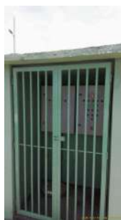
Foto 13 - Painéis de comando
