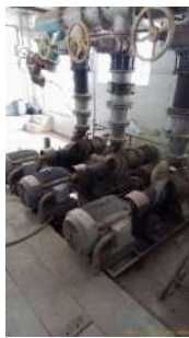
Foto 1 - As três bombas estão funcionando juntas em grande parte do tempo. Portanto, a operação está ocorrendo sem bomba reserva. Caso uma das bombas deixe de funcionar, o abastecimento poderá ser prejudicado.
