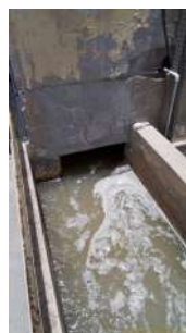
Foto 20 - Água bruta direcionada para os outros decantadores
