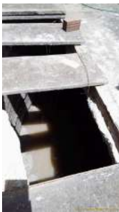
Foto 4 - Poço de sucção
