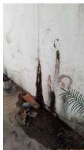
Foto 2 - Infiltração proveniente dos decantadores.
