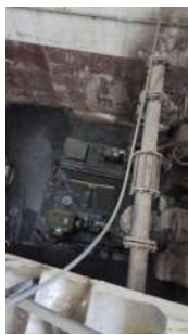
Foto 1 - Apenas uma bomba instalada
