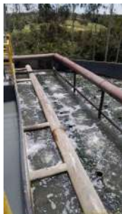
Foto 27 - Etapa aeróbica com aeração
