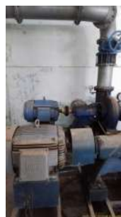
Foto 6 - Bombas de lavagem dos filtros, situadas no mesmo local.
