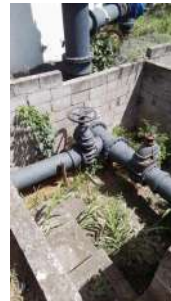
Foto 4 - Tubulações de saída do reservatório.
