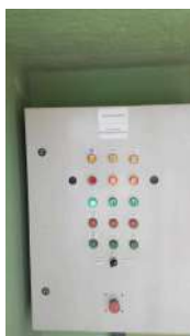
Foto 15 - Pannel do gradeamento mecanizado
