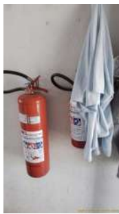
Foto 1 - Extintores na elevatória
