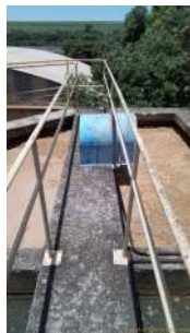
Foto 3 - Misturador mecânico inoperante
