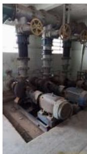
Foto 3 - Bombas da captação
