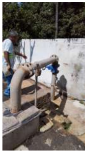
Foto 1 - Tubulação onde havia vazamento
