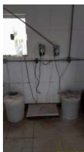
Foto 2 - Bomabs dosadoras de produtos químicos (cloro e flúor).
