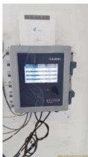
Foto 3 - Equipamento que realiza análises dos parâmetros
