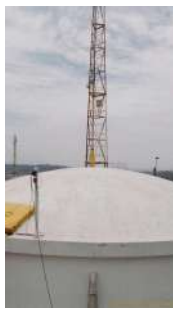
Foto 1 - Ventilação na cobertura.
