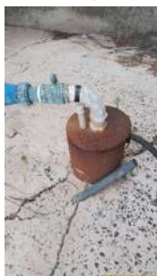
Foto 3 - Tubo para medição do nível do poço.
