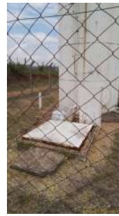
Foto 2 - Bomba que recalca para o reservatório.
