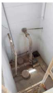
Foto 3 - Bomba que recalca água do tanque de mistura dos produtos químicos para os reservatórios da ETA.
