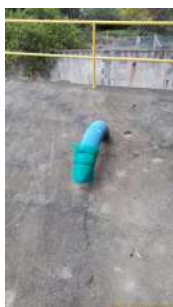
Foto 1 - Tubo de ventilação na cobertura.
