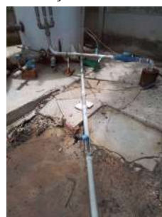
Foto 4 - Tubulação proveniente do poço 2, misturando com a água do poço 1.
