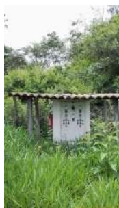
Foto 1 - Extintor junto ao painel de comando.
