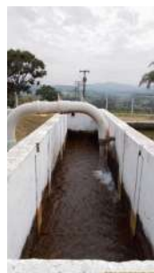
Foto 6 - entrada de água nos filtros ascendentes.
