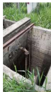
Foto 2 - Apenas uma bomba instalada.
