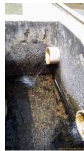
Foto 12 - Saída dos filtros ascendentes.
