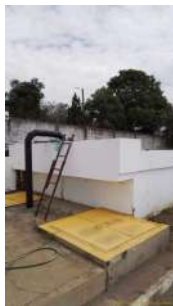
Foto 1 - Entrada de água bruta no filtro.
