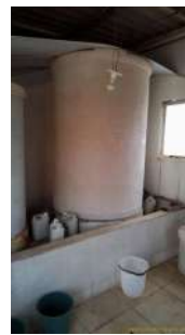
Foto 2 - Armazenamento de produtos químicos.
