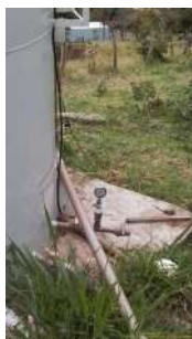
Foto 1 - Manômetro que possibilita a medição do nível indiretamente.
