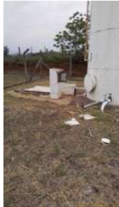
Foto 3 - Visão do sistema de bombeamento.
