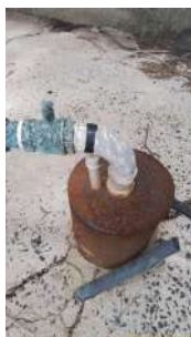
Foto 1 - Tubo para medição do nível do poço.
