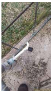
Foto 1 - Torneira para coleta de água bruta.
