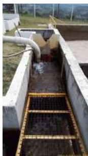
Foto 9 - entrada de água no filtro lento.
