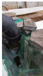
Foto 4 - Entrada de água bruta
