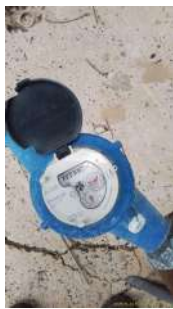
Foto 1 - Medidor de vazão no cavalete do poço.
