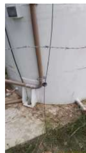
Foto 2 - Descida do aterramento.
