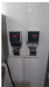
Foto 1 - Medidores de nível dos reservatórios da ETA.
