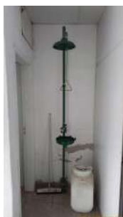
Foto 1 - Chuveiro de emergência no laboratório.
