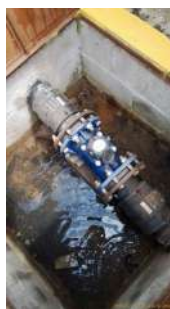
Foto 2 - Macromedidor de entrada
