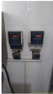
Foto 1 - Medidores de nível dos reservatórios da ETA.
