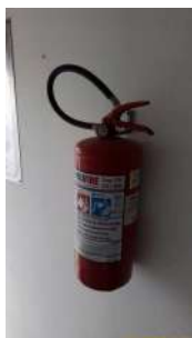
Foto 1 - Extintor na ETA.
