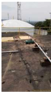
Foto 1 - Bomba situada na laje do reservatório apoiado.
