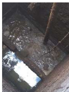
Foto 3 - Apenas uma bomba instalada.
