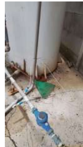
Foto 3 - Aplicação de cloro na saída do poço.
