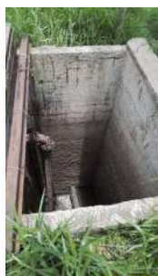
Foto 1 - Apenas uma bomba instalada.
