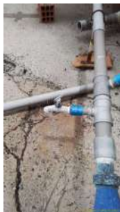
Foto 1 - Torneira para coleta de água bruta.
