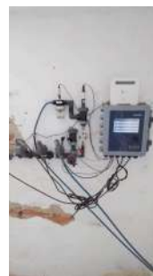
Foto 4 - Equipamento que realiza análises dos parâmetros
