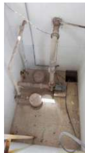
Foto 2 - Bomba que recalca água do tanque de mistura dos produtos químicos para os reservatórios da ETA.
