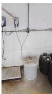
Foto 1 - Dosagem de hipoclorito de sódio.
