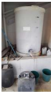
Foto 1 - Armazenamento de produtos químicos.
