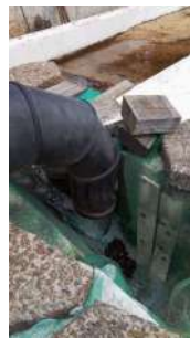
Foto 2 - Entrada de água bruta
