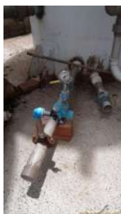
Foto 1 - Manômetro para monitoramento do nível do reservatório.
