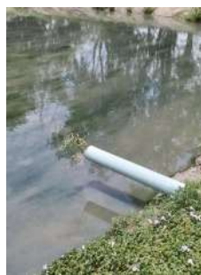
Foto 7 - Uma das tubulações de entrada está aparentemente obstruída por mato
