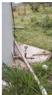
Foto 2 - Manômetro que possibilita a medição do nível indiretamente.
