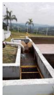
Foto 8 - entrada de água no filtro lento.
