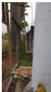
Foto 2 - Descida do aterramento.
