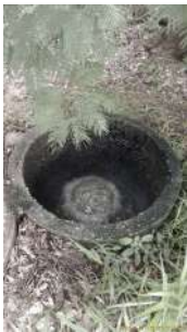
Foto 1 - Chegada do efluente à ETE, proveniente da elevatória.
