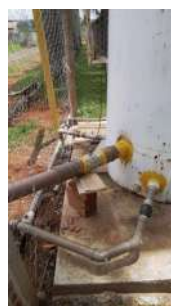
Foto 2 - Tubulações de entrada e saída.
