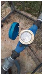
Foto 1 - Medidor de vazão no cavalete.
