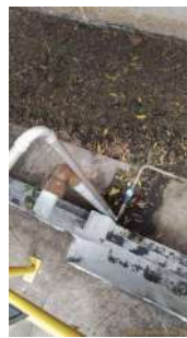
Foto 2 - Tubulação de recalque.
