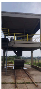
Foto 15 - ETA-5.2 - ETA JUNDIAQUARA: Novo sistema de tratamento de lodo - Caçambas de armazenamento do lodo desidratado, o material é retirado e destinado por empresa contratada.
