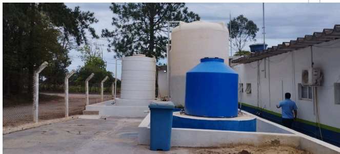
Foto 8 - ETA-5.11 - ETA JUNDIAQUARA: A área de estocagem de produtos químicos foi reformada e os tanques de produtos químicos estão instalados em diques de contenção.
