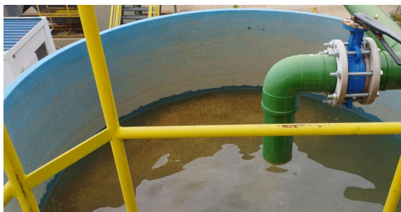
Foto 11 - ETA-5.2 - ETA JUNDIAQUARA: Novo sistema de tratamento de lodo - Tanques de decantação.
