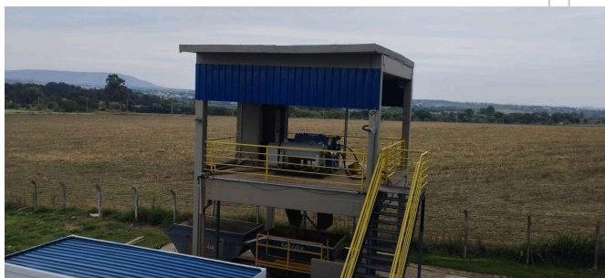
Foto 14 - ETA-5.2 - ETA JUNDIAQUARA: Novo sistema de tratamento de lodo - Centrifugas para desidratação do lodo.
