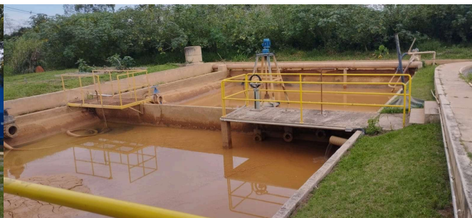
Foto 10 - ETA-5.2 - ETA JUNDIAQUARA: Novo sistema de tratamento de lodo - Tanques de homogeneização do lodo.
