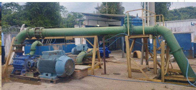
Foto 4 - EEA-4.8 - EEAB DA CAPTAÇÃO PIRAPORÃO: Os vazamentos existentes na tubulação foram consertados.
