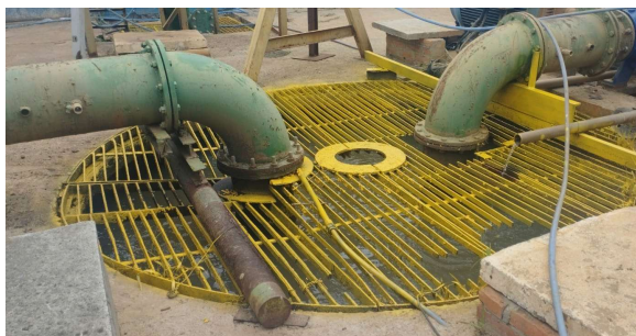
Foto 3 - CSP-3.12 - CAPTAÇÃO PIRAPORÃO: Não houve conserto ou substituição das grades de proteção.
