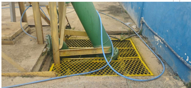
Foto 2 - CSP-3.12 - CAPTAÇÃO PIRAPORÃO: Não houve conserto ou substituição das grades de proteção.
