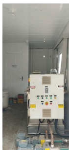
Foto 13 - ETA-5.2 - ETA JUNDIAQUARA: Novo sistema de tratamento de lodo - Equipamento de preparação e dosagem de polímero.
