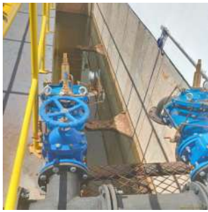
Foto 8 - Tanque de sucção, ao lado da casa de bombas.
