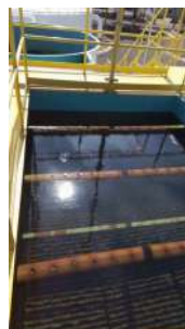
Foto 6 - Tubo coletor do decantador fora de nível.
