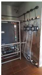
Foto 7 - Sistema de desinfecção utilizado no CR Comitivas quando o Poço do local ainda estava em operação.
