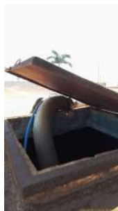
Foto 6 - Tampa entreaberta em virtude de passagem de tubulação.
