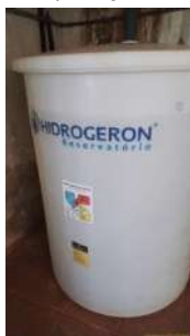
Foto 9 - Tanque do sistema de desinfecção.
