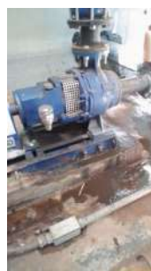
Foto 7 - Drenagem inadequada da água de lubrificação de gaxeta da última bomba de lodo.
