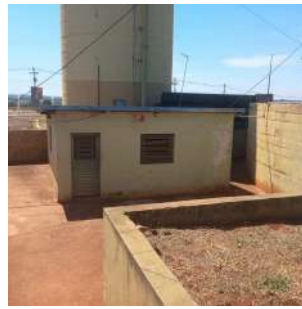
Foto 2 - Vista geral da casa de bombas da elevatória.
