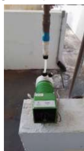
Foto 17 - Uma das bombas dosadoras de cloro.
