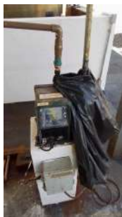
Foto 1 - Vedação inadequada do vazamento de cloreto férrico na bomba dosadora.
