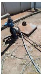
Foto 1 - Tampa com sinais de oxidação.
