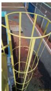
Foto 5 - Gaiola (guarda-corpo) da escada marinhoiro.
