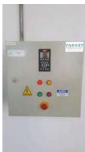
Foto 19 - Paineis de comando dos equipamentos de dosagem de geocálcio.
