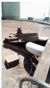
Foto 1 - Situação de uma das tampas de inspeção, entreaberta em virtude da passagem de tubulação.
