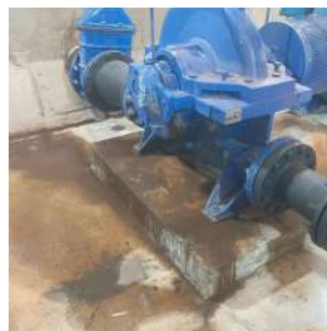
Foto 2 - Situação do piso do local, molhado devido à água de lubrificação de gaxetas.
