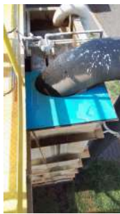
Foto 1 - Local onde há ressaltos e vazamento na chegada da água bruta.
