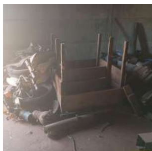
Foto 3 - Situação da área interna da base do reservatório, com diversos materiais estocados.
