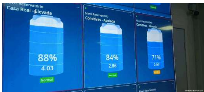
Foto 15 - Sistema de telemetria do reservatório Comitivas.
