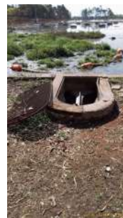
Foto 6 - Ausência de grade horizontal ou tampa para as caixas de passagem.
