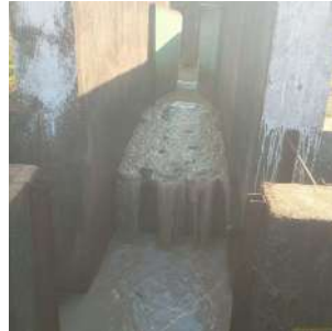
Foto 11 - Calha Parshall, sem medição adequada.
