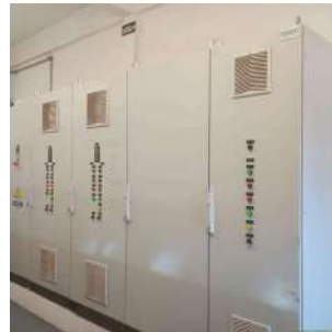
Foto 10 - Painéis elétricos e de comando da EEA.
