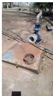
Foto 2 - Tampa com sinais de oxidação.
