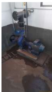
Foto 33 - Conjunto motobomba de lavagem dos filtros.
