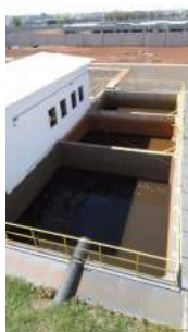
Foto 14 - Tanques de água de lavagem dos decantadores e filtros.
