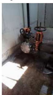
Foto 12 - Vazamento no registro da bomba BC 07.
