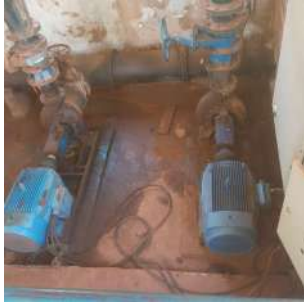
Foto 3 - Vista interna da casa de bombas.
