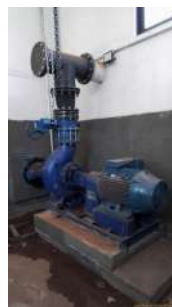
Foto 11 - Vazamento e drenagem inadequada da água de lubrificação de gaxetas da bomba de lavagem dos filtros.
