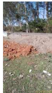
Foto 4 - Situação do entorno do canal de chegada do esgoto bruto.
