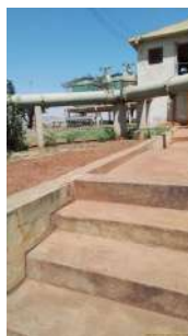
Foto 6 - Barrilete de abastecimento dos reservatórios semienterrados.
