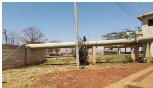
Foto 14 - Antiga tubulação de abastecimento do reservatório via Poço Comitivas (desativado).
