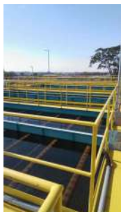
Foto 8 - Vista dos decantadores.
