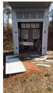
Foto 21 - Abrigo dos painéis elétricos e de comando dos aeradores, com porta deteriorada e no solo.
