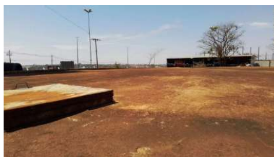
Foto 2 - Vista geral da laje do reservatório, sem tubulação de ventilação.
