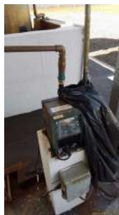
Foto 2 - Vedação inadequada do vazamento de cloreto férrico na bomba dosadora.
