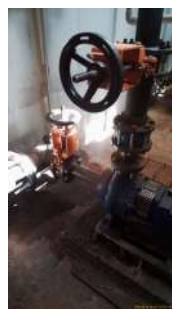
Foto 9 - Drenagem inadequada da água de lubrificação de gaxeta da última bomba de lodo.
