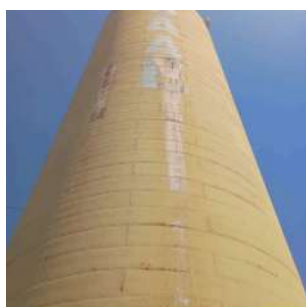
Foto 3 - Sinal de vazamento na lateral do reservatório.
