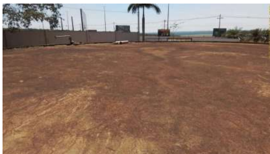
Foto 2 - Vista geral da laje do reservatório, sem tubos de ventilação visíveis.
