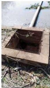
Foto 7 - Ausência de grade horizontal ou tampa para as caixas de passagem.
