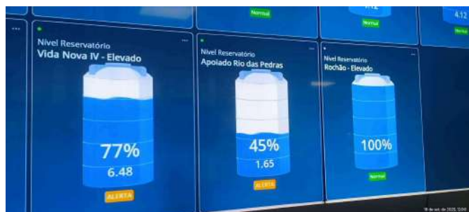
Foto 7 - Sistema de telemetria do reservatório Rio das Pedras.
