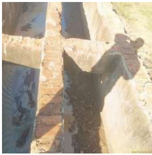
Foto 9 - Assoreamento do canal de chegada de esgoto bruto na ETE.
