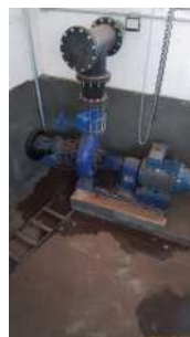
Foto 34 - Conjunto motobomba de lavagem dos filtros.
