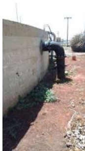
Foto 11 - Adutora de água tratada que abastece o reservatório.
