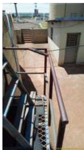
Foto 1 - Cabo de energia fixado no guarda-corpo à frente da escada.
