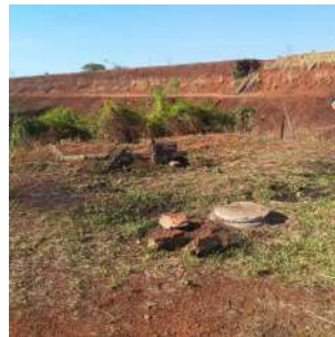
Foto 15 - PV do emissário da ETE.
