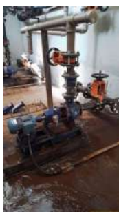
Foto 6 - Vazamento e drenagem inadequada da água de lubrificação de gaxetas de uma das bombas de lodo.
