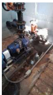
Foto 8 - Drenagem inadequada da água de lubrificação de gaxeta da última bomba de lodo.
