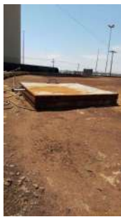
Foto 3 - Segunda tampa de inspeção entreaberta e com sinais de oxidação.
