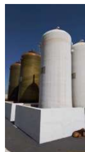
Foto 2 - Ausência de identificação adequada dos tanques de produtos químicos.
