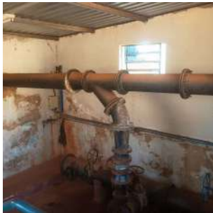
Foto 5 - Barrilete de recalque.
