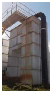
Foto 2 - Sinal de oxidação na lateral da ETA, por onde escoar a água do vazamento na chegada da água bruta.
