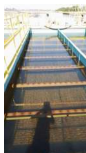
Foto 4 - Tubo coletor do decantador fora de nível.
