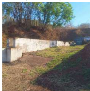
Foto 4 - Chegada do esgoto bruto.
