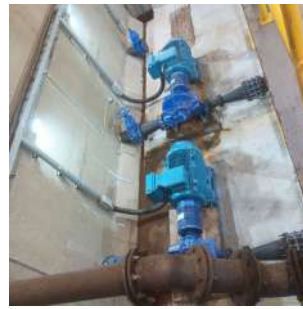
Foto 9 - Conjuntos motobomba da EEA.
