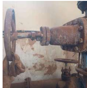
Foto 2 - Vazamento no registro.
