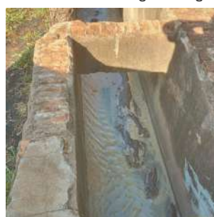
Foto 8 - Assoreamento do canal de chegada de esgoto bruto na ETE.
