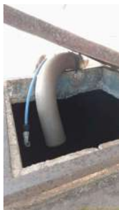
Foto 5 - Tampa entreaberta em virtude de passagem de tubulação.
