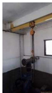
Foto 32 - Monovia e talha para remoção de equipamentos do conjunto motobomba de lavagem dos filtros.
