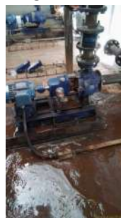
Foto 4 - Drenagem inadequada das gaxetas das bombas de e e de lodo da eta
