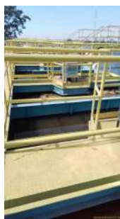
Foto 6 - Vista geral dos floculadores
