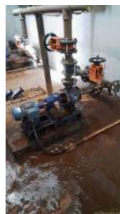
Foto 5 - Vazamento e drenagem inadequada da água de lubrificação de gaxetas de uma das bombas de lodo.
