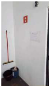
Foto 1 - Ausência de extintor de incêndios.
