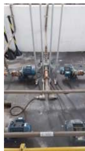
Foto 18 - Equipamentos de dosagem do geocálcio.
