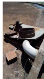
Foto 2 - Situação de uma das tampas de inspeção, entreaberta em virtude da passagem de tubulação.
