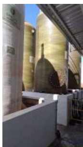
Foto 1 - Ausência de identificação adequada dos tanques de produtos químicos.
