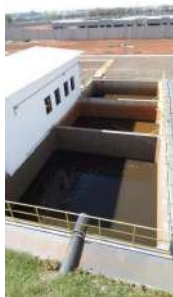
Foto 1 - Lodo dos tanques é lançado diretamente na rede de águas pluviais.
