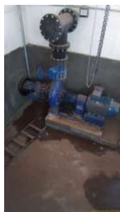
Foto 10 - Vazamento e drenagem inadequada da água de lubrificação de gaxetas da bomba de lavagem dos filtros.
