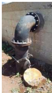
Foto 12 - Detalhe para torneira de tomada de água na adutora.
