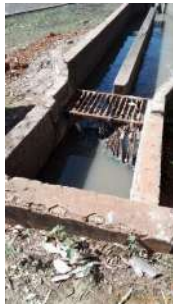
Foto 1 - Gradeamento grosseiro inadequado.
