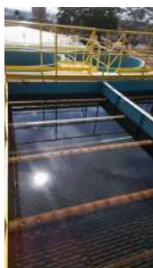
Foto 3 - Tubo coletor do decantador fora de nível.
