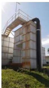
Foto 3 - Sinal de oxidação na lateral da ETA, por onde escoar a água do vazamento na chegada da água bruta.
