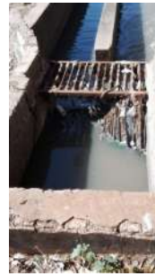
Foto 2 - Gradeamento grosseiro inadequado (grade deteriorada).
