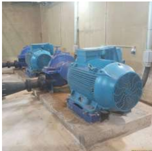
Foto 11 - Conjuntos motobomba da EEA.
