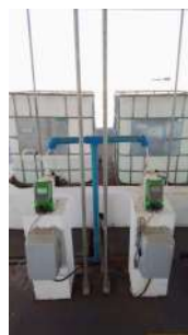
Foto 20 - Equipamentos de dosagem de flúor.
