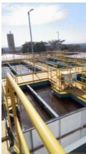
Foto 4 - Vista geral das unidades de tratamento da ETA.
