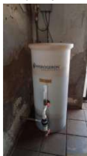
Foto 10 - Tanque do sistema de desinfecção.
