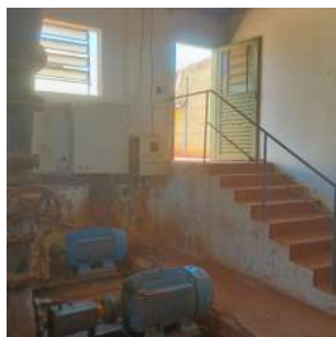
Foto 1 - Situação interna da casa de bombas, com ausência de talha/monovia para remoção dos equipamentos, se necessário.
