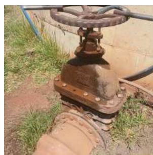
Foto 2 - Detalhe do vazamento no registro de saída.
