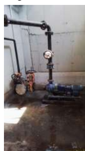
Foto 13 - Vazamento no registro da bomba BC 07.
