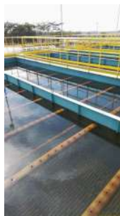
Foto 9 - Vista dos decantadores.
