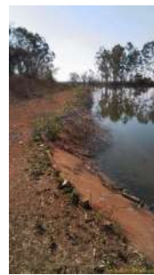
Foto 20 - Excesso de vegetação e de poda na borda da lagoa de polimento.
