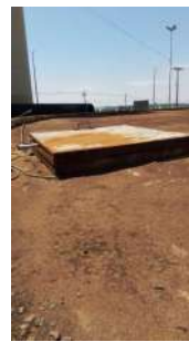
Foto 4 - Segunda tampa de inspeção entreaberta e com sinais de oxidação.
