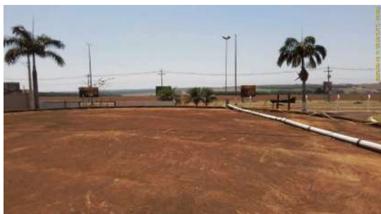
Foto 1 - Vista geral da laje do reservatório, sem tubos de ventilação visíveis.
