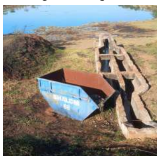
Foto 5 - Canal de tratamento preliminar do esgoto bruto antes de chegar à lagoa.
