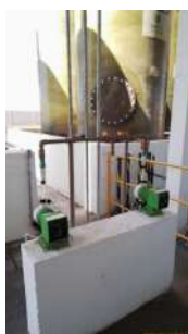
Foto 16 - Equipamentos de dosagem de hipolorito.
