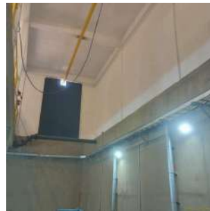
Foto 14 - Sistema de remoção dos equipamentos, se necessário.
