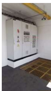
Foto 30 - Painel elétrico e de comandos da estação elevatória de lodo da ETA.
