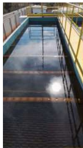
Foto 7 - Vista de um dos decantadores.
