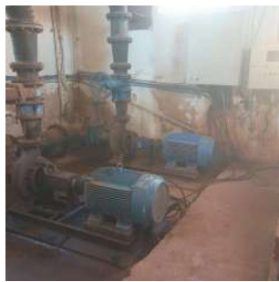
Foto 1 - Situação inadequada do cabeamento de energia da casa de bombas.
