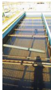
Foto 2 - Tubo coletor do decantador solto, caído.
