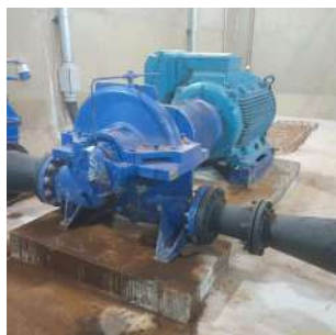
Foto 1 - Situação do piso do local, molhado devido à água de lubrificação de gaxetas.
