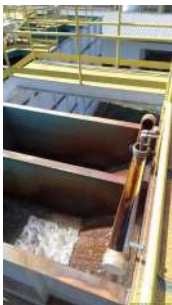
Foto 3 - Ponto de dosagem de coagulante cloreto férrico.
