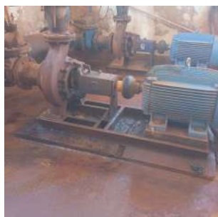
Foto 1 - Situação do conjunto motobomba mais próximo da escada.
