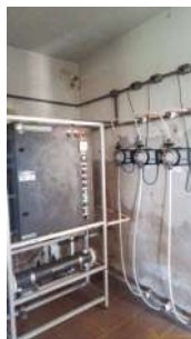
Foto 8 - Sistema de desinfecção utilizado no CR Comitivas quando o Poço do local ainda estava em operação.
