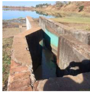
Foto 10 - Calha Parshall, sem medição adequada.
