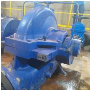
Foto 13 - Bomba de um dos conjuntos.
