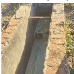
Foto 7 - Gradeamento na chegada do esgoto bruto na ETE.
