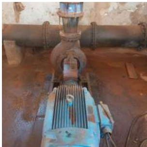
Foto 7 - Um dos conjuntos motobomba.
