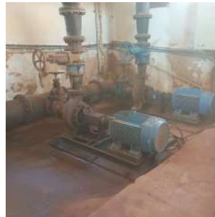
Foto 6 - Conjuntos motobomba da estação elevatória.
