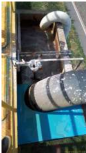
Foto 2 - Ponto de chegada da água bruta com dosagem de hidróxido de cálcio.
