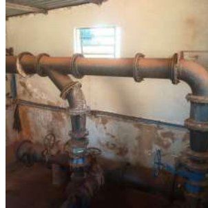
Foto 4 - Barrilete de recalque.
