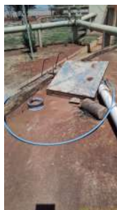
Foto 4 - Tampa entreaberta em virtude de passagem de tubulação.
