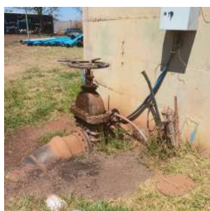
Foto 1 - Vazamento no registro de saída.
