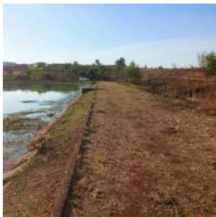
Foto 3 - Ausência completa de cercamento próximo à saída da ETE.
