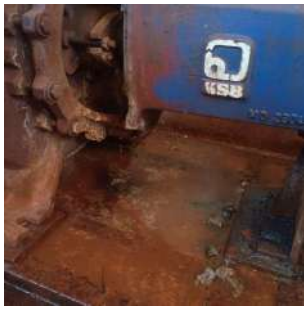
Foto 3 - Situação da água pingando no piso.
