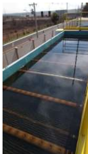
Foto 1 - Tubo coletor do decantador fora de nível.
