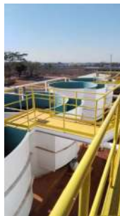
Foto 11 - Tanques de filtração.
