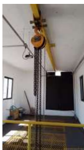
Foto 31 - Monovia e talha para remoção de equipamentos da estação elevatória de lodo.
