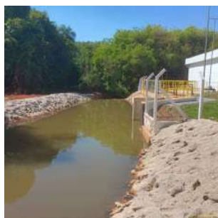
Foto 1 - Barramento e captação superficial no Rio das Pedras.
