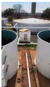
Foto 12 - Controle de nível filtros.
