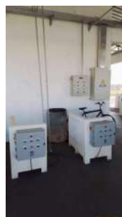
Foto 15 - Painéis de controle dos sistema da ETA e de dosagem de produtos químicos.
